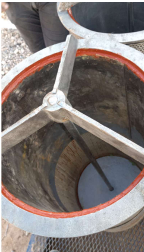
Imagen 14. Cartucho de filtro previo a su reacondicionamiento
