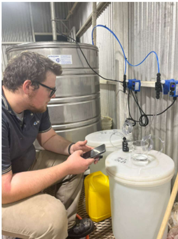
Imagen 2. Adición de productos químicos al agua de caldera.
