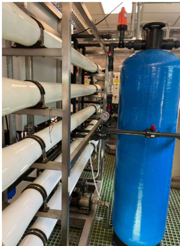
Imagen 1. Filtro Multimedia Instalado en ósmosis de agua dulce
