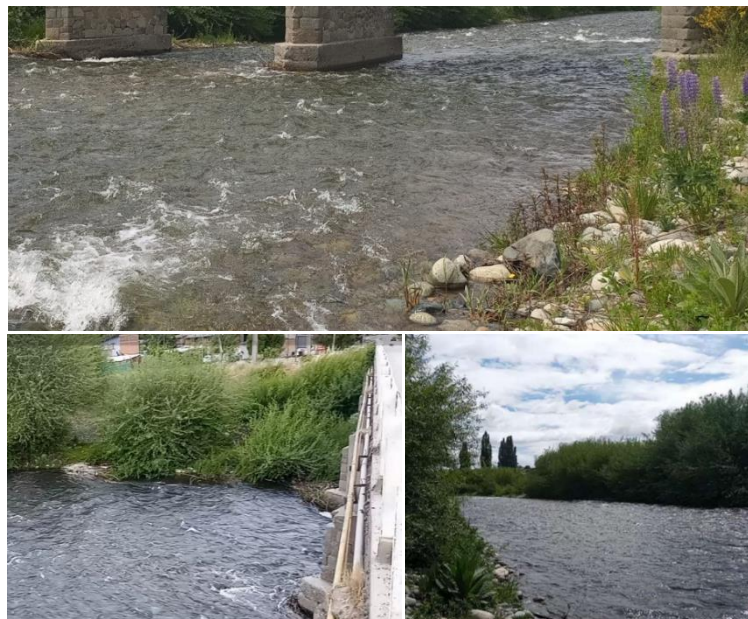
Figura No. 5 Condición de escurrimiento del río Quemquentreu al 20 de noviembre de 2024.
