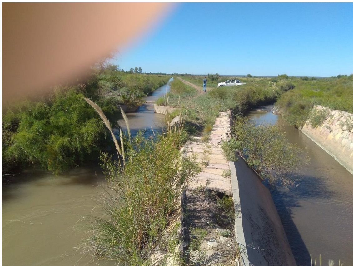
Figura 23. Salida de Antetoma. A la izquierda, canal principal de El Sauzal y aforador 1, y a la derecha descargador al río.
