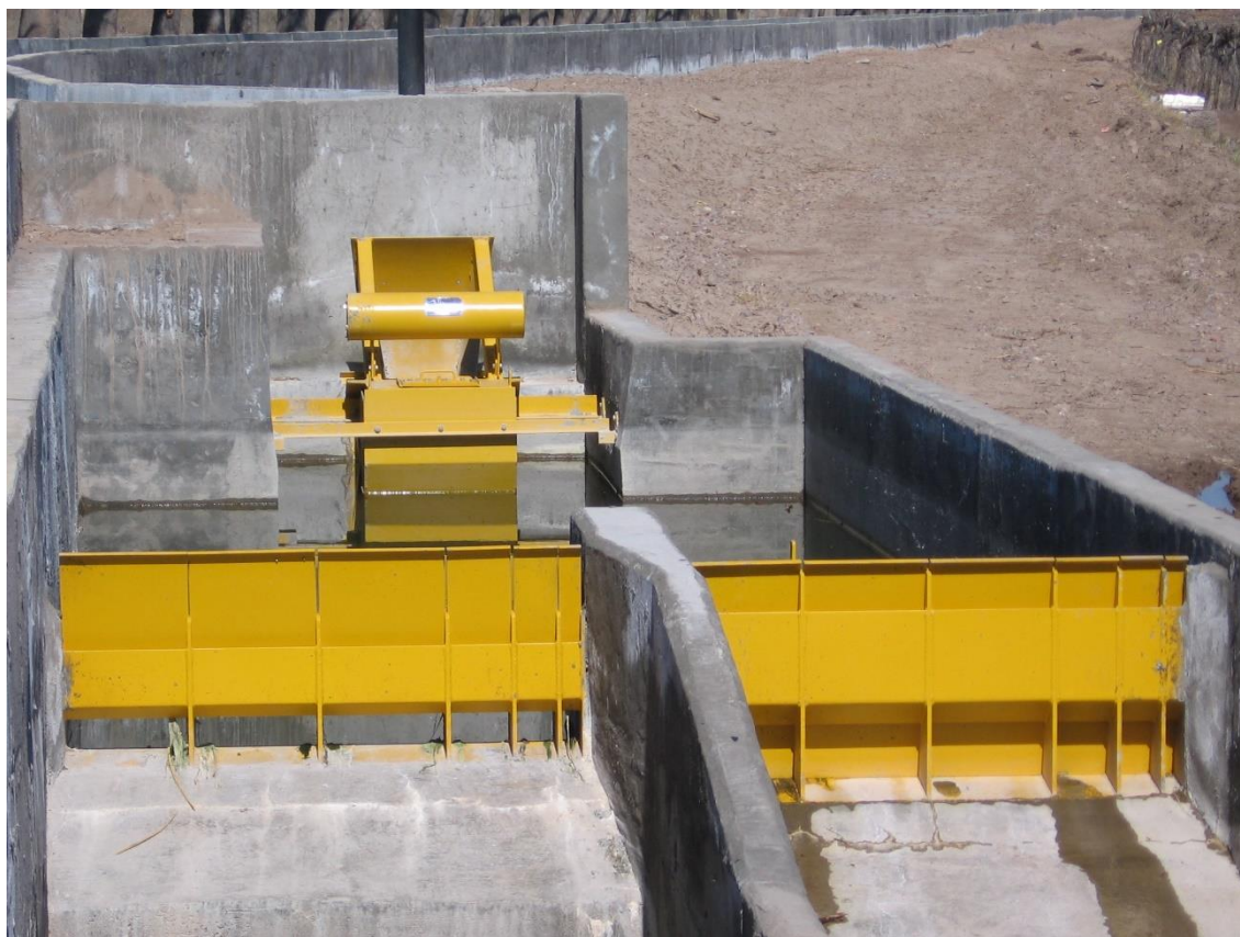
Figura 28. Compuerta de control aguas abajo y compuertas modulares en derivado de canal principal (Mendoza)
