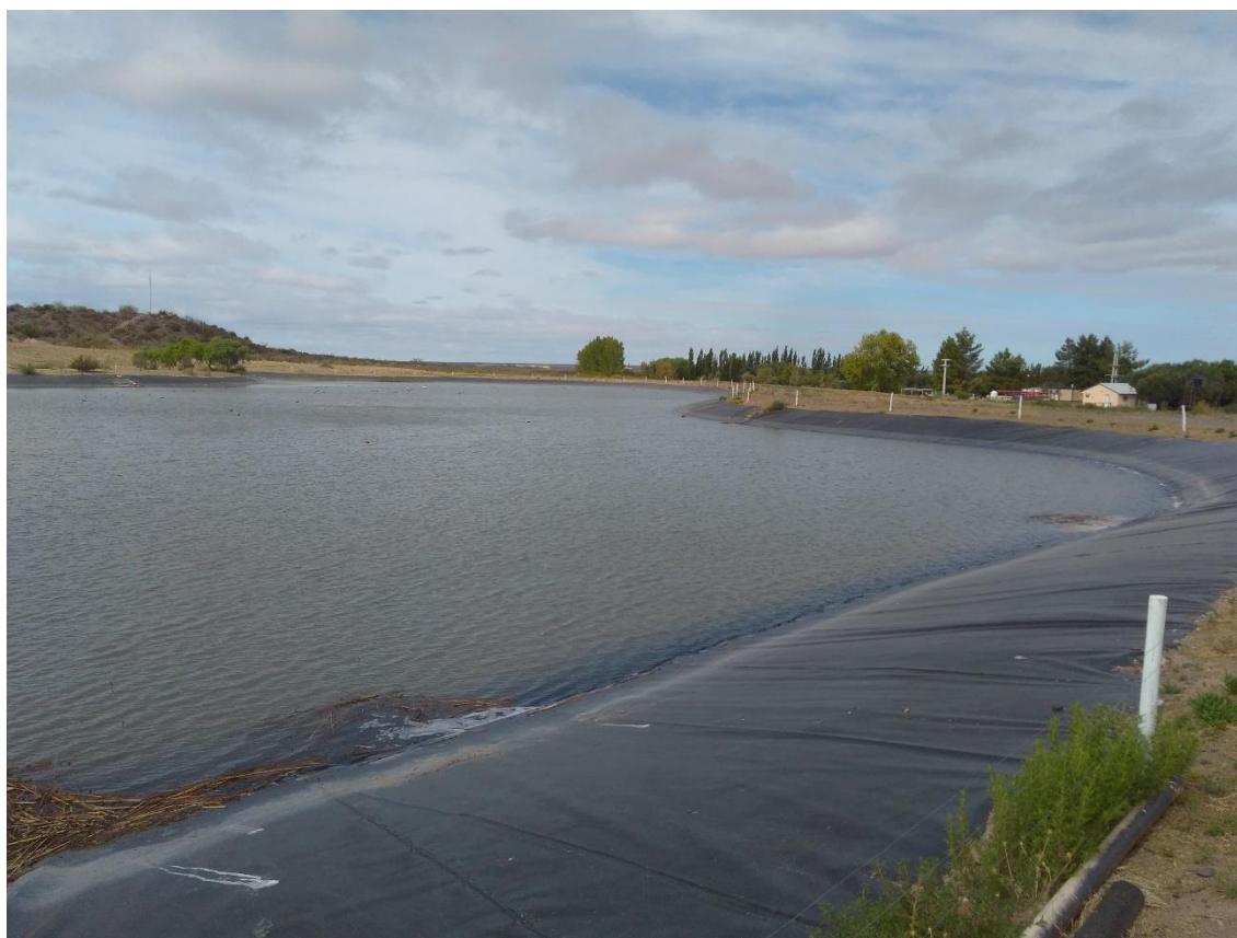
Figura 13. Reservorio con membrana impermeable (Bodega del Desierto)
