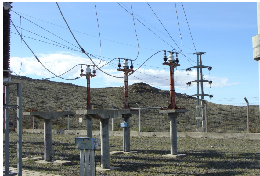
Foto 102-Salida LAT DT Bocamina
