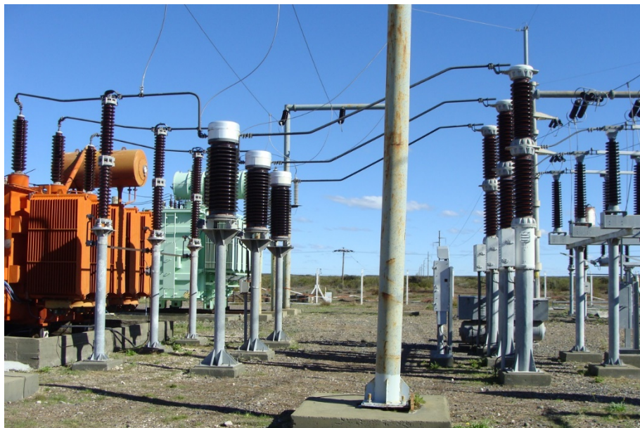
Foto 66-TP1, TP2 y Campo TP 132 kV.
