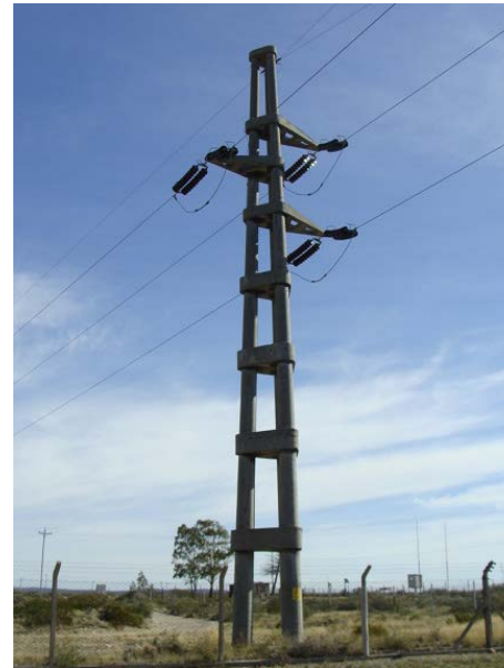
Foto 114-Retención inicial LAT
