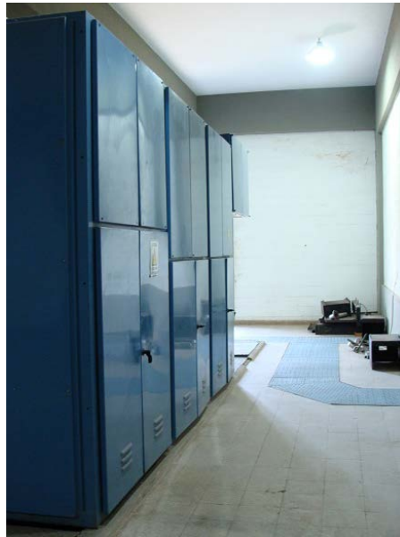
Foto 119-Sala de Celdas 33 y 6.6kV
