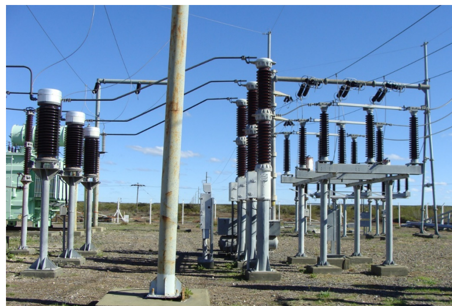
Foto 67-TP1, TP2 y Campo TP 132 kV.
