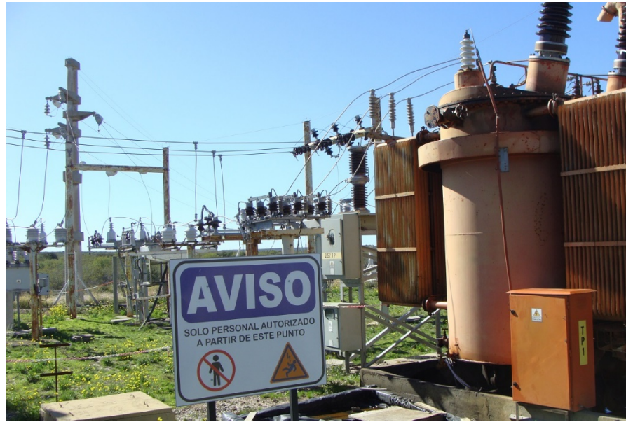
Foto 47-Vista hacia Alim. 33 kV.
