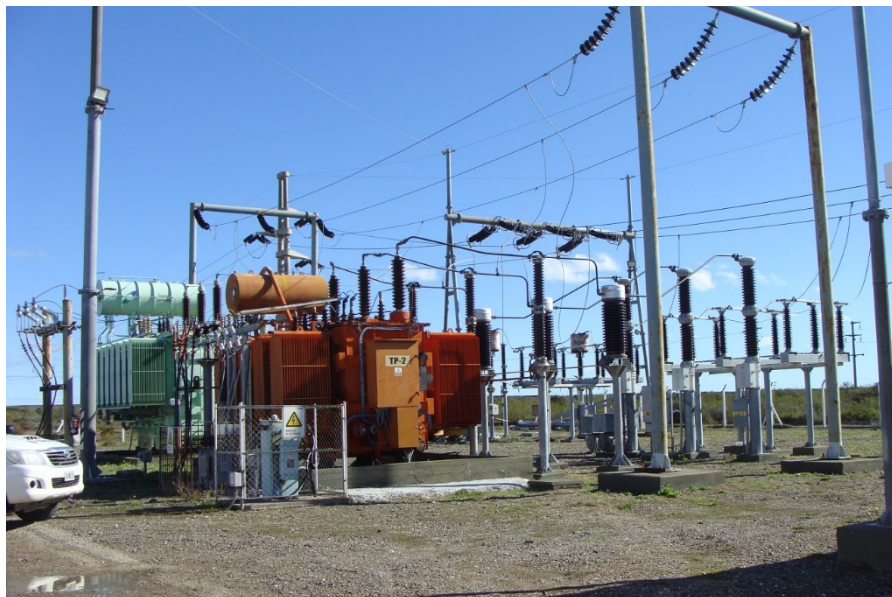
Foto 63-TP1, TP2 y Campo TP 132 kV.
