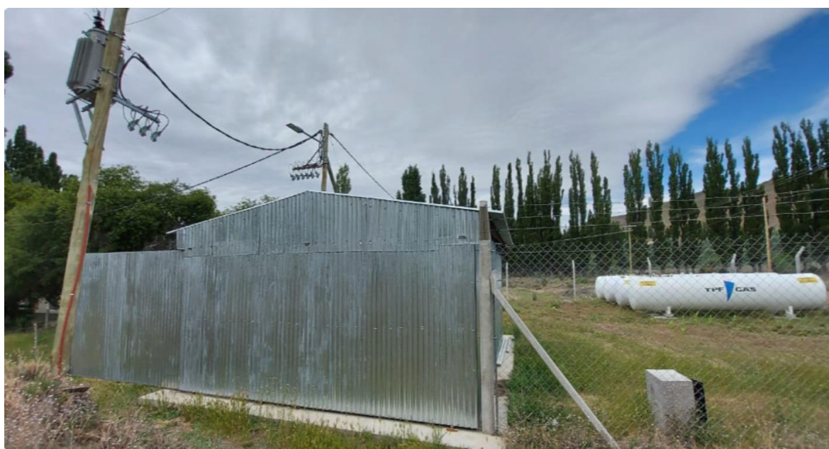
Fotografía N° 5: Vista abastecimiento de los generadores eléctricos
