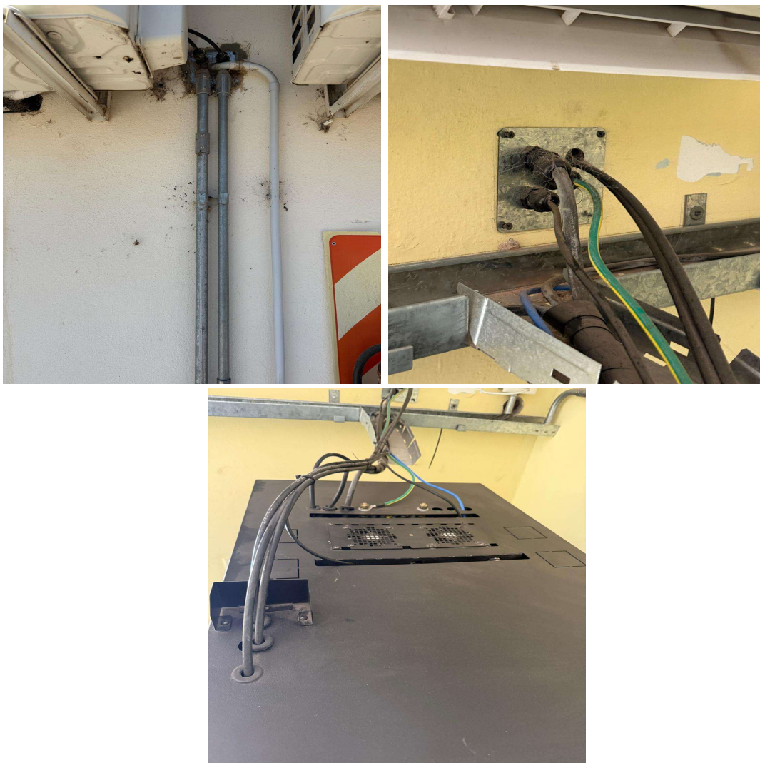
Foto ingreso de FO-Data Center o rack
