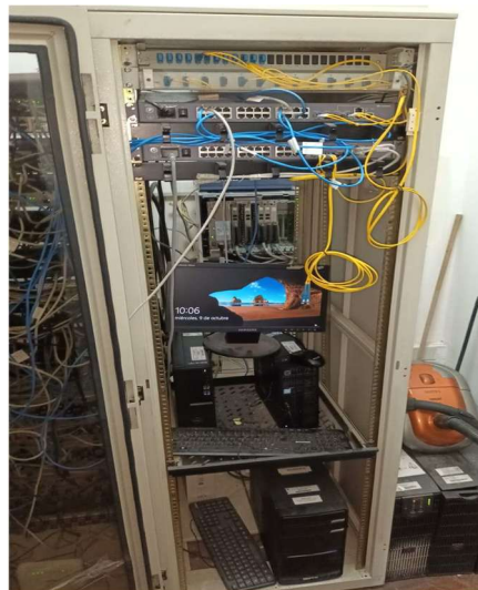
○ Fig. 28 – Foto de Rack de Frente
