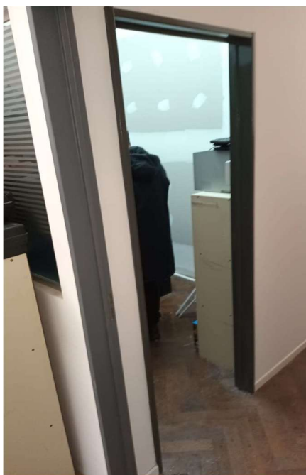
Fig. 18 - Ingreso de FO-Data Center o Rack
