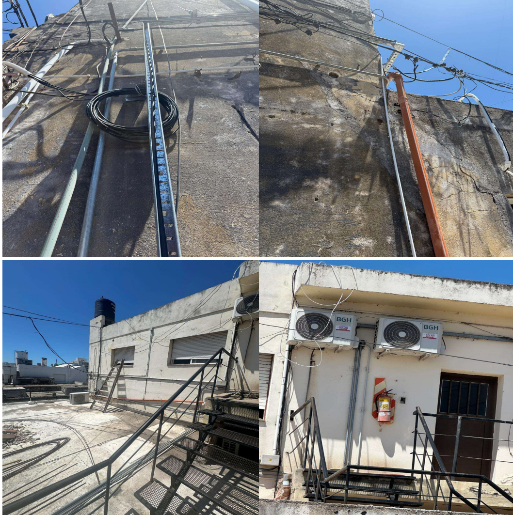
Foto acceso de FO al edificio
