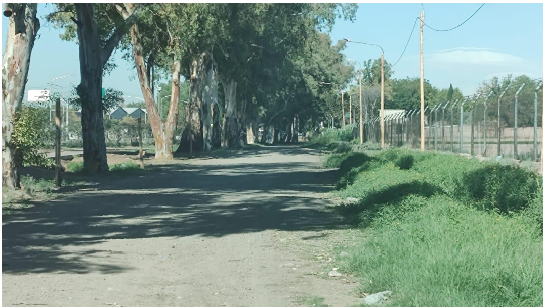
Figura 4. Vista del tipo y estado de la calzada entre calle Los Pescadores y Pedro P. Segura.
