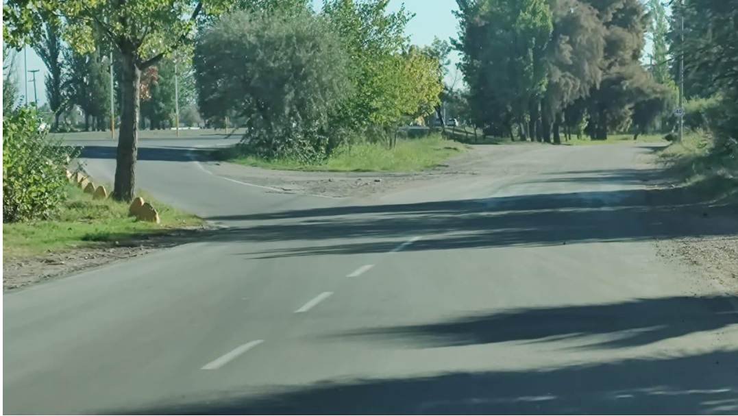
Fotografía 32. Muestra el estado de la calzada entre Calle Araoz y calle J.J. Paso.
