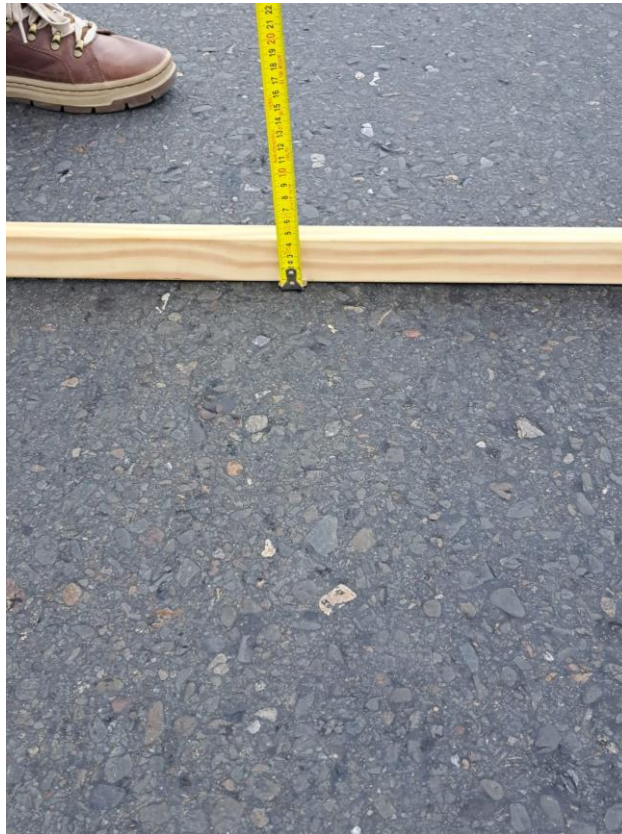
Fotografía 25. Muestra el ahuellamiento entre calle San Pedro y Calle Tirasso.
