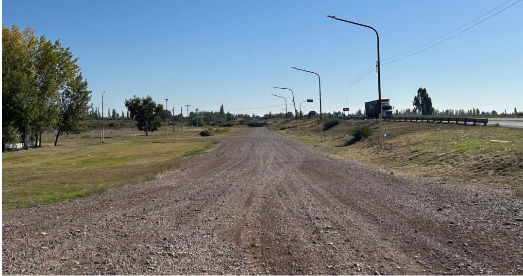
Fotografía 5: Muestra el estado de la calzada enripiada. Tramo Intersección Azcuénaga, Ruta 7, colectora Oeste.
