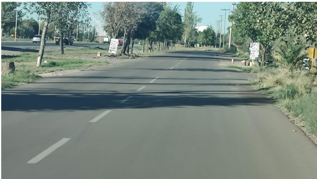
Fotografía 8. RN N 40 – J.J. Paso-Azcuénaga- Colectora Oeste (Descendente). Vista de la calzada y banquetas después del cruce con calle Malabia
