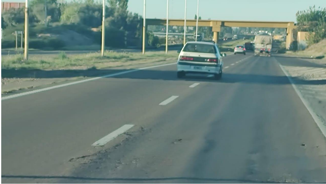
Fotografía 3: Muestra el estado de la calzada y banquetas. Tramo Intersección Azcuénaga, Ruta 7.
