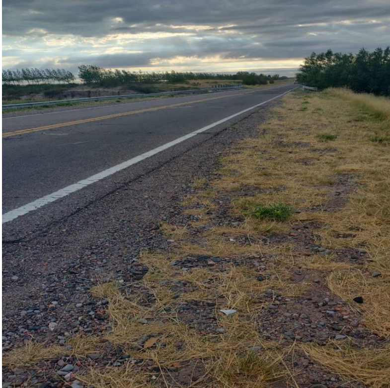
Fotografía 31. Muestra el estado de las banquetas antes de Las Paredes
