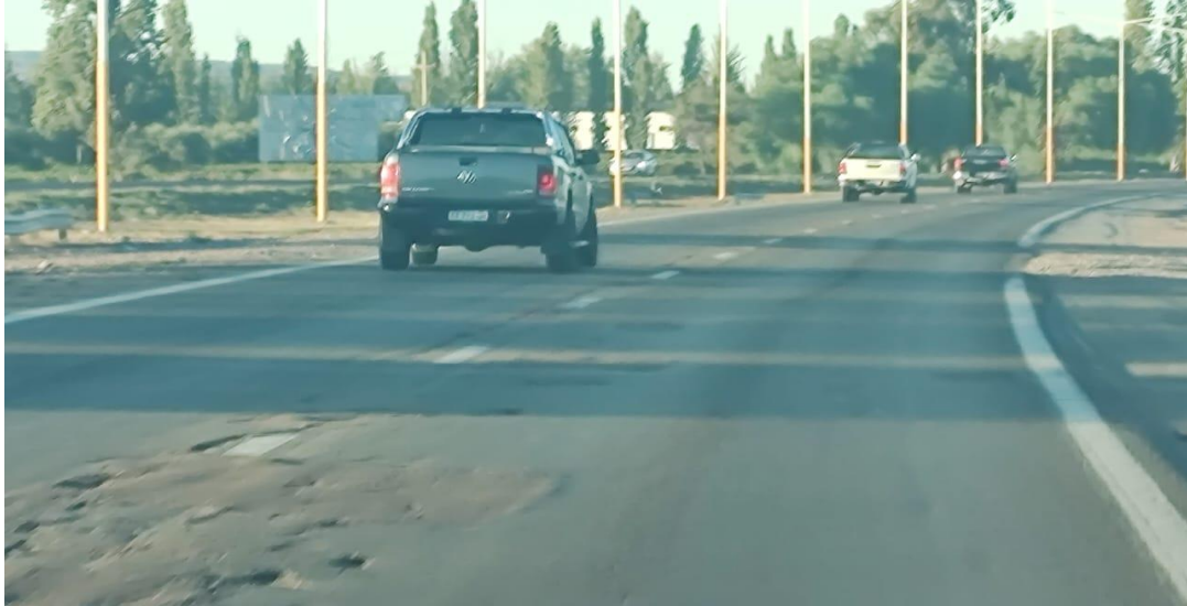
Fotografía 19. Muestra el estado de la calzada entre calle Araoz y calle Azcuénaga.
