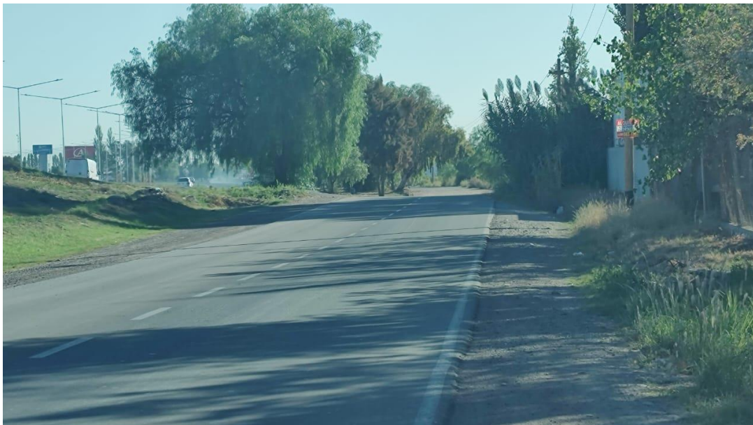
Fotografía 14. Muestra el estado de la calzada entre Calle Azcuénaga y Calle Araoz.
