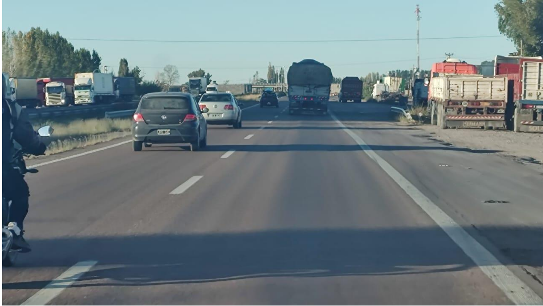
Fotografía 17: Muestra el estado de la calzada y banquetas. Tramo Intersección Azcuénaga, Ruta 7
