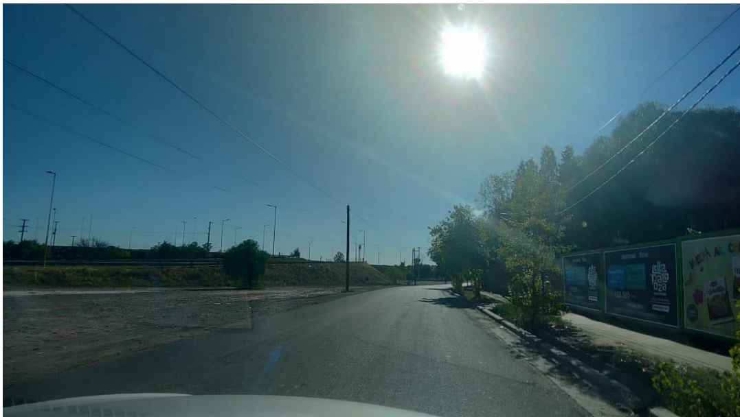
Fotografía 45. Muestra el estado de la calzada entre Calle Araoz y calle J.J. Paso.
