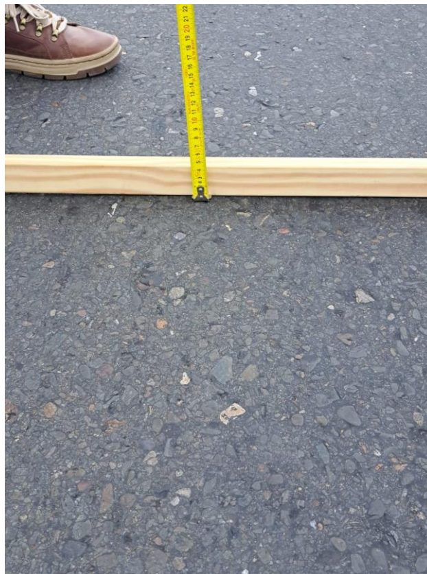
Fotografía 2. Muestra el ahuellamiento entre calle Tirasso y R:P: 50
