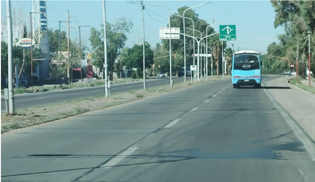
Fotografía 7. Calzada Principal – Descendente. Muestra las reparaciones efectuadas en la calzada y el estado de las juntas próximas al cruce con Rotonda de la calle Manuel A Sáez.
