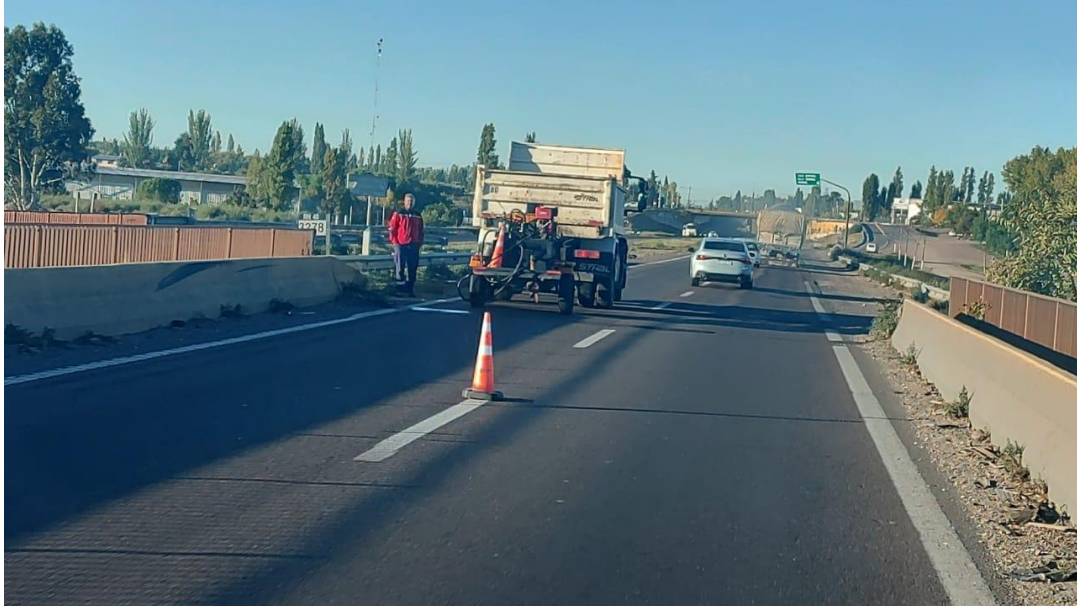
Fotografía 7: Muestra el estado de la calzada SOBRE Puente Rio Mendoza. Tramo Intersección Azcuénaga, Ruta 7
