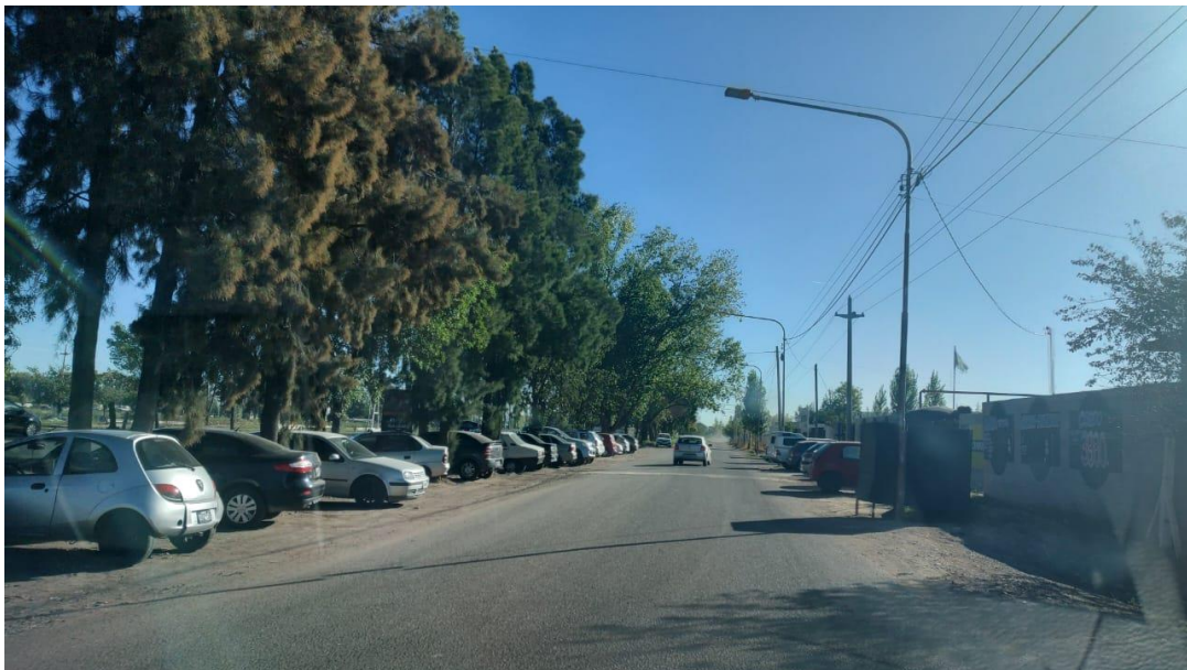
Fotografía 6. Muestra el estado de la calzada entre Calle Azcuénaga y Calle Araoz.
