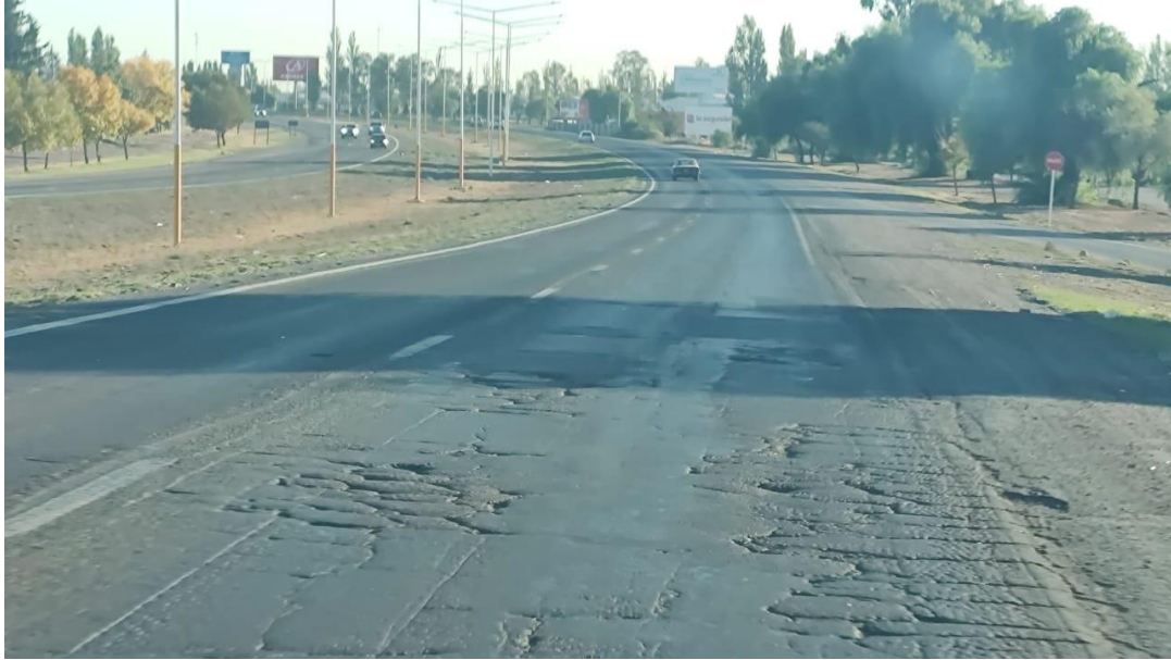
Fotografía 7. Muestra el estado de la calzada y las banquetas entre calle Azcuénaga y Calle Araoz.
