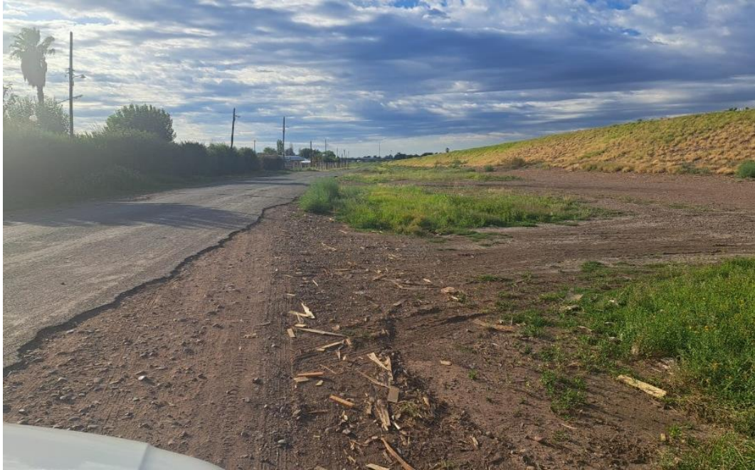
Fotografía 17. Muestra el estado de la calzada y las banquetas entre calle Nicola Serpa y calle Lamadrid.
