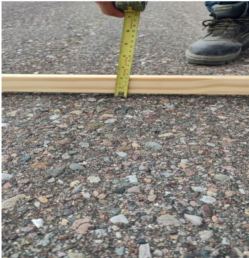
Fotografía 22. Otra vista del ahuellamiento de la calzada antes del Arrollo El Chancho
