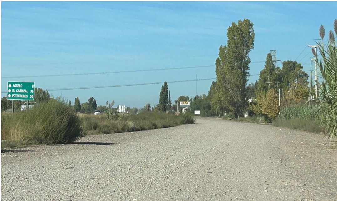
Fotografía 10: Muestra el estado de la calzada enripiada. Tramo Intersección Azcuénaga, Ruta 7, colectora Oeste.
