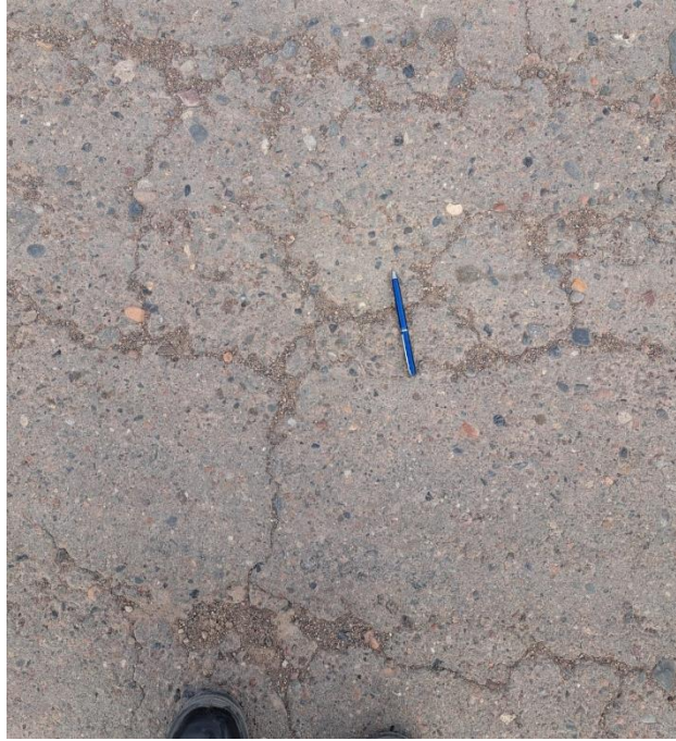
Fotografía 11: Muestra el estado de la calzada pavimentada. Tramo Intersección Azcuénaga, Ruta 7, colectora Este.
