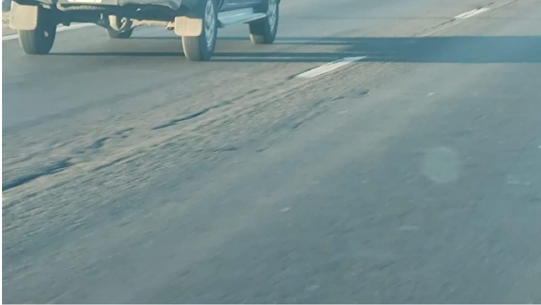
Fotografía 5. Muestra el estado de la calzada entre J.J. Paso y calle Araoz.
