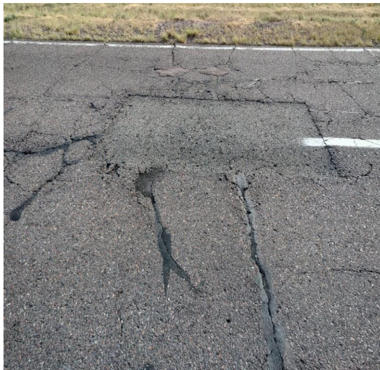
Fotografía 14. Muestra la fisuración de la calzada después del Arrollo Las Peñas
