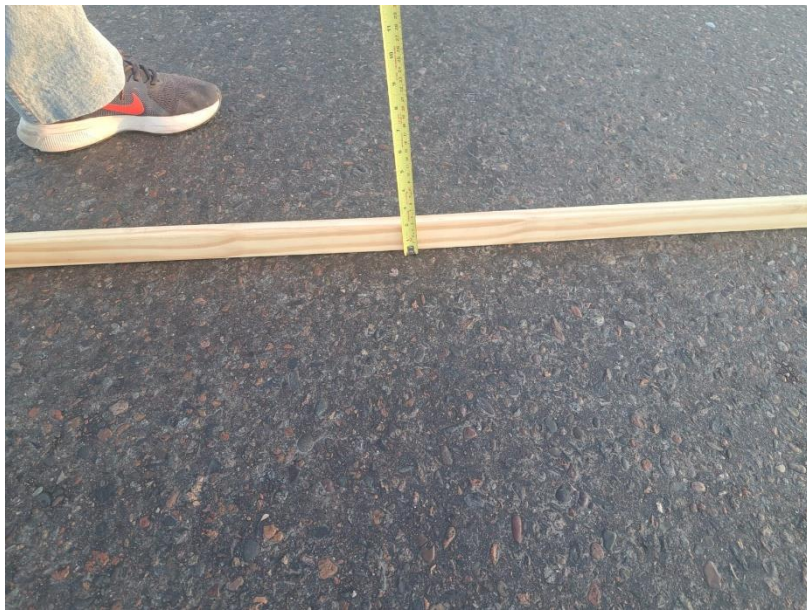
Fotografía 1. Muestra el ahuellamiento en el cruce con la RN N° 7 – Inicio del tramo.
