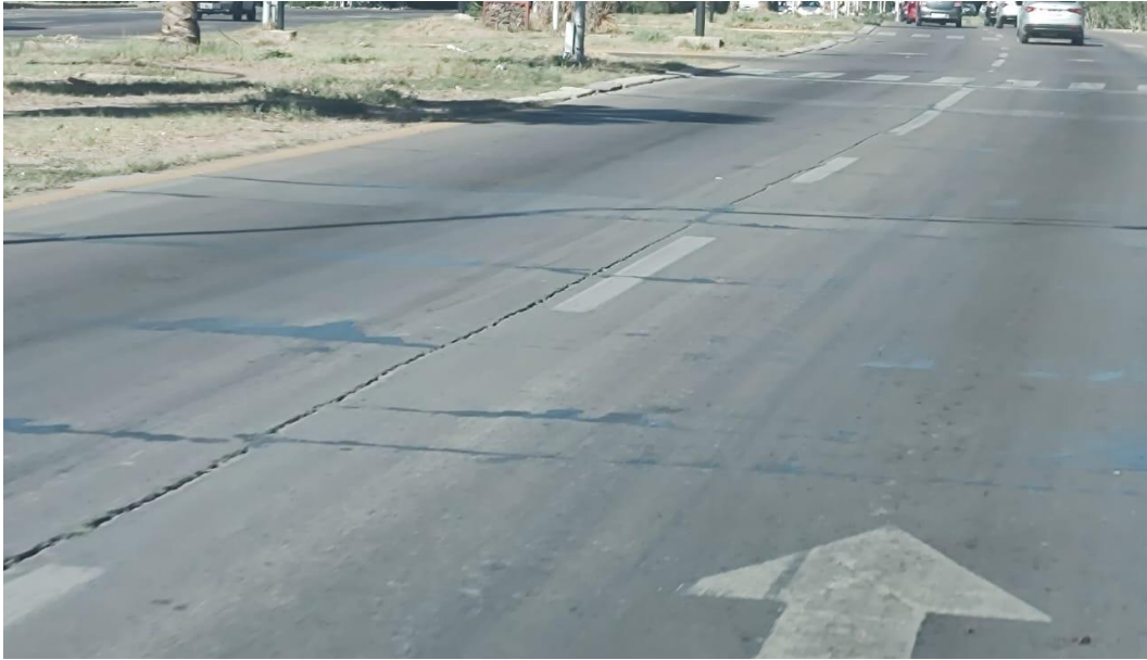
Fotografía 9. Calzada Principal – Descendente. Muestra el estado de las juntas en el cruce con la calle Los Pescadores.
