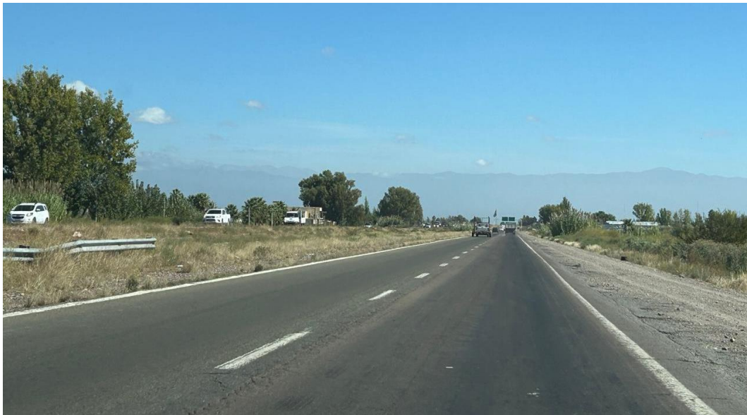
Fotografía 14. Muestra el estado de la calzada y las banquetas entre calle Medina y calle Los Álamos.
