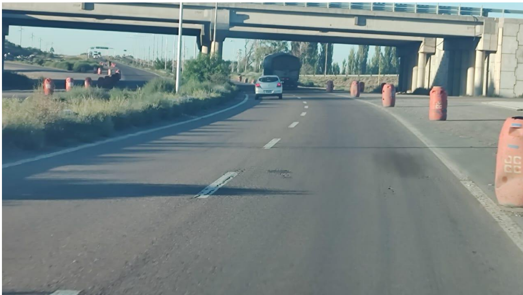
Fotografía 20: Muestra el estado de la calzada, puente de Ruta 7 y banquetas. Tramo Intersección Azcuénaga, Ruta 7. FIN DEL TRAMO.
