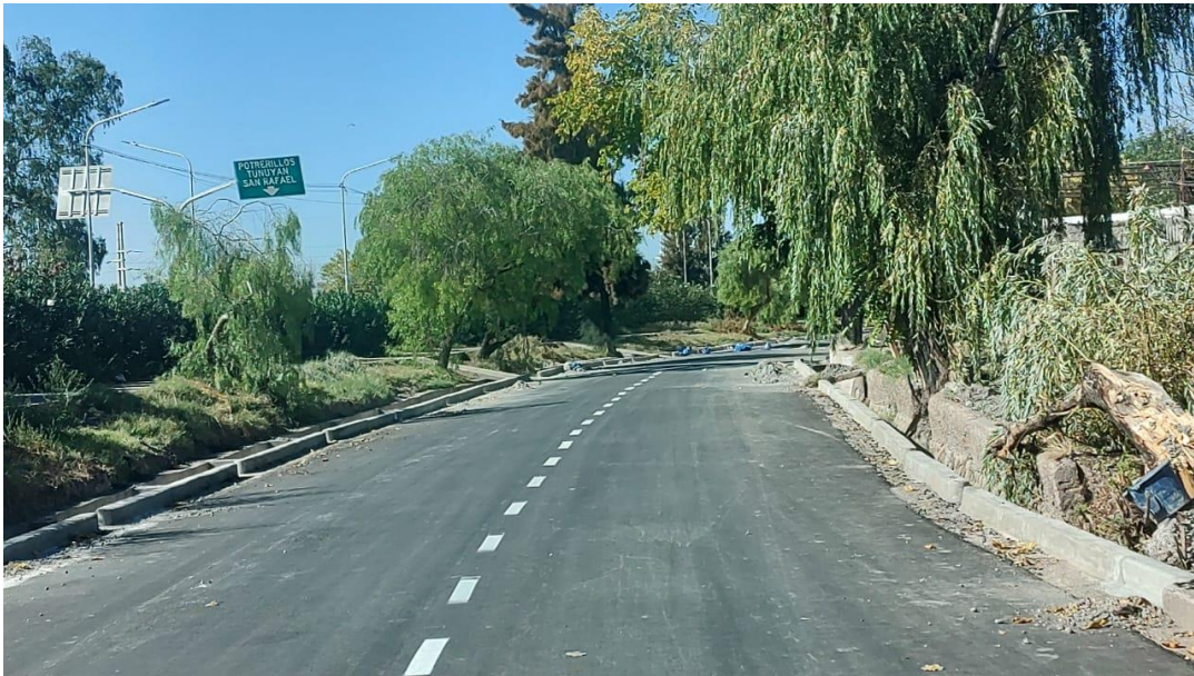
Figura 11. Vista del tipo y estado de la calzada entre calle General Paz e Independencia.
