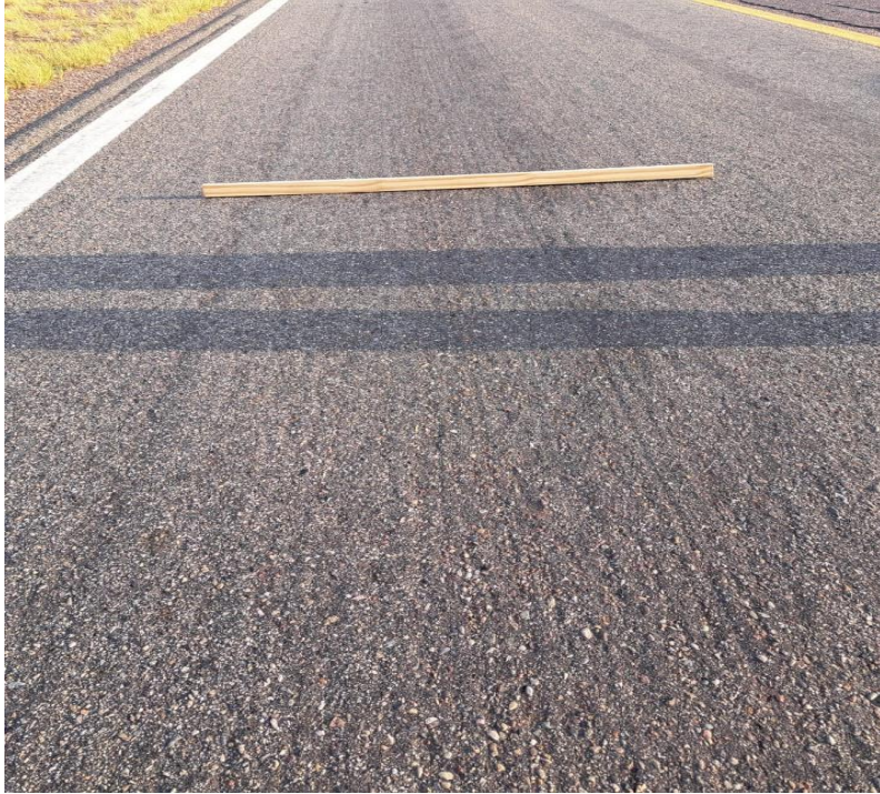
Fotografía 5. Muestra el estado de la calzada en kilómetro 565.
