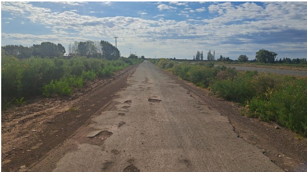
Fotografía 28. Muestra el estado de la calzada y las banquetas entre calle Nicola Serpa y calle Lamadrid.
