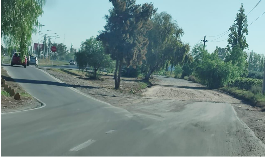
Fotografía 13. Muestra el estado de la calzada entre calle Azcuénaga y calle Araoz.
