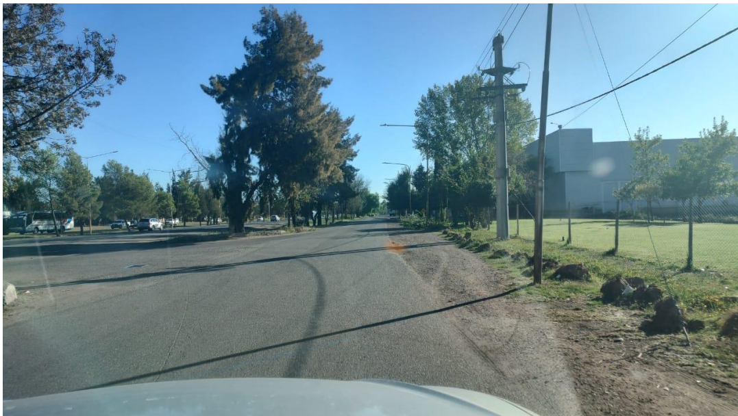
Fotografía 4. Muestra el estado de la calzada entre Calle Azcuénaga y Calle Araoz.
