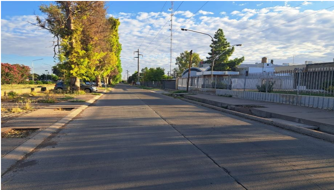
Fotografía 5. Vista del tipo y estado de la calzada entre la rotonda del Avi3 y calle Los Pescadores
