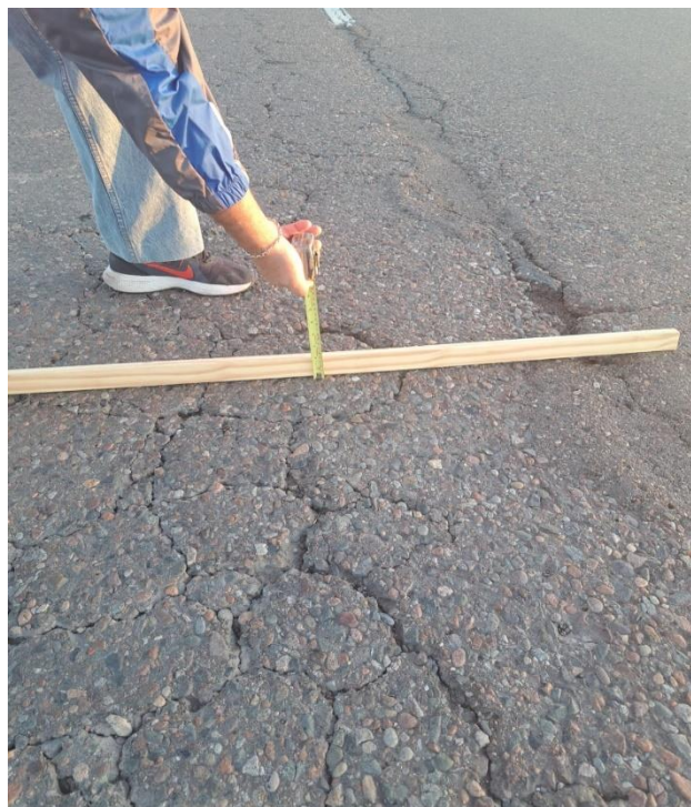
Fotografía 2. Muestra el ahuellamiento y la fisuración en la zona entre la RN N° 7 y el Arrollo Carrizal.
