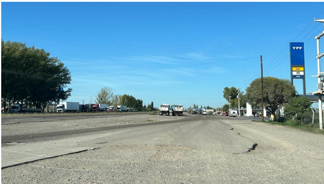
Fotografía 18: Muestra el estado de la calzada ingreso Estación de Servicio. Tramo Intersección Azcuénaga, Ruta 7, colectora Oeste.
