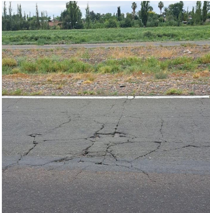
Fotografía 1. Muestra el estado de la calzada en calle Tirasso. Inicio del tramo.
