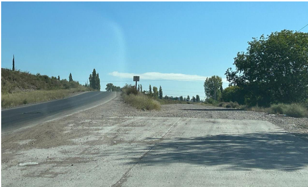
Fotografía16: Muestra el estado de la calzada, rama salida calle Quintana. Tramo Intersección Azcuénaga, Ruta 7, colectora Este.
