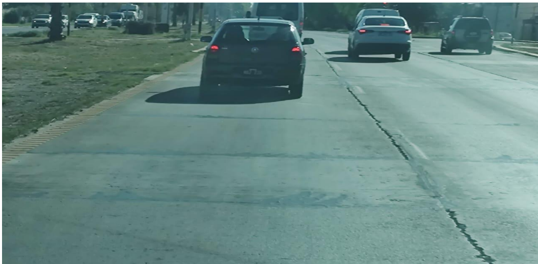
Fotografía 2 - Calzada Principal – Ascendente. Muestra el estado de la junta longitudinal y las reparaciones recientes a la calzada
