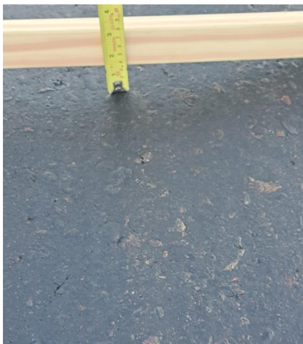
Fotografía 10. Muestra el ahuellamiento en la zona entre Arrollo Los Pozos y La Cruz Negra – Zona de Canteras.
