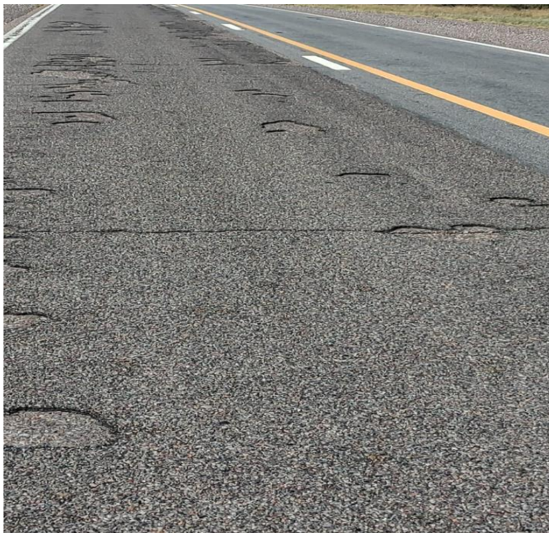
Fotografía 26. Muestra desprendimientos de la calzada después del Arrollo El Chancho
