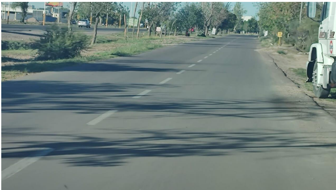
Fotografía 6. RN N 40 – J.J. Paso-Azcuénaga- Colectora Oeste (Descendente). Otra vista de la calzada y banquetas después de J.J. Paso y próxima al cruce con calle Malabia.
