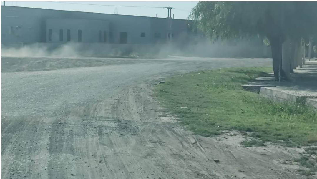
Fotografía 39. Muestra el estado de la calzada entre Calle Araoz y calle J.J. Paso. Cruce calle Malabia.
