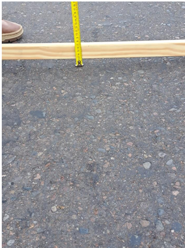
Fotografía 8. Muestra el ahuellamiento entre calle Tirasso y R. P. 50
