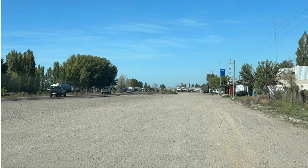
Fotografía 17: Muestra el estado de la calzada enripiada. Tramo Intersección Azcuénaga, Ruta 7, colectora Oeste.
