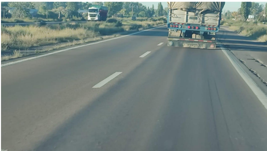
Fotografía 12: Muestra el estado de la calzada y banquetas. Tramo Intersección Azcuénaga, Ruta 7
