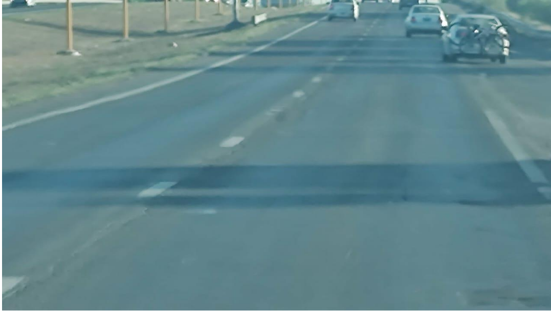
Fotografía 20. Muestra el estado de la calzada y las banquetas entre calle Araoz y J.J. Paso.
