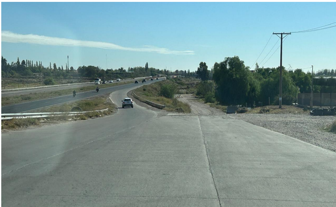
Fotografía 20: Muestra el estado de la calzada enripiada. Rama entrada Ruta 40. Bajada al Rio Mendoza. Tramo Intersección Azcuénaga, Ruta 7, colectora Este.
