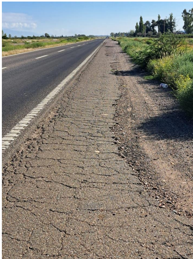
Fotografía 6. Muestra el estado de calzada y la banquina externa entre Zapata y la Cruz Negra
