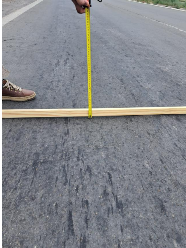
Fotografía 20. Muestra el ahuellamiento entre calle R.P. 50 y calle Lamadrid.
