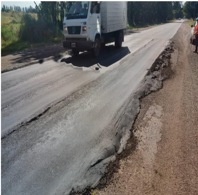
Fotografía 36. Muestra la gran deformación de la calzada entre Las Paredes y el canal El Toledano.
