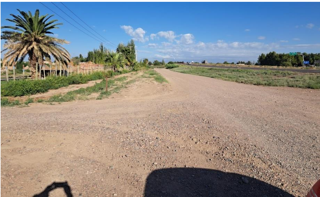
Fotografía 26. Muestra el estado de la calzada y las banquetas entre calle Nicola Serpa y calle Laprida.
