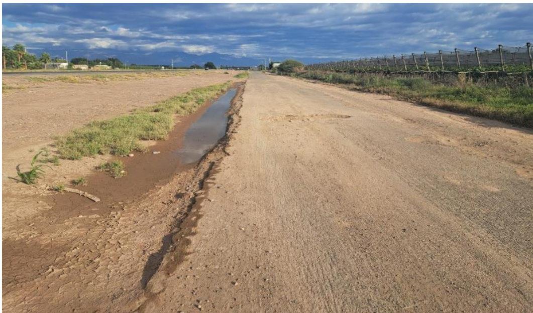
Fotografía 14. Muestra el estado de la calzada y las banquetas entre calle Nicola Serpa y calle Lamadrid.
