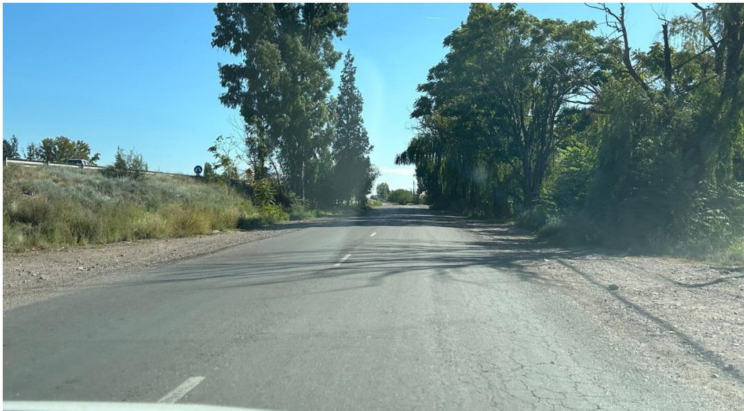
Fotografía 10: Muestra el estado de la calzada pavimentada. Tramo Intersección Azcuénaga, Ruta 7, colectora Este.
