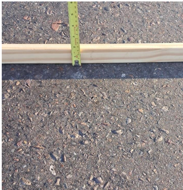
Fotografía 8. Muestra el ahuellamiento en la zona entre la RN N° 7 y el Arrollo Carrizal.
