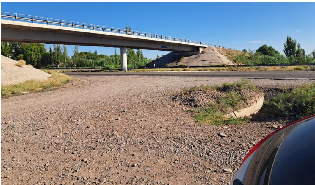
Fotografía 28. Muestra el estado de la calzada y las banquetas entre calle Nicola Serpa y calle Laprida. Cruce calle Medina.
