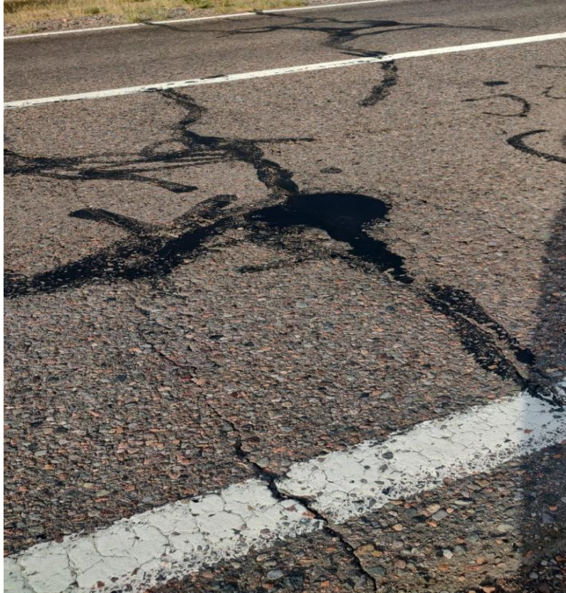
Fotografía 7. Estado de la calzada. Muestra la fisuración y bacheo, que se repite en toda la traza.
