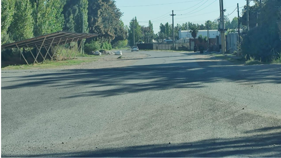
Fotografía 30. Muestra el estado de la calzada entre Calle Araoz y calle J.J. Paso.
