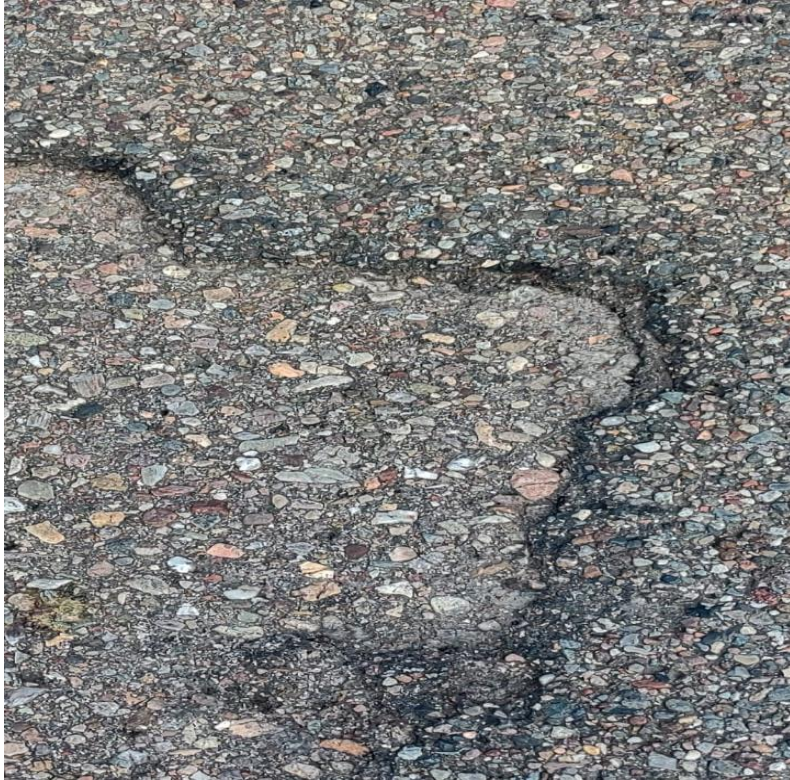
Fotografía 29. Muestra el desprendimiento en la Calzada después del Arrollo La Hedionda.
