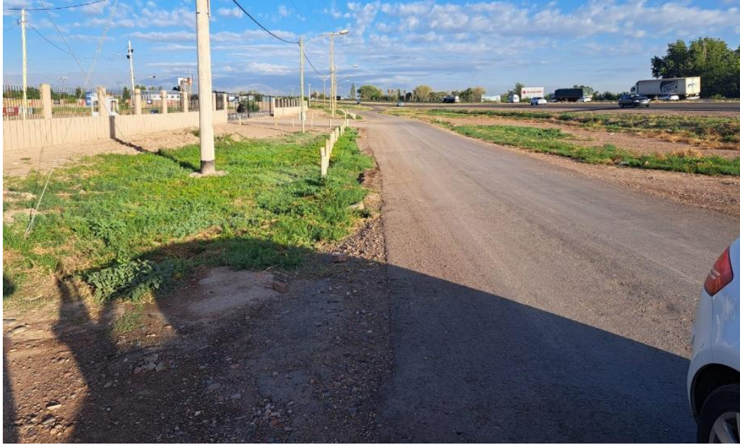
Fotografía 15. Muestra el estado de la calzada y las banquetas entre calle Tirasso y calle Nicola Serpa.
