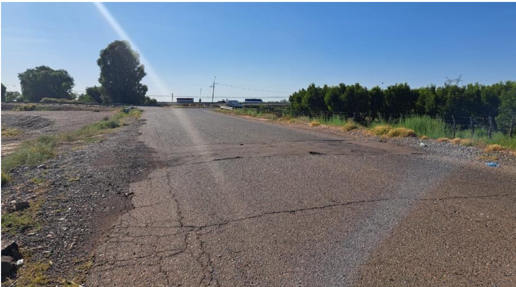
Fotografía 34. Muestra el estado de la calzada y las banquetas entre calle Nicola Serpa y calle Laprida.
