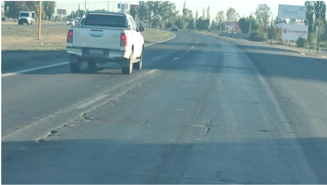
Fotografía 10. Muestra el estado de la calzada y las banquetas entre calle Azcuénaga y Calle Araoz.
