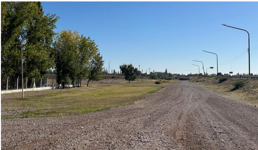
Fotografía 6: Muestra el estado de la calzada enripiada. Tramo Intersección Azcuénaga, Ruta 7, colectora Oeste.
