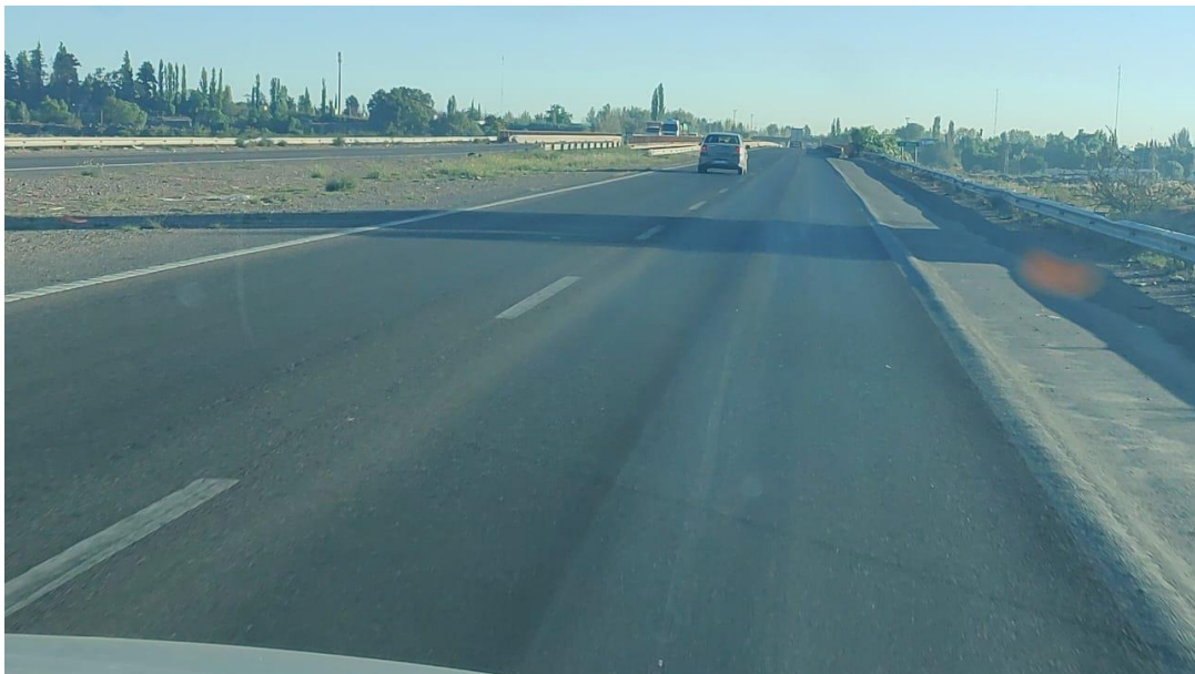
Fotografía 22: Muestra el estado de la calzada y banquetas, sobre puente Río Mendoza- Tramo Intersección Ruta 7 y Azcuénaga.
