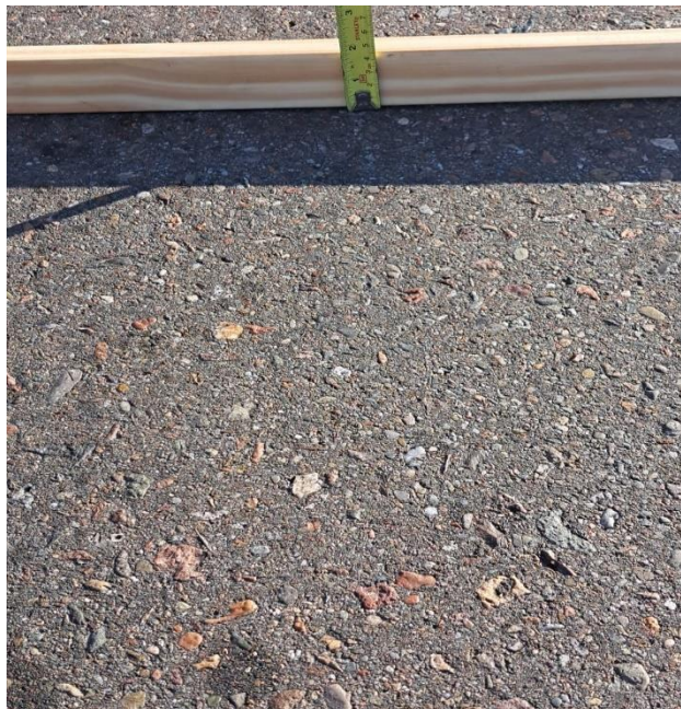
Fotografía 14. Muestra el ahuellamiento en la zona entre Zapata y la Rotonda de La Tonada. Fin del tramo.
