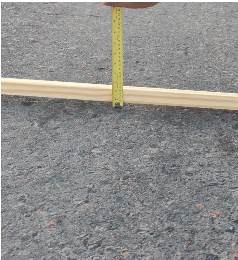
Fotografía 32 - Muestra el ahuellamiento de la calzada antes de Las Paredes
