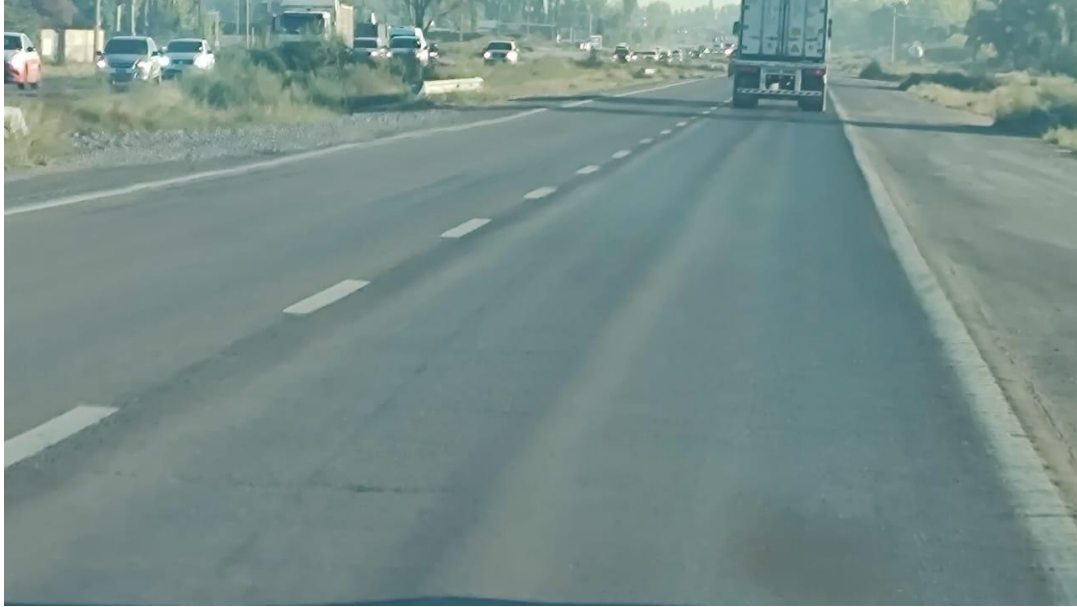
Fotografía 9: Muestra el estado de la calzada, banquetas. Tramo Intersección Ruta 7 y Azcuénaga.
