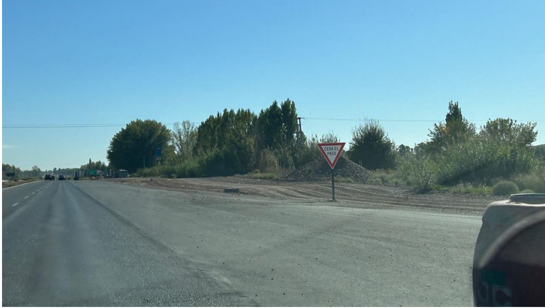
Fotografía 3: Muestra el estado de la calzada enripiada, rama de salida Ruta 7. Tramo Intersección Azcuénaga, Ruta 7, colectora Este
