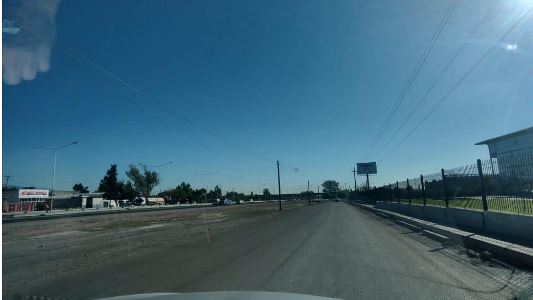
Fotografía 44. Muestra el estado de la calzada entre Calle Araoz y calle J.J. Paso.
