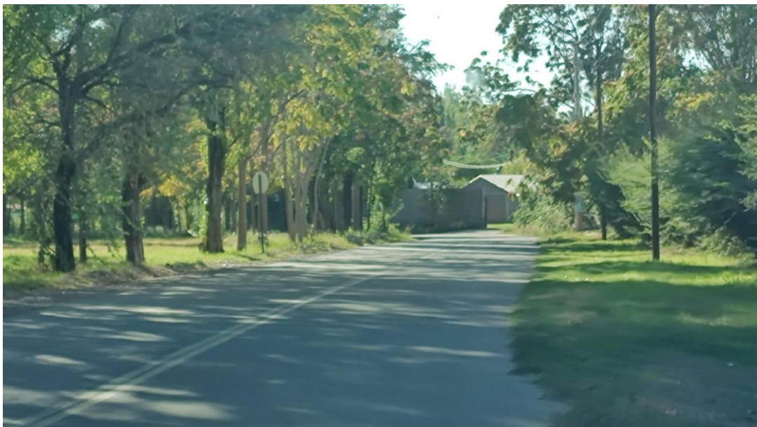
Fotografía 33. Muestra el estado de la calzada entre Calle Araoz y calle J.J. Paso.
