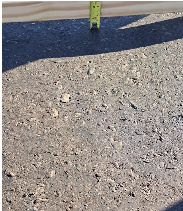
Fotografía 12. Muestra el ahuellamiento en la zona entre Arrollo Los Pozos y La Cruz Negra – Zona de Canteras.
