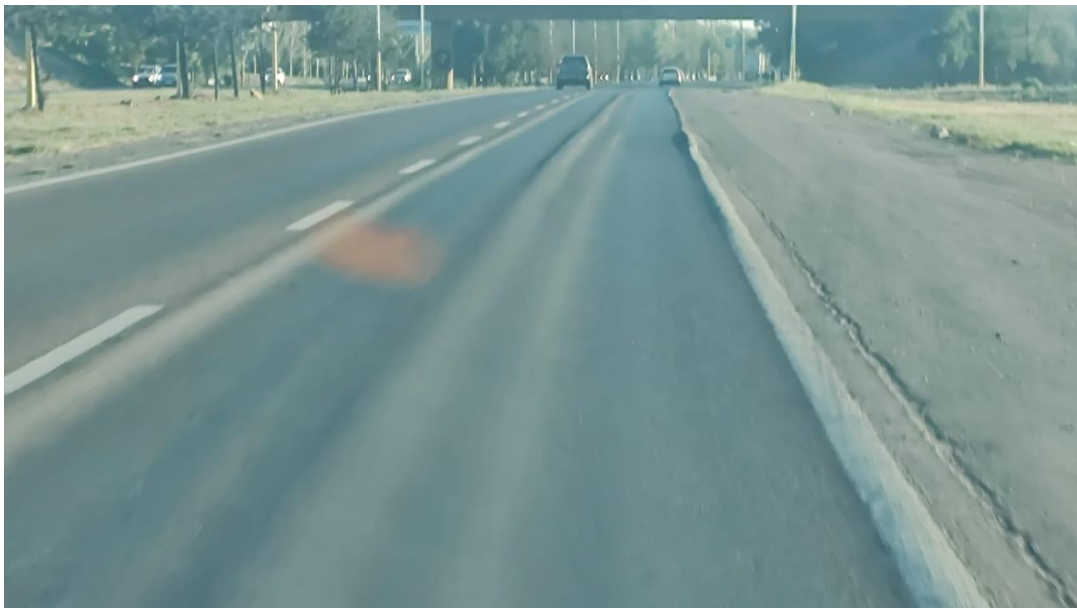
Fotografía 26: Muestra el estado de la calzada y banquetas. Tramo Intersección Ruta 7 y Azcuénaga.
