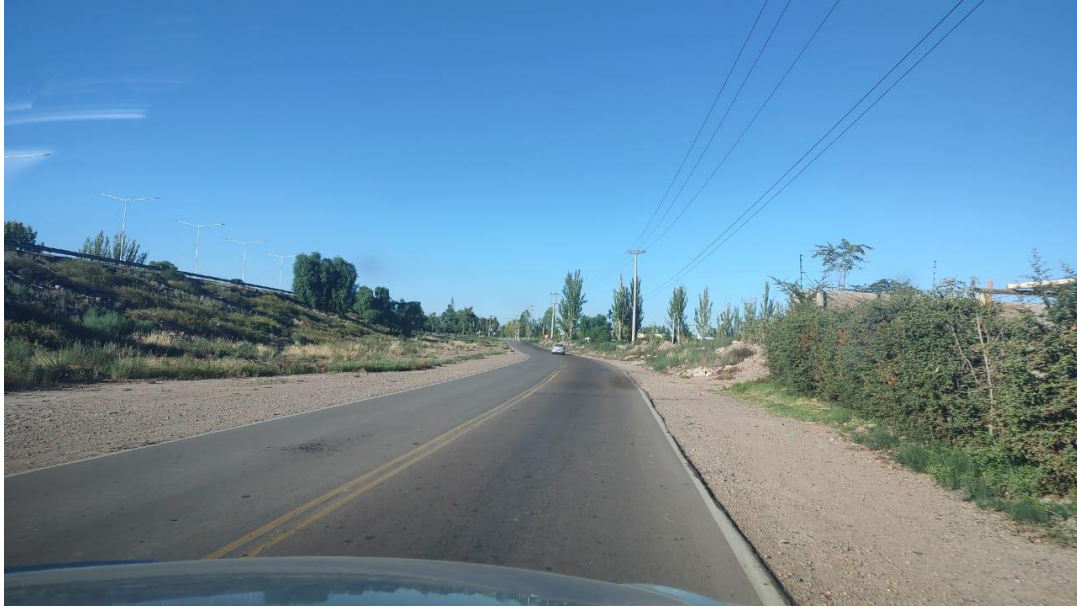
Fotografía 25. RN N 40 – J.J. Paso-Azcuénaga- Colectora Oeste (Descendente). Vista de la calzada y banquina después del cruce con calle Castro Barros.
