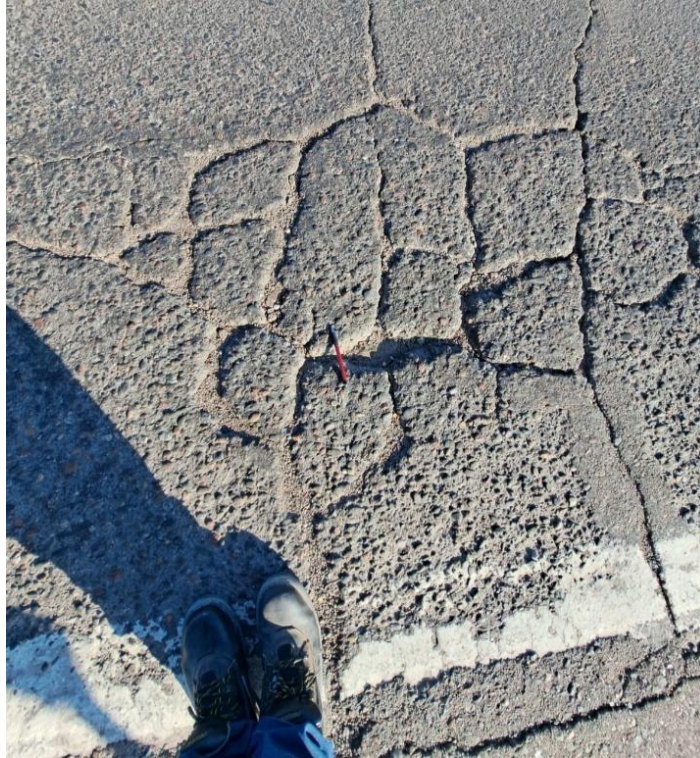
Fotografía 3. Otra vista de la fisuración y desprendimiento entre la Rotonda de La Tonada y Zapata.
