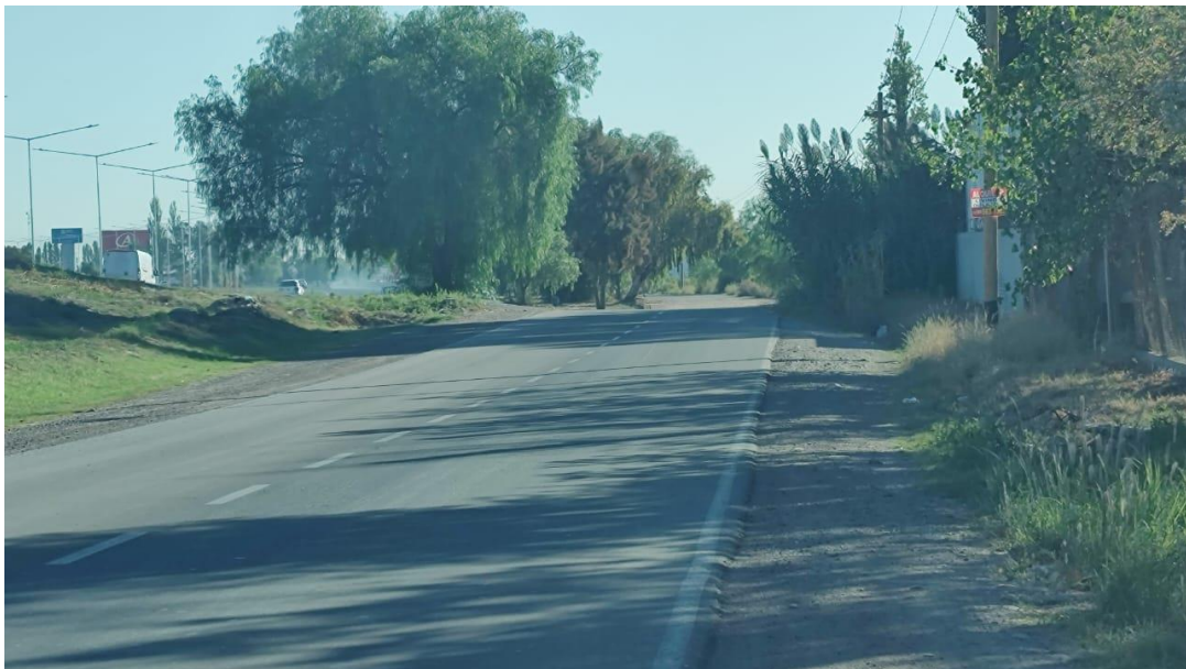
Fotografía 12. Muestra el estado de la calzada entre Calle Azcuénaga y Calle Araoz.
