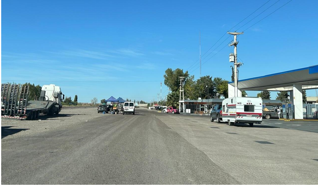
Fotografía 19: Muestra el estado de la calzada pavimentada. Tramo Intersección Azcuénaga, Ruta 7, colectora Oeste.
