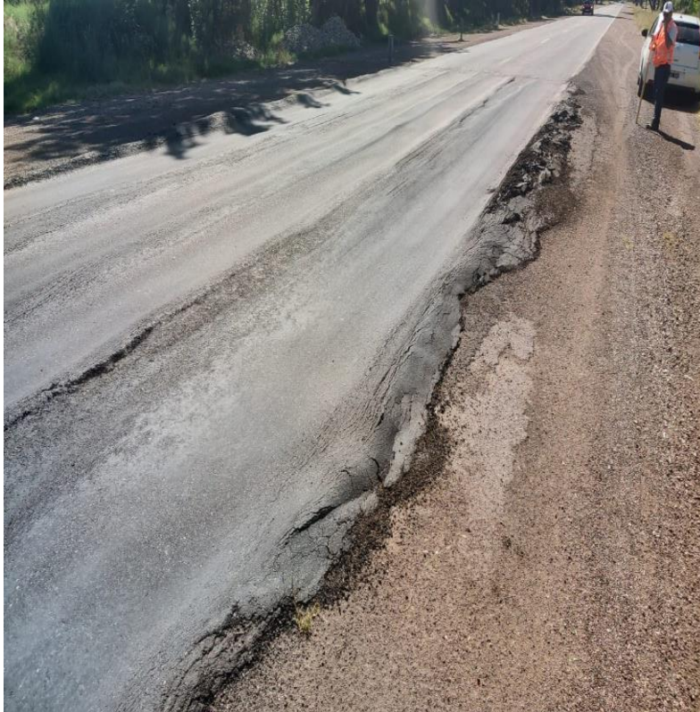
Fotografía 37. Otra vista de la gran deformación de la calzada entre Las Paredes y el canal El Toledano.
