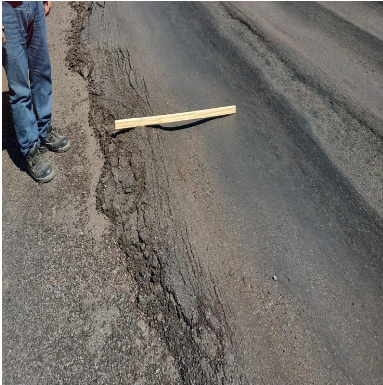
Fotografía 39. Detalle de la gran deformación de la calzada entre Las Paredes y el canal El Toledano.
