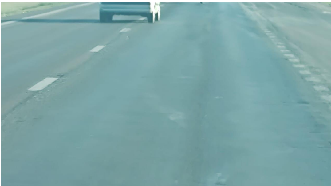
Fotografía 24. Muestra el estado de la calzada y las banquetas entre calle Araoz y J.J. Paso.
