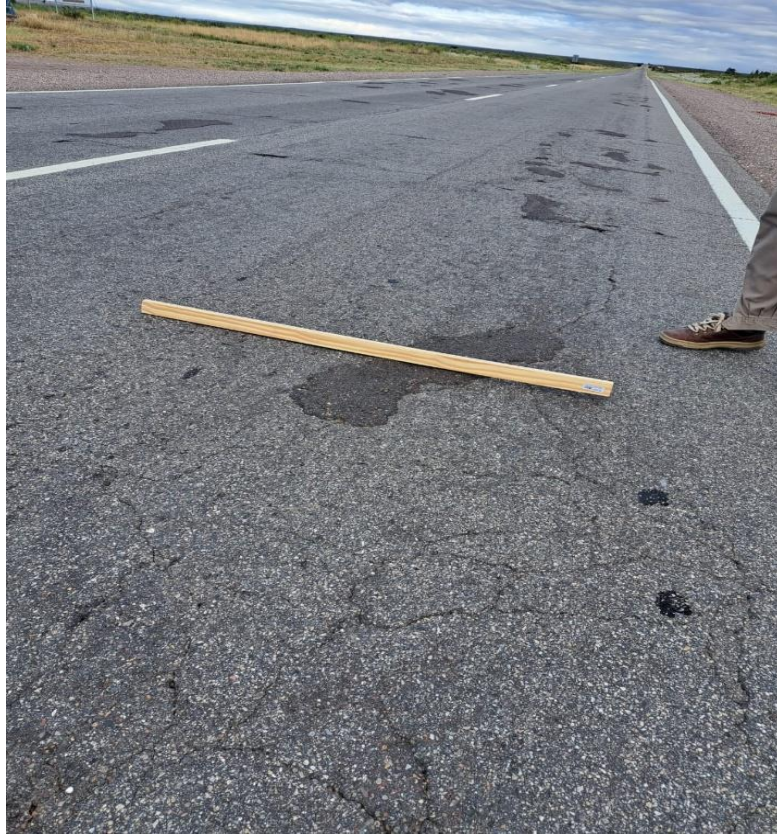
Fotografía 13. Muestra el estado de la calzada en el kilómetro 620.
