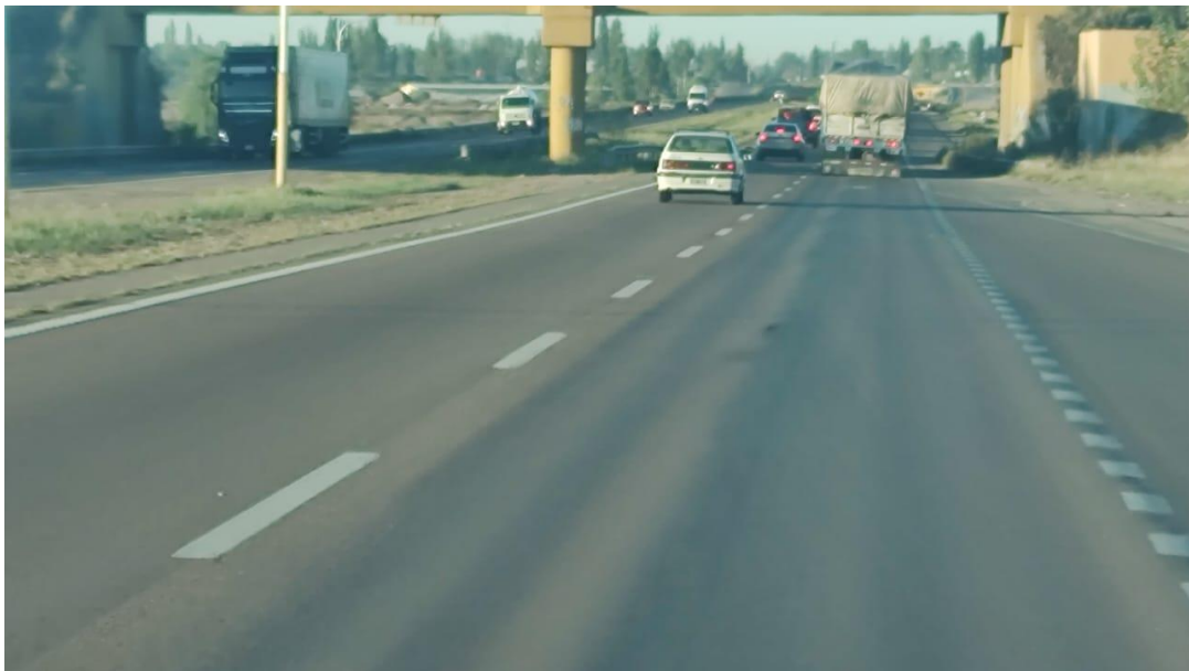
Fotografía 4: Muestra el estado de la calzada y banquetas. Tramo Intersección Azcuénaga, Ruta 7.
