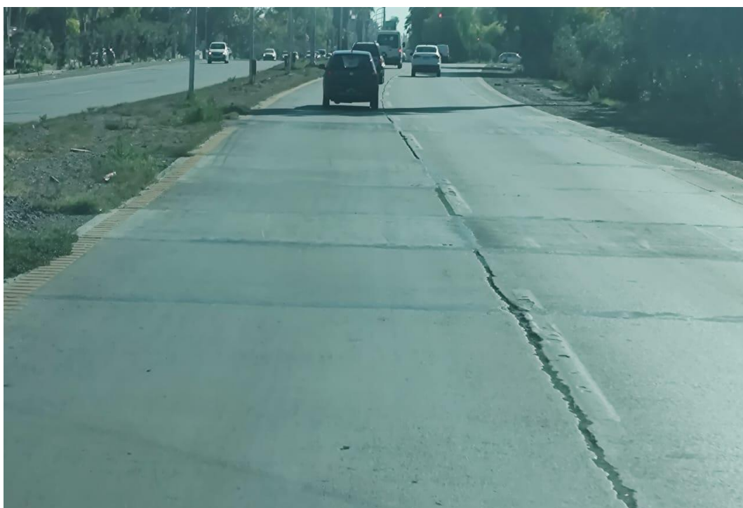
Fotografía 4 - Calzada Principal – Ascendente. Muestra el estado de la junta longitudinal y las reparaciones recientes a la calzada
