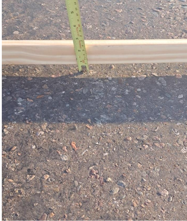
Fotografía 5. Muestra el ahuellamiento en la zona entre la RN N° 7 y el Arrollo Carrizal.
