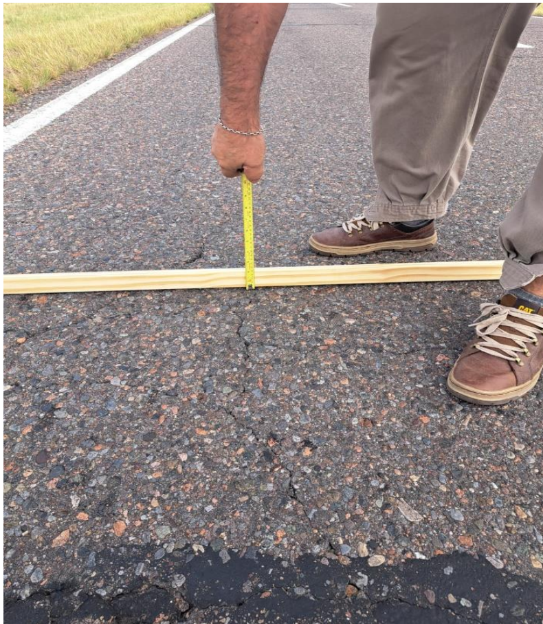
Fotografía 10. Muestra el ahuellamiento en kilómetro 605.
