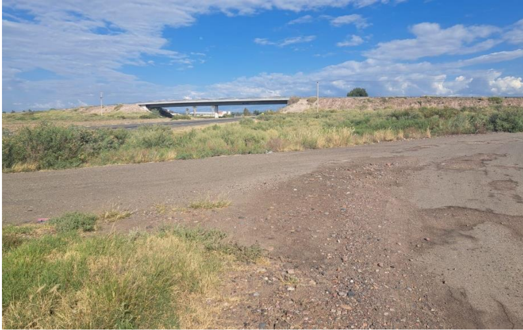
Fotografía 27. Muestra el estado de la calzada y las banquetas entre calle Nicola Serpa y calle Lamadrid.
