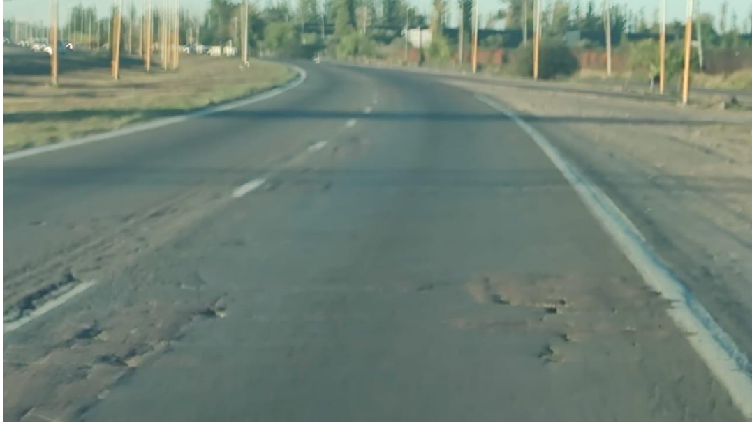
Fotografía 15. Muestra el estado de la calzada y la banquina externa entre calle Araoz y calle Azcuénaga.
