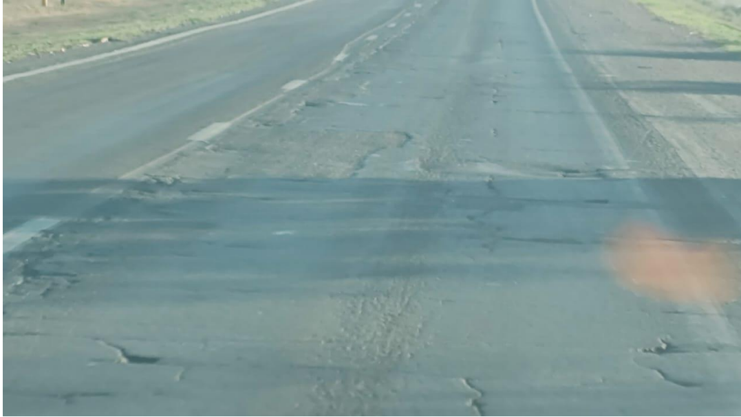
Fotografía 3 Muestra el estado de la calzada y las banquetas entre calle Azcuénaga y Calle Araoz.
