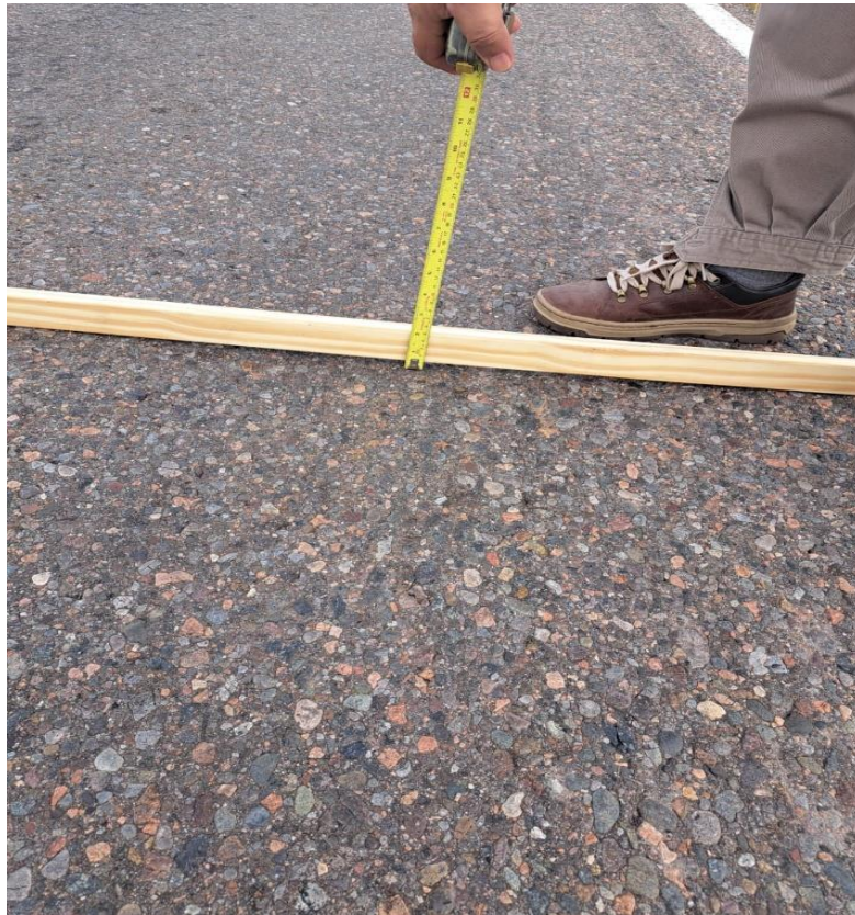
Fotografía 16. Muestra el ahuellamiento en kilómetro 635.
