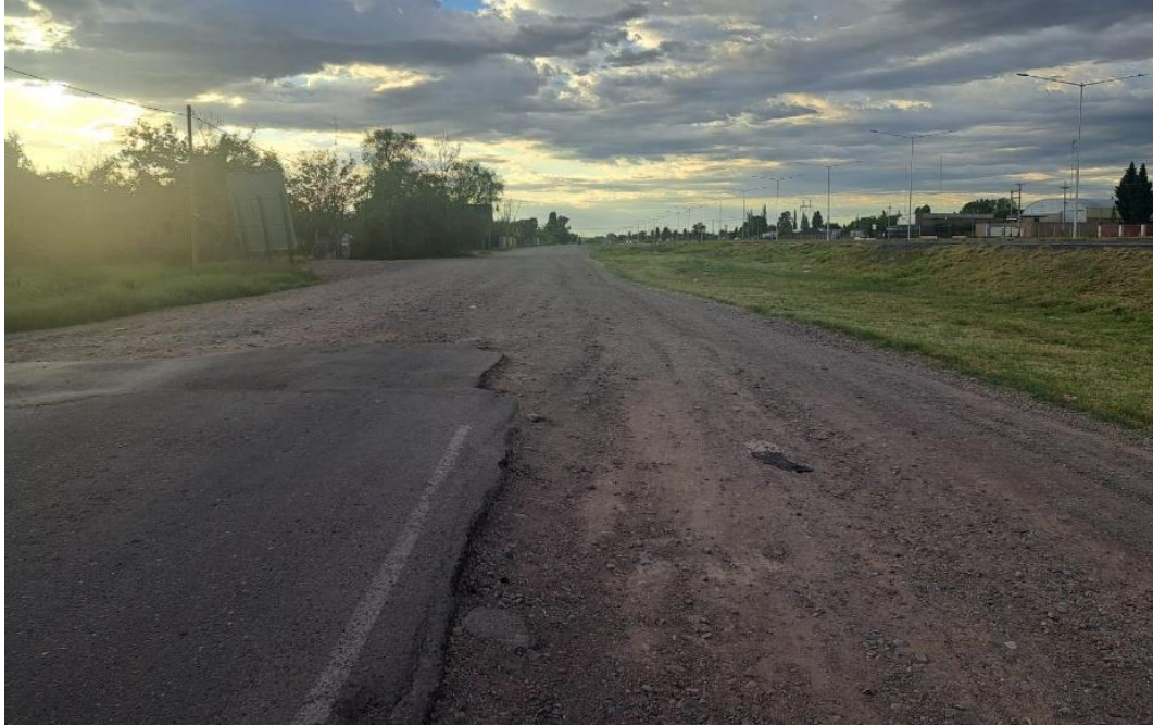
Fotografía 7. Muestra el estado de la calzada y las banquetas entre calle Tirazzo y R. P. 50.
