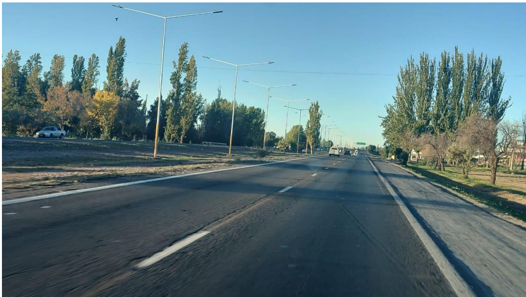
Fotografía 12. Muestra el estado de la calzada y la banquina externa entre J.J. Paso y calle Araoz.
