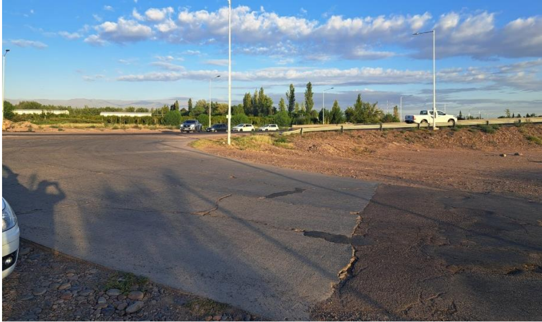
Fotografía 9. Muestra el estado de la calzada y las banquetas entre calle Tirasso y calle Nicola Serpa.
