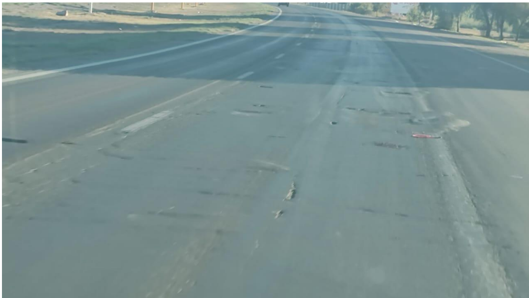
Fotografía 9. Muestra el estado de la calzada y las banquetas entre calle Azcuénaga y Calle Araoz.
