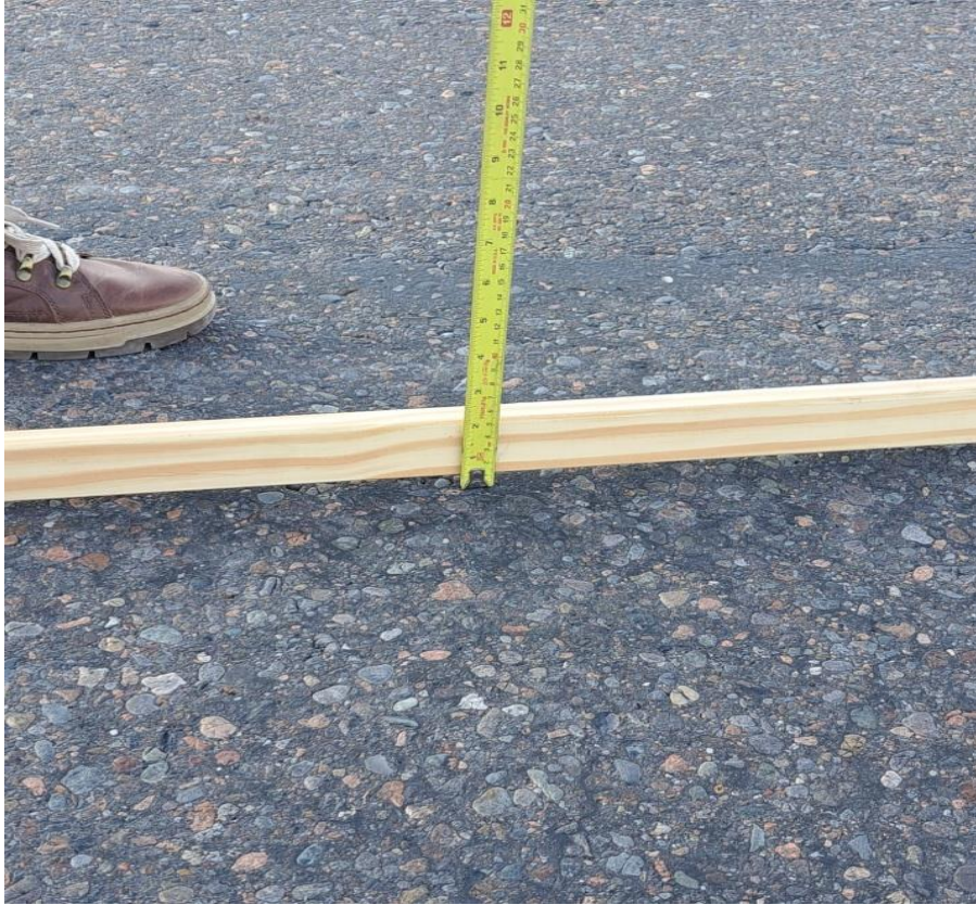
Fotografía 3. Vista del estado de la calzada y el ahuellamiento al inicio del tramo.
