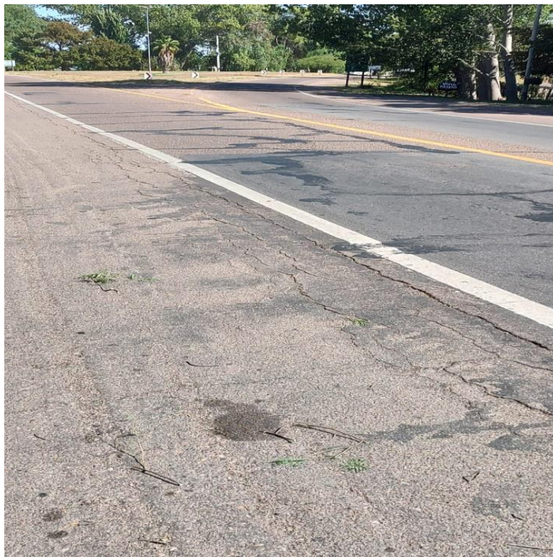
Fotografía 34 - Muestra las fisuras en la calzada y la banquina entre Las Paredes y el canal El Toledano.
