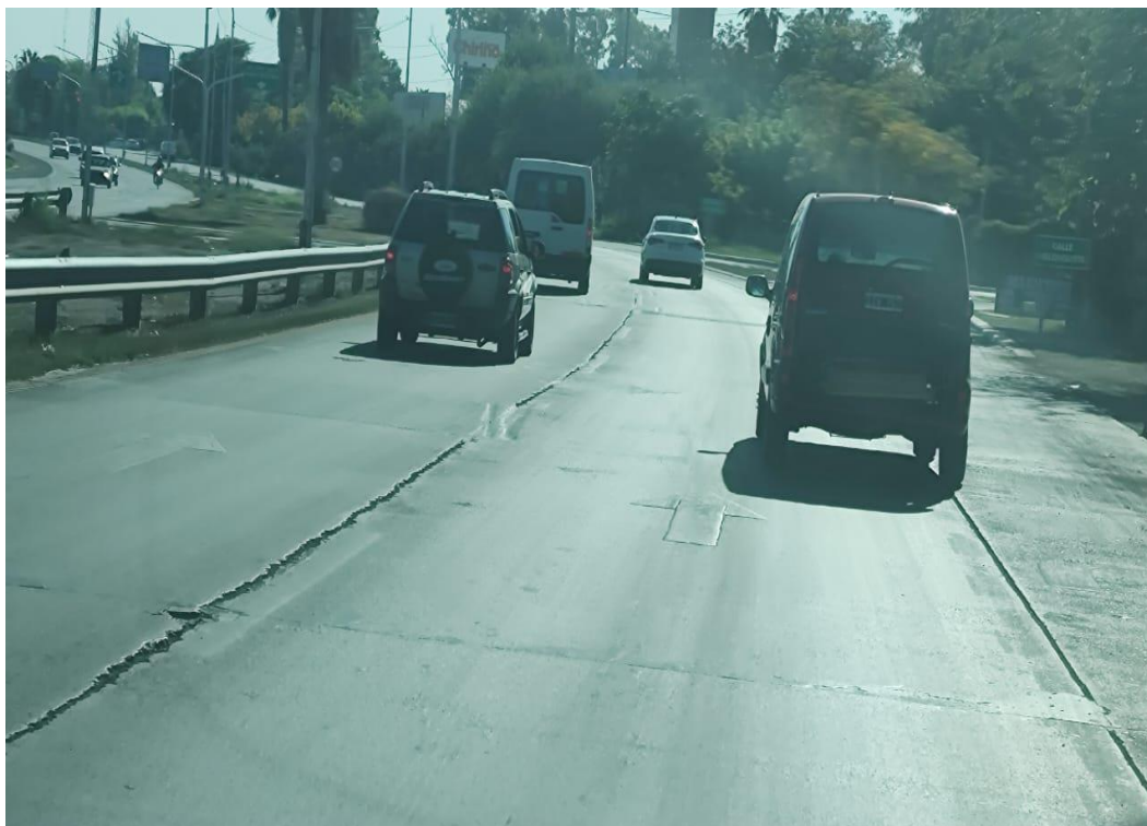
Fotografía 3 - Calzada Principal – Ascendente. Muestra el estado de la junta longitudinal antes de la calle Los Pescadores.
