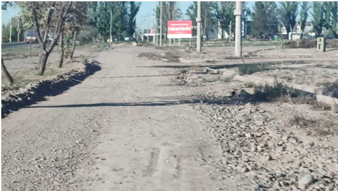
Fotografía 18. RN N 40 – J.J. Paso-Azcuénaga- Colectora Oeste (Descendente). Vista de la calzada de ripio y banquina llegando al cruce con calle Castro Barros.
