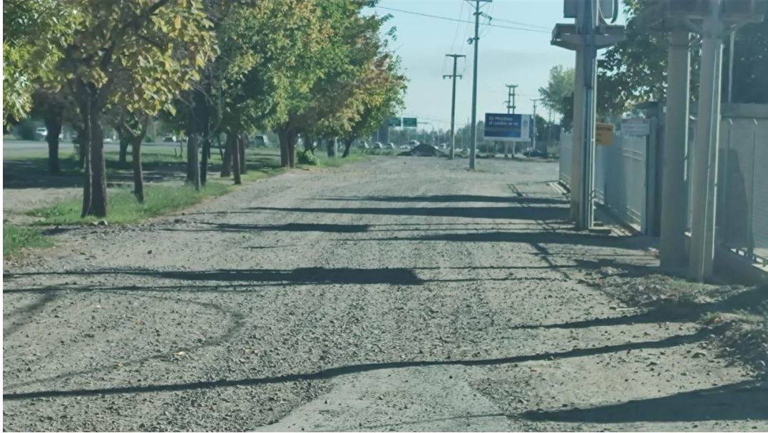
Fotografía 39. Muestra el estado de la calzada entre Calle Araoz y calle J.J. Paso.
