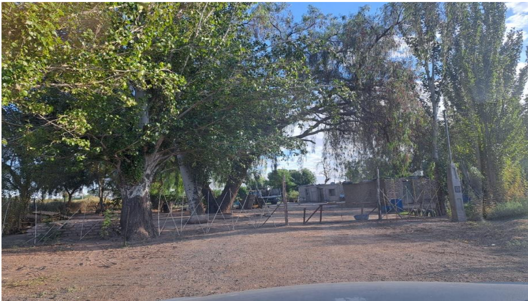
Fotografía 14. Vista del tipo y estado de la calzada entre Constitución y las vías de FFCC. Fin del tramo.
