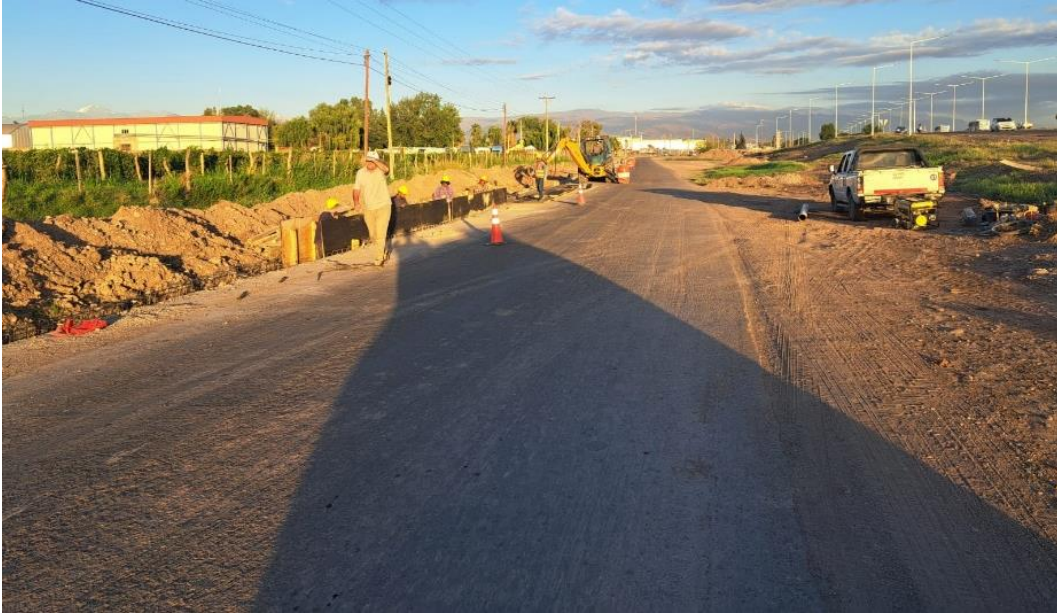
Fotografía 5. Muestra el estado de la calzada y las banquetas entre calle Tirasso y calle Nicola Serpa.
