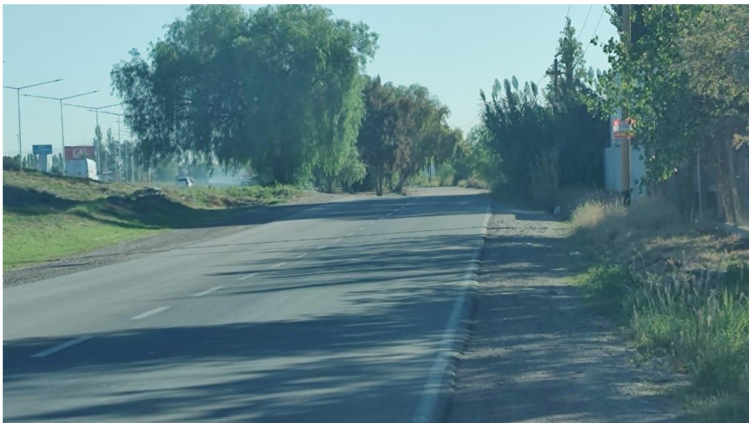
Fotografía 16. Muestra el estado de la calzada entre Calle Azcuénaga y Calle Araoz.
