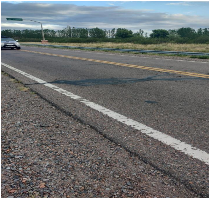
Fotografía 14. Muestra el estado de la calzada en la zona de Las Carretas.
