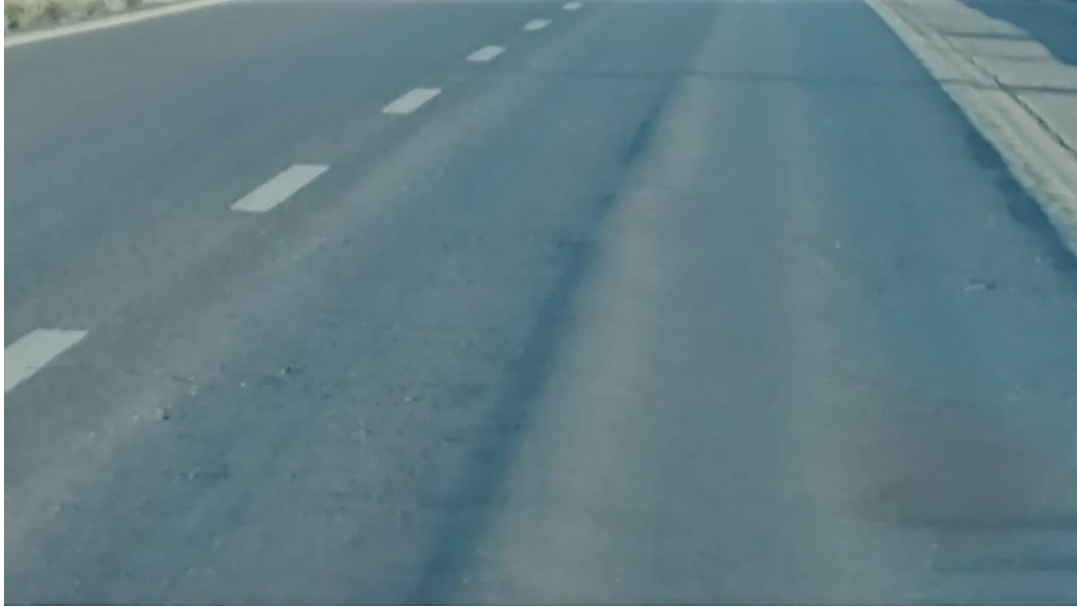
Fotografía 17: Muestra el estado de la calzada y banquetas. Tramo Intersección Ruta 7 y Azcuénaga.
