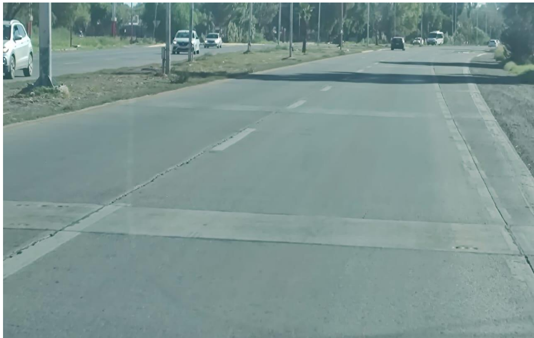
Fotografía 8. Calzada Principal Ascendente - Muestra las reparaciones en calzada y las juntas después de la Rotonda de Gral. Paz
