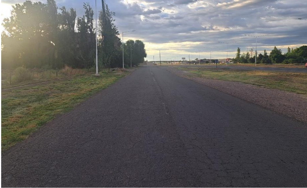
Fotografía 5. Muestra el estado de la calzada y las banquetas entre calle Tirazzo y R. P. 50
