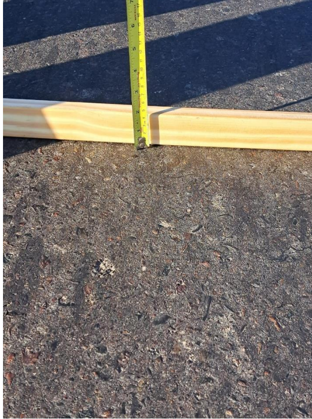
Fotografía 13. Muestra el ahuellamiento en la zona entre Arrollo La Cruz Negra y Zapata.
