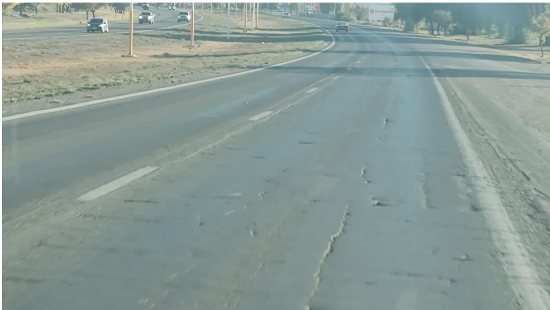
Fotografía 8. Muestra el estado de la calzada y las banquetas entre calle Azcuénaga y Calle Araoz.
