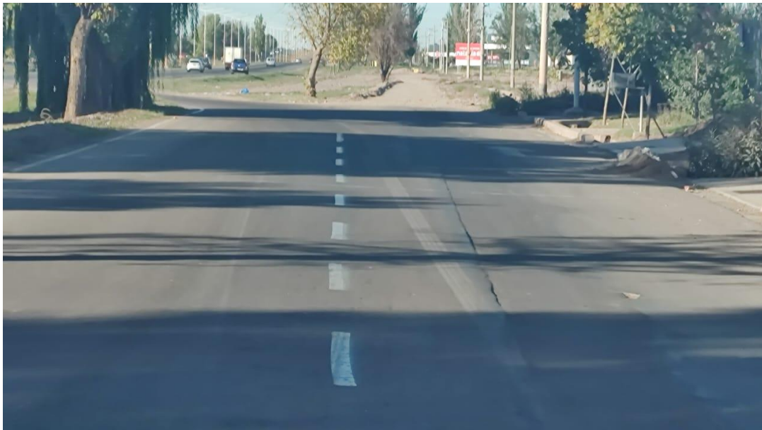
Fotografía 16. RN N 40 – J.J. Paso-Azcuénaga- Colectora Oeste (Descendente). Otra vista de la calzada y banquina después del cruce con calle Boedo. Comienza ripio.
