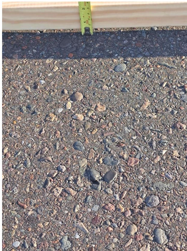
Fotografía 10. Muestra el ahuellamiento en la zona entre el Arrollo Carrizal y la zona de Anchoris.
