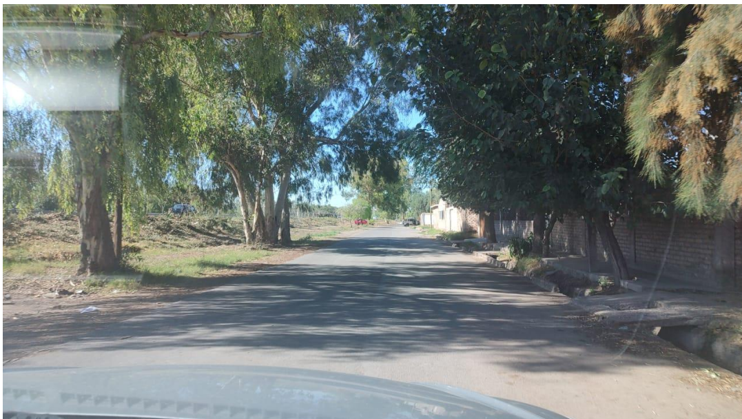
Figura 14. Vista del tipo y estado de la calzada entre calle Constitución y Libertad.
