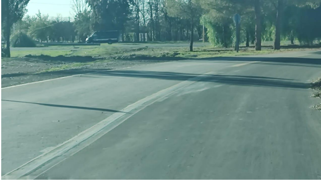
Fotografía 15. RN N 40 – J.J. Paso-Azcuénaga- Colectora Oeste (Descendente). Vista de la calzada y banquina después del cruce con calle Boedo.
