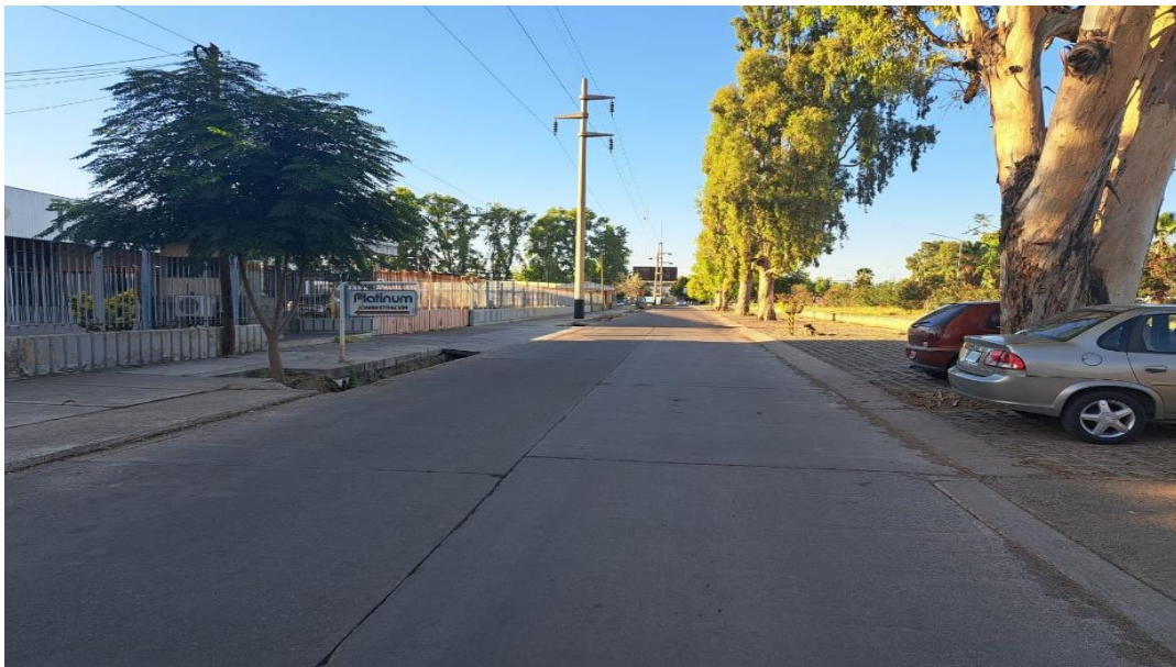
Fotografía 4. Vista del tipo y estado de la calzada entre la rotonda del Avión y calle Los Pescadores
