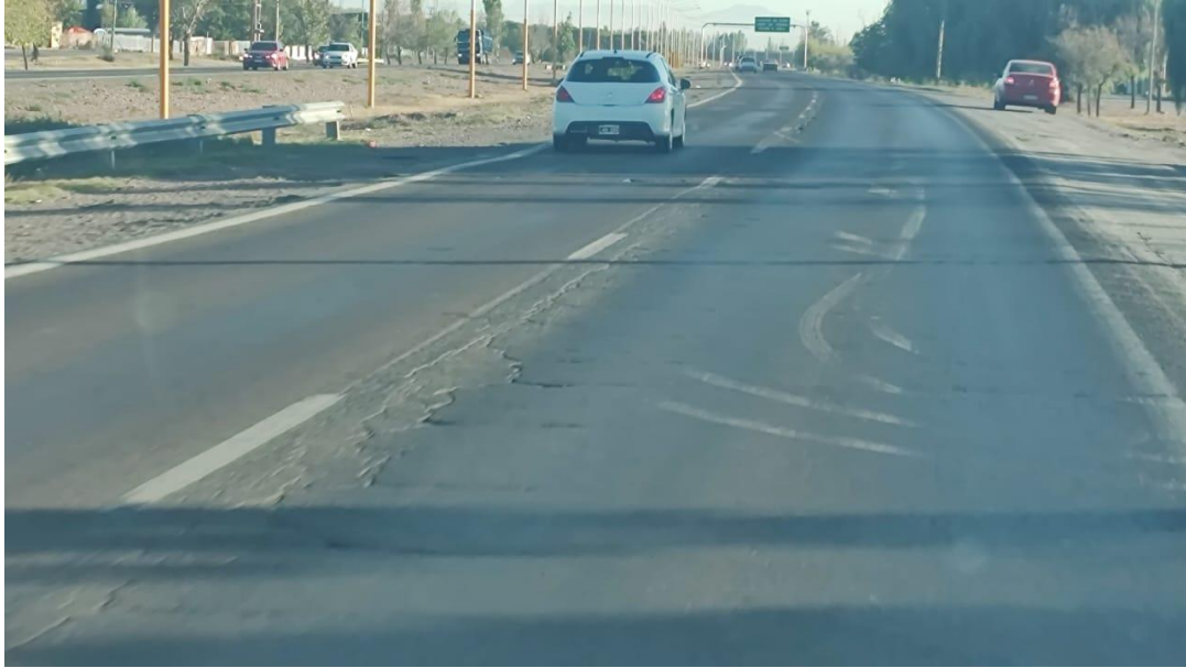
Fotografía 12. Muestra el estado de la calzada y las banquetas entre calle Azcuénaga y Calle Araoz.
