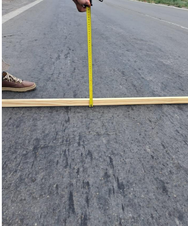
Fotografía 17. Muestra el ahuellamiento entre calle R.P. 50 y calle Lamadrid.
