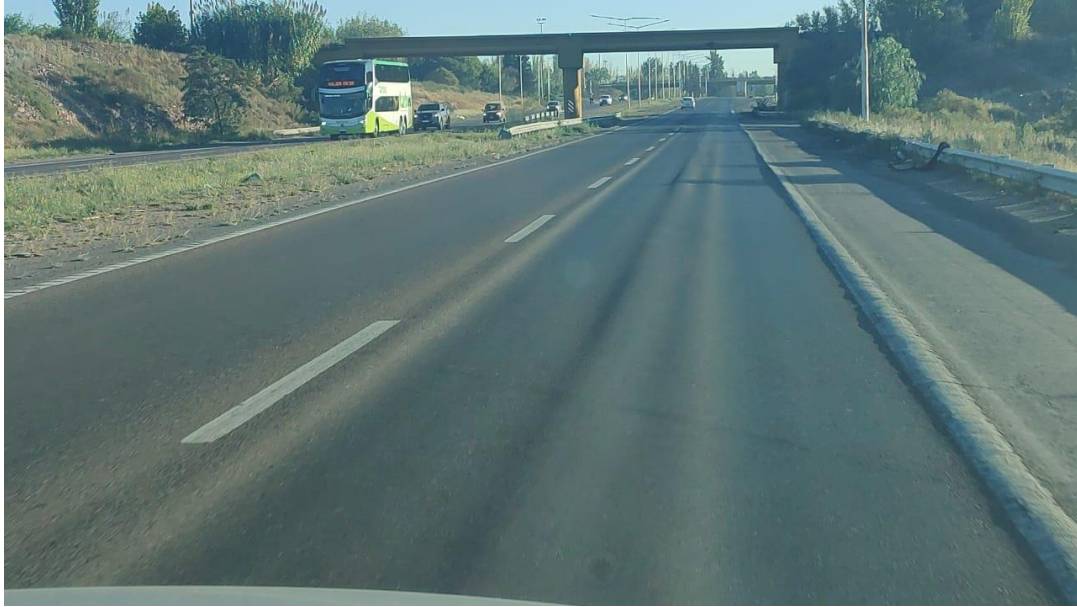
Fotografía 25: Muestra el estado de la calzada y banquetas. Tramo Intersección Ruta 7 y Azcuénaga.
