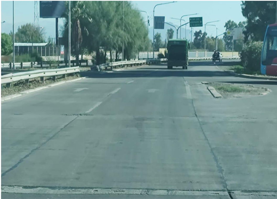
Fotografía 13. Calzada Principal Ascendente - Muestra el estado de la calzada y las juntas en el cruce con calle Libertad.
