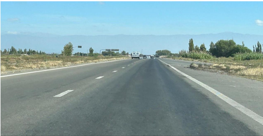
Fotografía 8. Muestra el estado de la calzada y las banquetas entre calle San Pedro y calle Medina.
