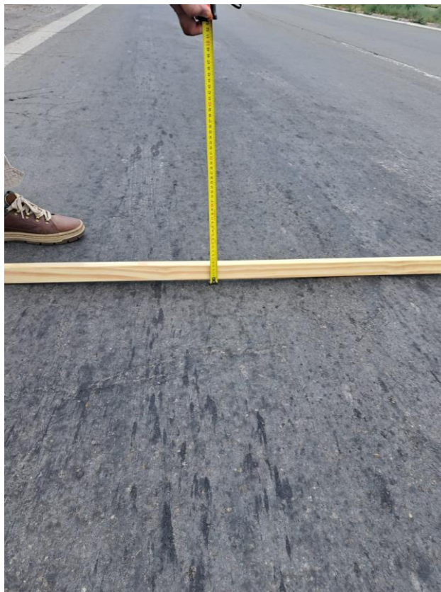
Fotografía 18. Muestra el ahuellamiento entre calle R.P. 50 y calle Lamadrid.
