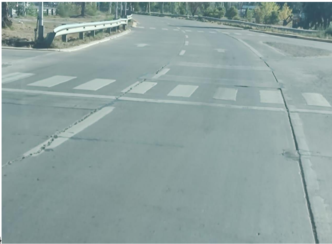
Fotografía 10. Calzada Principal Ascendente - Muestra el estado de la calzada y las juntas en la Rotonda de calle Independencia.
