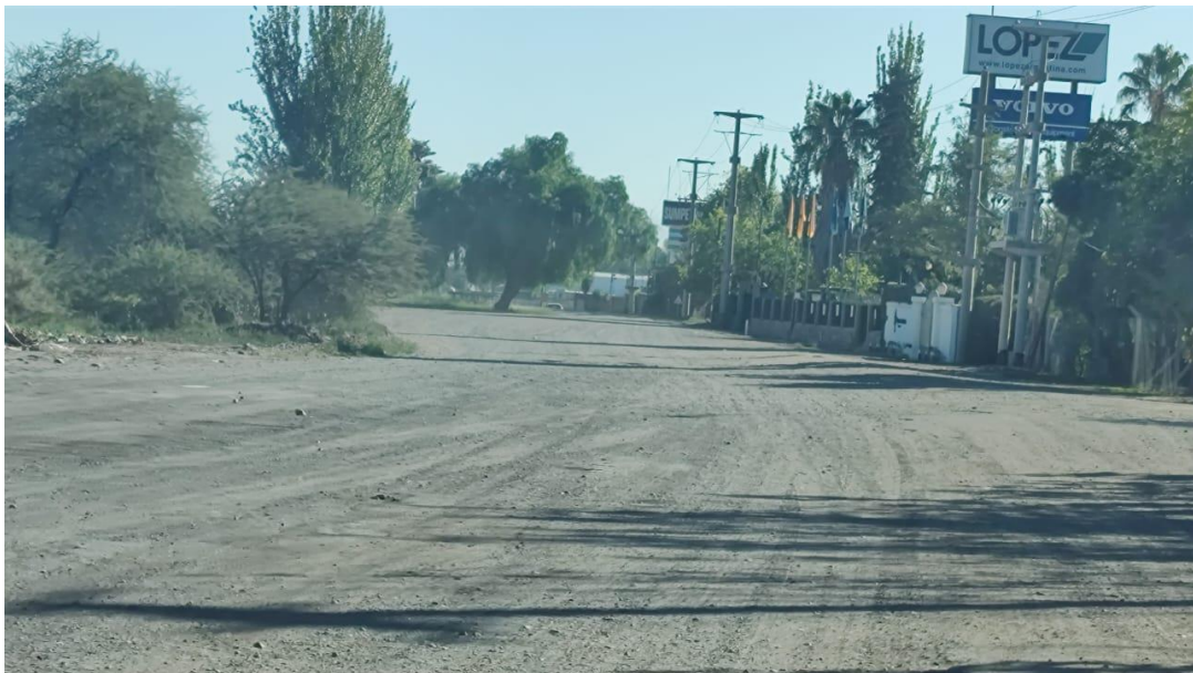
Fotografía 29. Muestra el estado de la calzada entre Calle Araoz y calle J.J. Paso.
