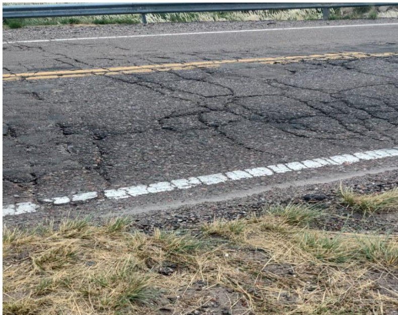
Fotografía 6. Estado de la calzada. Muestra la fisuración, que se repite en toda la traza.
