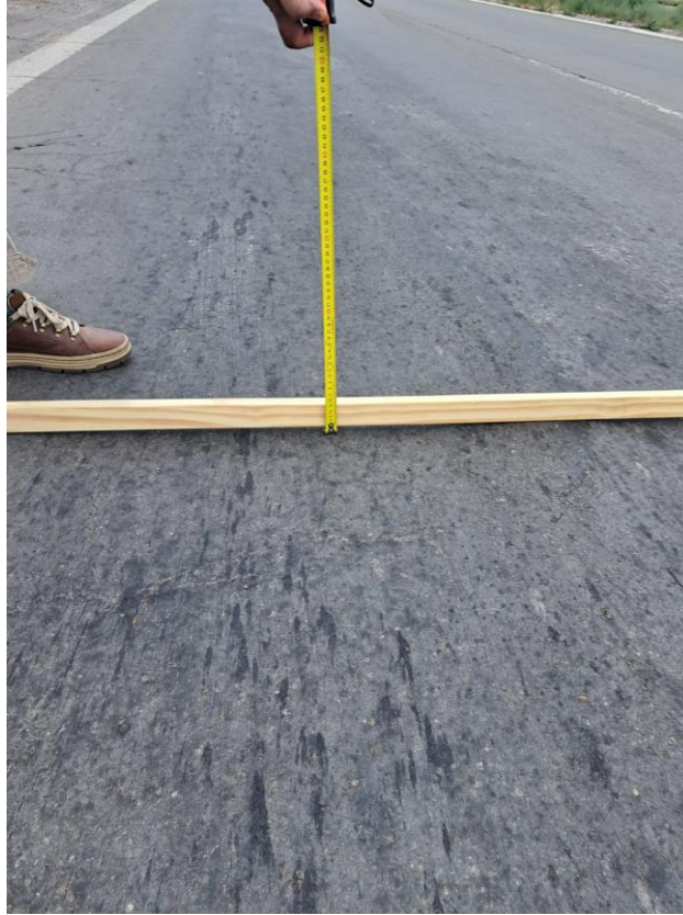
Fotografía 19. Muestra el ahuellamiento entre calle R.P. 50 y calle Lamadrid.
