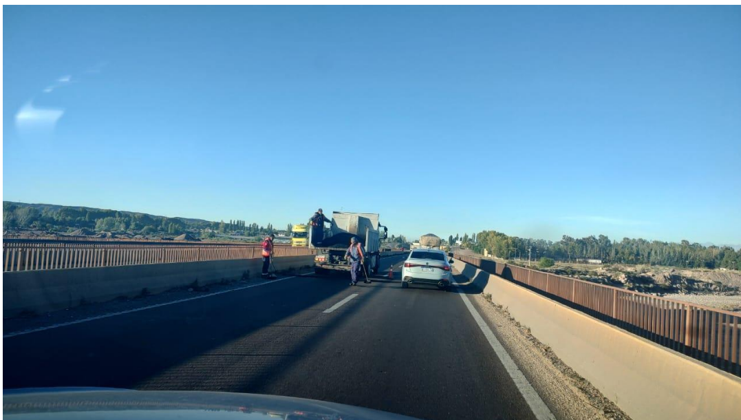
Fotografía 6: Muestra el estado de la calzada SOBRE Puente Rio Mendoza. Tramo Intersección Azcuénaga, Ruta 7
