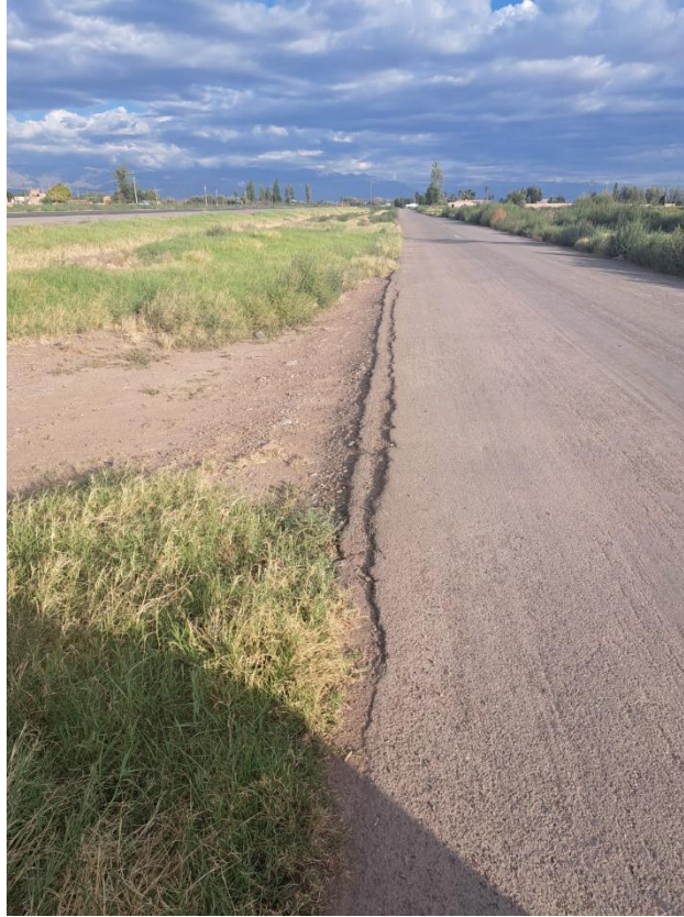
Fotografía 11. Muestra el estado de la calzada y las banquetas entre calle Tirazzo y R. P. 50
