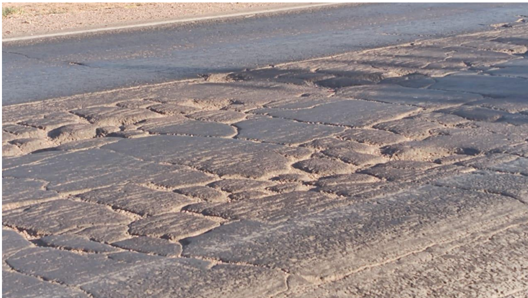
Fotografía 15. Muestra el estado de la calzada y las banquetas entre calle Azcuénaga y Calle Araoz.
