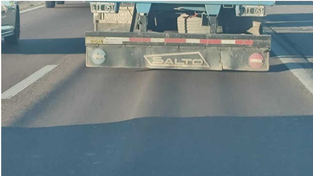
Fotografía 5: Muestra el estado de la calzada y banquetas. Tramo Intersección Azcuénaga, Ruta 7
