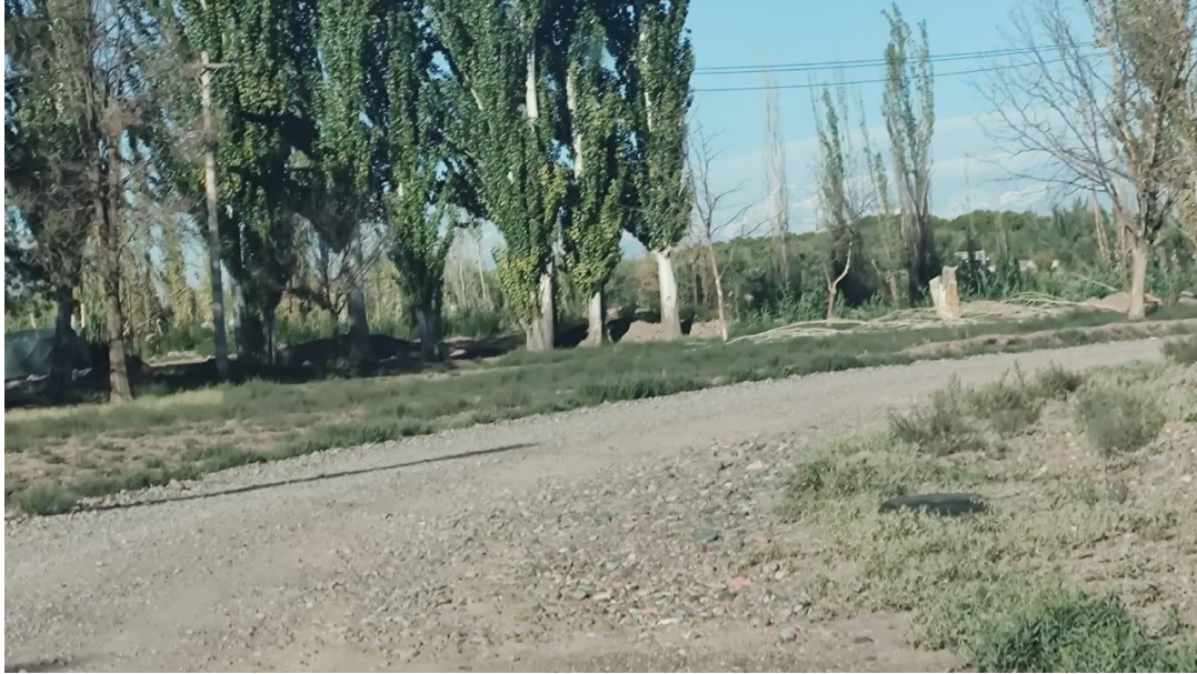
Fotografía 19. RN N 40 – J.J. Paso-Azcuénaga- Colectora Oeste (Descendente). Vista de la calzada de ripio y banquina después del cruce con calle Castro Barros.
