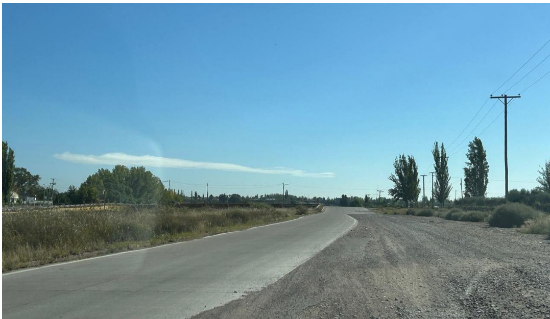
Fotografía18: Muestra el estado de la calzada enripiada. Rama entrada Ruta 40. Tramo Intersección Azcuénaga, Ruta 7, colectora Este.
