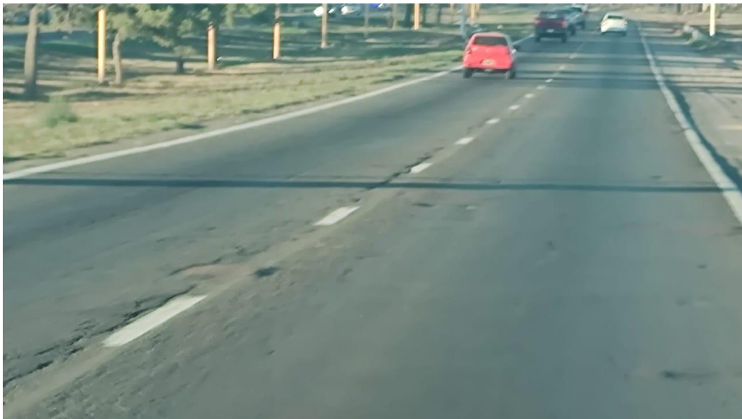
Fotografía 22. Muestra el estado de la calzada y las banquetas entre calle Araoz y calle Azcuénaga.
