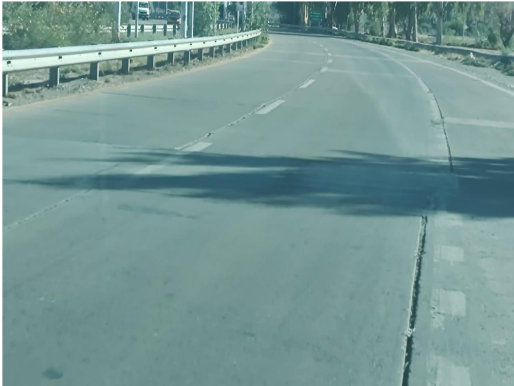
Fotografía 11. Calzada Principal Ascendente - Muestra el estado de la calzada y las juntas después de la Rotonda de calle Independencia.
