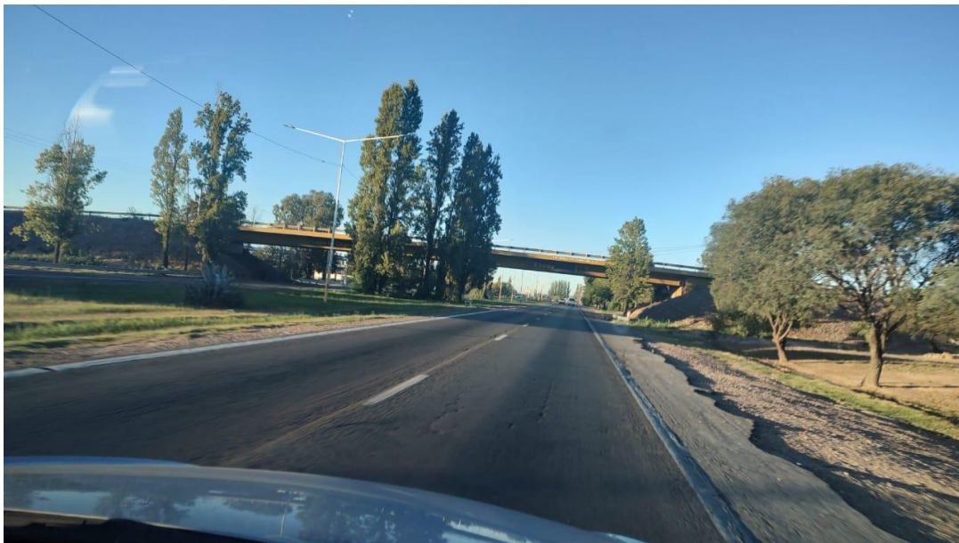
Fotografía 10. Muestra el estado de la calzada y la banquina externa entre J.J. Paso y calle Araoz. Cruce con calle Boedo.
