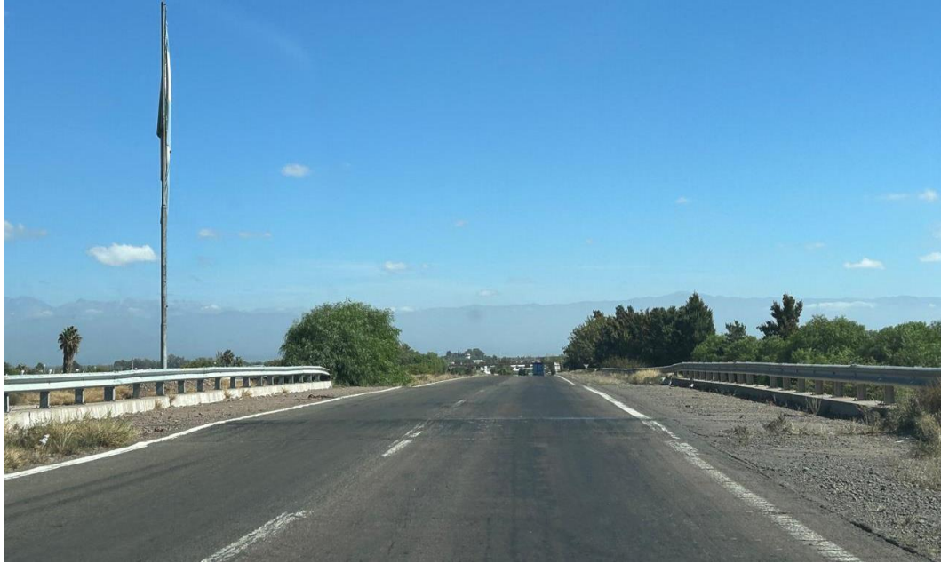
Fotografía 17. Muestra el estado de la calzada y las banquetas entre calle Medina y calle Los Álamos. – Zona de Juan L. Beltrán.
