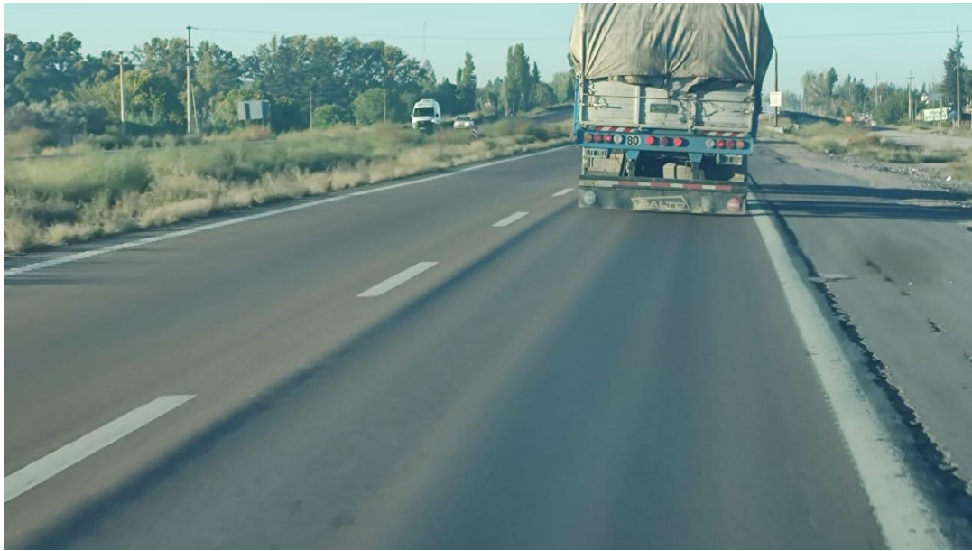
Fotografía 11: Muestra el estado de la calzada y banquetas. Tramo Intersección Azcuénaga, Ruta 7
