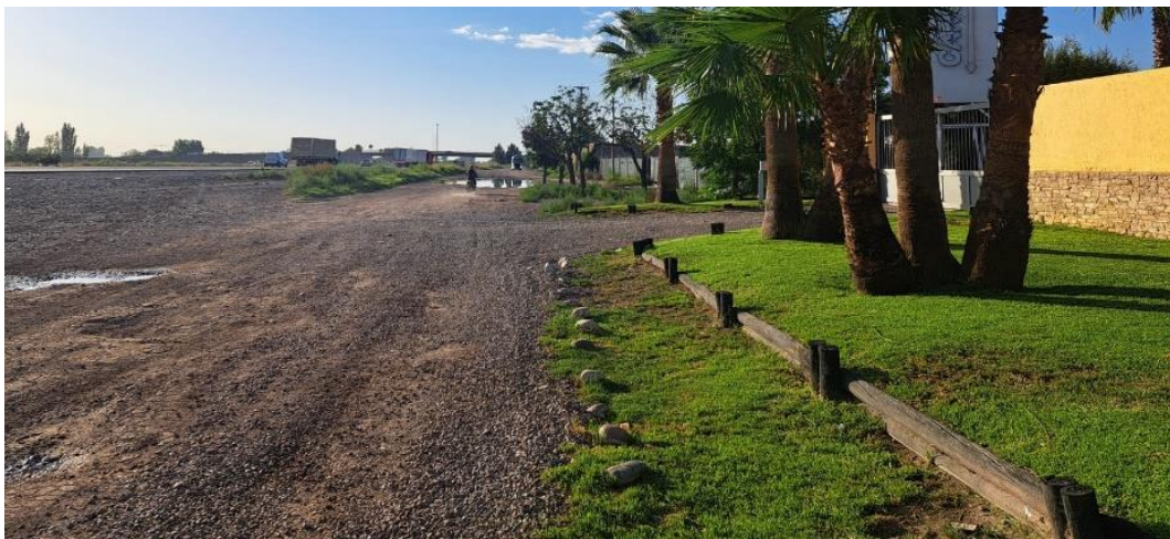
Fotografía 16. Muestra el estado de la calzada y las banquetas entre calle Tirasso Nicola Serpa y calle Laprida.
