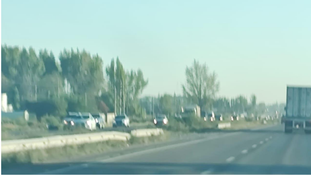
Fotografía 7: Muestra de la deformación de la calzada. Tramo Intersección Ruta 7, Azcuénaga.
