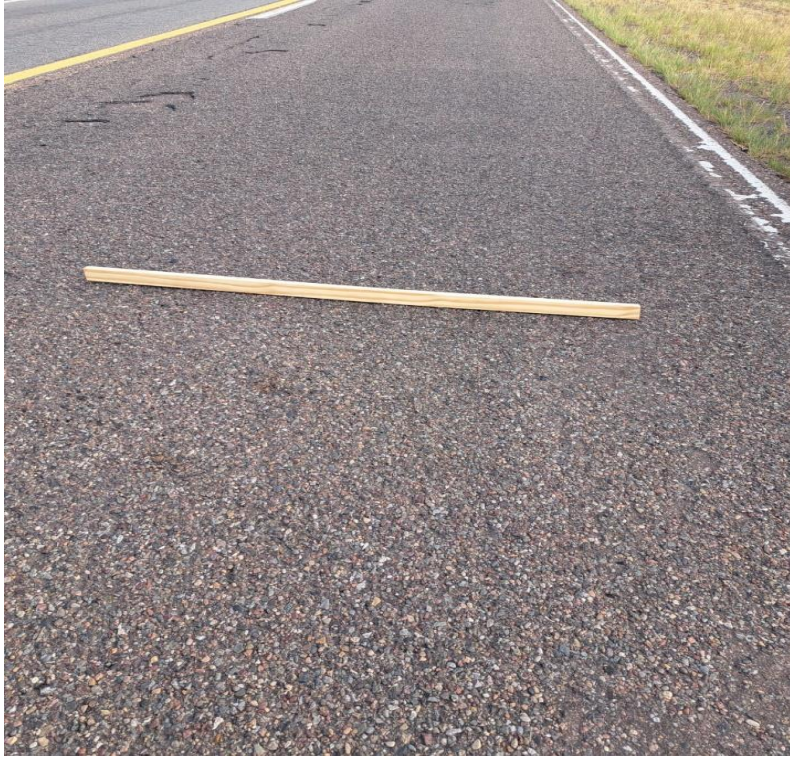
Fotografía 7. Muestra desprendimientos en la calzada en kilómetro 580.
