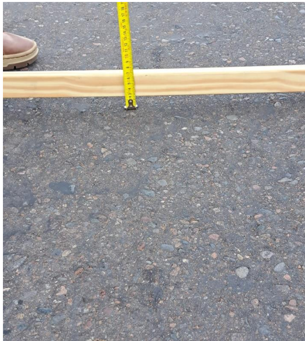
Fotografía 26. Muestra el ahuellamiento entre calle San Pedro y Calle Tirasso.
