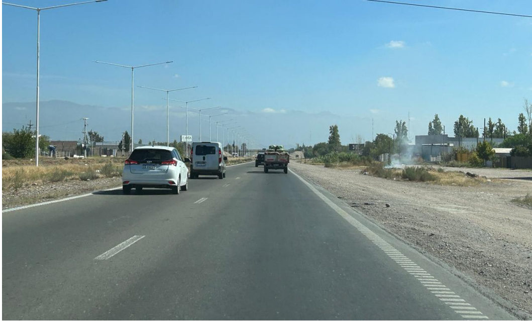
Fotografía 21. Muestra el estado de la calzada y las banquetas entre calle Los Álamos y Calle Tirasso.
