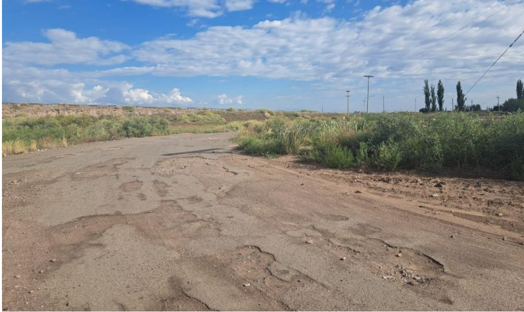
Fotografía 29. Muestra el estado de la calzada y las banquetas entre calle Nicola Serpa y calle Lamadrid.
