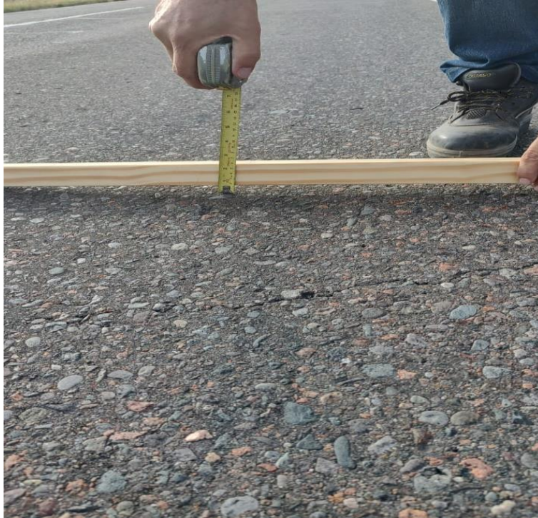
Fotografía 11. Muestra el ahuellamiento de la calzada antes del Arrollo Las Peñas
