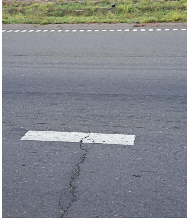
Fotografía 7. Fotografía 6. Muestra el estado de la calzada en calle Tirasso.
