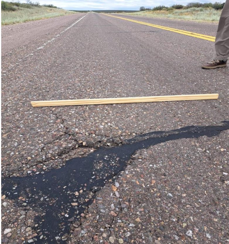
Fotografía 17. Muestra fisuras y la banquina en kilómetro 628. Fin del tramo.
