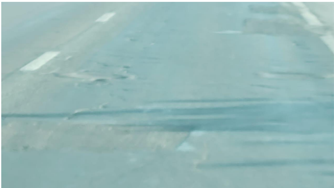
Fotografía 18 Muestra el estado de la calzada y las banquetas entre calle Araoz y J.J. Paso.
