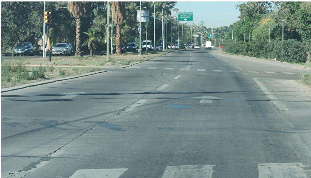
Fotografía 8. Calzada Principal – Descendente. Muestra el estado de las juntas en el cruce con la calle Pedro P. Segura.
