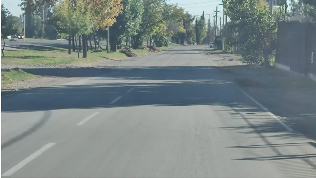
Fotografía 34. Muestra el estado de la calzada entre Calle Araoz y calle J.J. Paso.
