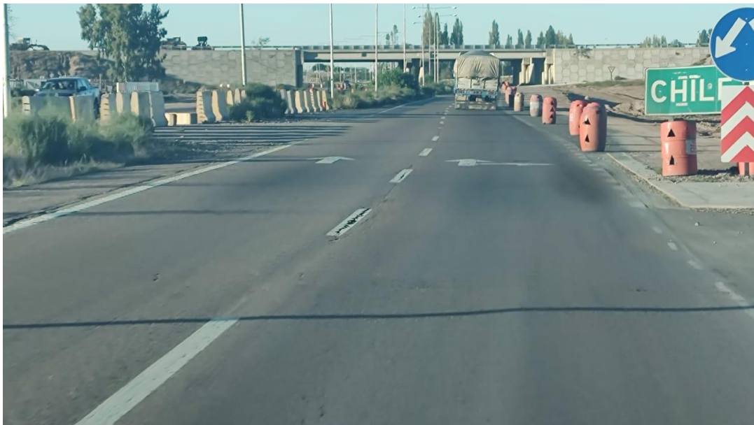
Fotografía 18: Muestra el estado de la calzada y banquetas. Tramo Intersección Azcuénaga, Ruta 7
