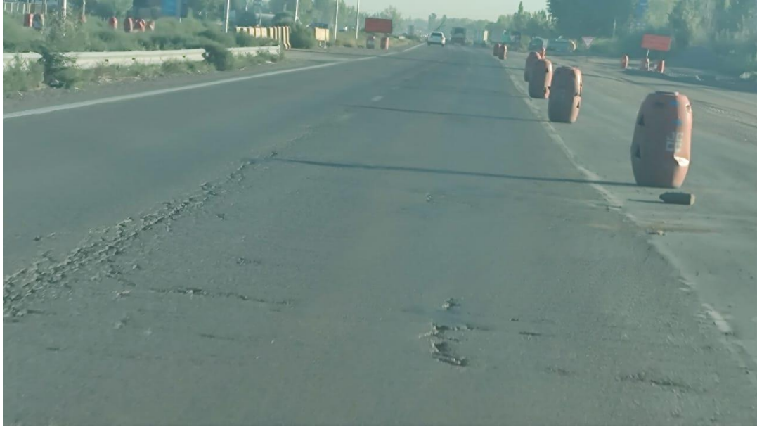
Fotografía 3: Muestra el estado de la calzada comienzo del tramo Intersección Ruta 7.
