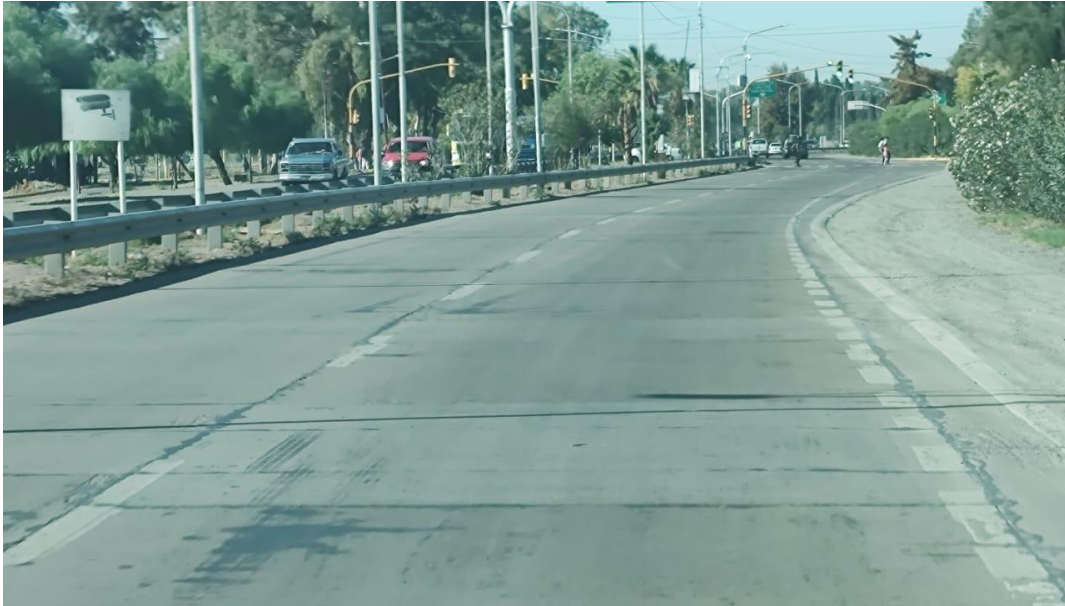
Fotografía 3. Calzada Principal – Descendente. Muestra las reparaciones de la calzada y el estado de las juntas en la zona del cruce con calle Libertad.
