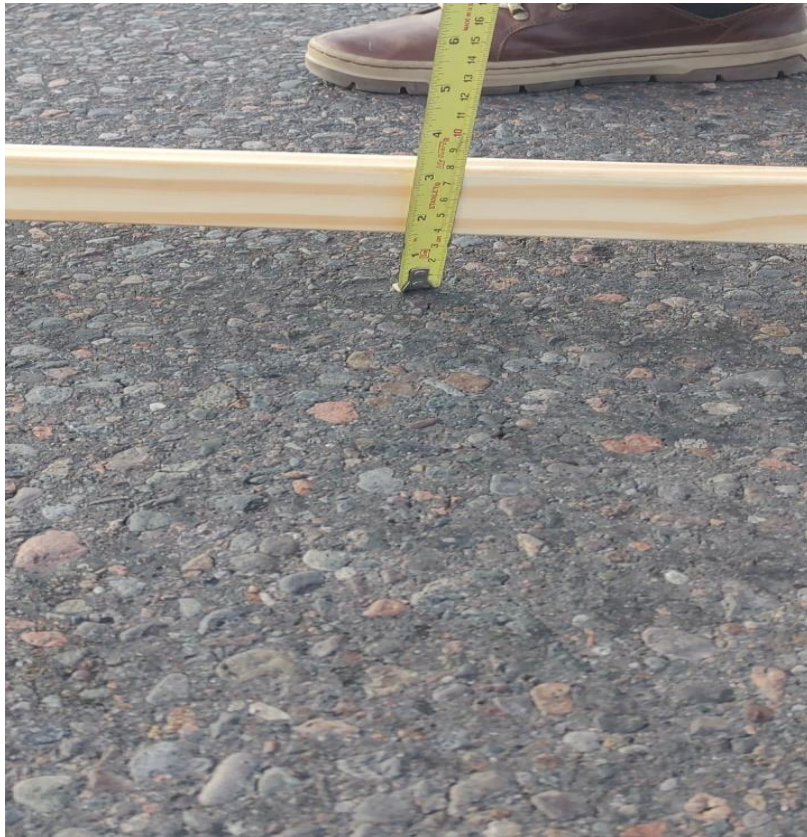
Fotografía 33 - Muestra el ahuellamiento de la calzada en Las Paredes
