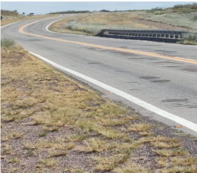
Fotografía 28. Otra vista del bacheo de la Calzada en el puente del Arrollo La Hedionda
