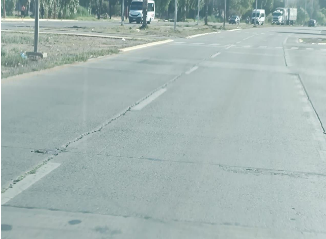
Fotografía 9. Calzada Principal Ascendente - Muestra las reparaciones en calzada y las juntas después en la Rotonda de calle Gral. Paz.
