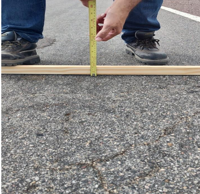
Fotografía 23 - Muestra el ahuellamiento de la calzada después del Arrollo El Chancho
