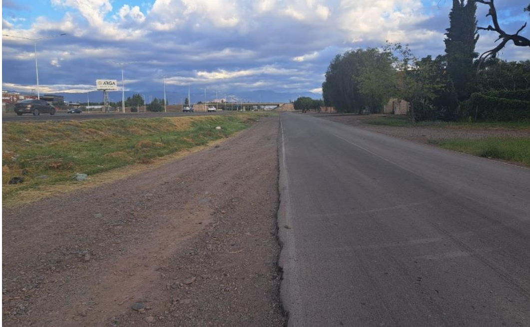
Fotografía 3. Muestra el estado de la calzada y la banquina entre calle Tirazzo y R. P. 50
