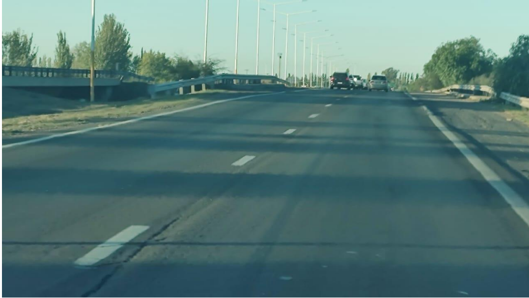
Fotografía 13. Muestra el estado de la calzada y la banquina externa entre J.J. Paso y calle Araoz. Cruce con calle Castro Barros
