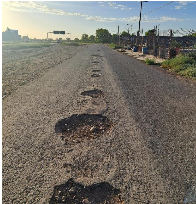
Fotografía 12. Muestra el estado de la calzada y las banquetas entre calle Tirasso y calle Nicola Serpa.
