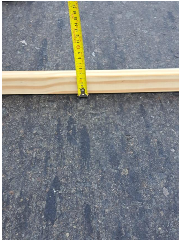
Fotografía 10. Muestra el ahuellamiento entre calle Tirasso y R. P. 50
