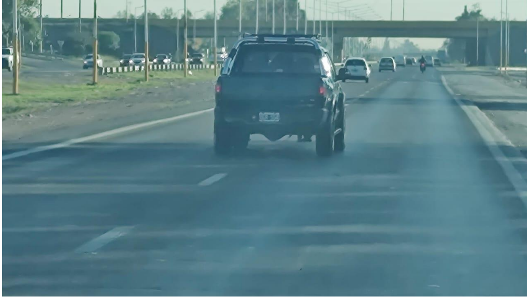
Fotografía 29. Muestra el estado de la calzada y las banquetas entre calle Arazo y J.J. Paso.
