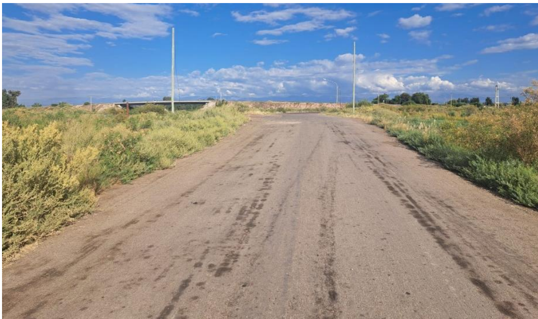
Fotografía 26. Muestra el estado de la calzada y las banquetas entre calle Nicola Serpa y calle Lamadrid.
