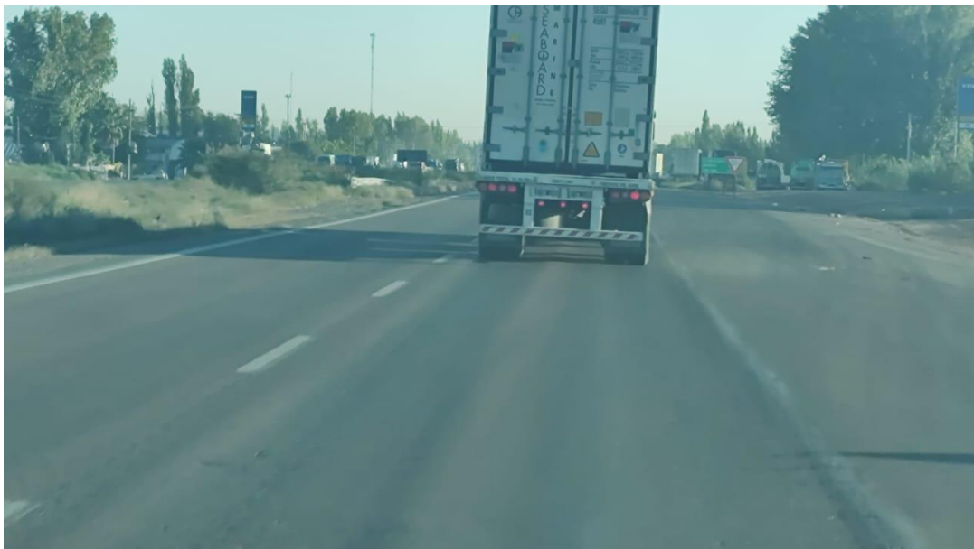
Fotografía 4: Muestra el estado de la calzada, ahuellamiento, tramo Intersección Ruta 7 y Azcuénaga.
