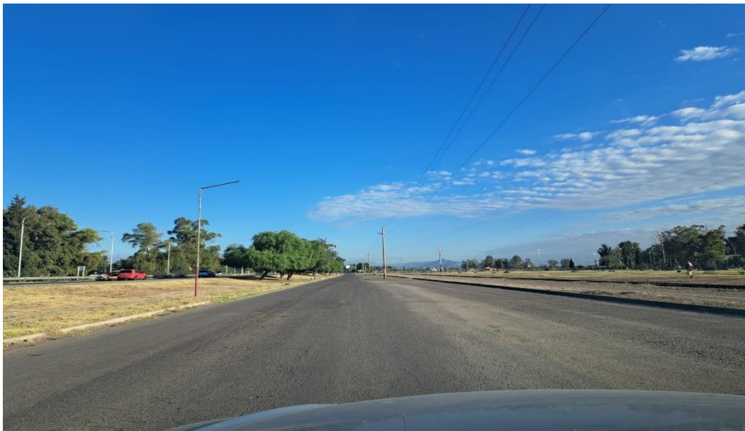
Fotografía 10. Vista del tipo y estado de la calzada entre Independencia y Libertad.
