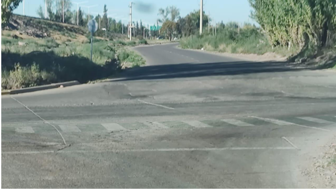
Fotografía 45. RN N 40 – J.J. Paso-Azcuénaga- Colectora Oeste (Descendente)
