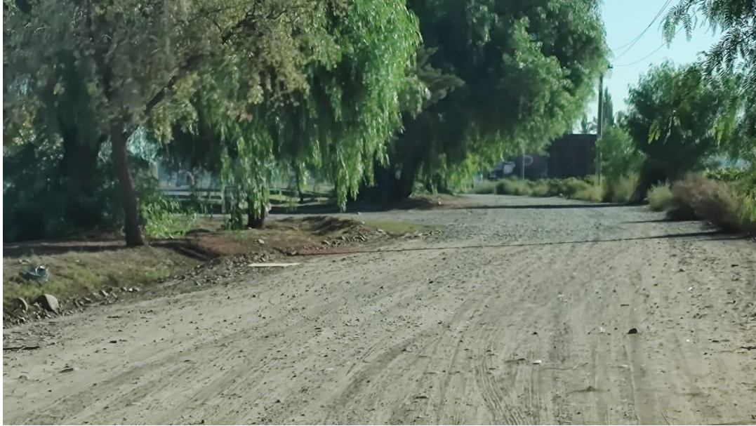
Fotografía 17. Muestra el estado de la calzada entre Calle Azcuénaga y Calle Araoz.
