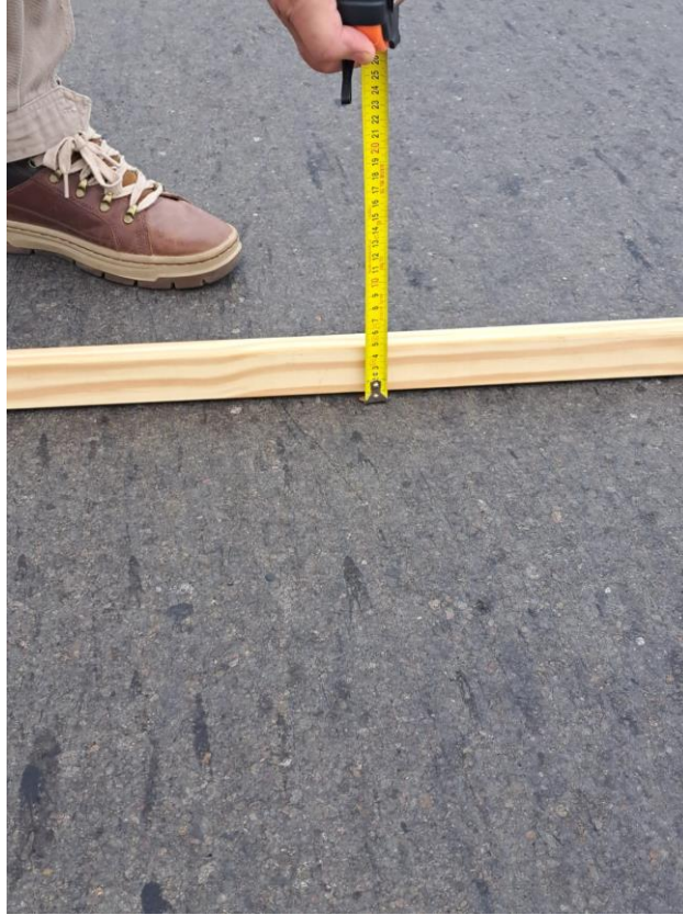
Fotografía 15. Muestra el ahuellamiento entre calle R.P. 50 y calle Lamadrid.
