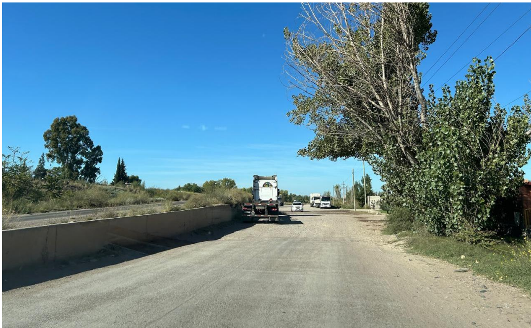
Fotografía 14: Muestra el estado de la calzada. Rama egreso intersección calle Olavarría Tramo Intersección Azcuénaga, Ruta 7, colectora Oeste.
