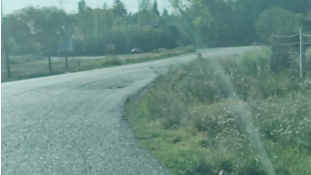
Fotografía 22. Muestra el estado de la calzada entre Calle Azcuénaga y Calle Araoz.
