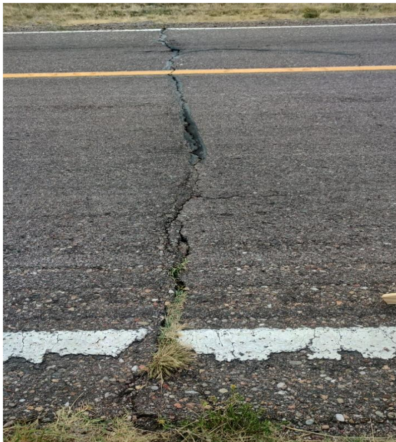
Fotografía 18. Muestra la fisura transversal en la calzada en la zona del Arrollo Silva
