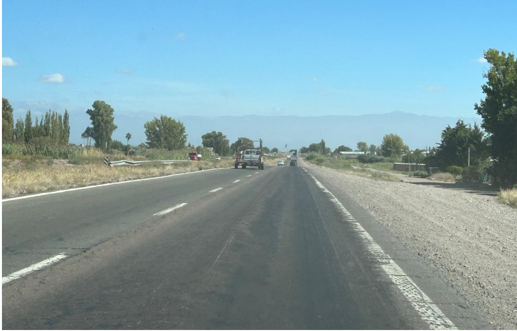
Fotografía 13. Muestra el estado de la calzada y las banquetas entre calle Medina y calle Los Álamos.
