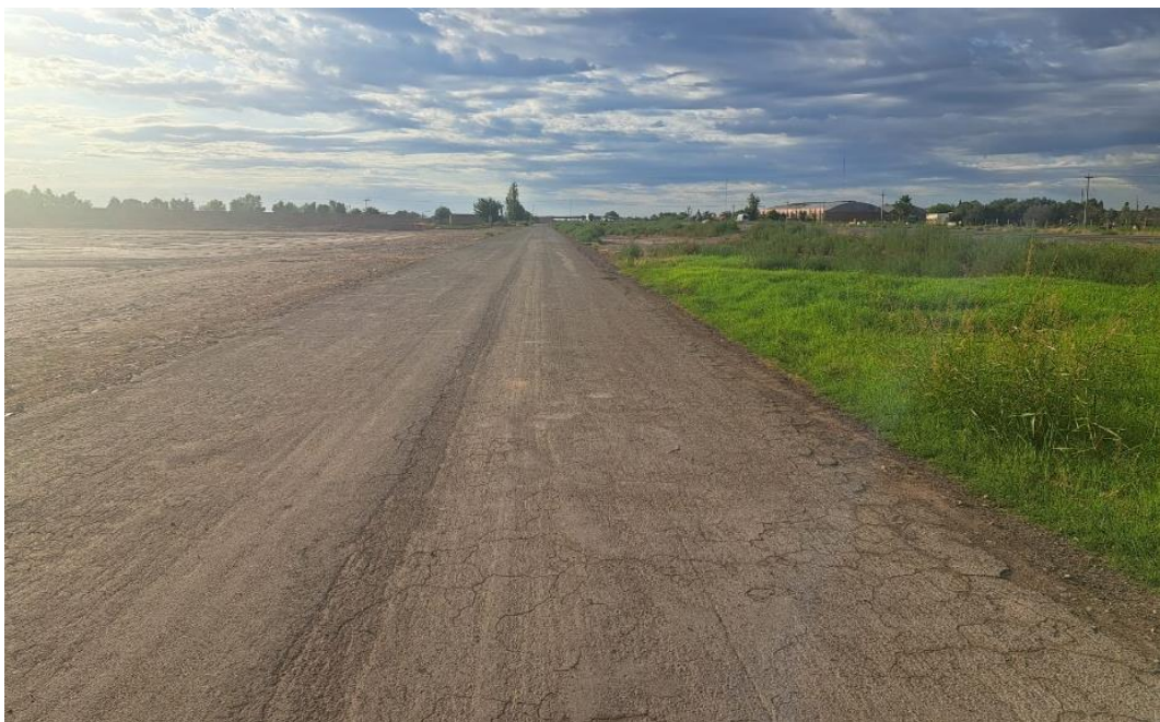
Fotografía 12. Muestra el estado de la calzada y las banquetas entre calle Tirazzo y R. P. 50
