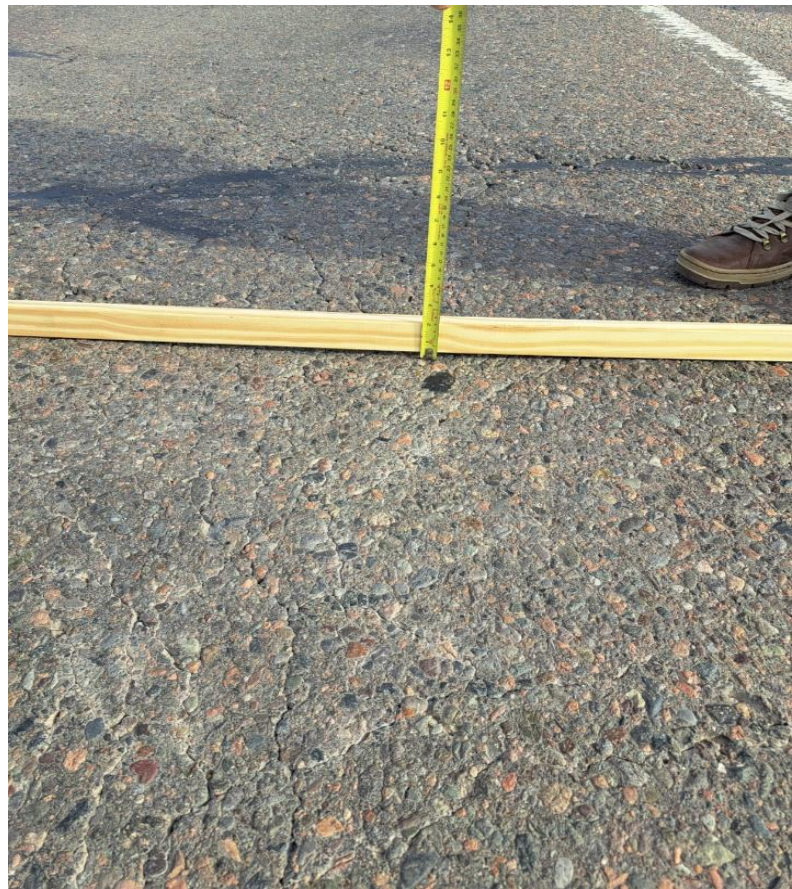
Fotografía 6. Muestra el ahuellamiento en kilómetro 575.
