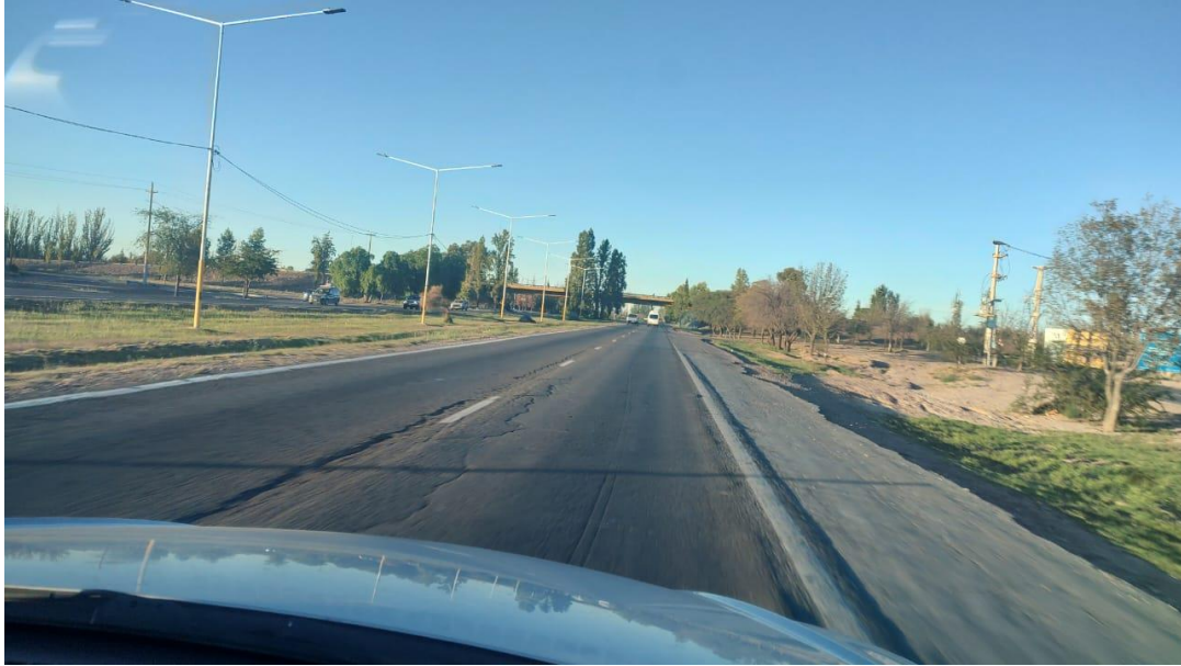
Fotografía 9. Muestra el estado de la calzada y la banquina externa entre J.J. Paso y calle Araoz.
