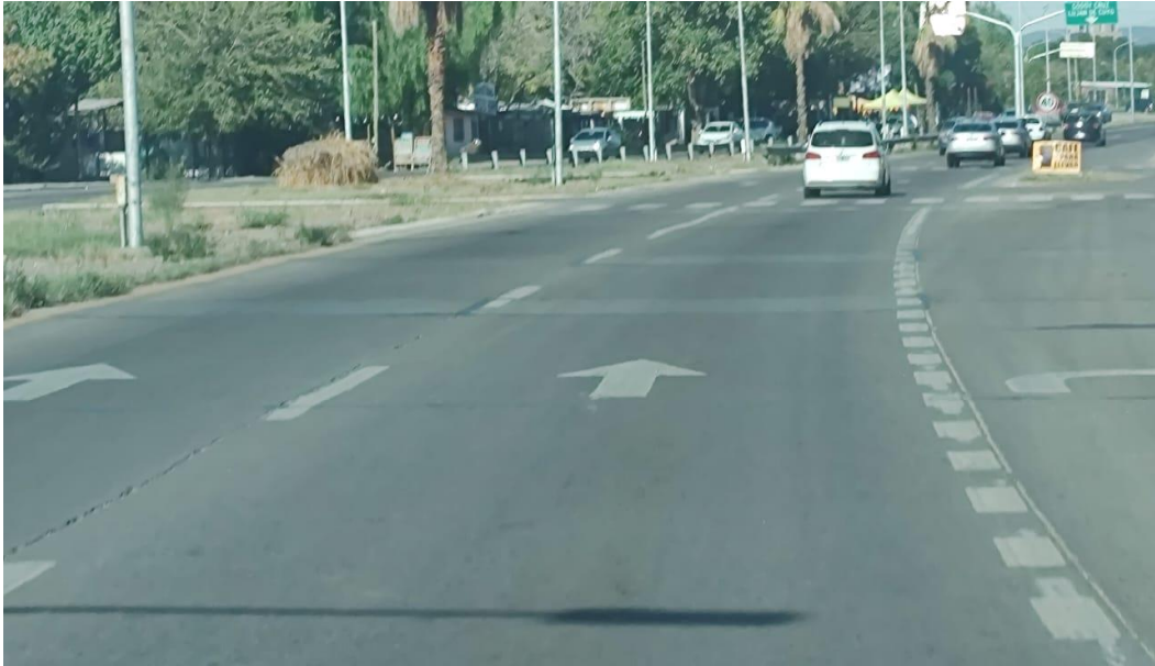
Fotografía 11. Calzada Principal – Descendente. Muestra las reparaciones efectuadas en la calzada y el estado de las juntas en la Rotonda del Avión. Fin del tramo.
