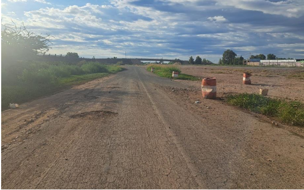
Fotografía13. Muestra el estado de la calzada y las banquetas entre calle Nicola Serpa y calle Lamadrid.
