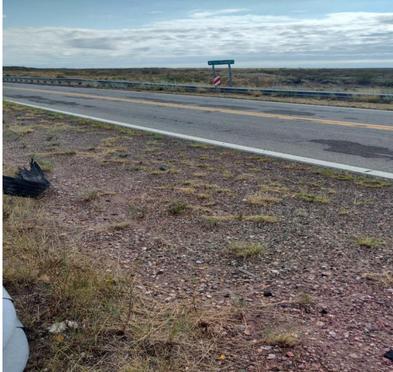
Fotografía 25. Muestra el estado de la Calzada y la banquina en el puente del Arrollo El Chancho
