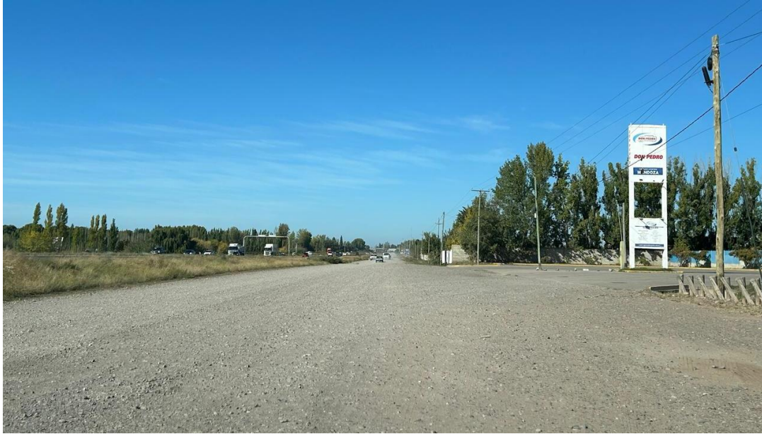
Fotografía 15: Muestra el estado de la calzada enripiada. Tramo Intersección Azcuénaga, Ruta 7, colectora Oeste.
