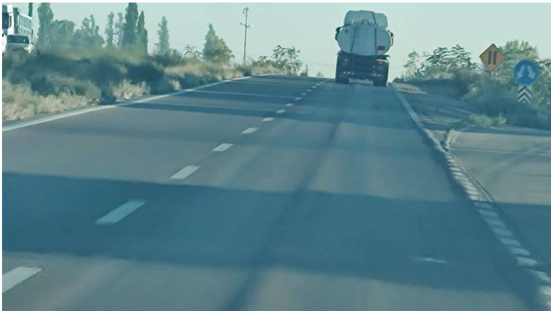
Fotografía 16: Muestra el estado de la calzada y banquetas. Tramo Intersección Ruta 7 y Azcuénaga.
