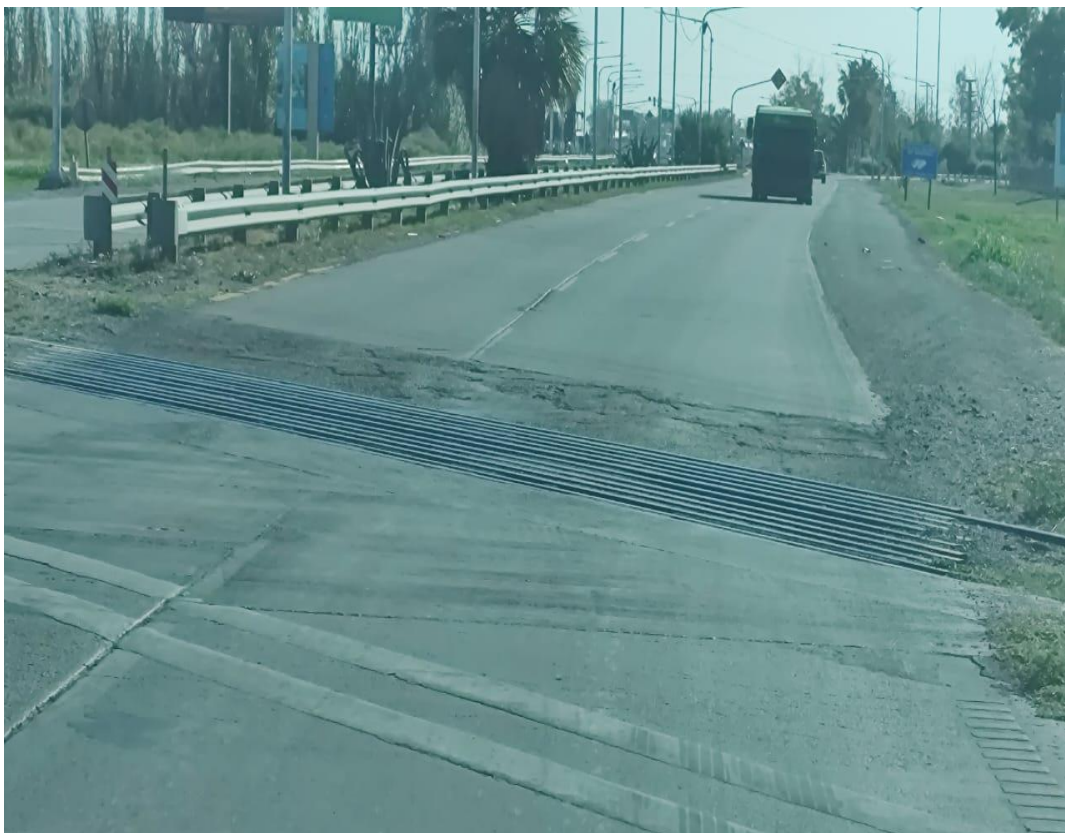
Fotografía 14. Calzada Principal Ascendente - Muestra el estado de la calzada y las juntas en el cruce con el FFCC. Fin del tramo.
