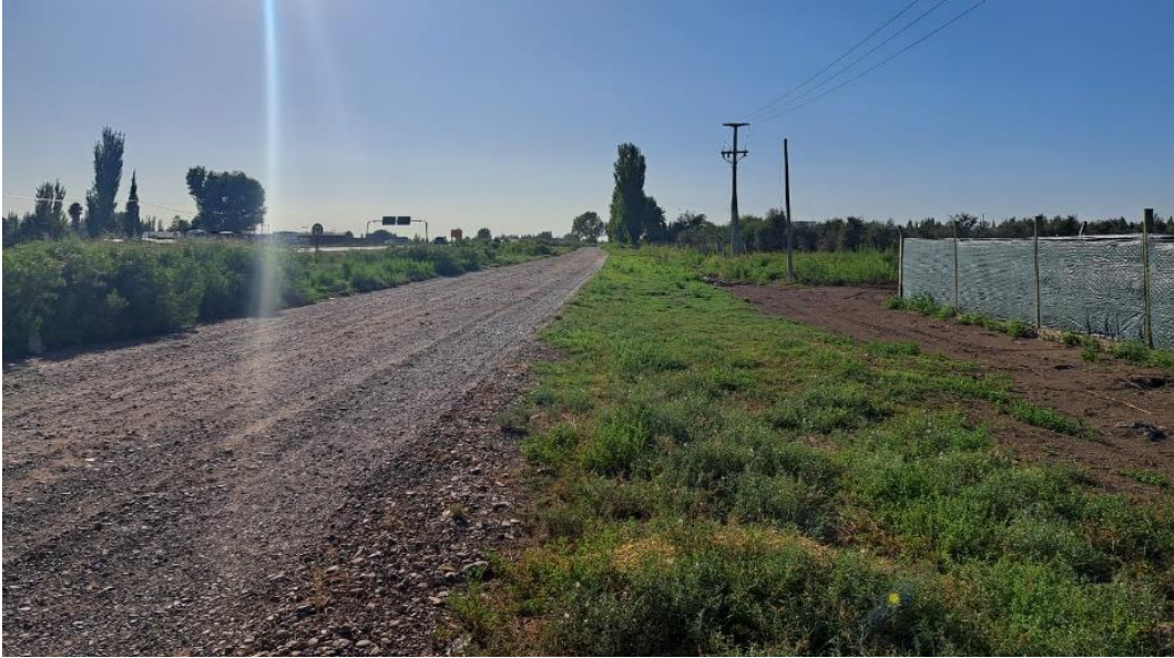
Fotografía 25. Muestra el estado de la calzada y las banquetas entre calle Nicola Serpa y calle Laprida.
