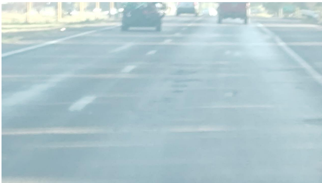
Fotografía 21. Muestra el estado de la calzada y las banquetas entre calle Araoz y J.J. Paso.
