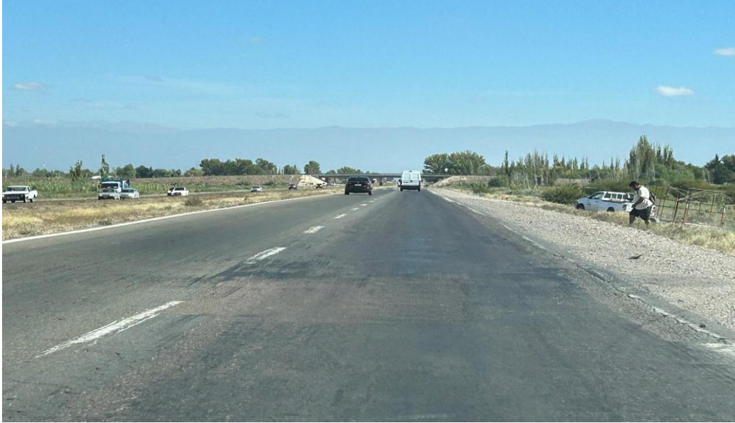
Fotografía 9. Muestra el estado de la calzada y las banquetas entre calle San Pedro y calle Medina. Obsérvese el intento de cruce de un peatón.
