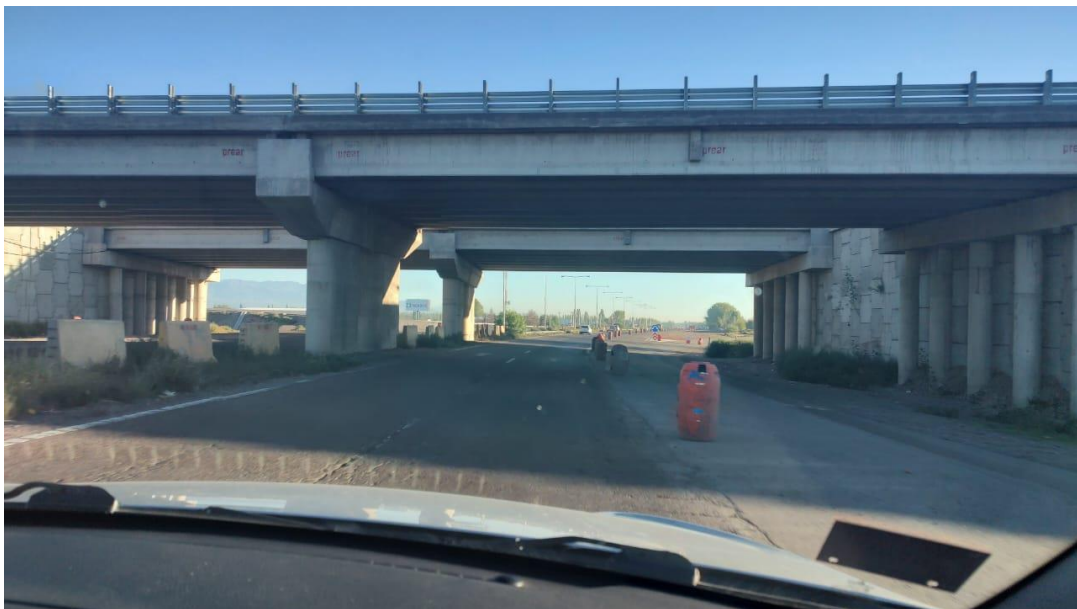
Fotografía 2: Muestra el estado de la calzada comienzo del tramo Intersección
