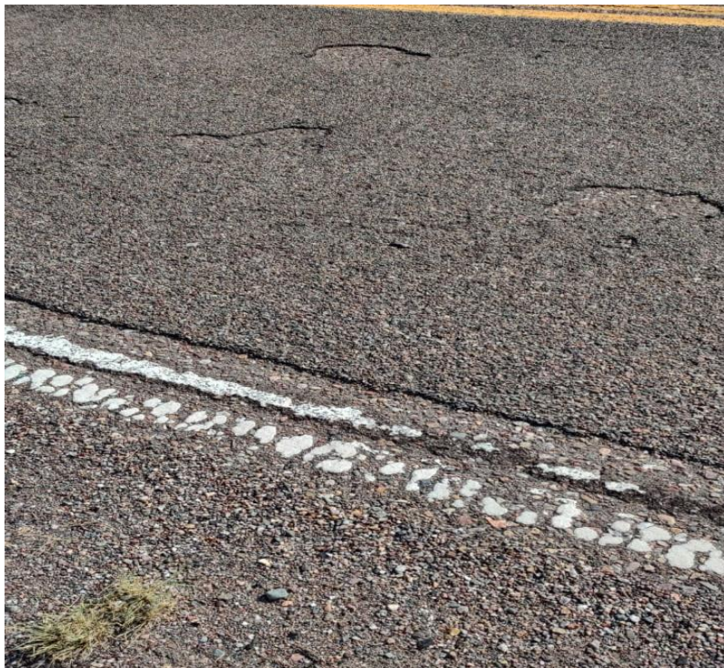
Fotografía 24. Muestra desprendimientos de la calzada antes del Arrollo El Chancho
