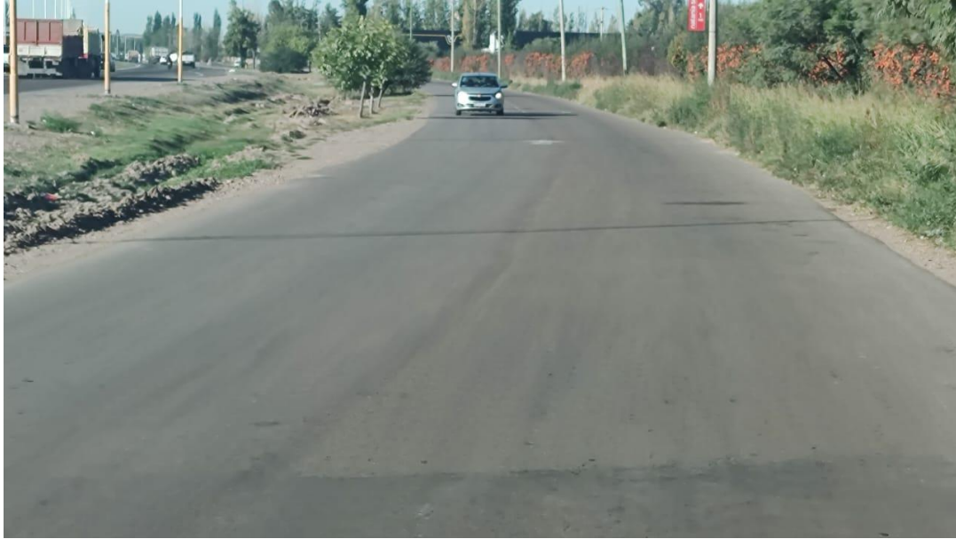
Fotografía 35. RN N 40 – J.J. Paso-Azcuénaga- Colectora Oeste (Descendente). Otra vista de la calzada y banquina después del cruce con calle Araoz.
