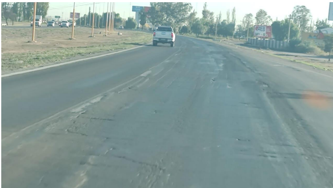
Fotografía 11. Muestra el estado de la calzada y las banquetas entre calle Azcuénaga y Calle Araoz.
