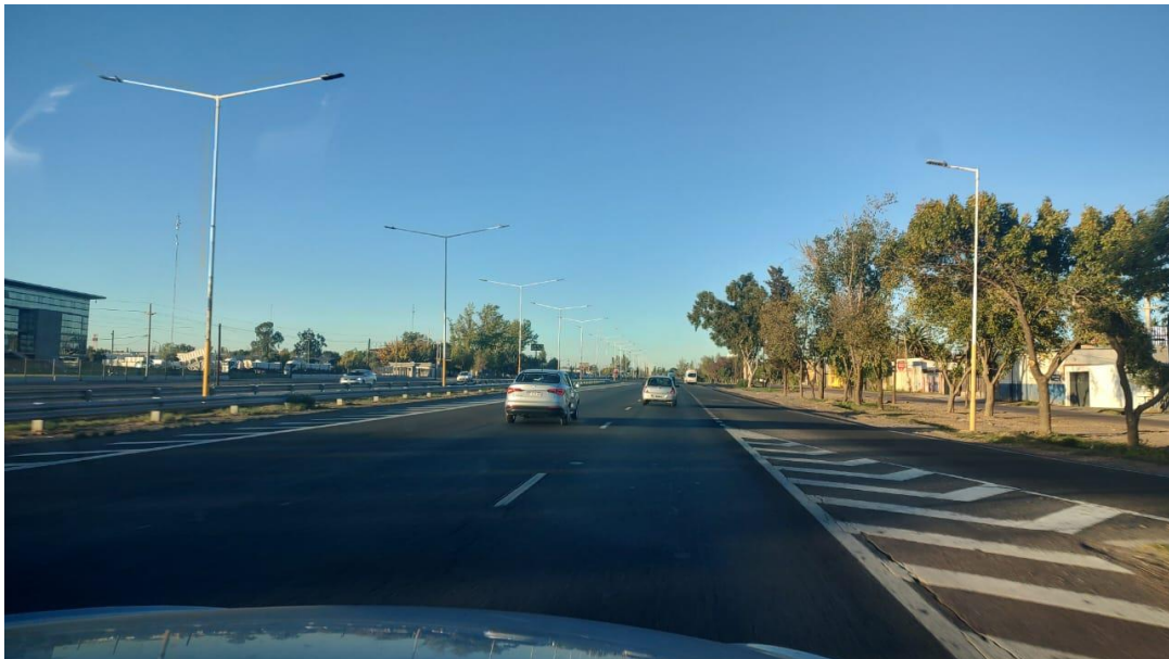
Fotografía 2. Muestra el estado de la calzada entre J.J. Paso y calle Araoz.
