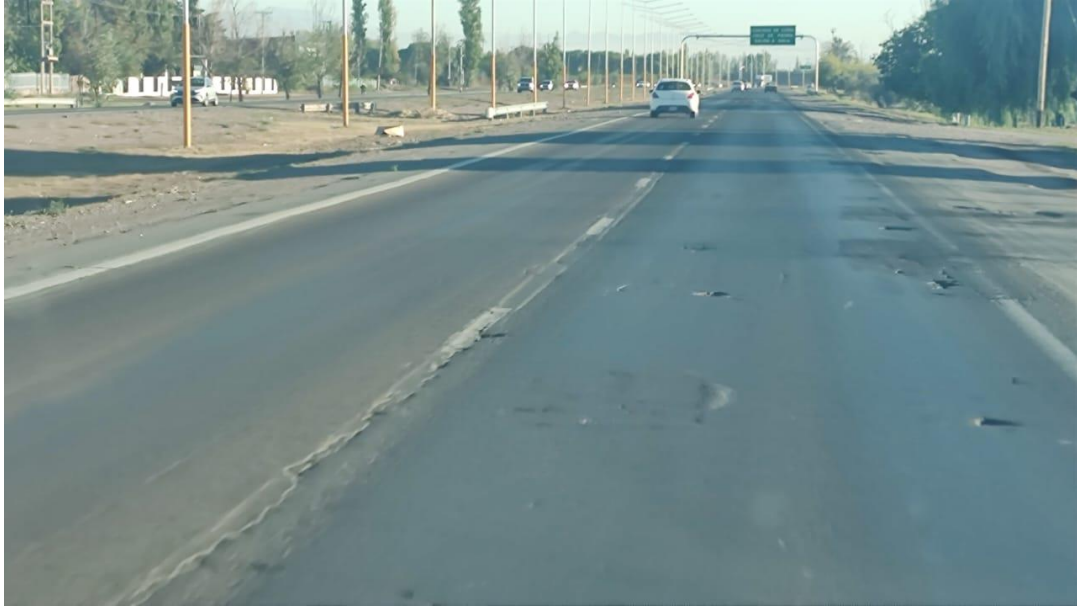
Fotografía 14. Muestra el estado de la calzada y las banquetas entre calle Azcuénaga y Calle Araoz.
