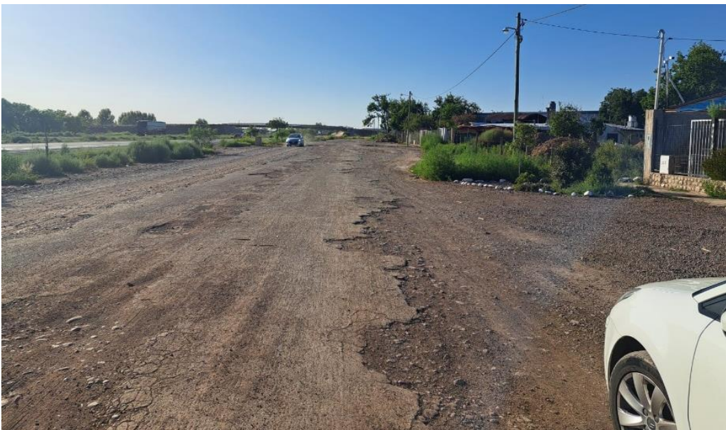
Fotografía 20. Muestra el estado de la calzada y las banquetas entre calle Nicola Serpa y calle Laprida.
