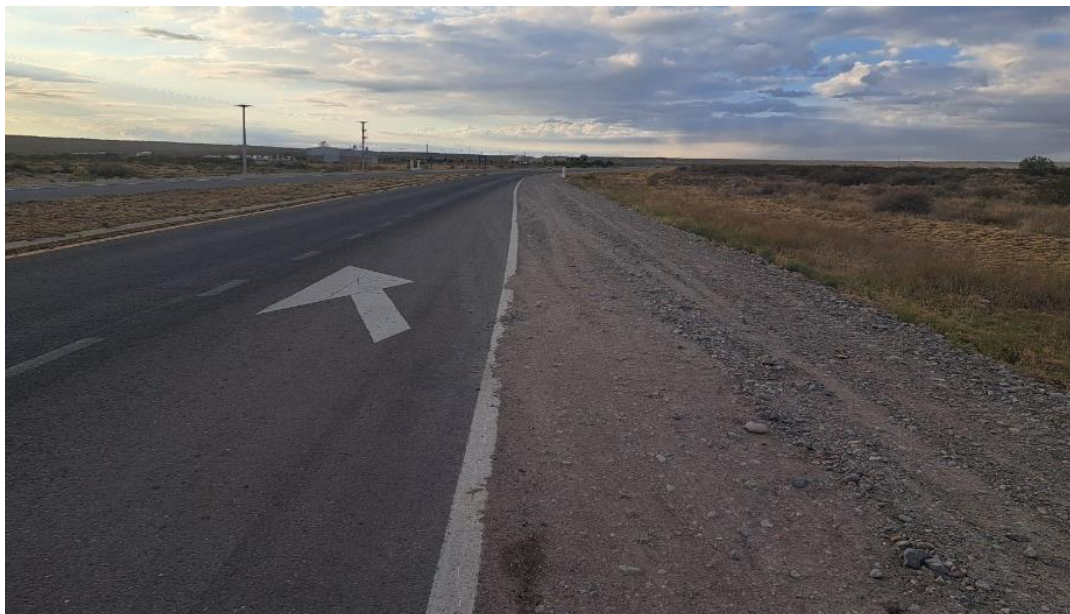
Fotografía 1. Muestra el estado de la calzada y la banquina al inicio del tramo.
