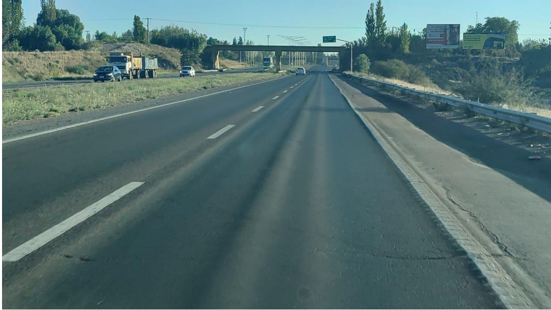
Fotografía 23: Muestra el estado de la calzada y banquetas. Tramo Intersección Ruta 7 y Azcuénaga.
