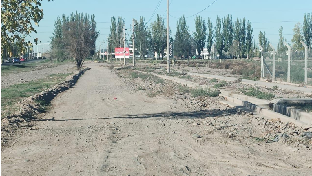
Fotografía 17. RN N 40 – J.J. Paso-Azcuénaga- Colectora Oeste (Descendente). Otra vista de la calzada de ripio y banquina después del cruce con calle Boedo.
