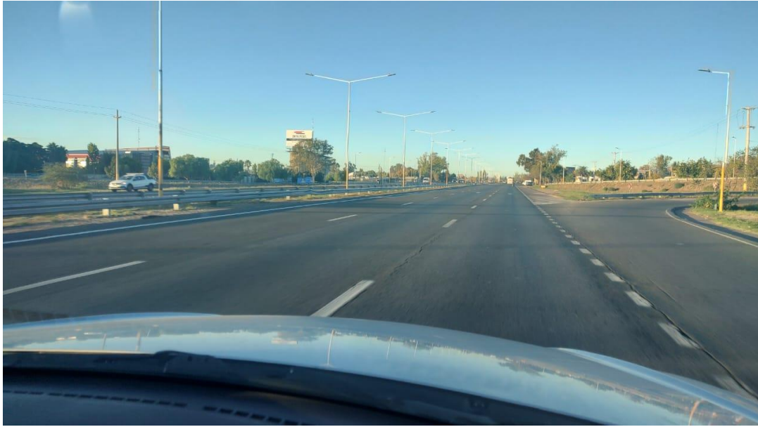
Fotografía 1. Muestra el estado de la calzada en el cruce con J.J. Paso. Inicio del tramo.
