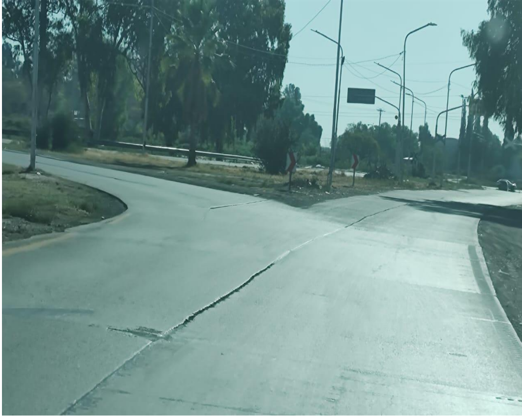
Fotografía 7. Calzada Principal Ascendente - Muestra el estado de calzada y las juntas en la Rotonda de Gral. Paz
