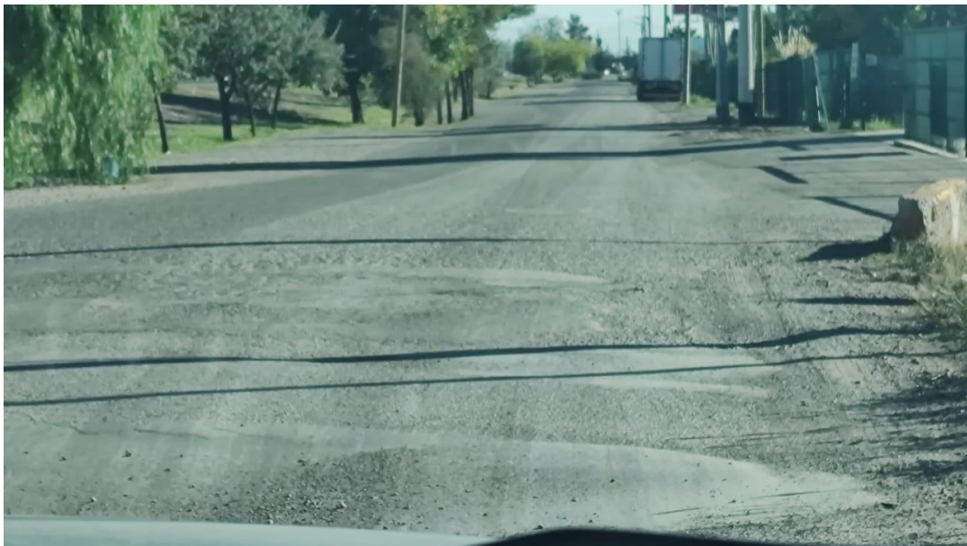
Fotografía 20. Muestra el estado de la calzada entre Calle Azcuénaga y Calle Araoz.
