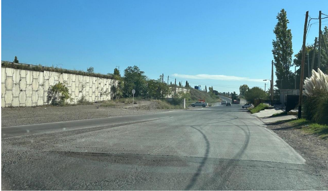
Fotografía 15 Muestra el estado de la calzada intersección Quintana. Tramo Intersección Azcuénaga, Ruta 7, colectora Este.
