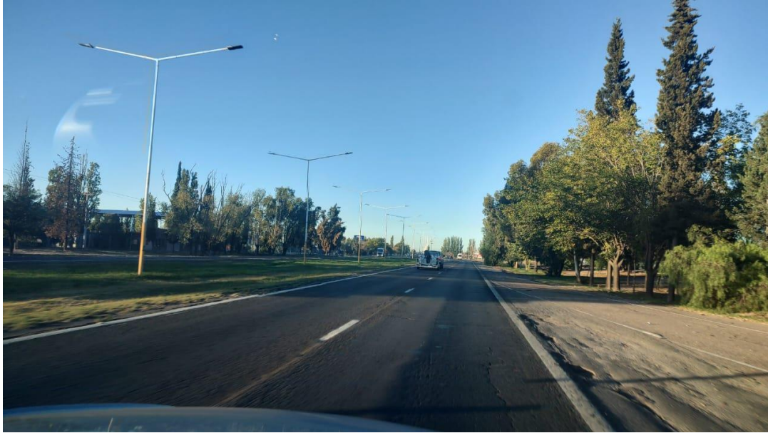
Fotografía 11. Muestra el estado de la calzada y la banquina externa entre J.J. Paso y calle Araoz.
