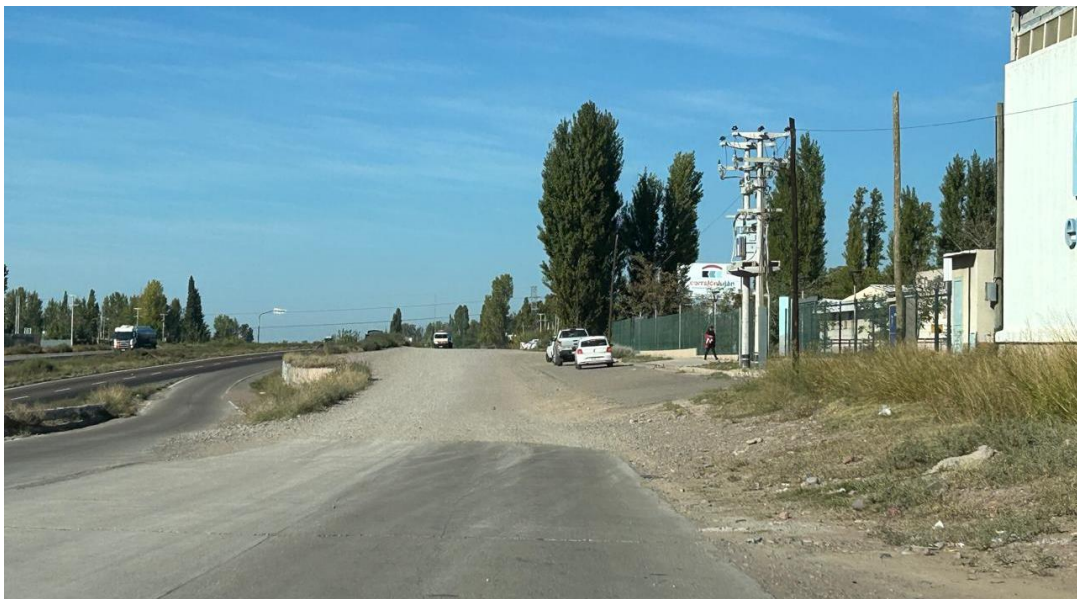
Fotografía 8: Muestra el estado de la calzada enripiada. Rama salida Calle Quintana. Tramo Intersección Azcuénaga, Ruta 7, colectora Oeste.
