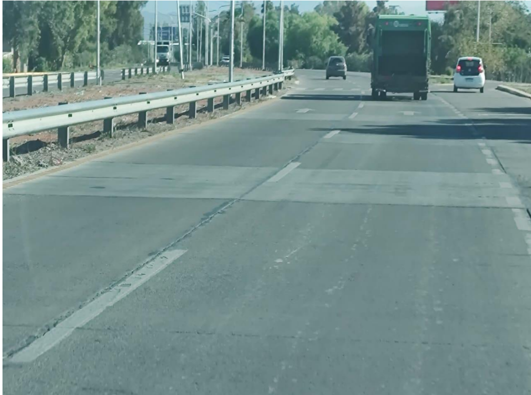
Fotografía 12. Calzada Principal Ascendente - Muestra el estado de la calzada y las juntas próximas al cruce con calle Libertad.
