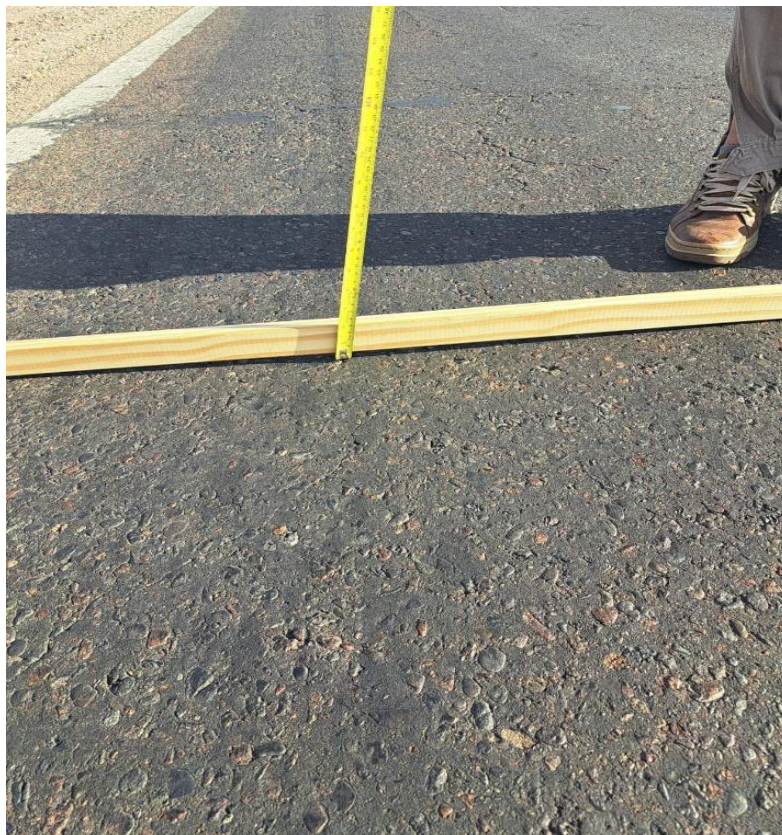
Fotografía 2. Muestra el ahuellamiento en kilómetro 545.
