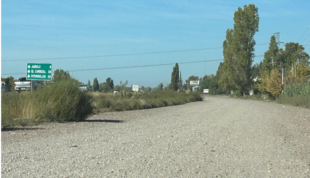
Fotografía 11: Muestra el estado de la calzada enripiada. Tramo Intersección Azcuénaga, Ruta 7, colectora Oeste.
