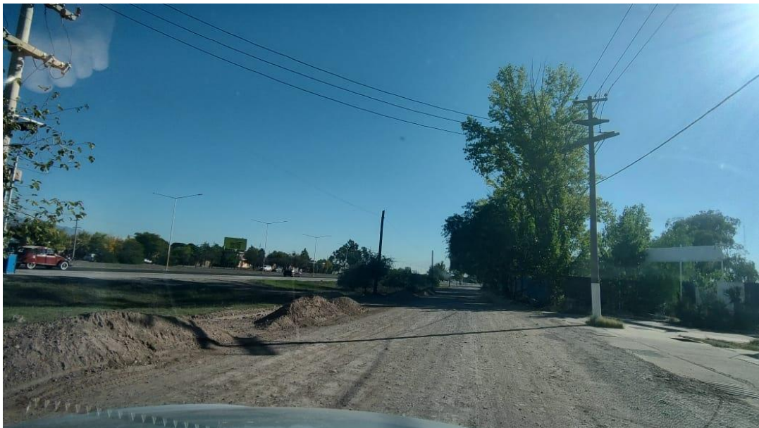
Fotografía 43. Muestra el estado de la calzada entre Calle Araoz y calle J.J. Paso.
