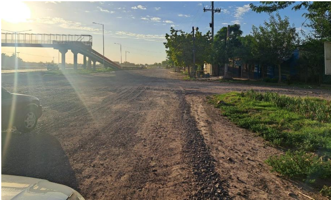
Fotografía 10. Muestra el estado de la calzada y las banquetas entre calle Tirasso y calle Nicola Serpa.
