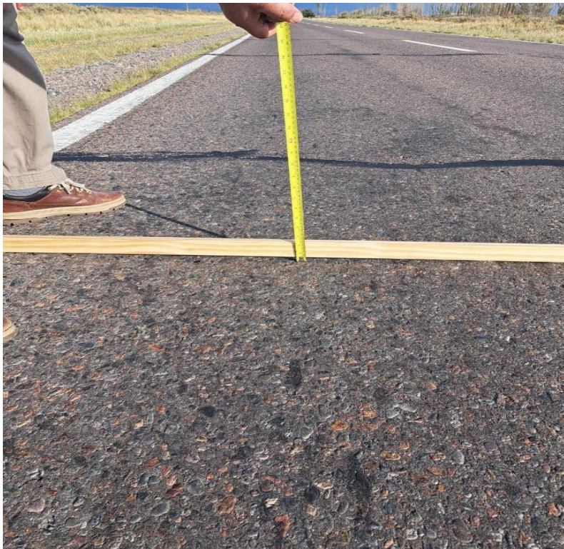
Fotografía 8. Muestra el ahuellamiento en kilómetro 585.
