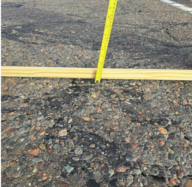
Fotografía 9. Muestra el ahuellamiento en kilómetro 595.
