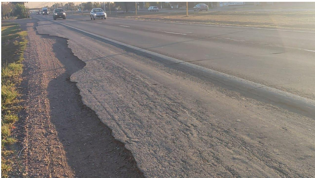
Fotografía 6. Muestra el estado de la calzada y la banquina externa entre J.J. Paso y calle Araoz.
