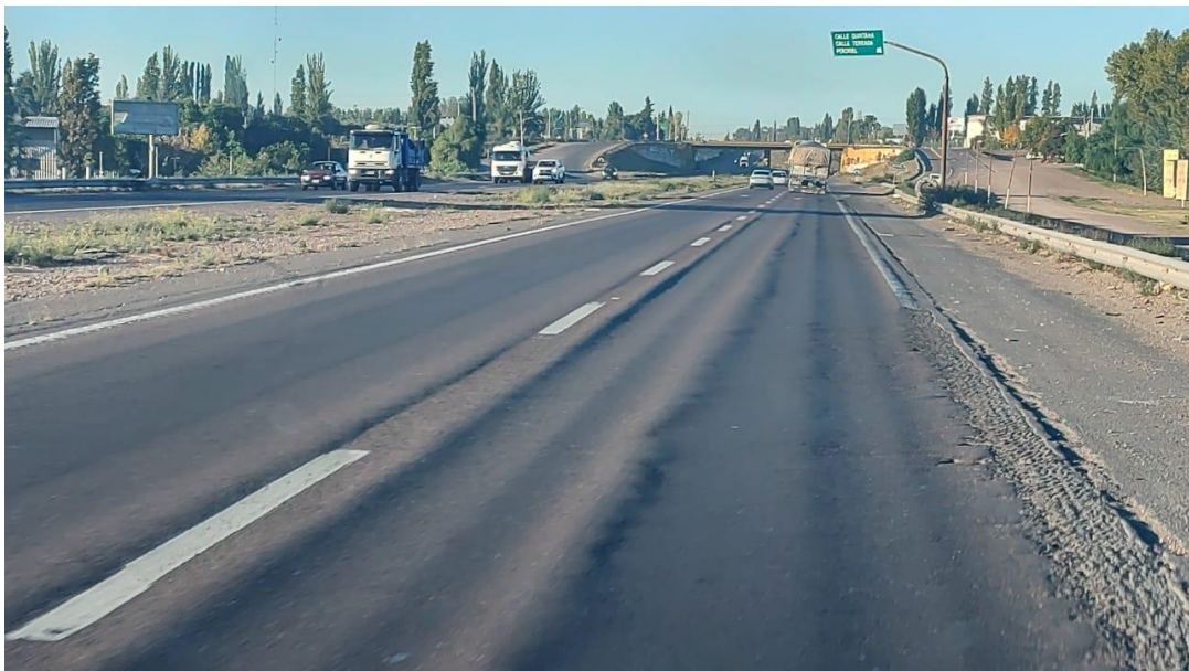
Fotografía 8: Muestra el estado de la calzada y banquetas. Tramo Intersección Azcuénaga, Ruta 7
