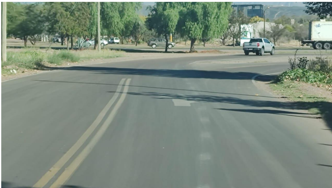
Fotografía 37. Muestra el estado de la calzada entre Calle Araoz y calle J.J. Paso.
