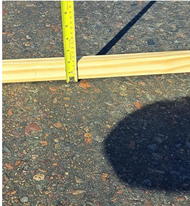
Fotografía 13. Muestra el ahuellamiento en la zona entre El Arrollo Carrizal y el cruce con la RN N° 7 – Fin del tramo
