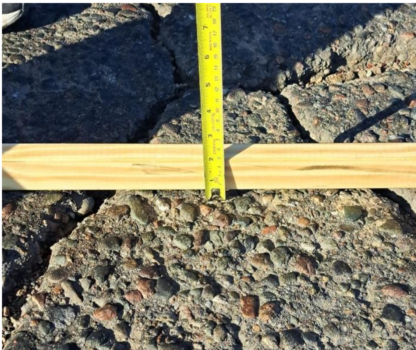
Fotografía 2. Muestra la fisuración y desprendimiento entre la Rotonda de La Tonada y Zapata.
