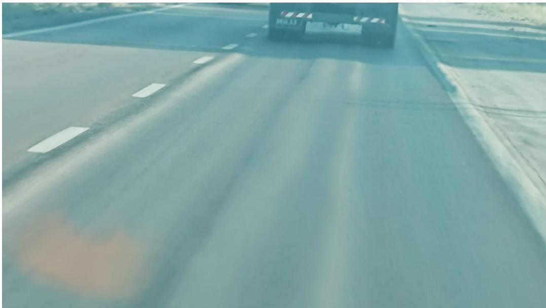
Fotografía 12: Muestra el estado de la calzada y banquetas. Tramo Intersección Ruta 7 y Azcuénaga.
