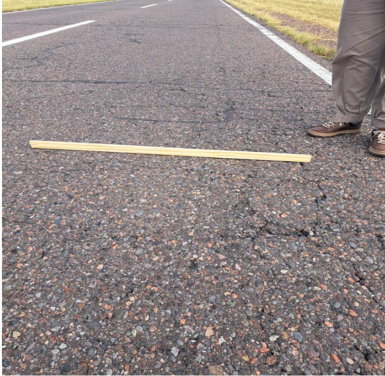
Fotografía 11. Muestra el ahuellamiento en kilómetro 615.
