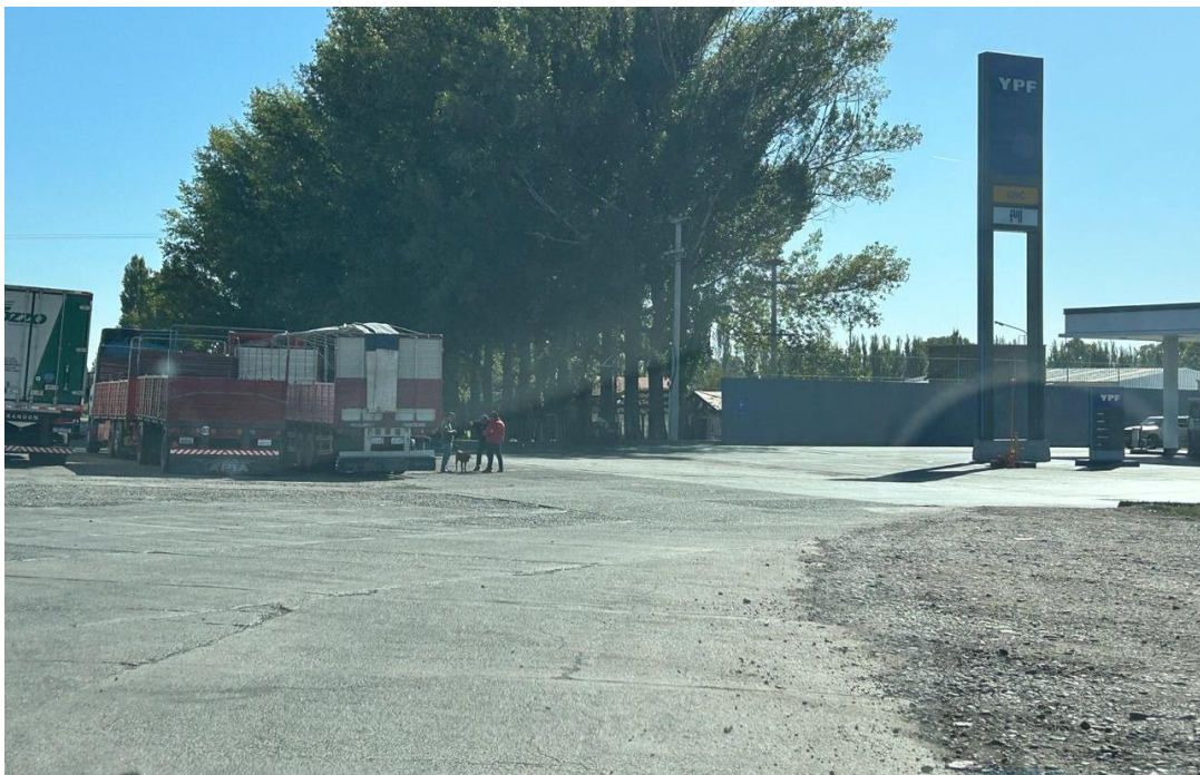
Fotografía 4: Muestra el estado de la calzada, rama de entrada Estacio de Servicio. Tramo Intersección Azcuénaga, Ruta 7, colectora Este.
