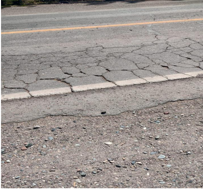
Fotografía 35- Muestra las fisuras en la calzada y la banquina entre Las Paredes y el canal El Toledano.
