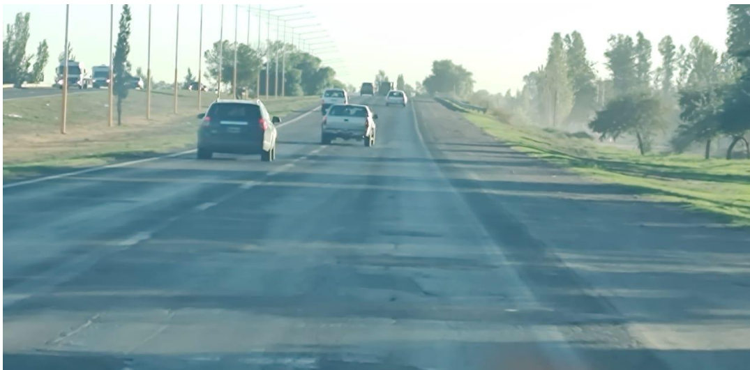
Fotografía 2. Muestra el estado de la calzada y las banquetas entre calle Azcuénaga y Calle Araoz.
