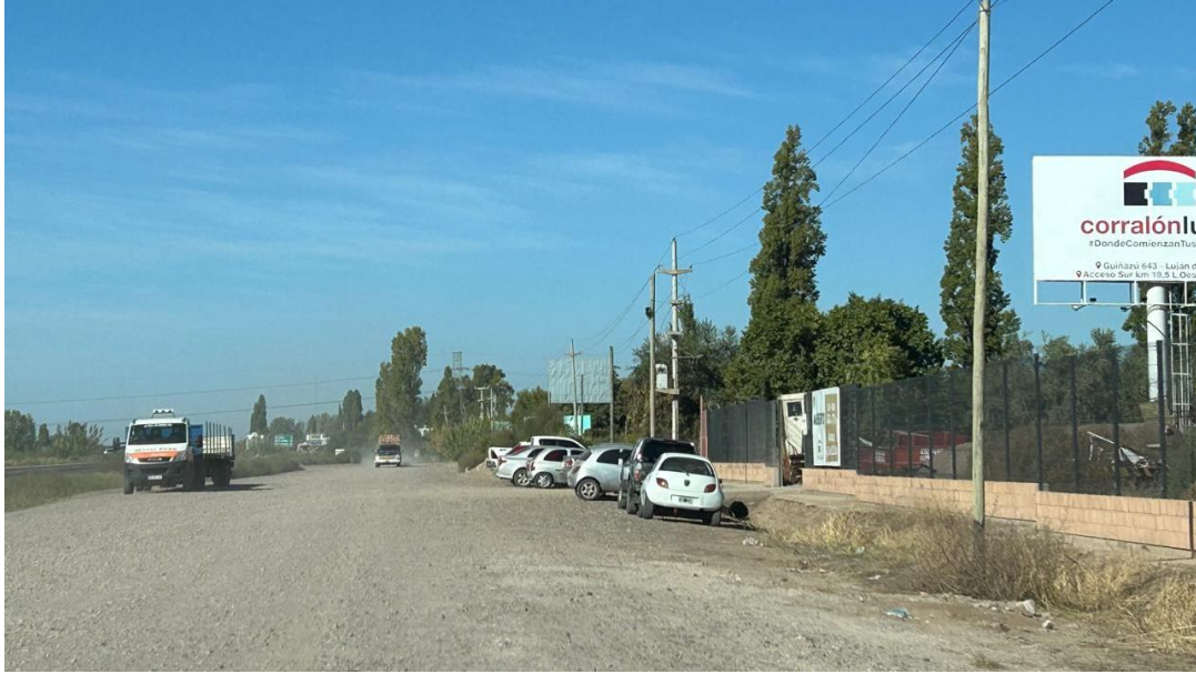
Fotografía 9: Muestra el estado de la calzada enripiada. Tramo Intersección Azcuénaga, Ruta 7, colectora Oeste.
