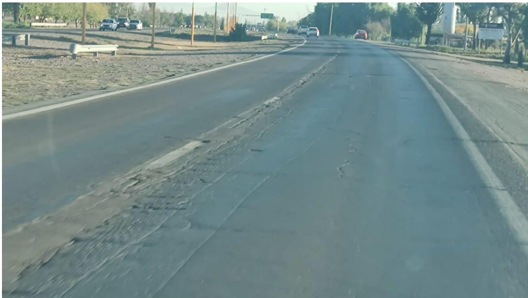
Fotografía 13. Muestra el estado de la calzada y las banquetas entre calle Azcuénaga y Calle Araoz.
