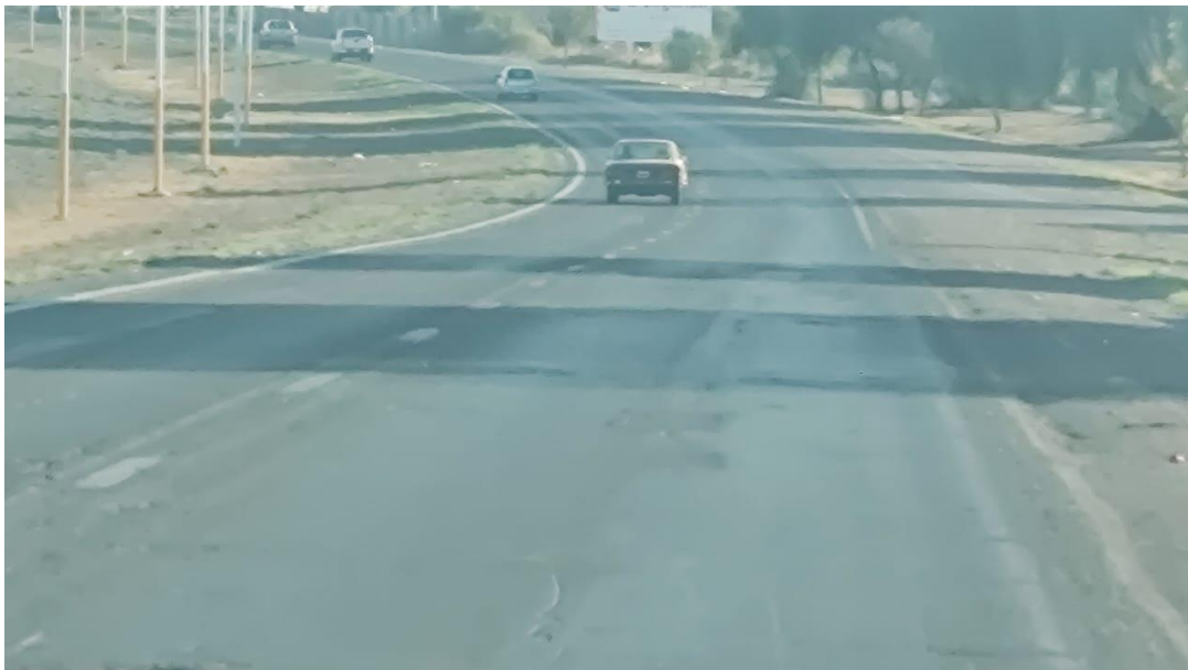
Fotografía 6. Muestra el estado de la calzada y las banquetas entre calle Azcuénaga y Calle Araoz.
