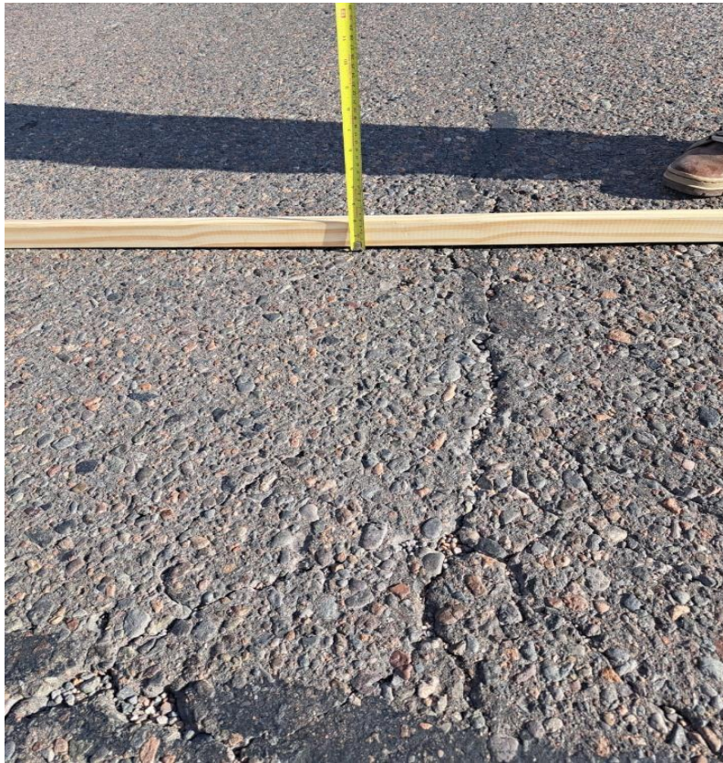
Fotografía 3. Muestra el ahuellamiento en kilómetro 555.
