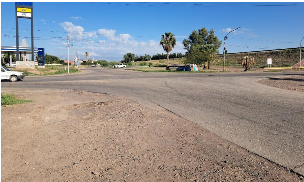
Fotografía 22. Cruce calle Los Alamos. Muestra el estado de la calzada y las banquetas entre calle Nicola Serpa y calle Laprida.
