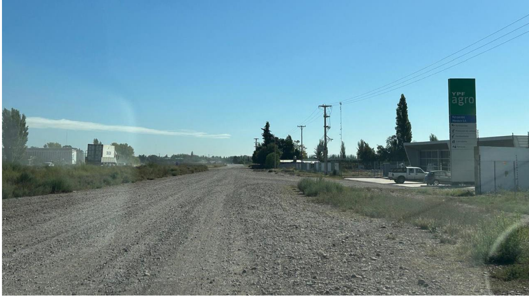
Fotografía17: Muestra el estado de la calzada enripiada. Tramo Intersección Azcuénaga, Ruta 7, colectora Este.
