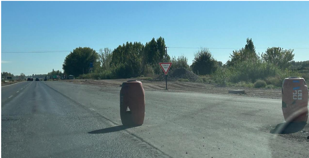
Fotografía 1: Muestra el estado de la calzada, rama de salida Ruta 7. Tramo Intersección Azcuénaga, Ruta 7, colectora Este.
