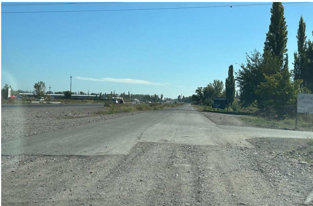
Fotografía 14: Muestra el estado de la calzada enripiada. Tramo Intersección Azcuénaga, Ruta 7, colectora Este.
