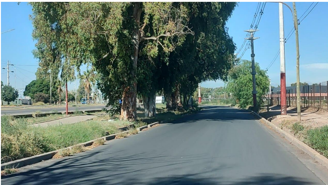
Figura 10. Vista del tipo y estado de la calzada entre calle Manuel A. Sáenz y Gral. Paz
