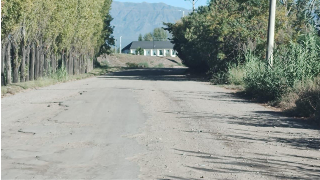
Fotografía 26. Muestra el estado de la calzada entre Calle Araoz y calle J.J. Paso.
