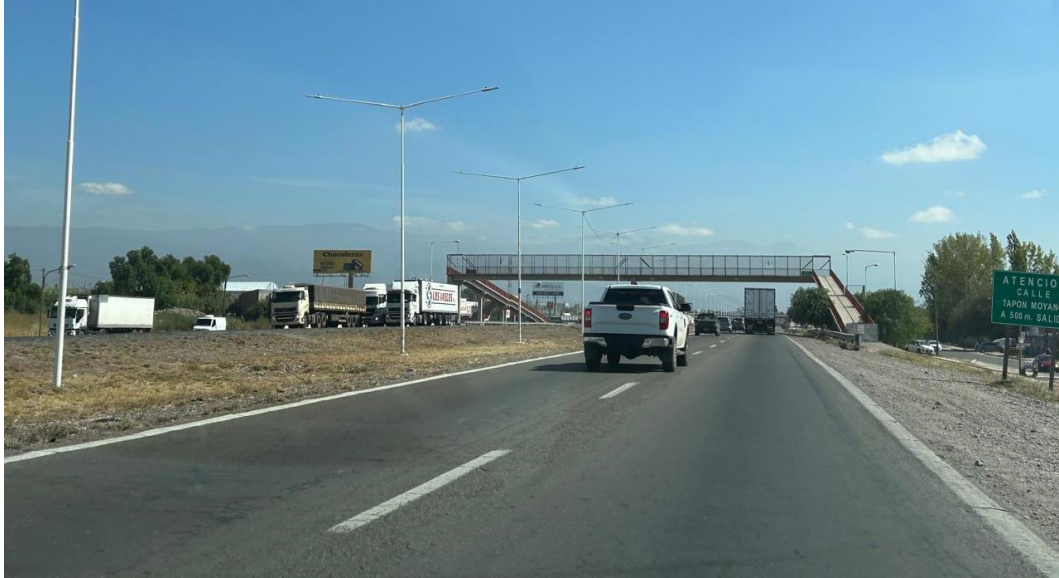
Fotografía 23. Muestra el estado de la calzada y las banquetas entre calle Los Álamos y Calle Tirasso.
