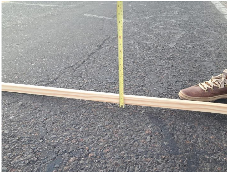
Fotografía 4. Vista del estado de la calzada y el ahuellamiento medido antes de Las Carretas.
