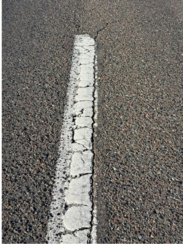
Fotografía 7. Muestra la fisura longitudinal en la zona entre la RN N° 7 y el Arrollo Carrizal.
