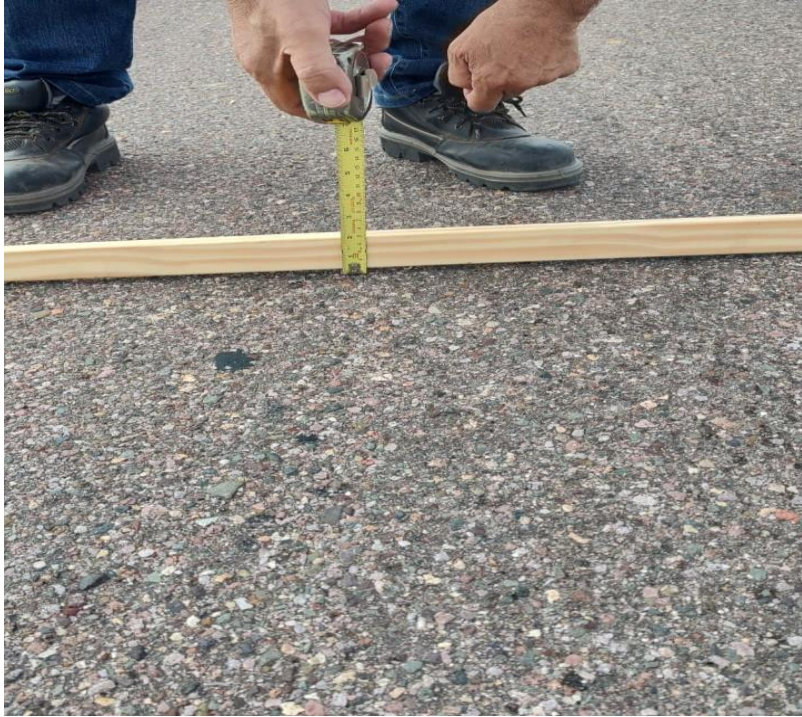
Fotografía 21. Muestra el ahuellamiento de la calzada antes del Arrollo El Chancho
