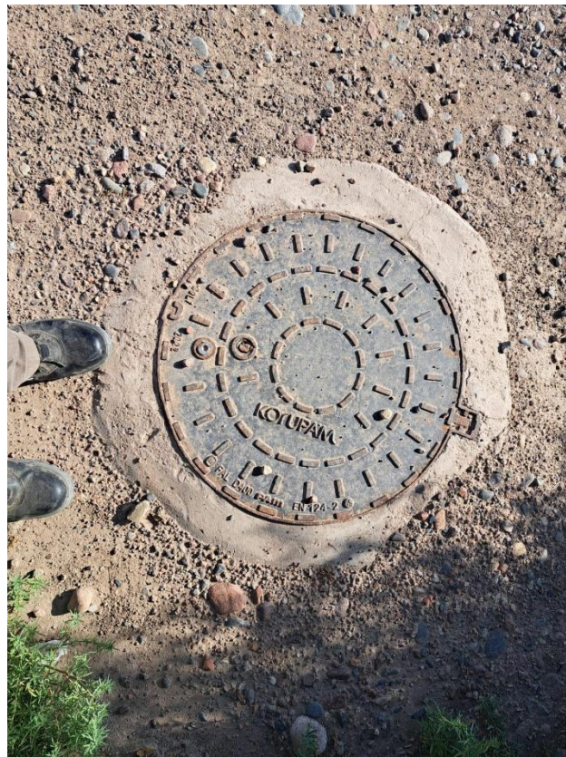
Fotografía 30. Cámara de cloaca en la calle colectora entre calle Nicola Serpa y calle Laprida.
