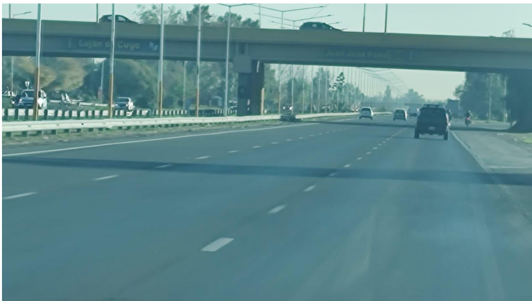
Fotografía 30. Muestra el estado de la calzada y las banquetas entre calle Arazo y J.J. Paso. Cruce con calle J.J. Paso Fin del tramo.
