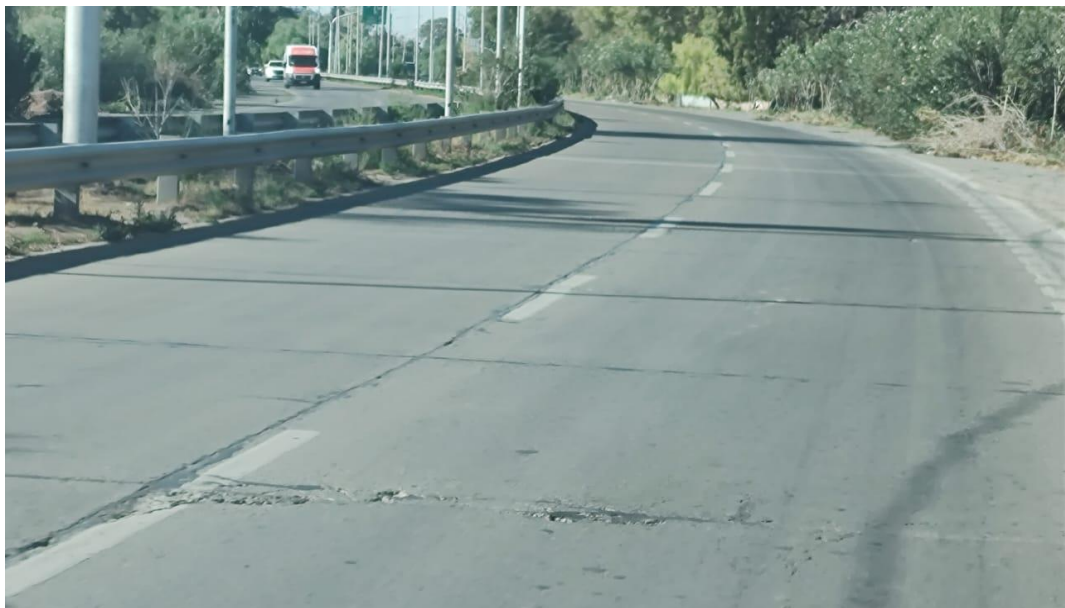
Fotografía 4. Calzada Principal – Descendente. Muestra el estado de la calzada y de las juntas en la zona próxima al cruce con calle Libertad.
