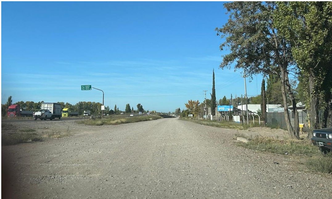
Fotografía 12: Muestra el estado de la calzada enripiada. Tramo Intersección Azcuénaga, Ruta 7, colectora Oeste.
