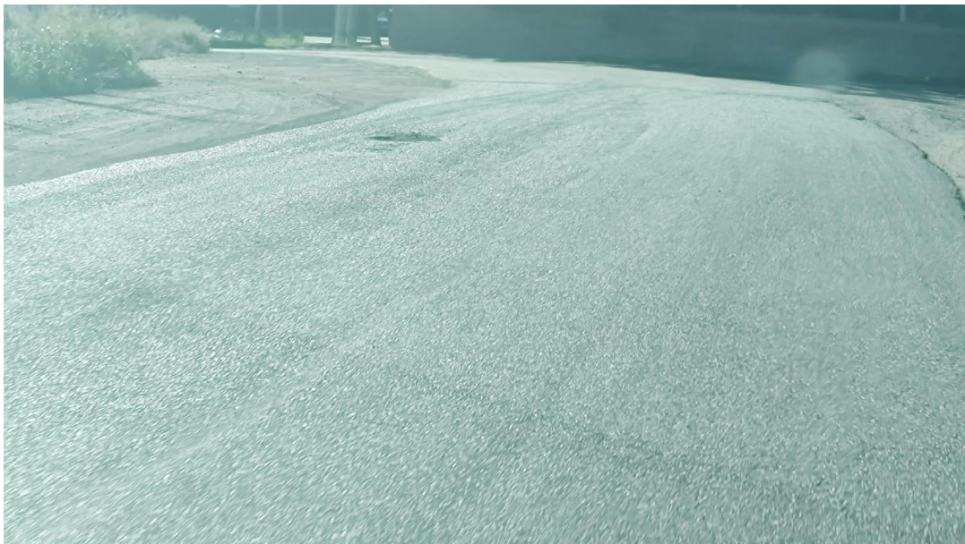
Fotografía 23. Muestra el estado de la calzada entre Calle Azcuénaga y Calle Araoz.
