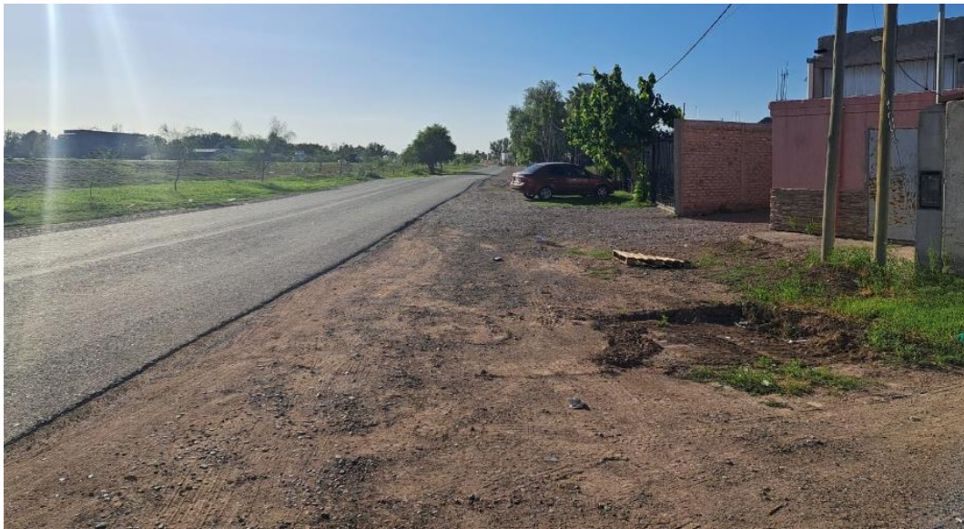
Fotografía 24. Muestra el estado de la calzada y las banquetas entre calle Nicola Serpa y calle Laprida.
