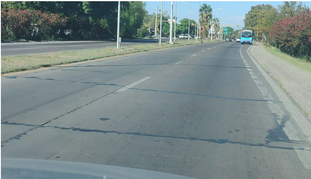
Fotografía 10. Calzada Principal – Descendente. Muestra el estado de las juntas en la zona próxima a la Rotonda del Avión.
