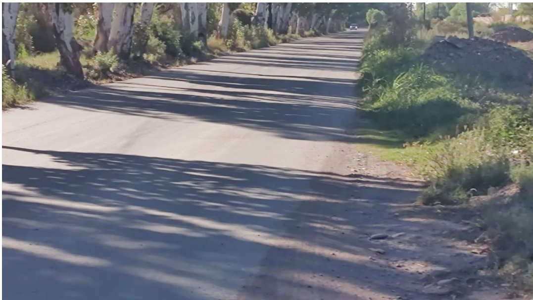
Fotografía 31. Muestra el estado de la calzada entre Calle Araoz y calle J.J. Paso.
