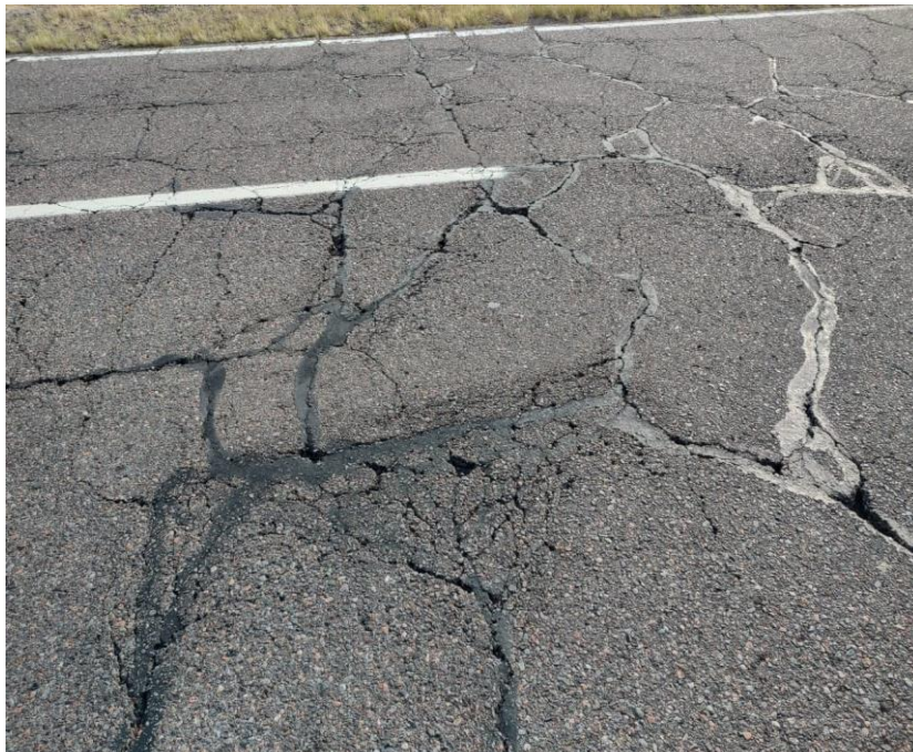
Fotografía 10. Muestra la fisuración de la calzada después de Las Carretas
