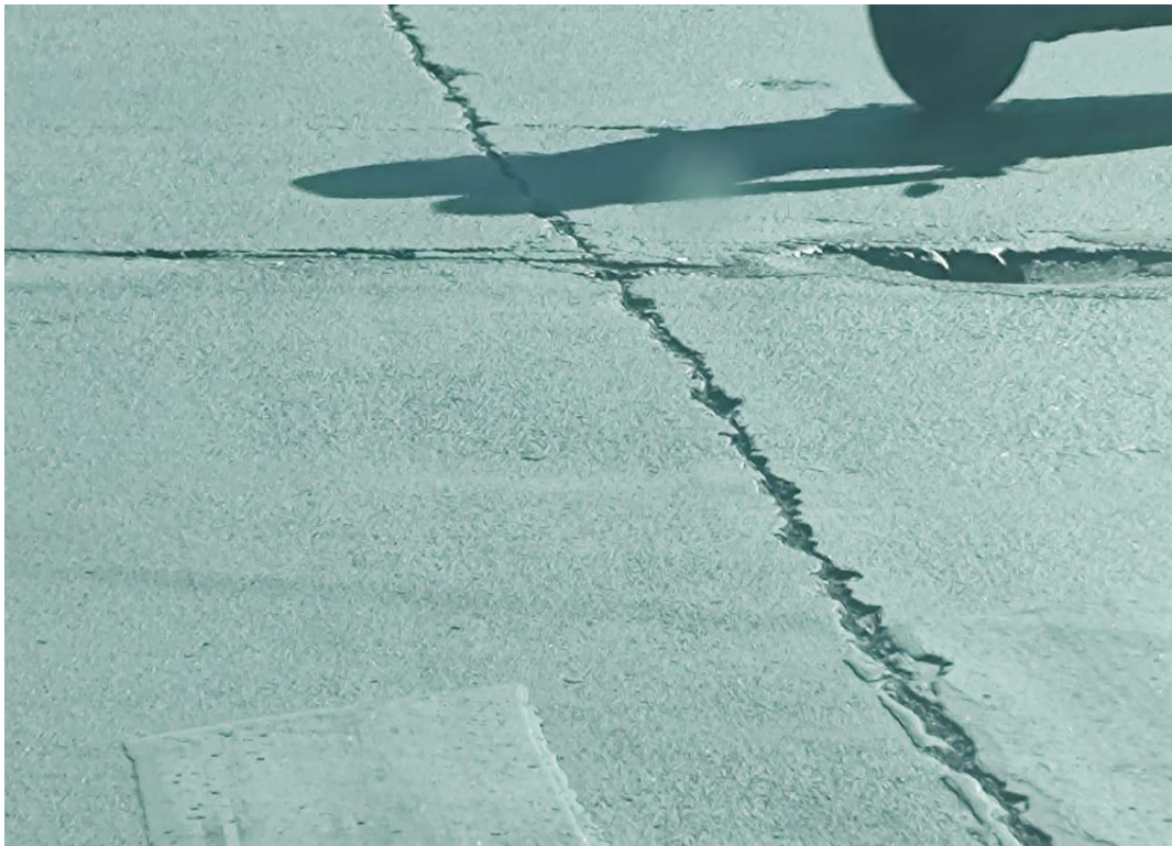
Fotografía 6. Calzada Principal Ascendente - Muestra el estado de las juntas en el cruce de Manuela A. Sáenz
