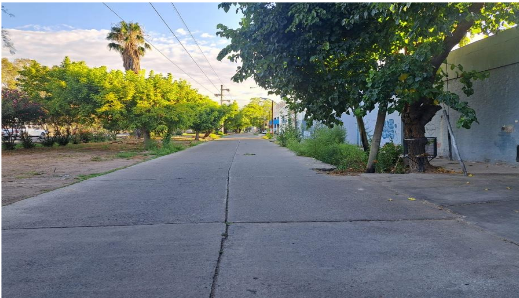
Fotografía 2. Vista del tipo y estado de la calzada entre la rotonda del Avión y calle Los Pescadores.
