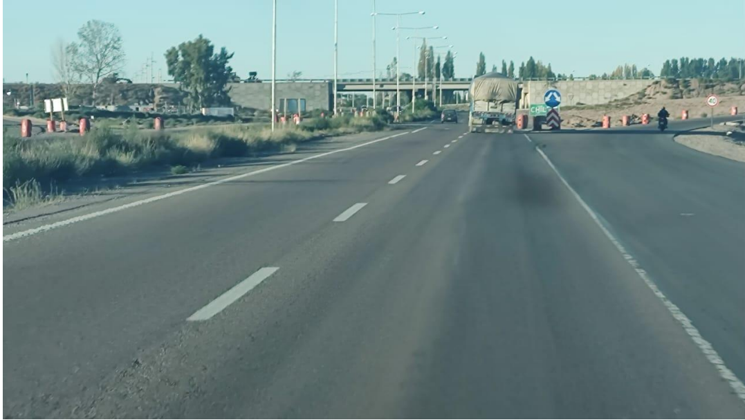
Fotografía 19: Muestra el estado de la calzada, rama de subida a Ruta 7 y banquetas. Tramo Intersección Azcuénaga, Ruta 7
