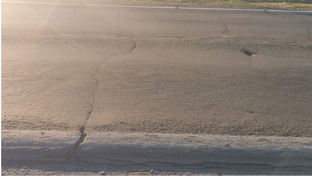
Fotografía 7. Muestra el estado de la calzada entre J.J. Paso y calle Araoz.
