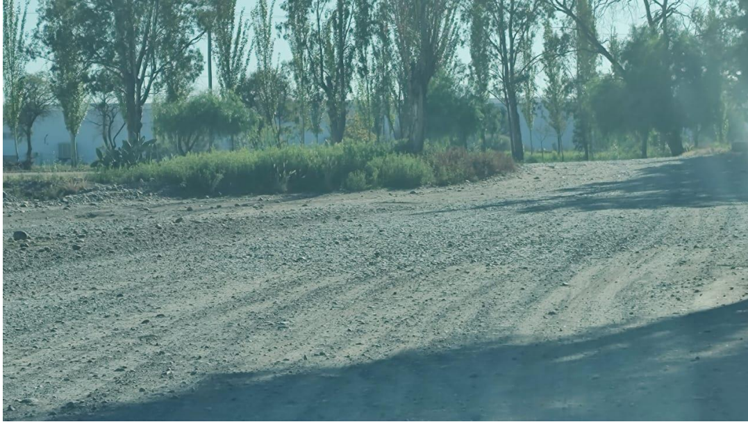
Fotografía 19. Muestra el estado de la calzada entre Calle Azcuénaga y Calle Araoz.
