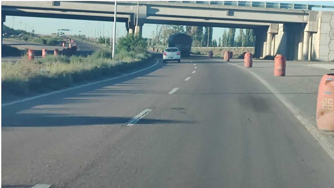
Fotografía 1: Muestra el estado de la calzada comienzo del tramo Intersección
