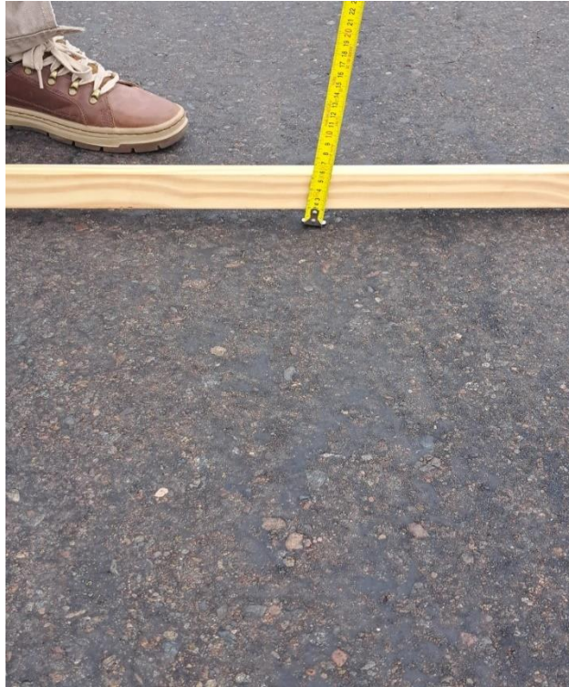
Fotografía 12. Muestra el ahuellamiento entre calle R.P. 50 y calle Lamadrid.
