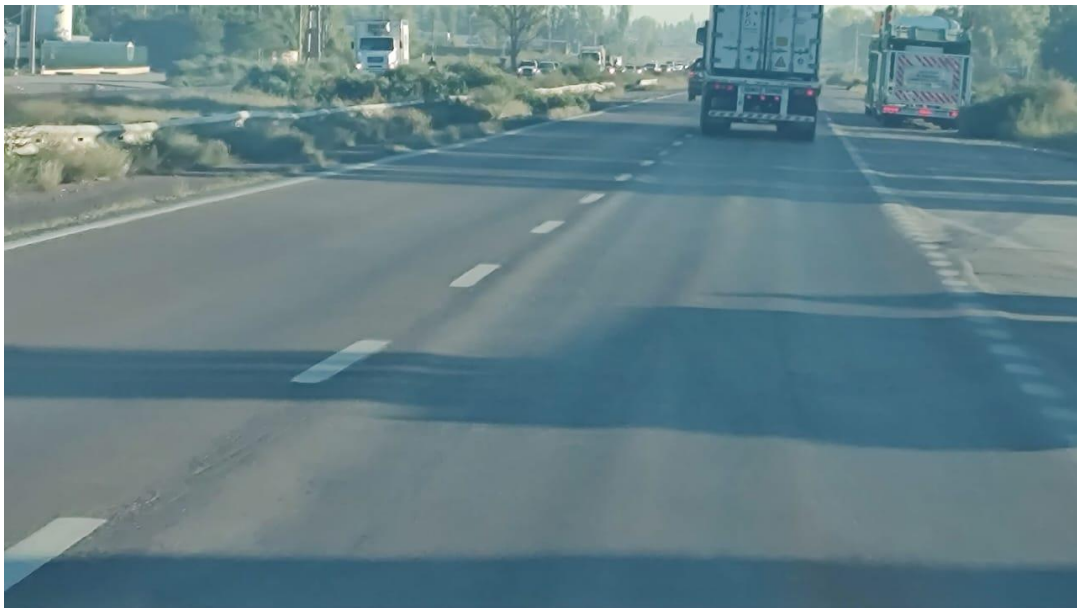
Fotografía 6: Muestra el estado de la calzada y banquetas. Tramo Ruta 7, Azcuénaga.
