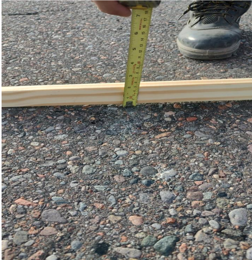
Fotografía 9. Muestra el ahuellamiento de la calzada después de Las Carretas
