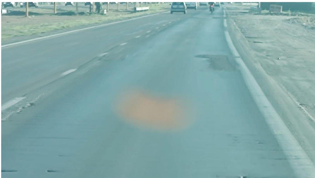
Fotografía 26. Muestra el estado de la calzada y las banquetas entre calle Araoz y J.J. Paso.
