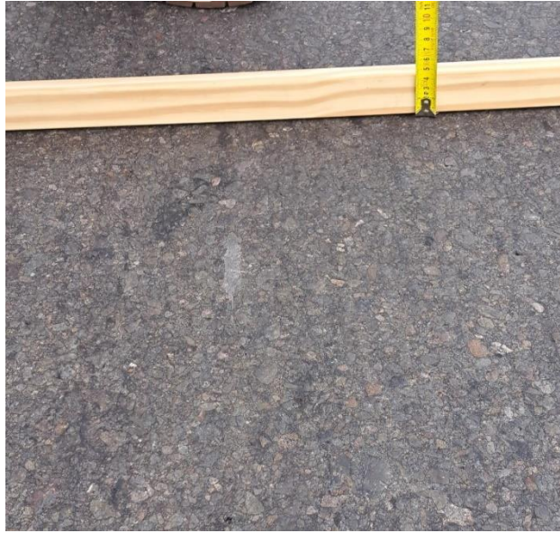
Fotografía 9. Muestra el ahuellamiento entre calle Tirasso y R. P. 50
