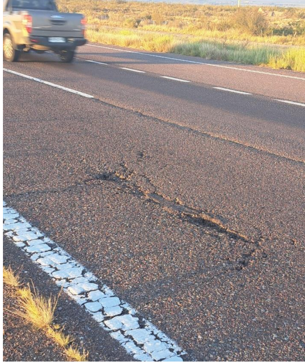
Fotografía 3. Muestra la fisuración en la zona entre la RN N° 7 y el Arrollo Carrizal.
