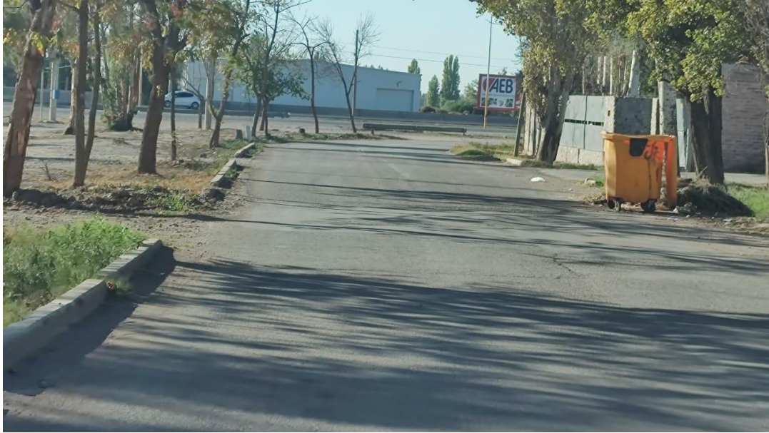
Fotografía 41. RN N 40 – J.J. Paso-Azcuénaga- Colectora Oeste (Descendente)
