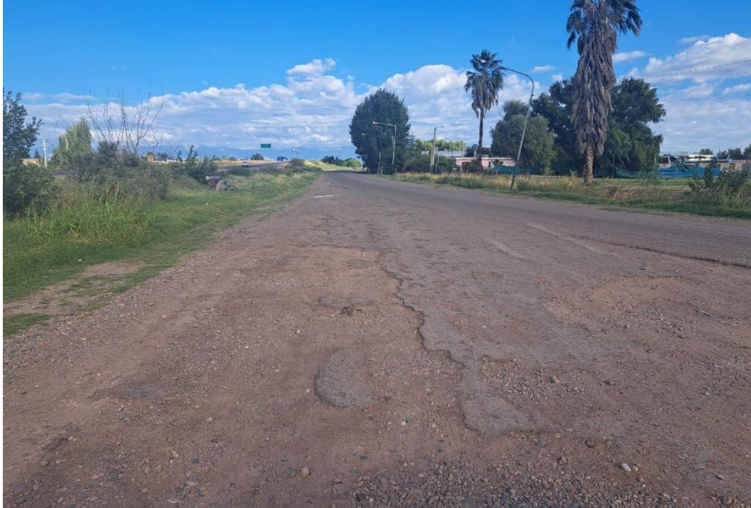
Fotografía 21. Muestra el estado de la calzada y las banquetas entre calle Nicola Serpa y calle Lamadrid.
