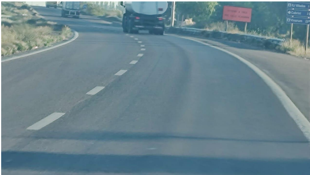
Fotografía 14: Muestra el estado de la calzada y banquetas. Tramo Intersección Ruta 7 y Azcuénaga.
