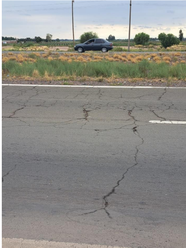
Fotografía 14. Muestra el estado de la calzada entre R.P. 50 y calle Lamadrid.
