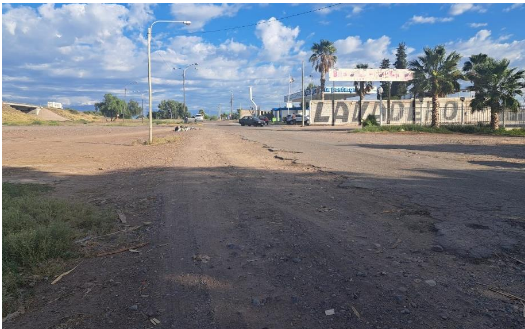
Fotografía 16. Muestra el estado de la calzada y las banquetas entre calle Nicola Serpa y calle Lamadrid.
