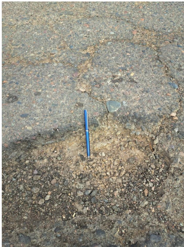
Fotografía 12: Muestra el estado de la calzada pavimentada. Tramo Intersección Azcuénaga, Ruta 7, colectora Este.
