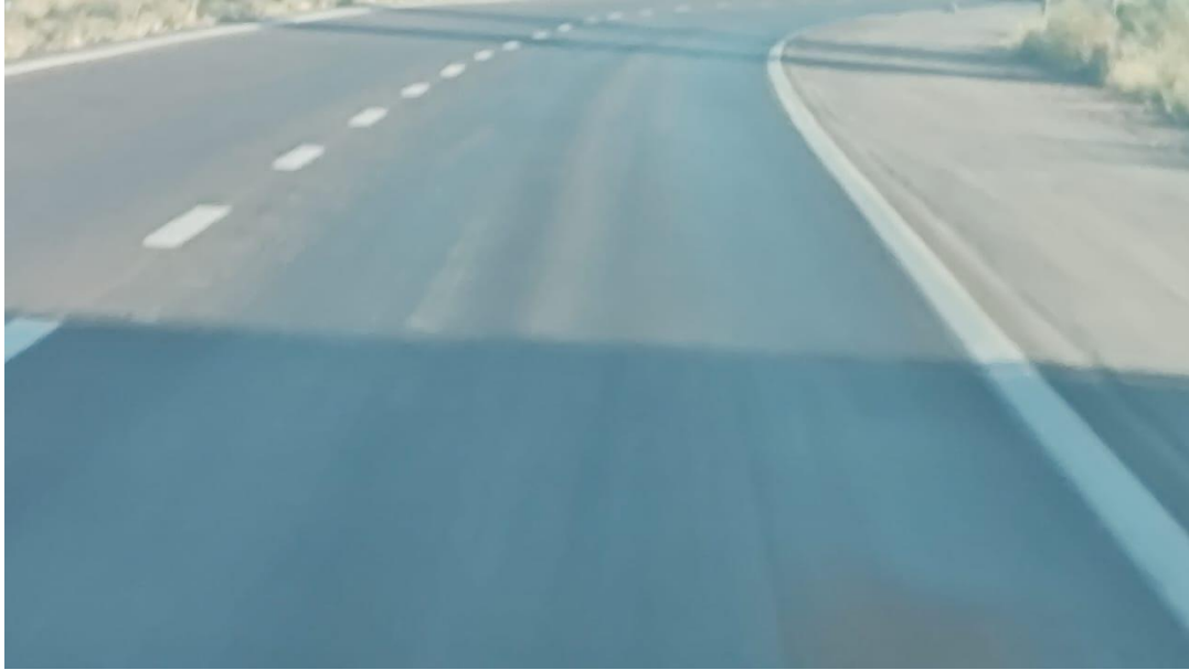
Fotografía 19: Muestra el estado de la calzada y banquetas. Tramo Intersección Ruta 7 y Azcuénaga.
