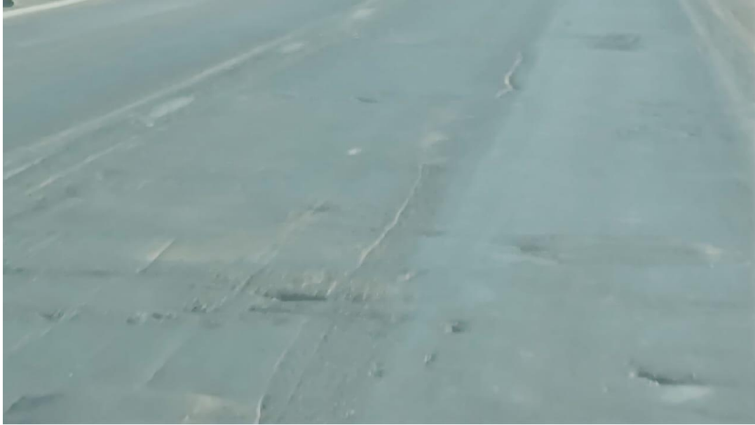
Fotografía 5. Muestra el estado de la calzada y las banquetas entre calle Azcuénaga y Calle Araoz.
