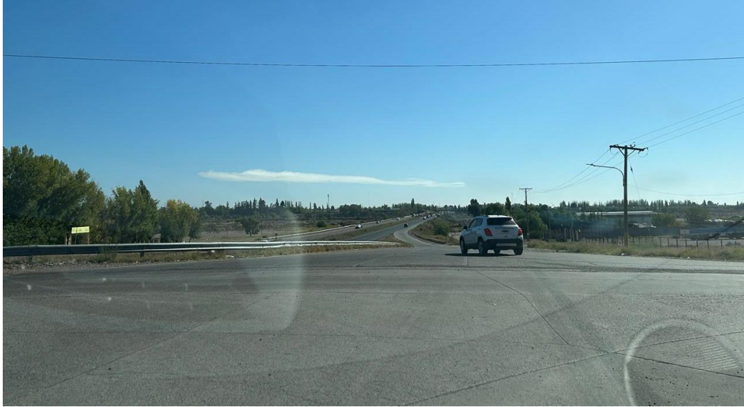
Fotografía19: Muestra el estado de la calzada enripiada. Rama entrada Ruta 40 Tramo Intersección Azcuénaga, Ruta 7, colectora Este.
