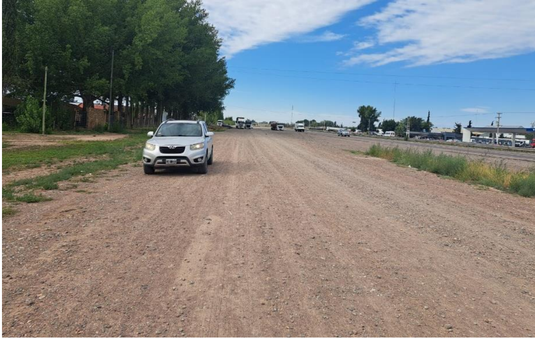
Fotografía 9: Muestra el estado de la calzada enripiada. Tramo Intersección Azcuénaga, Ruta 7, colectora Este.
