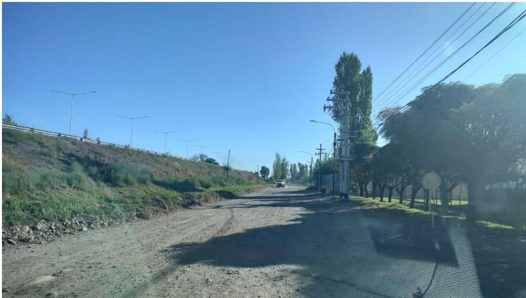
Fotografía 8. Muestra el estado de la calzada entre Calle Azcuénaga y Calle Araoz.
