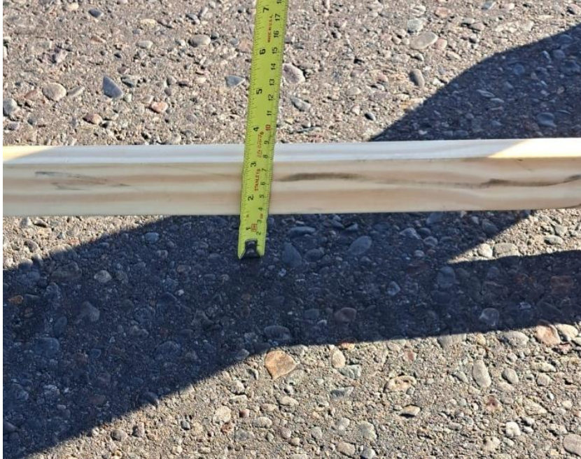
Fotografía 1. Muestra el ahuellamiento en la zona de la Rotonda de La Tonada.
