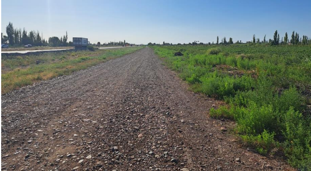
Fotografía 27. Muestra el estado de la calzada y las banquetas entre calle Nicola Serpa y calle Laprida.
