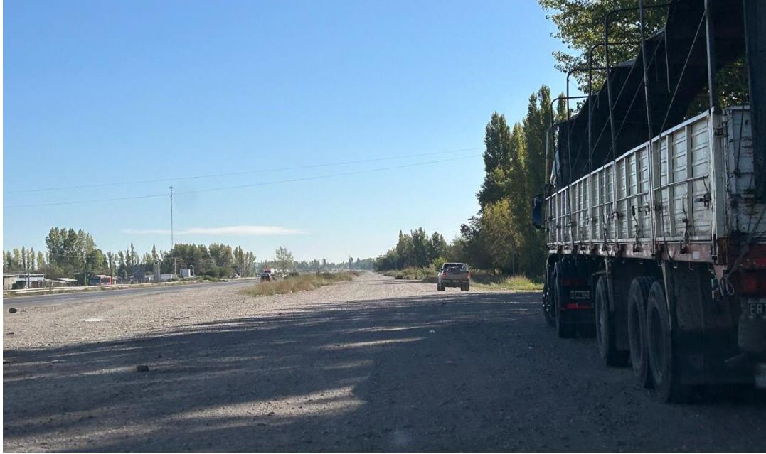
Fotografía 7: Muestra el estado de la calzada, rama de salida Estacio de Servicio. Tramo Intersección Azcuénaga, Ruta 7, colectora Este.
