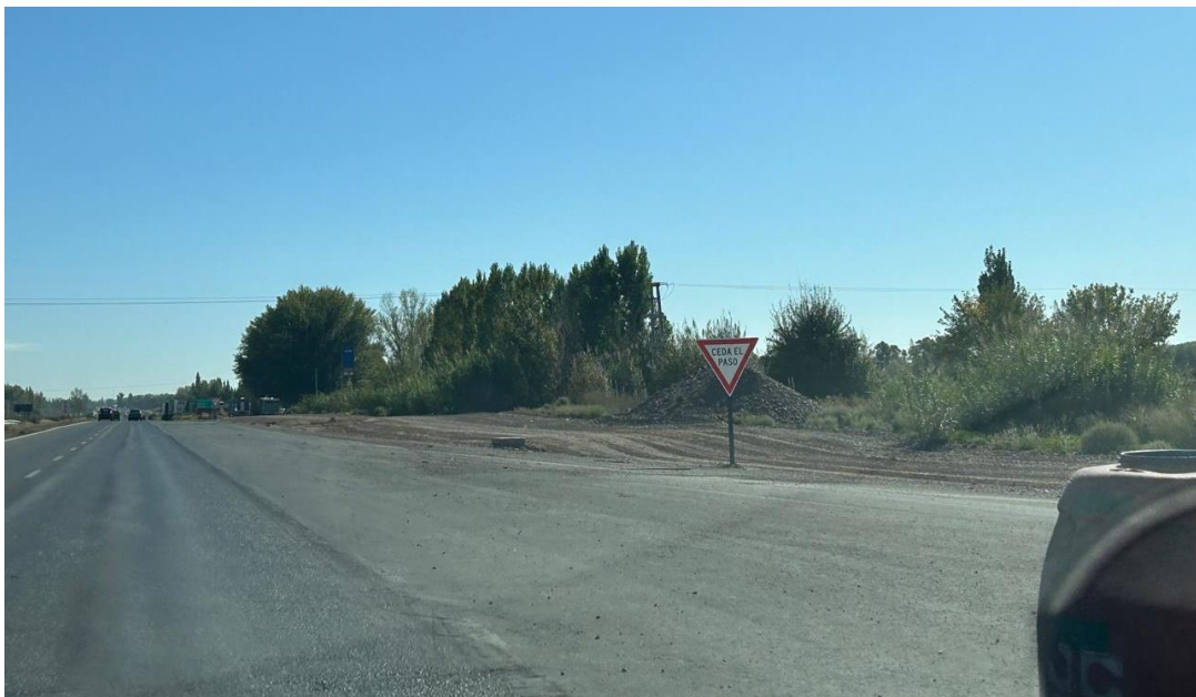
Fotografía 2: Muestra el estado de la calzada enripiada, rama de salida Ruta 7. Tramo Intersección Azcuénaga, Ruta 7, colectora Este
