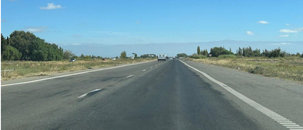
Fotografía 7. Muestra el estado de la calzada y las banquetas entre calle San Pedro y calle Medina.
