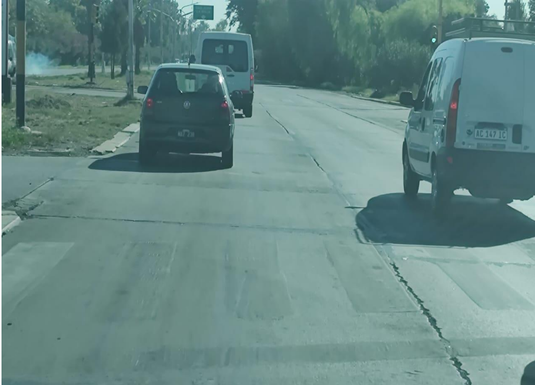
Fotografía 5 - Calzada Principal – Ascendente. Muestra el estado de la junta longitudinal y las reparaciones recientes a la calzada en el cruce con Manuel A, Sáenz
