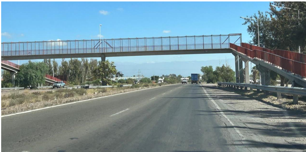
Fotografía 18. Muestra el estado de la calzada y las banquetas entre calle Los Álamos y Calle Tirasso.
