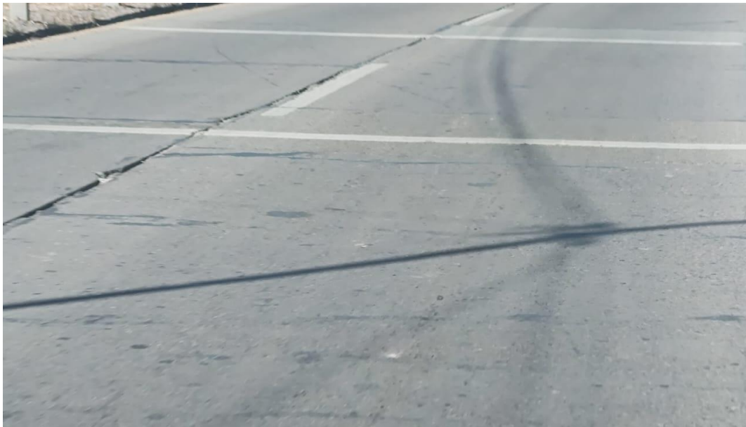
Fotografía 6. Calzada Principal – Descendente. Muestra el estado de las juntas en la zona próxima al cruce con la calle Independencia.
