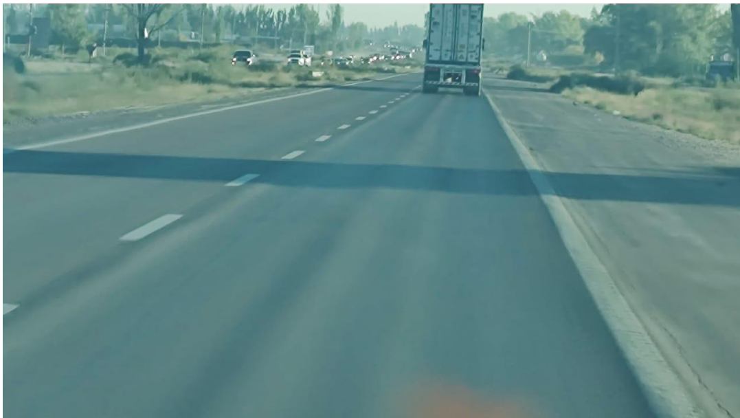
Fotografía 10: Muestra el estado de la calzada. Tramo Intersección Ruta 7 y Azcuénaga.
