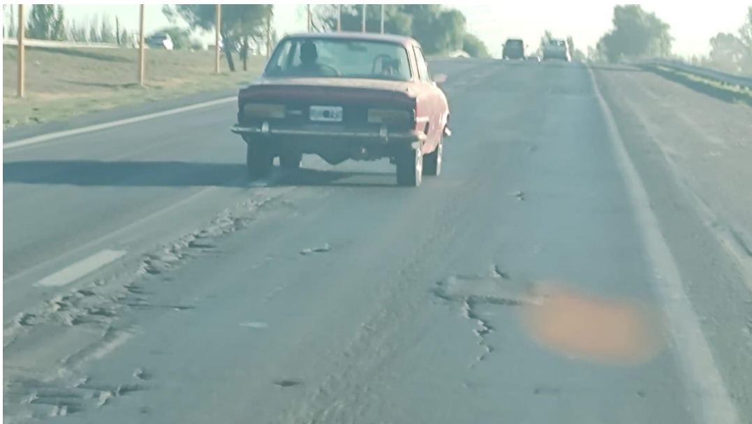
Fotografía 4. Muestra el estado de la calzada y las banquetas entre calle Azcuénaga y Calle Araoz. Cruce calle Anchorena.
