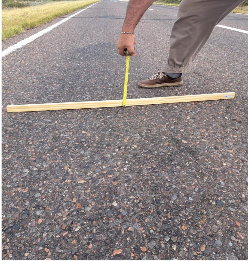
Fotografía 15. Muestra el ahuellamiento en kilómetro 625.
