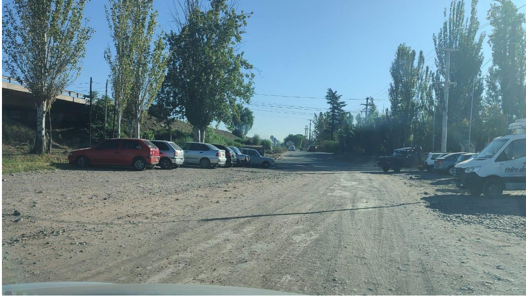
Fotografía 9. Muestra el estado de la calzada entre Calle Azcuénaga y Calle Araoz.
