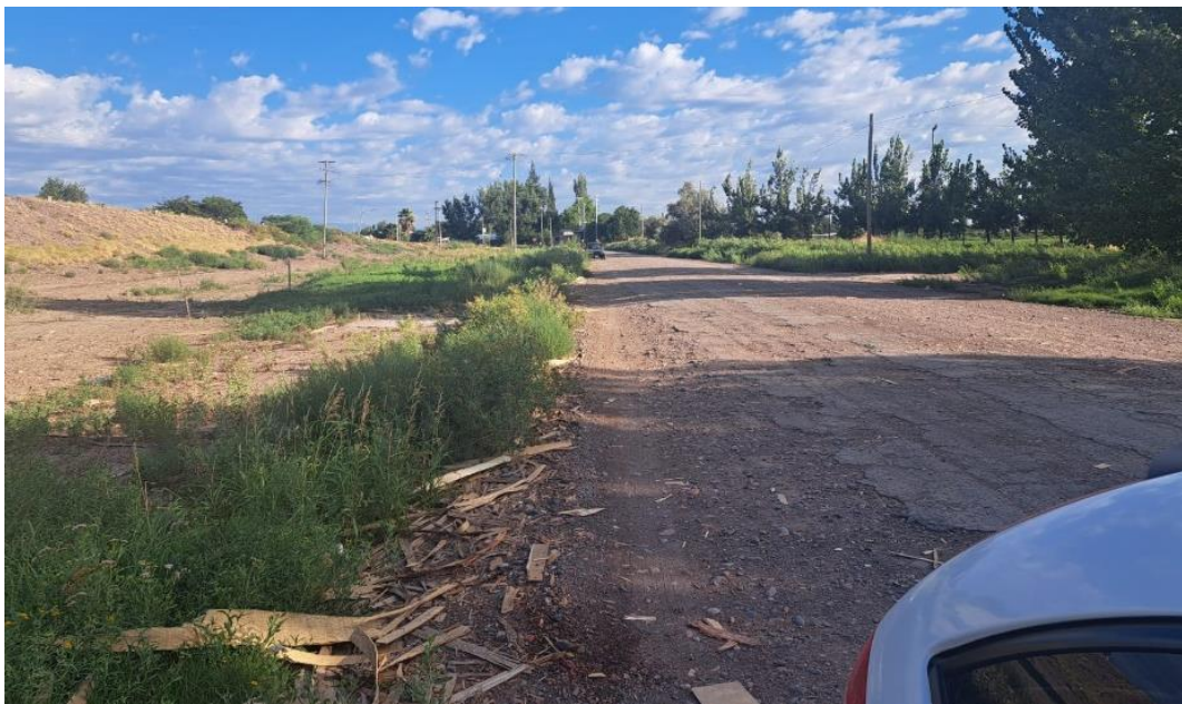
Fotografía 20. Muestra el estado de la calzada y las banquetas entre calle Nicola Serpa y calle Lamadrid.
