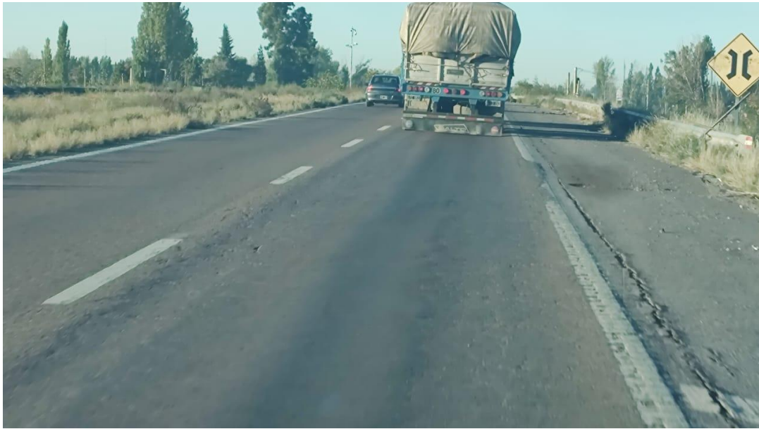
Fotografía 15: Muestra el estado de la calzada, fisuras ahuellamientos y banquetas. Tramo Intersección Azcuénaga, Ruta 7
