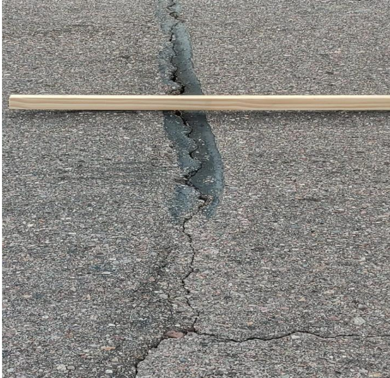
Fotografía 19. Muestra la fisuración y escalonamiento de la calzada después del Arrollo Silva.
