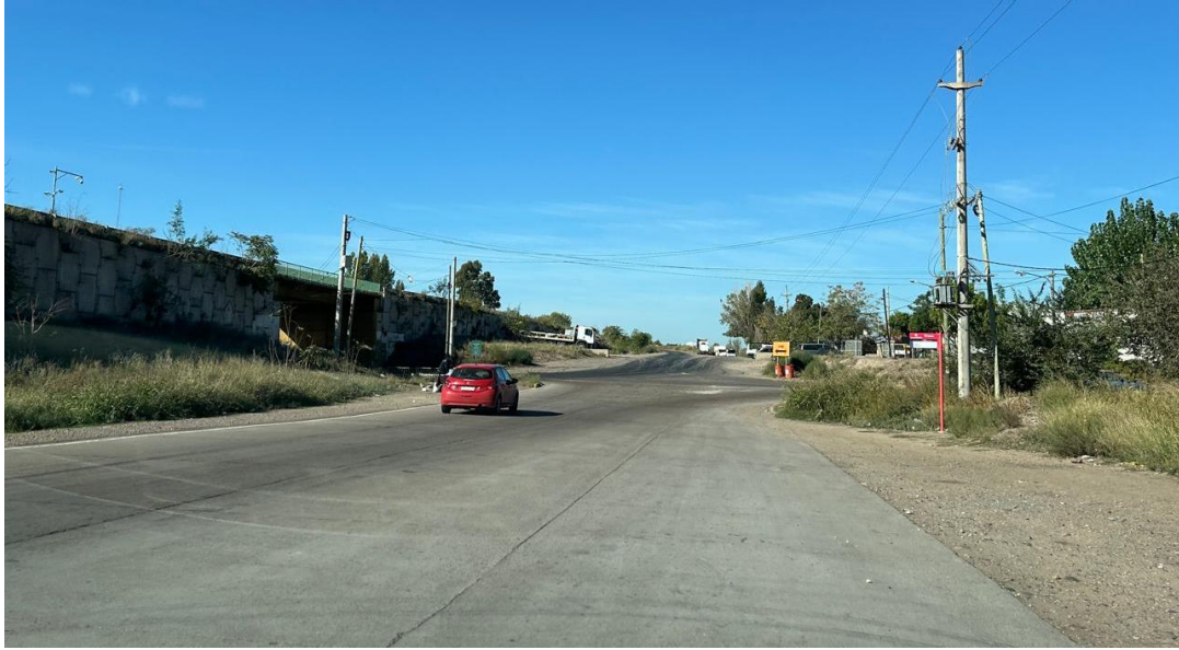
Fotografía13: Muestra el estado de la calzada Rama acceso intersección Olavarria. Tramo Intersección Azcuénaga, Ruta 7, colectora Oeste.
