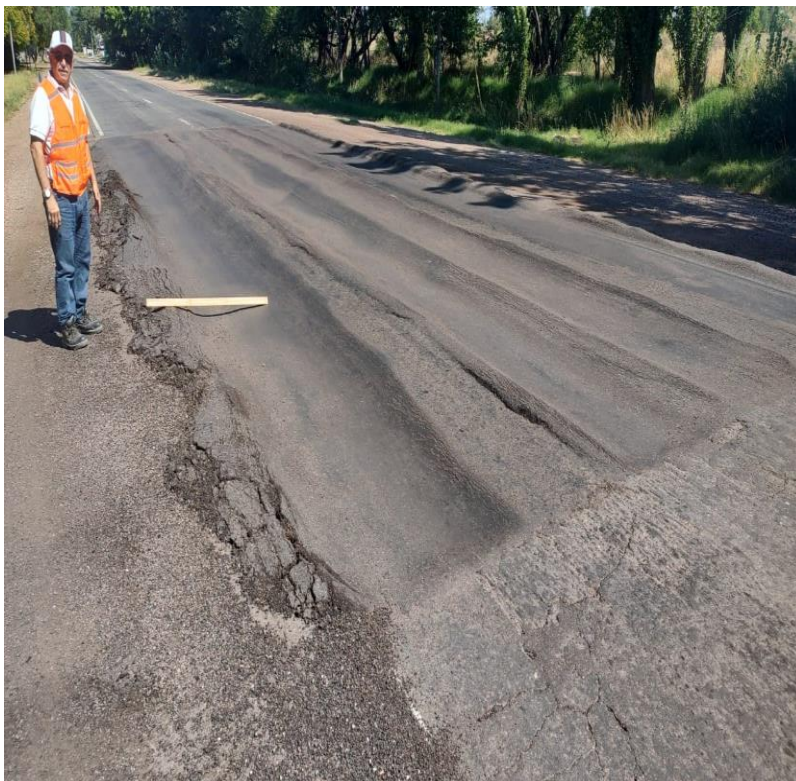
Fotografía 38. Otra vista de la gran deformación de la calzada entre Las Paredes y el canal El Toledano.
