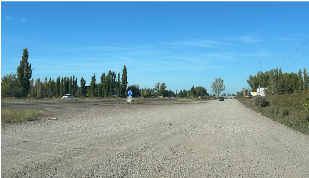
Fotografía 16: Muestra el estado de la calzada enripiada. Tramo Intersección Azcuénaga, Ruta 7, colectora Oeste.
