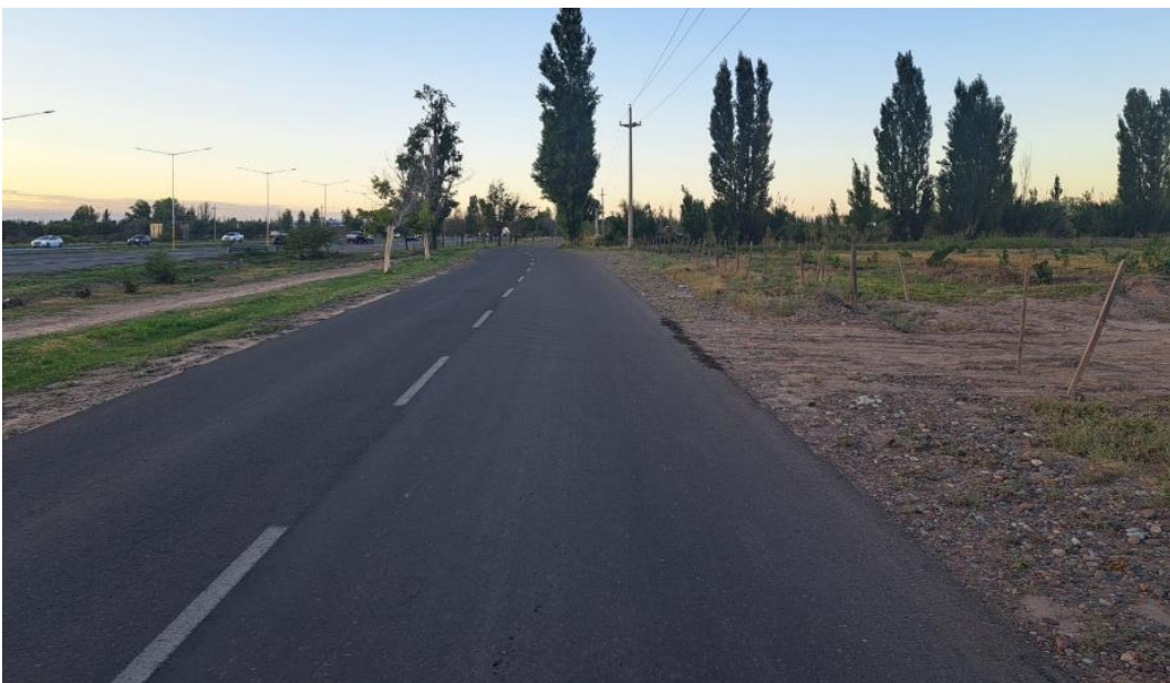
Fotografía 4. Muestra el estado de la calzada y las banquetas entre calle Tirasso y calle Nicola Serpa.
