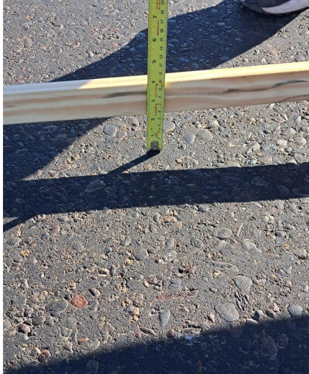
Fotografía5. Muestra el ahuellamiento en la zona de Zapata.
