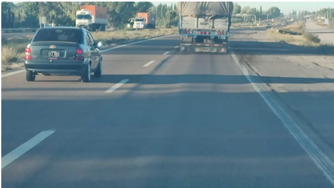
Fotografía 14: Muestra el estado de la calzada y banquetas. Tramo Intersección Azcuénaga, Ruta 7
