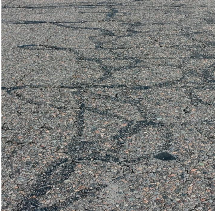
Fotografía 15. Otra vista de la fisuración de la calzada antes del Arrollo La Tosca
