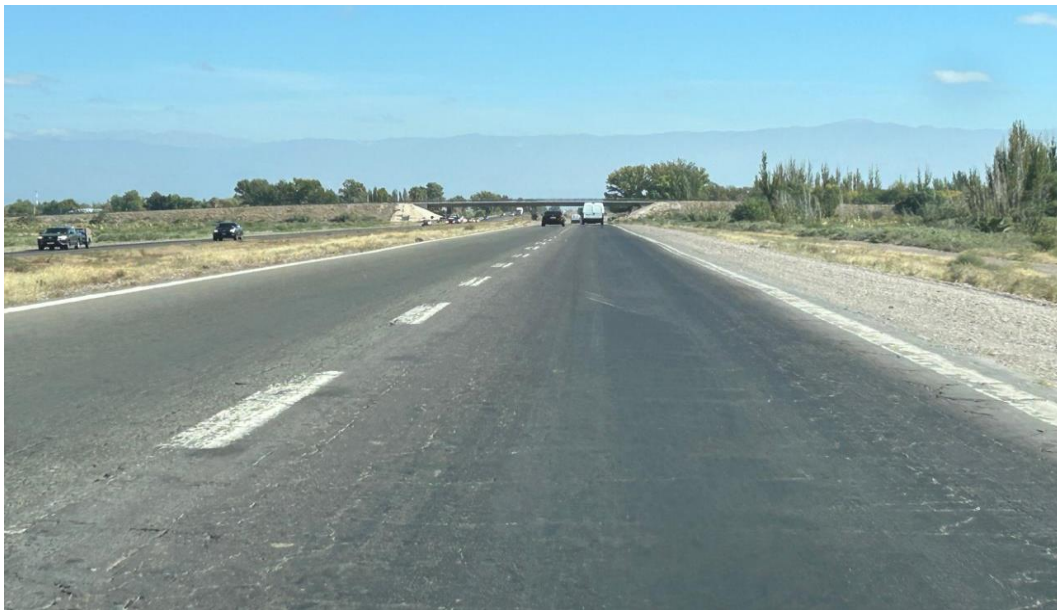
Fotografía 10. Muestra el estado de la calzada y las banquetas entre calle San Pedro y calle Medina.
