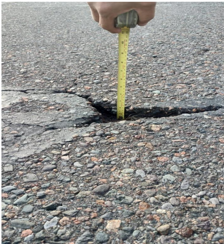
Fotografía 12. Muestra desprendimiento y bacheo de la calzada antes del Arrollo Las Peñas
