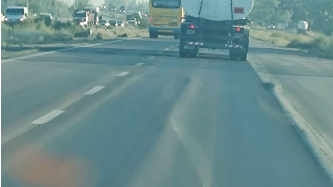
Fotografía 13: Muestra el estado de la calzada y banquetas. Tramo Intersección Ruta 7 y Azcuénaga.
