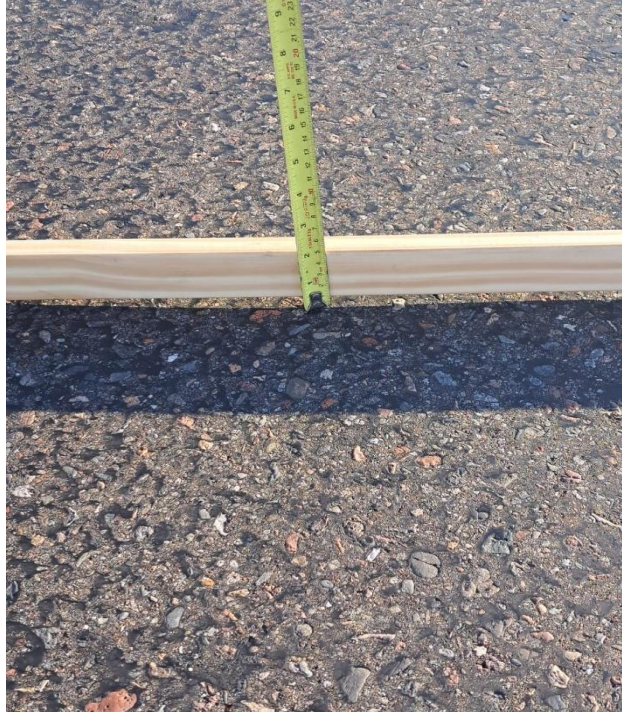
Fotografía 11. Muestra el ahuellamiento en la zona entre la RN N° 7 y el Arrollo Carrizal.
