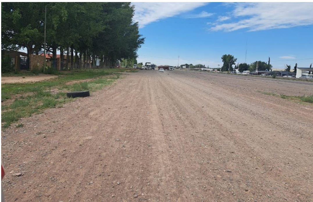
Fotografía 8: Muestra el estado de la calzada enripiada. Tramo Intersección Azcuénaga, Ruta 7, colectora Este.
