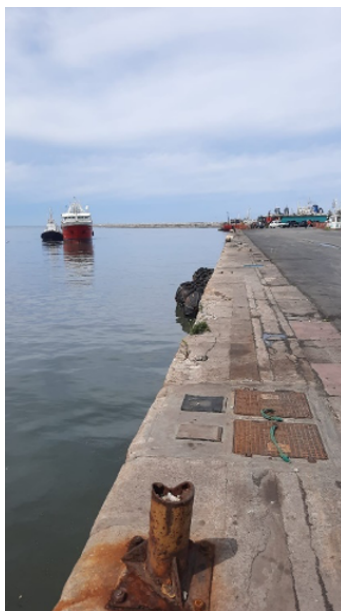
Figura 25: Distintas vistas del estado de conservación de los muelles.
