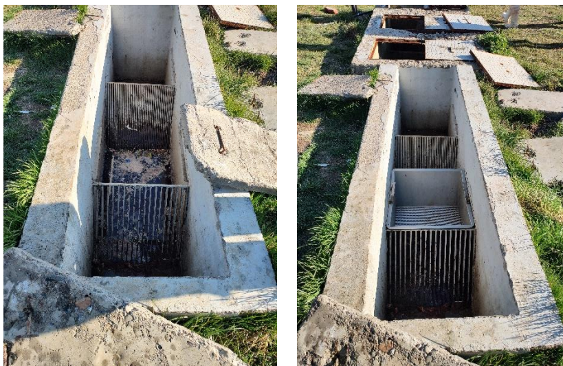
Figura 15: Fotografías 11.09.24. Rejas de desbaste línea de rojos.
