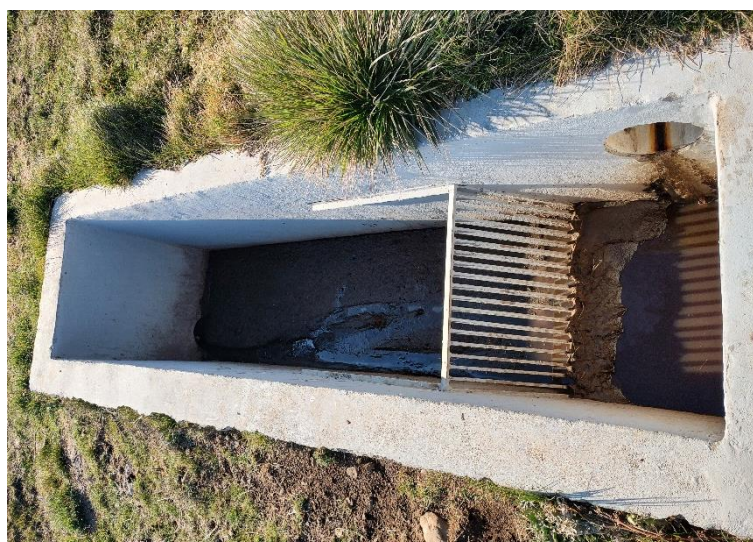
Figura 12: Fotografía de cámara de rejás línea de verdes. Detalle de rejás y zona de desarenador.
