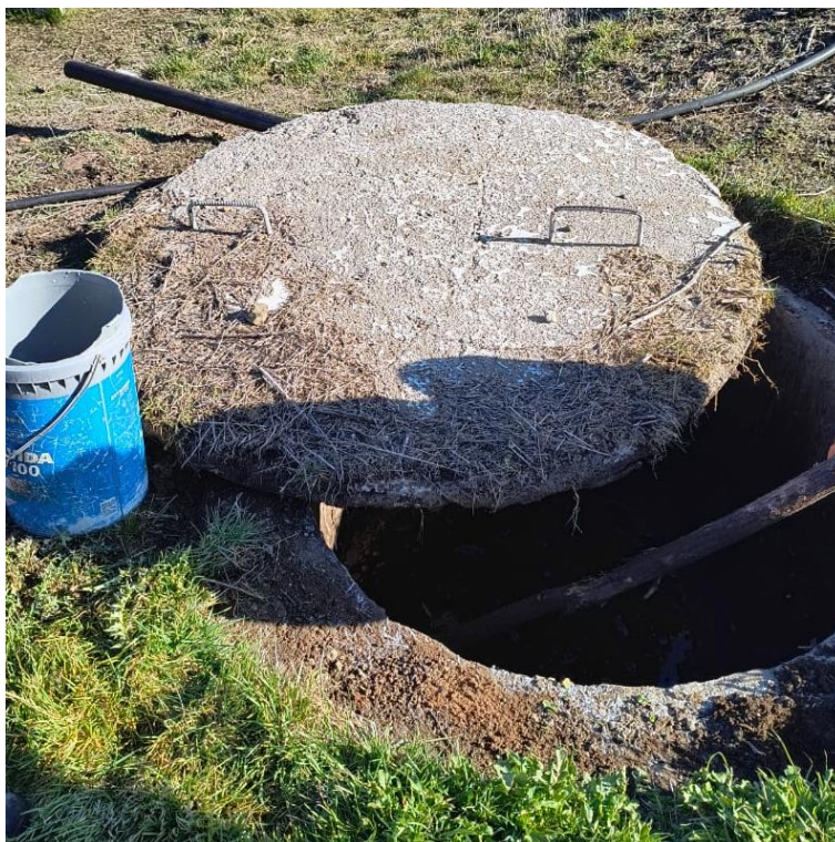
Figura 19: Fotografías 22/12/2022: Pozo de Bombeo
