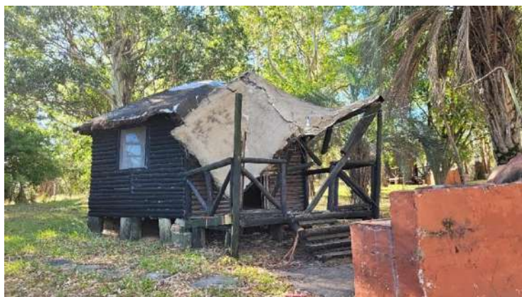
Refugio con techo caído
