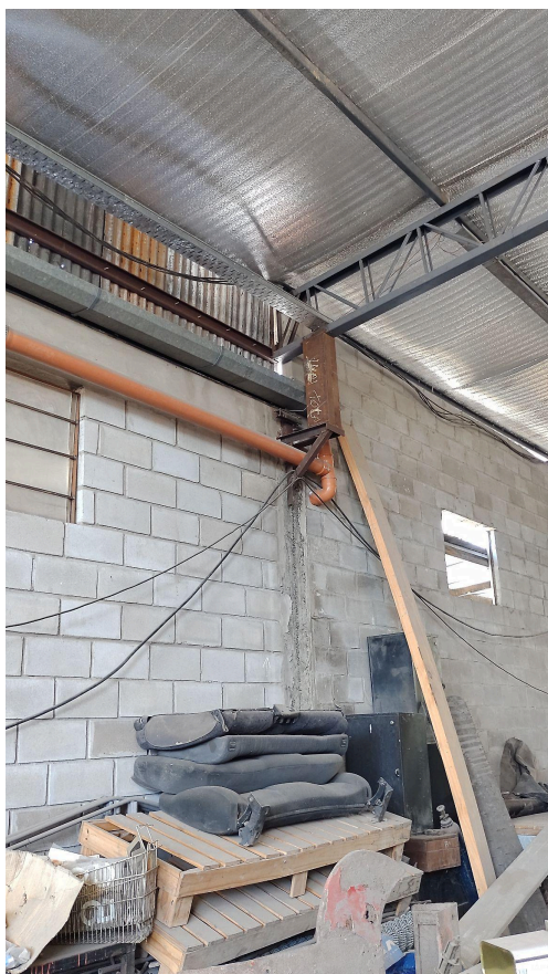
Apoyo deficiente antes.
