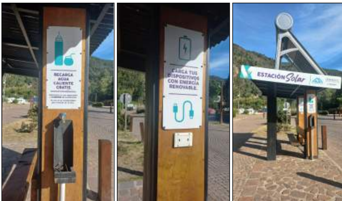
Figura 75. Zona de recarga de agua caliente y recarga de celular con energía solar Fuente: Elaboración propia
