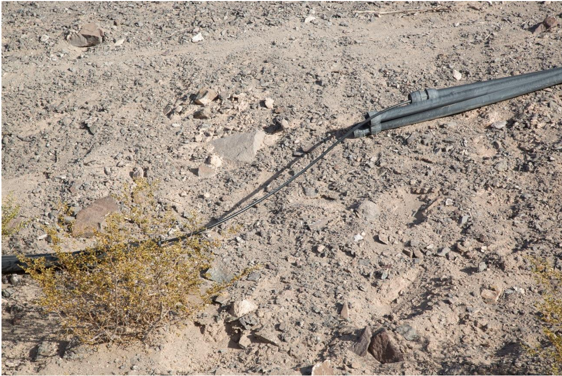
Fotografía 14 – Progresiva 21+400 – Vista de la rotura del cable de la Fibra óptica
