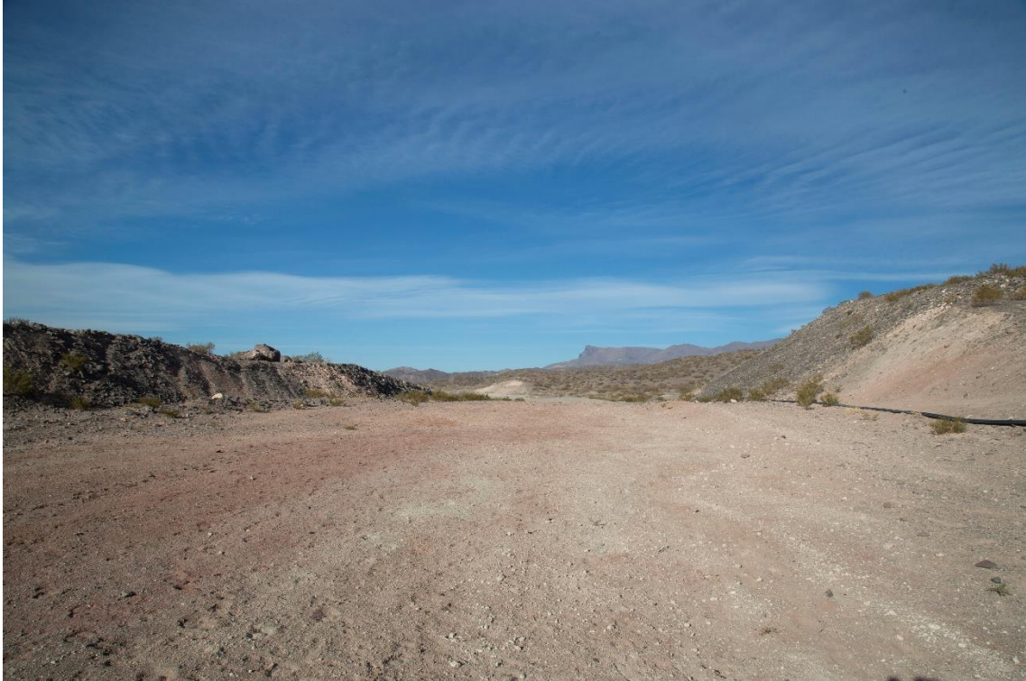
Fotografía 15 – Progresiva 21+400 – otra vista del terraplén sur. Obra paralizada
