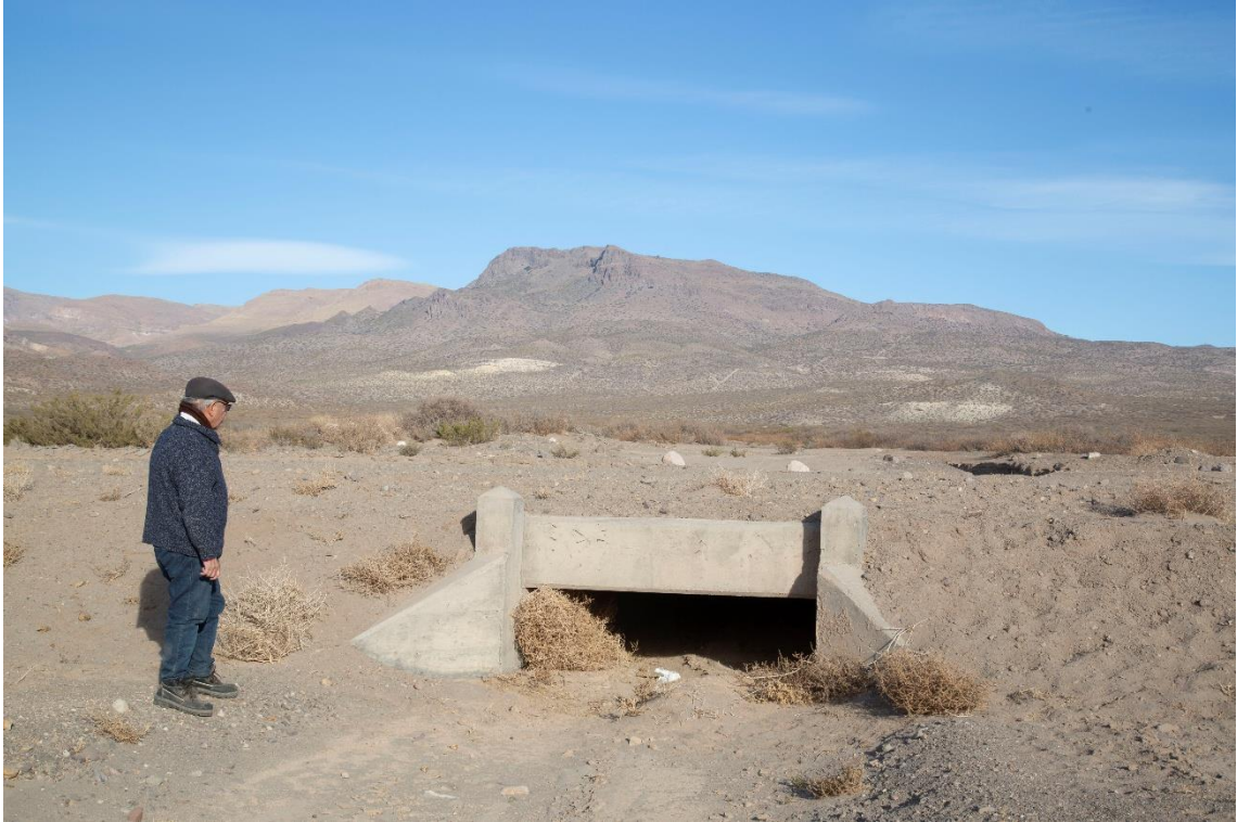
Fotografía 9 – Progresiva 19+000 – Otra vista de alcantarilla en la variante prevista. Obra paralizada.
