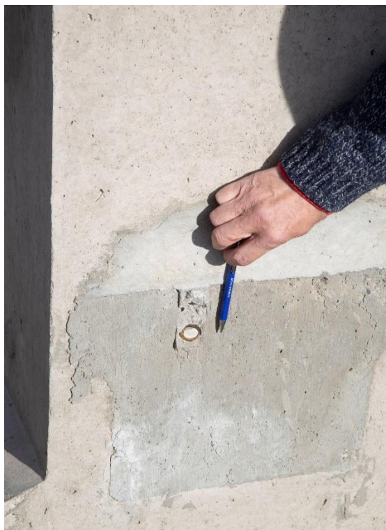
Fotografía 22 – Progresiva 24+000 – Detalle del cable de tensado de las vigas construida para el puente sobre el canal de riego. Obra paralizada
