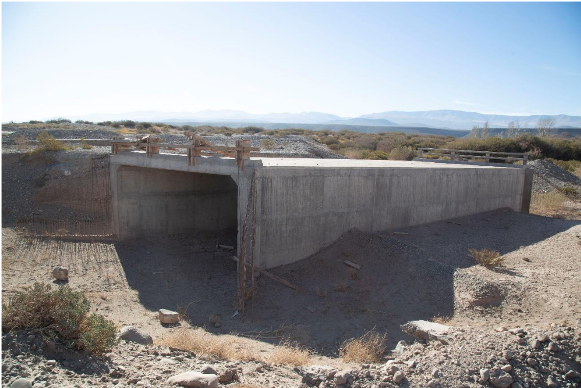
Fotografía 32 – Progresiva 39+000 – Otra vista de la alcantarilla en la variante. Obra paralizada
