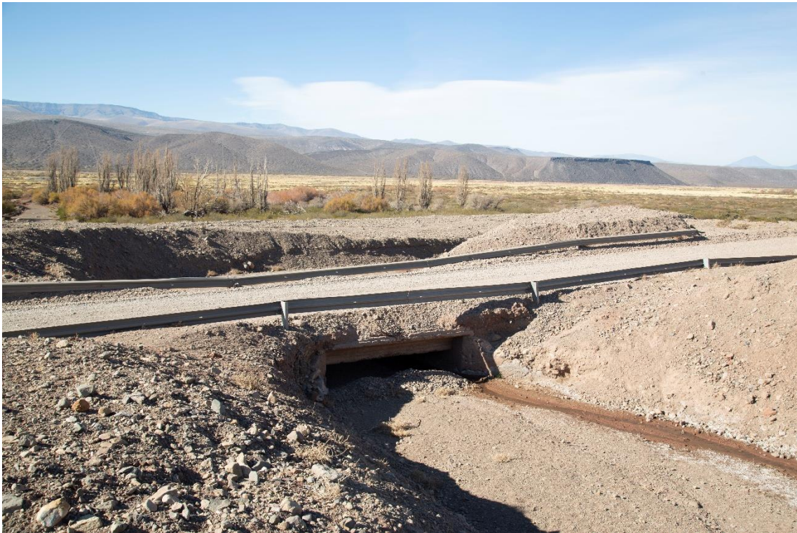
Fotografía 36 – Progresiva – 48+500 – Puente actual en mal estado
