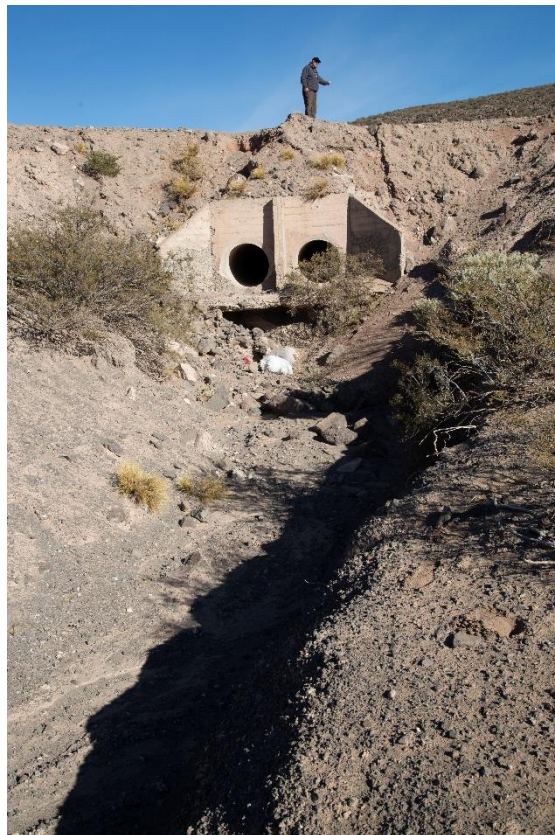
Fotografía 16 - Progresiva 7+100 – Alcantarilla descalzada
