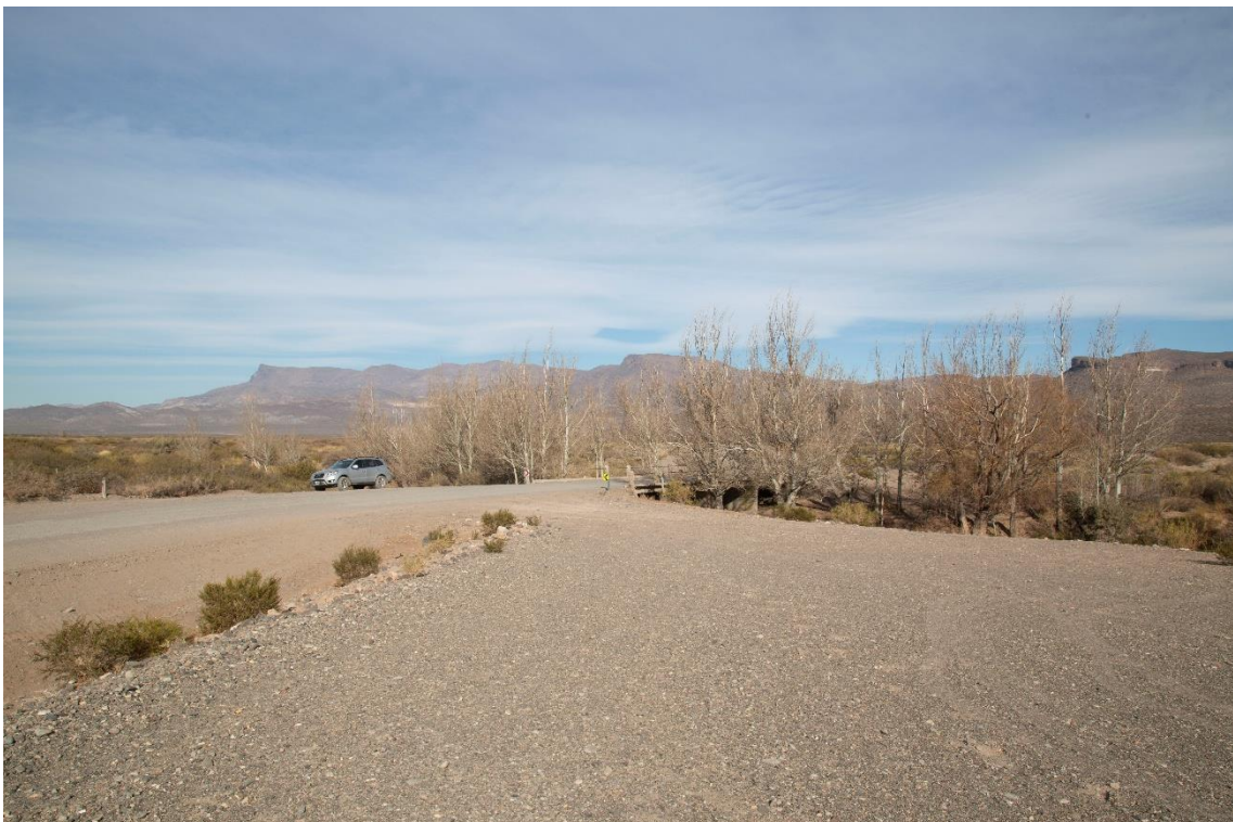
Fotografía 27 – Progresiva 24, 200 – Otra vista del terraplén lado norte del canal de riego. Obra paralizada.
