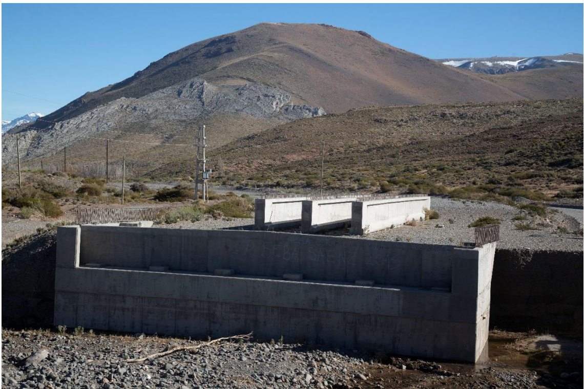
Fotografía 47 – Progresiva 72+000 – Vigas del lado norte para el puente sobre el Arroyo Agua Botada. Obra paralizada.
