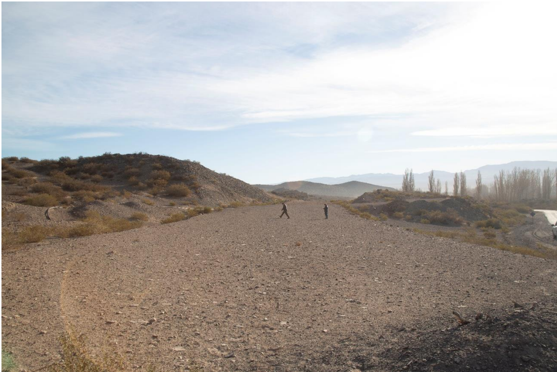
Fotografía 12 – Progresiva 21+400 – Terraplén sur de Acceso al Puente sobre canal de riego. Obra paralizada
