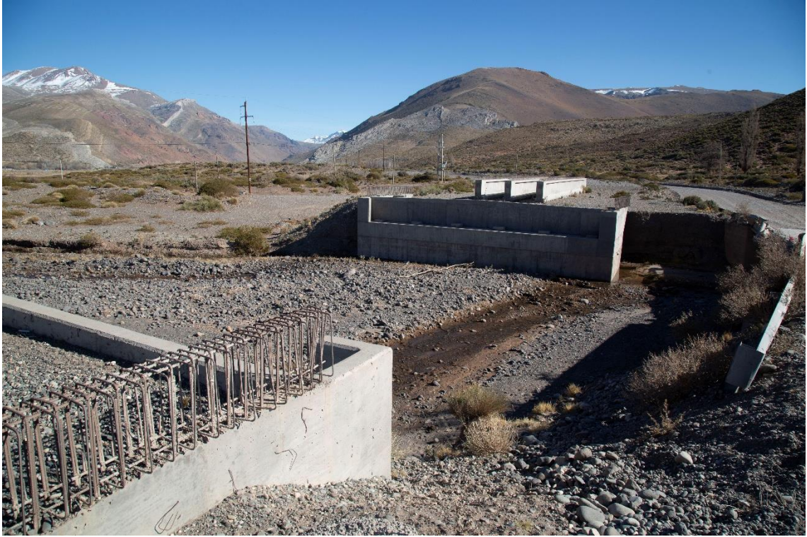
Fotografía 48 – Progresiva 72+000 – Estribos Norte y sur para el puente sobre el Arroyo Agua Botada. Obra paralizada.
