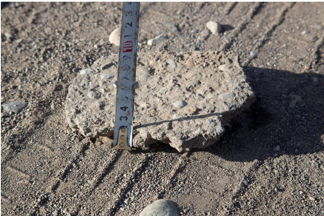
Fotografía 10 – Progresiva 19+400 – Resto de Pavimento en Frio de la Antigua Ruta Nacional 40 Sur
