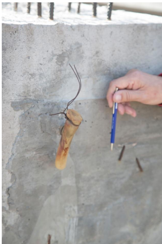
Fotografía 23 – Progresiva 24+000 – Detalle del cable de tensado de las vigas construida para el puente sobre el canal de riego. Obra paralizada
