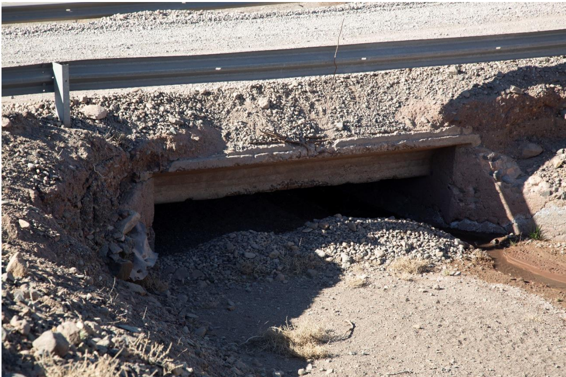
Fotografía 35 – Progresiva – 48+500 – Puente actual en mal estado
