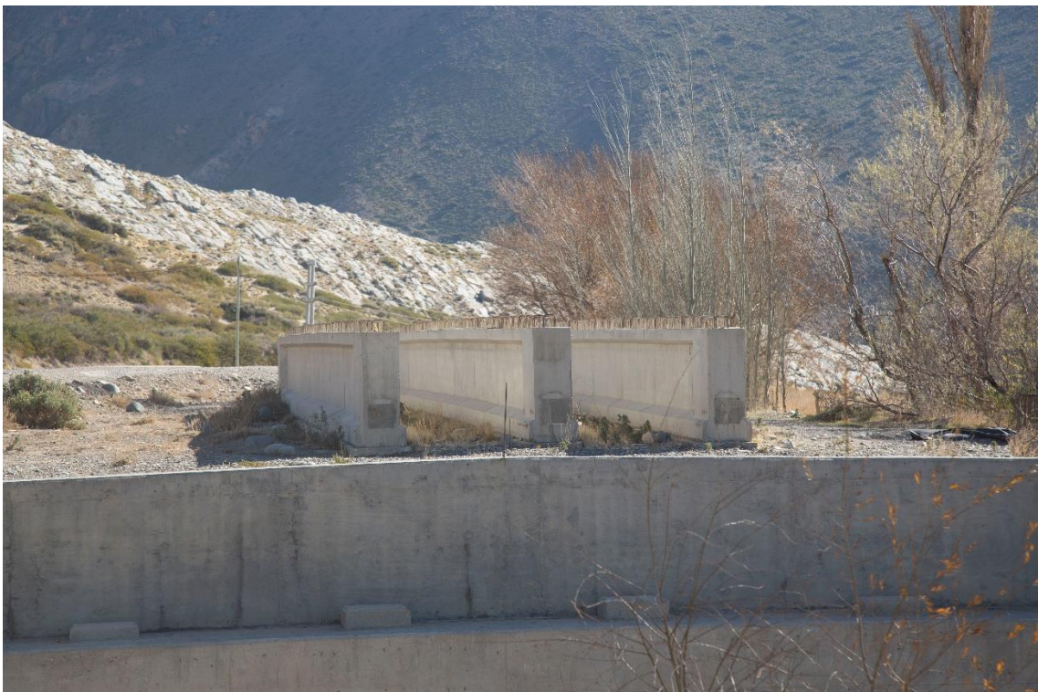
Fotografía 39 – Progresiva 68+800 – Vigas del lado norte para el puente en Bardas Blanca. Obra paralizada
