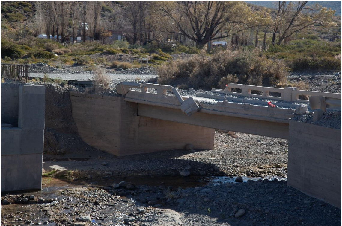
Fotografía 49 – Progresiva 72+000 – Actual puente sobre el Arroyo Agua Botada en mal estado. Fin de la Sección 2.
