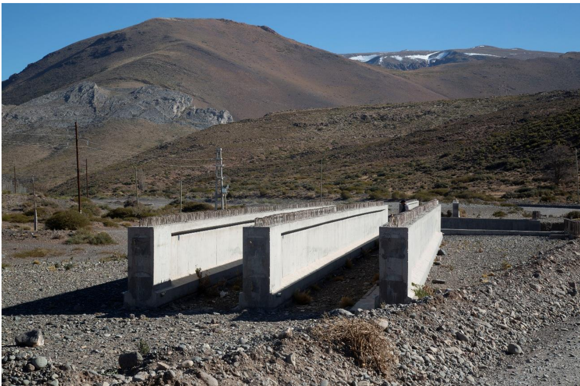
Fotografía 45 – Progresiva 72+000 – Vigas del lado norte para el puente sobre el Arroyo Agua Botada. Obra paralizada.
