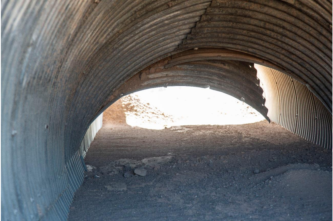
Fotografía 23 - Progresiva 17+000 – Otra vista de alcantarilla de caño en mal estado
