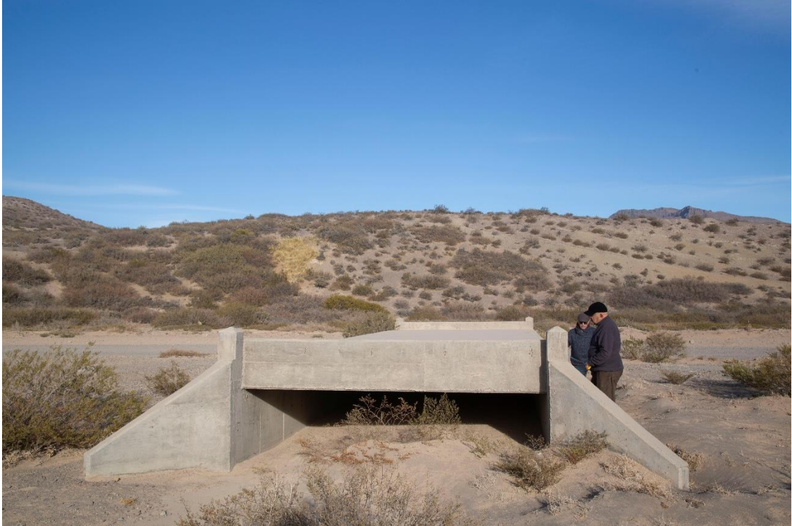
Fotografía 7 – Progresiva 17+700 – Alcantarilla de hormigón en la Variante prevista en el Proyecto Ejecutivo. Obra paralizada
