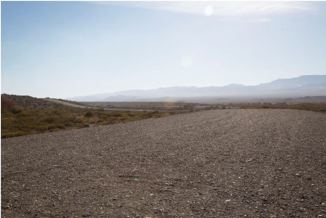
Fotografía 26 – Progresiva 24, 200 – Vista terraplén lado norte del canal de riego. Obra paralizada.
