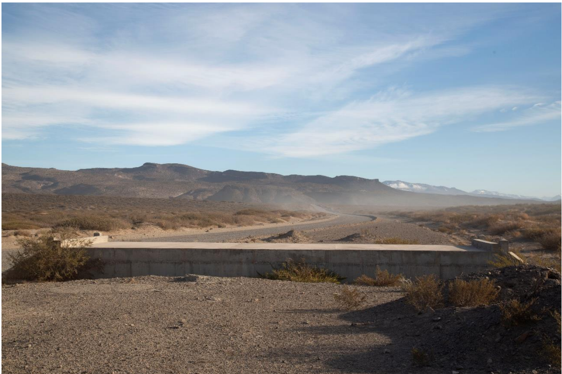
Fotografía 9 – Progresiva 19+000 – Vista de alcantarilla en la variante prevista. Obra paralizada.
