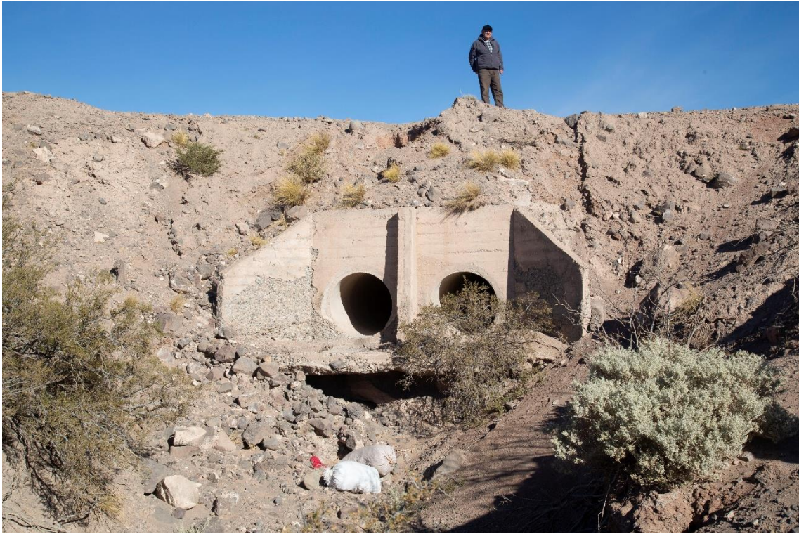
Fotografía 15 - Progresiva 7+100 – Otra vista de la alcantarilla descalzada
