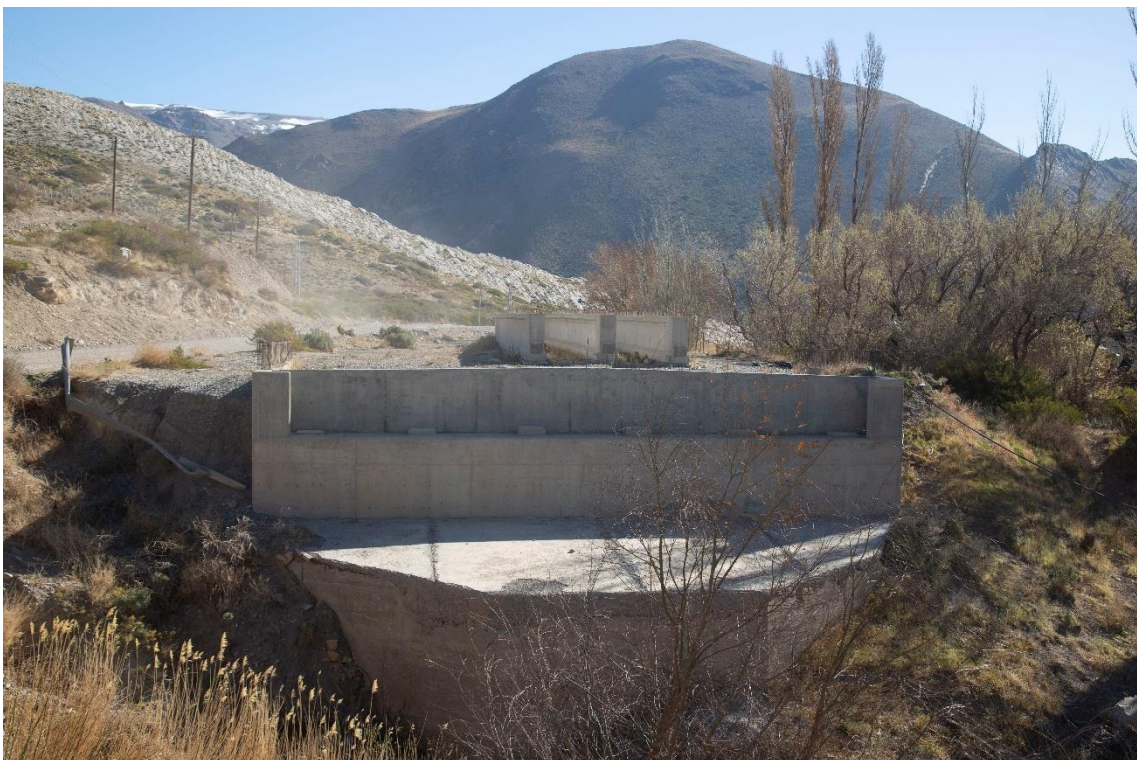
Fotografía 37 – Progresiva 68+800 – Estribo Norte del puente en Bardas Blanca. Obra paralizada.
