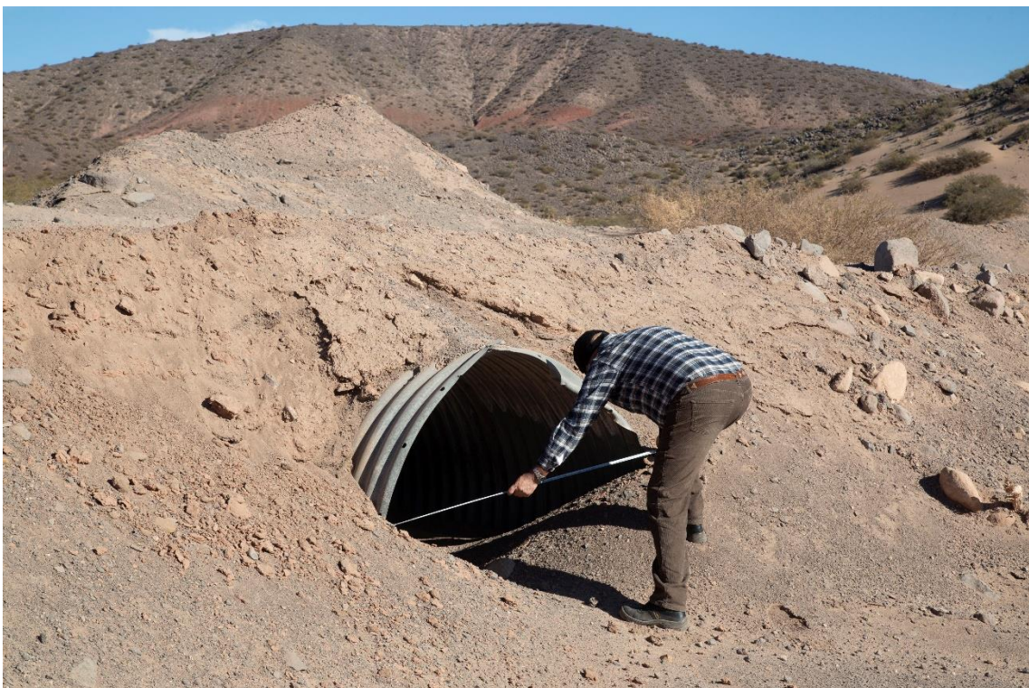
Fotografía 20 – Progresiva 17+000 – Alcantarilla de caño colmatada y en mal estado
