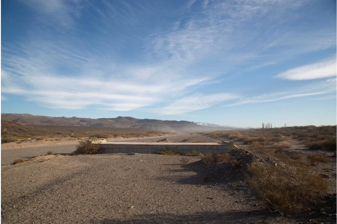
Fotografía 8 - Progresiva 17+700 – vista de la Variante. Obra paralizada
