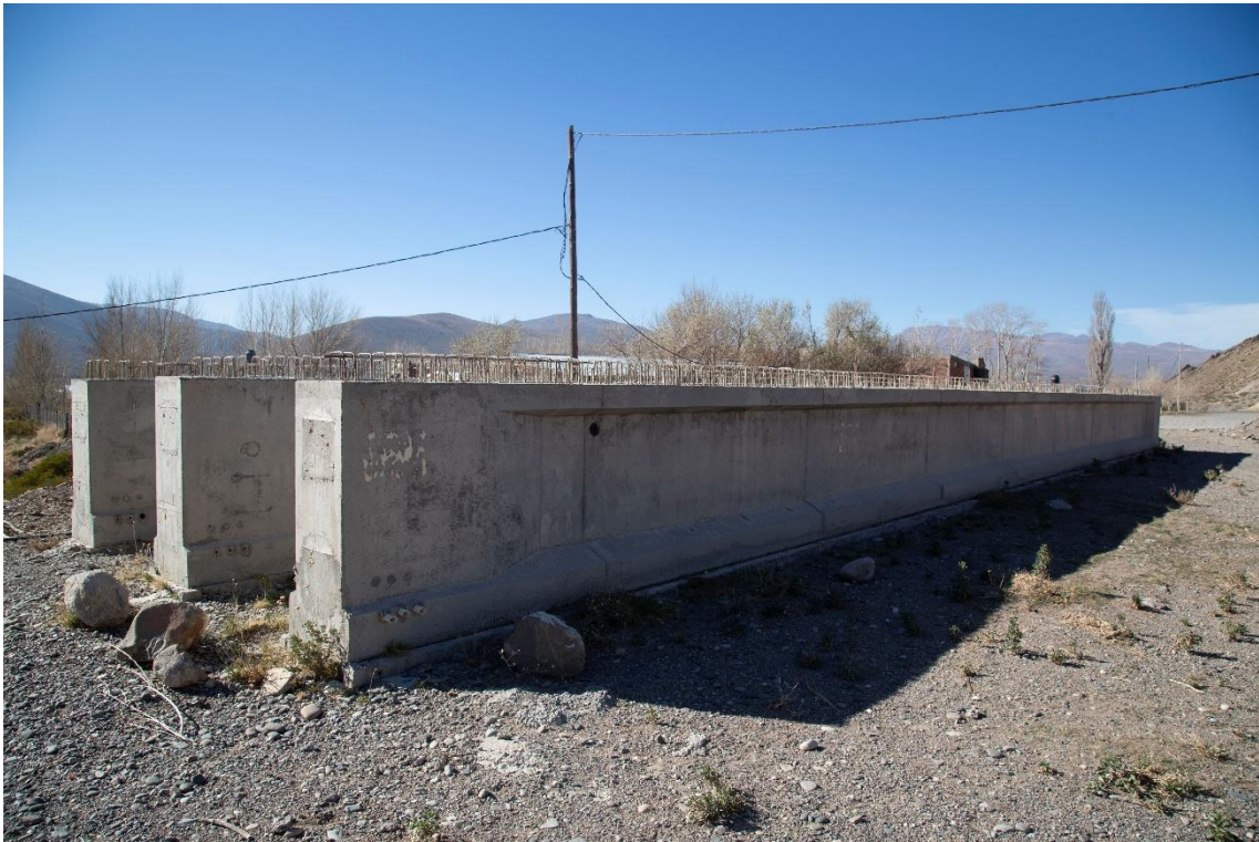
Fotografía 42 – Progresiva 68+800 – Otra vista de las vigas del lado norte. Obra paralizada.
