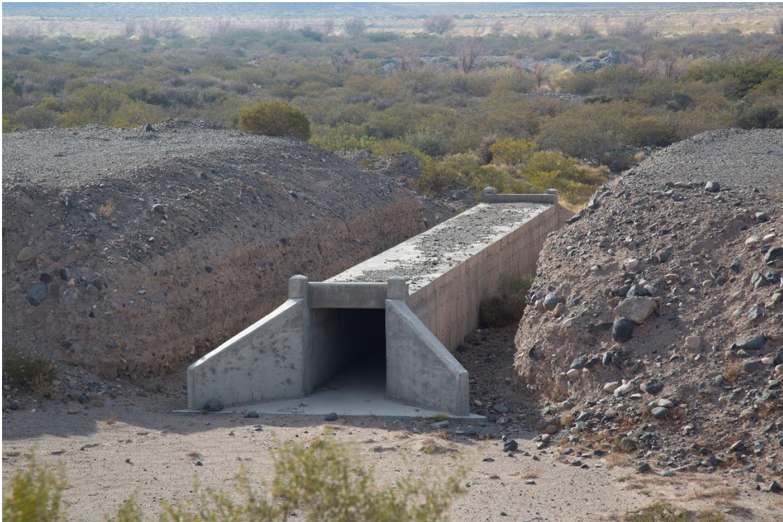
Fotografía 28 - Progresiva 24+000 – Alcantarilla de hormigón en el terraplén de variante. Obra paralizada.
