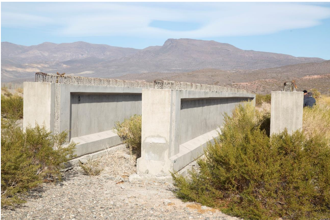
Fotografía 21 - Progresiva 24+000 – Otra vista de 3 vigas construida para el puente sobre el canal de riego. Obra paralizada,
