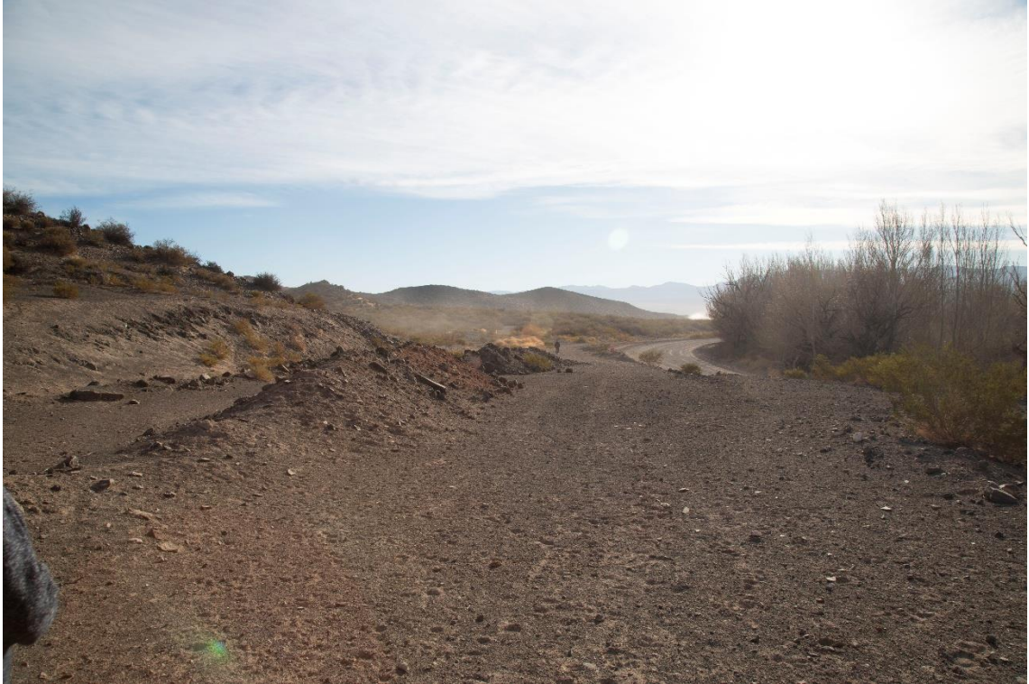
Fotografía 16 – Progresiva 22+400 – Vista del terraplén norte de acceso al puente sobre canal de riego. Obra paralizada
