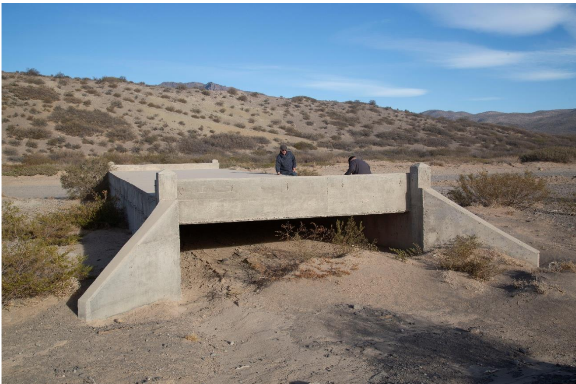
Fotografía 6 – Progresiva 17+700 – Alcantarilla de hormigón en la Variante prevista en el Proyecto Ejecutivo. Obra paralizada
