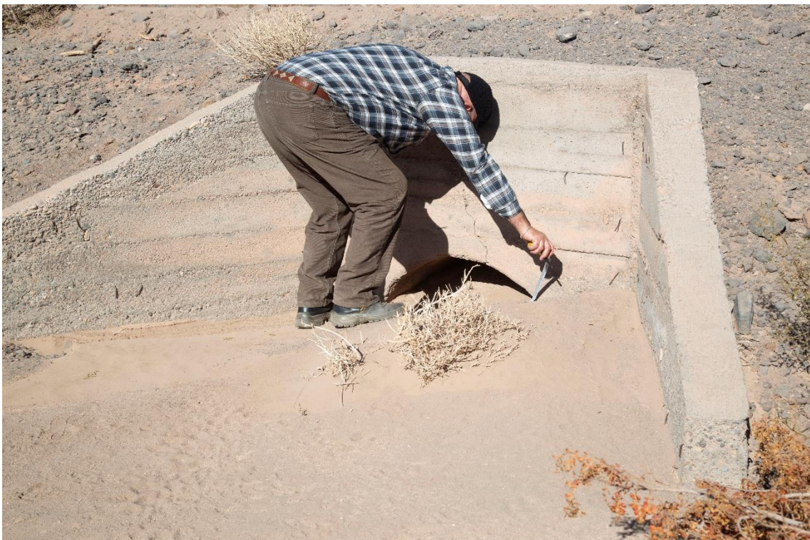
Fotografía 22- Progresiva 17+100 – Alcantarilla de hormigón colmatada
