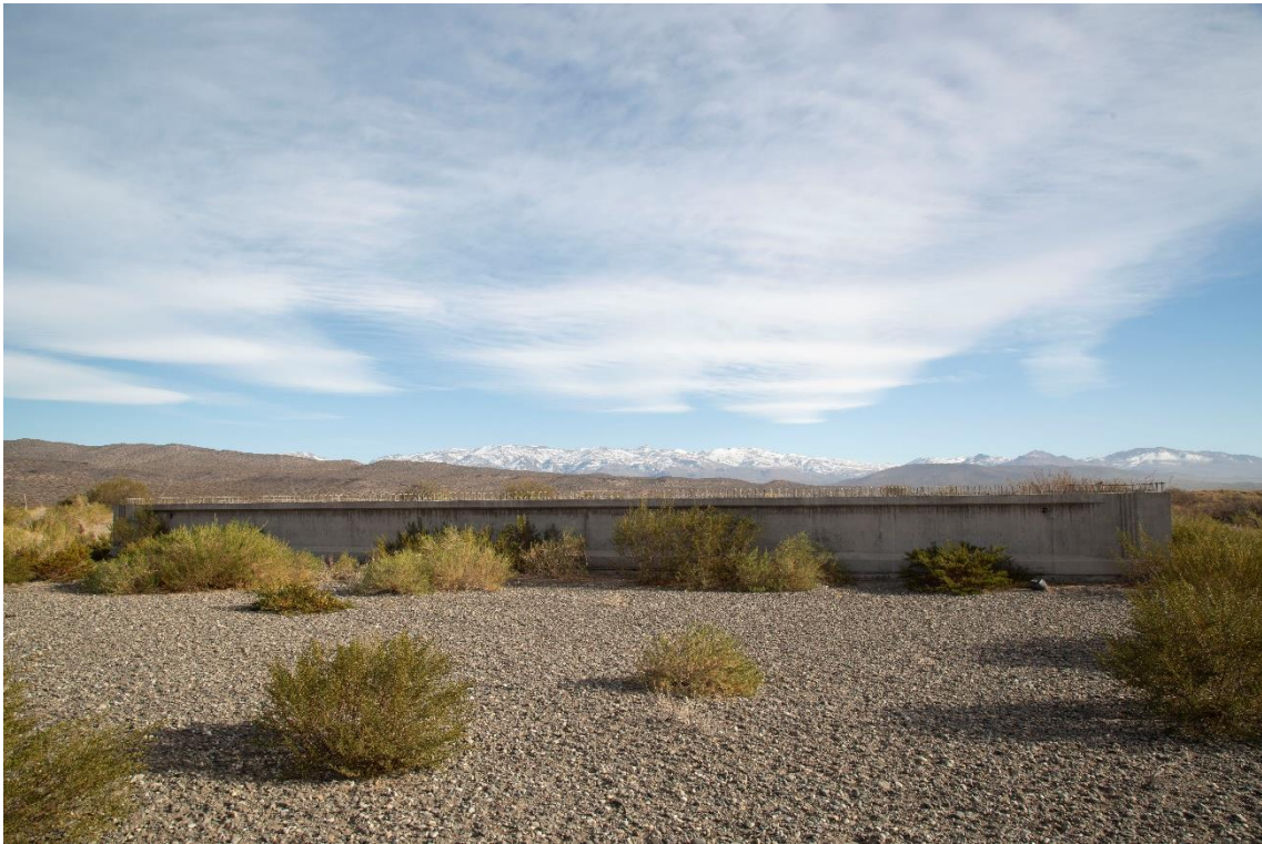
Fotografía 20 – Progresiva 24+000 – Vista lateral de una de las vigas construida para el puente sobre el canal de riego. Obra paralizada, L= 24,80 m.
