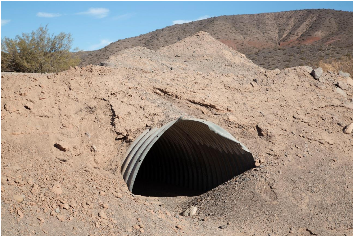
Fotografía 21 - Progresiva 17+000 – Otra vista de alcantarilla de caño colmatada y en mal estado
