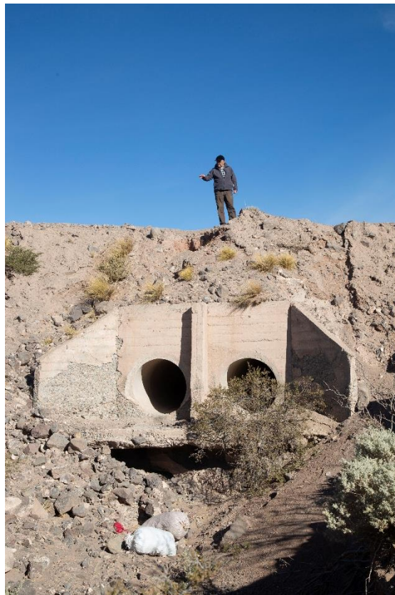
Fotografía 14. Progresiva 7+100 – Alcantarilla descalzada
