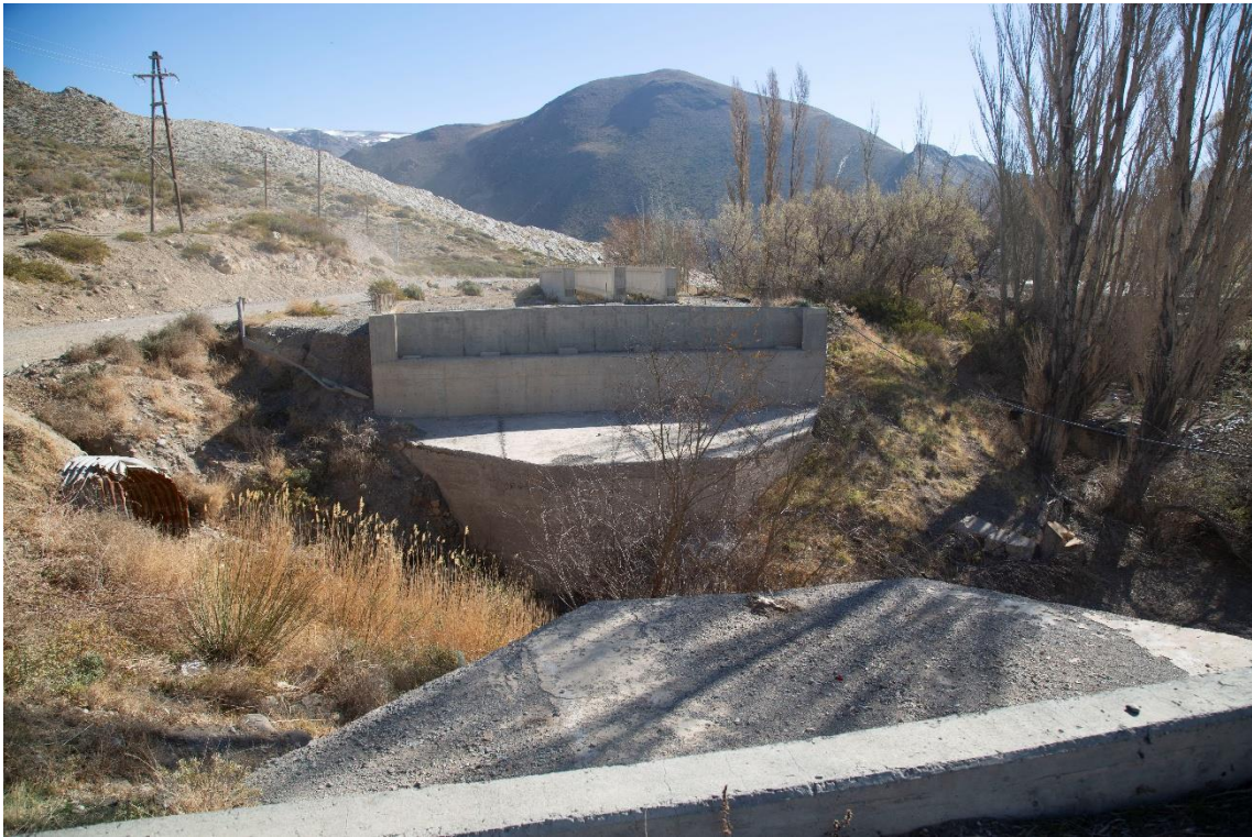
Fotografía 38 – Progresiva 68+800 – Estribo Norte y Sur del puente en Bardas Blanca. Obra paralizada.
