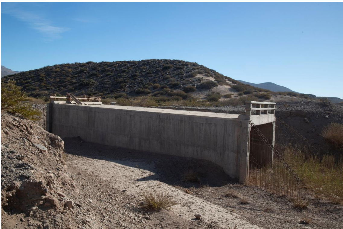
Fotografía 31 – Progresiva 39+000 – Alcantarilla en la variante. Obra paralizada
