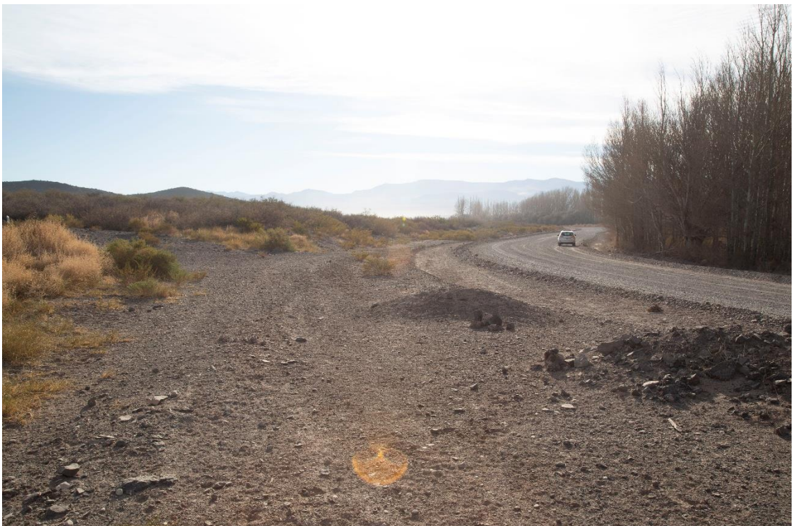
Fotografía 17 – Progresiva 22+400 – Vista del terraplén norte de acceso al puente sobre canal de riego y de la traza actual. Obra paralizada
