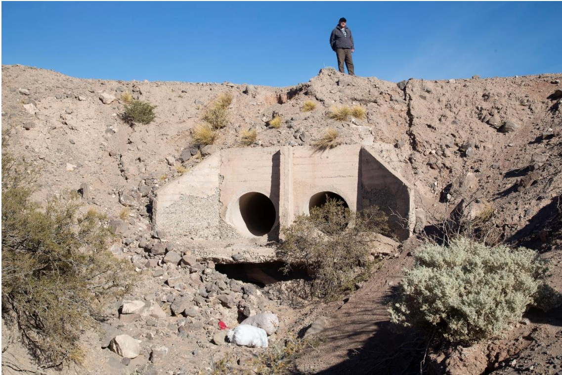
Fotografía 15 - Progresiva 7+100 – Otra vista de la alcantarilla descalzada
