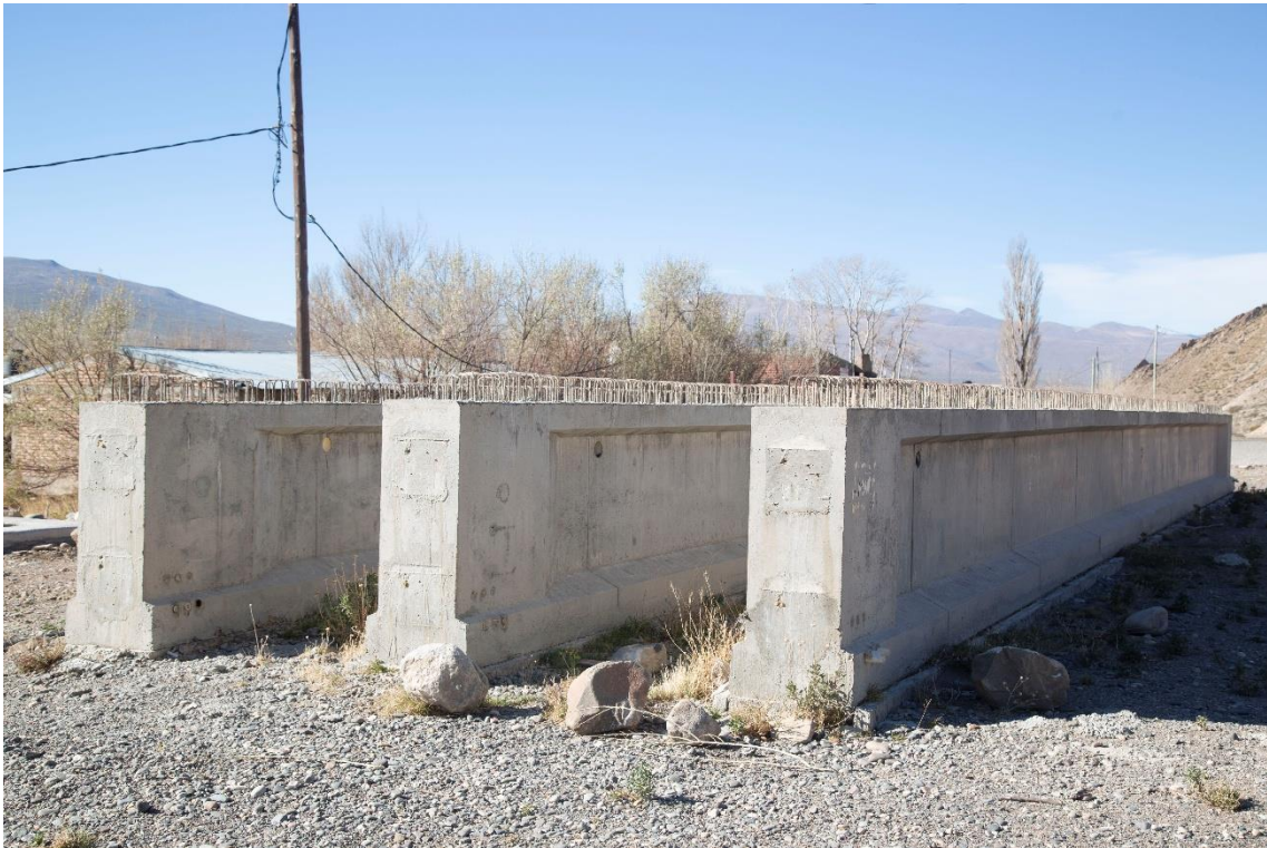
Fotografía 40 – Progresiva 68+800 –Vigas del lado sur para el puente en Bardas Blanca. Obra paralizada
