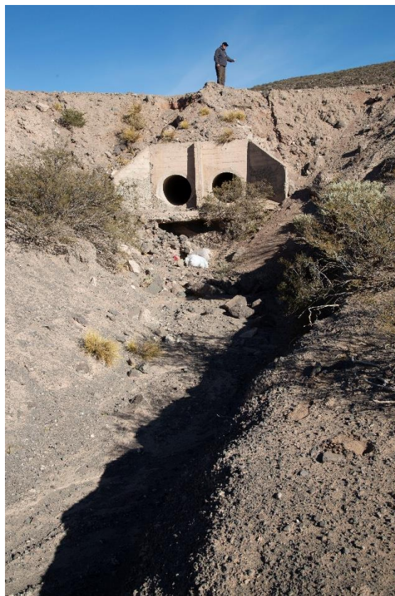
Fotografía 16 - Progresiva 7+100 – Alcantarilla descalzada
