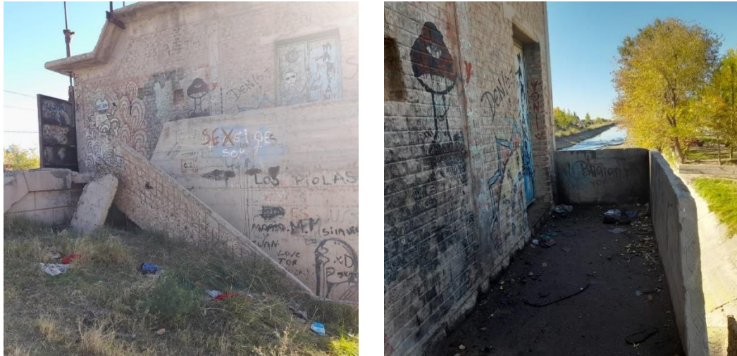
Fotografía N° 21: Vista del recinto de la turbina–bomba existente.
