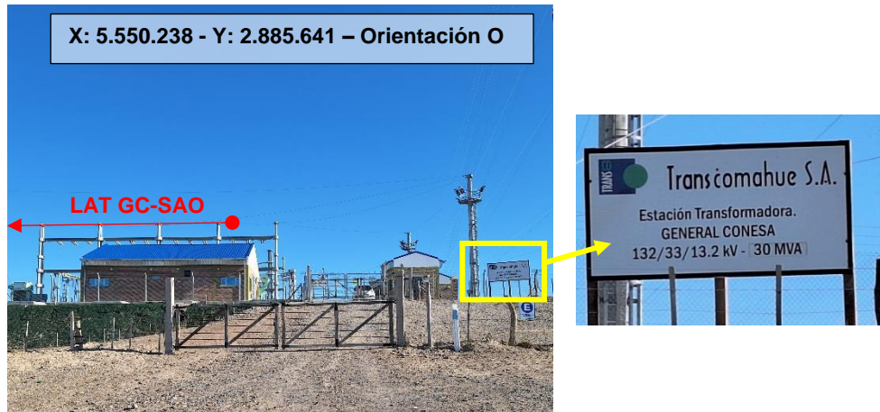
Fotografía N° 5: Vista de la ET GC (Inicio de la LAT) y detalle de cartel identificatorio (Progressiva 0).
