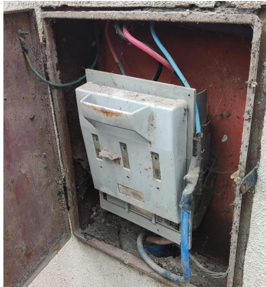
Figura 118 - Tablero Pilar calle Italia – CET N°6
