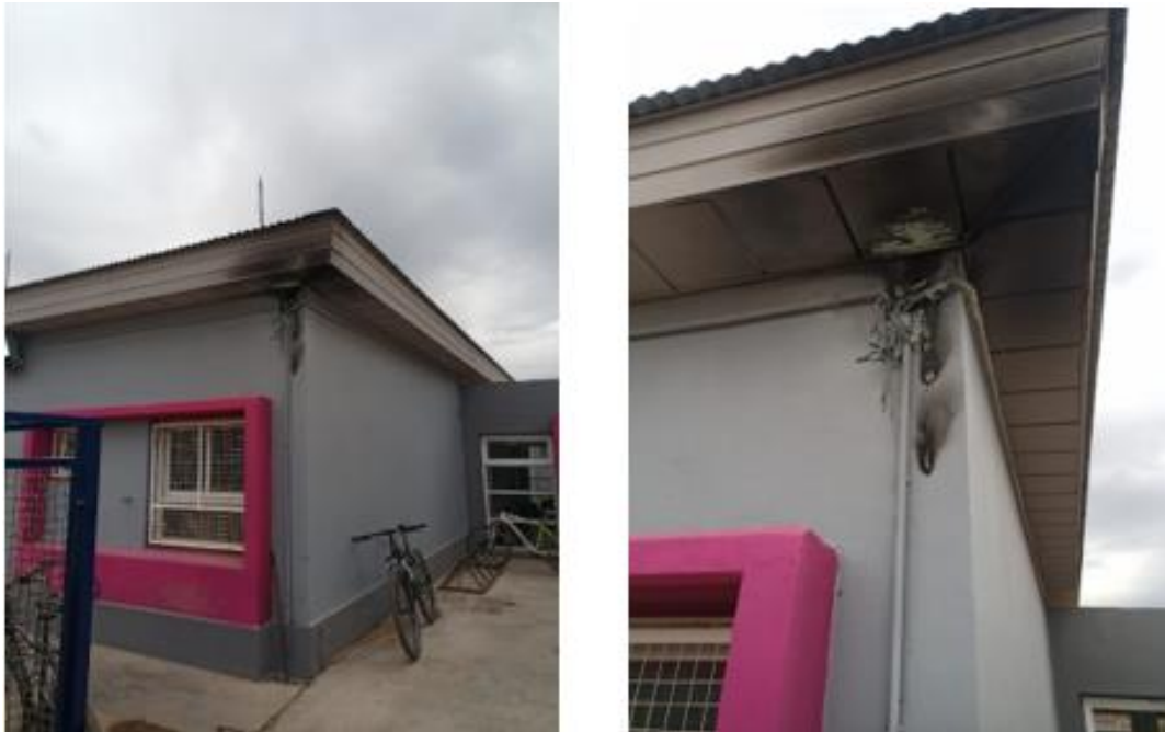
Figura 79: Principio de incendio - CET N°21
