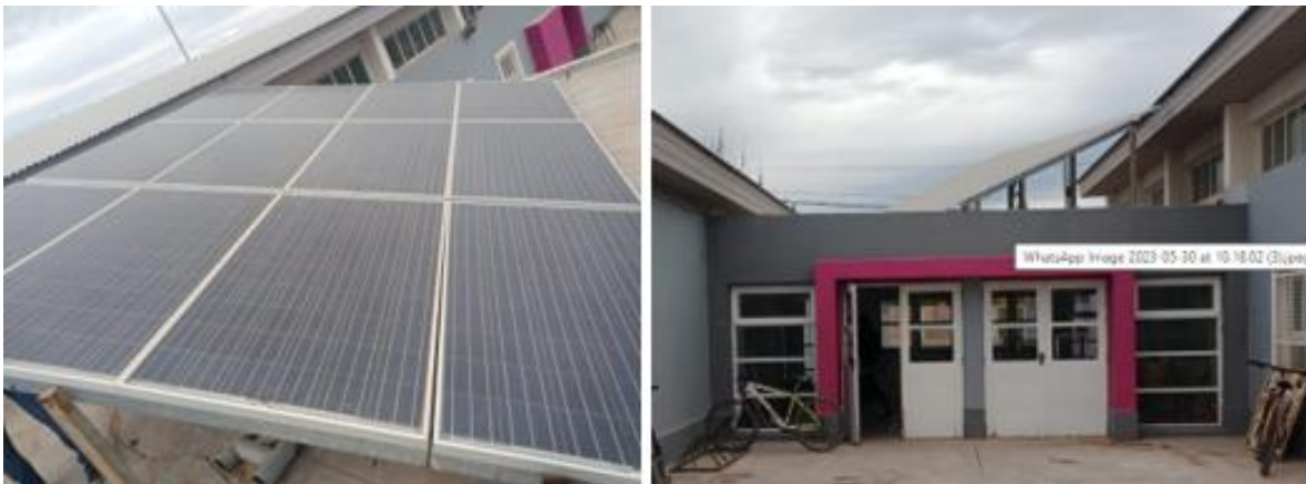
Figura 76: Paneles solares - CET N°21
