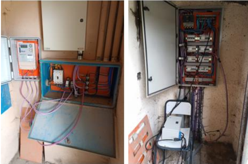
Figura 34: Analizadores de redes Discar DiMet3 (izquierda) y PM3255 Schneider (derecha) - CET N°2
