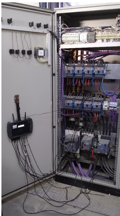
Figura 44: Analizador de redes Circutor MYeBOX 1500 en tablero seccional
