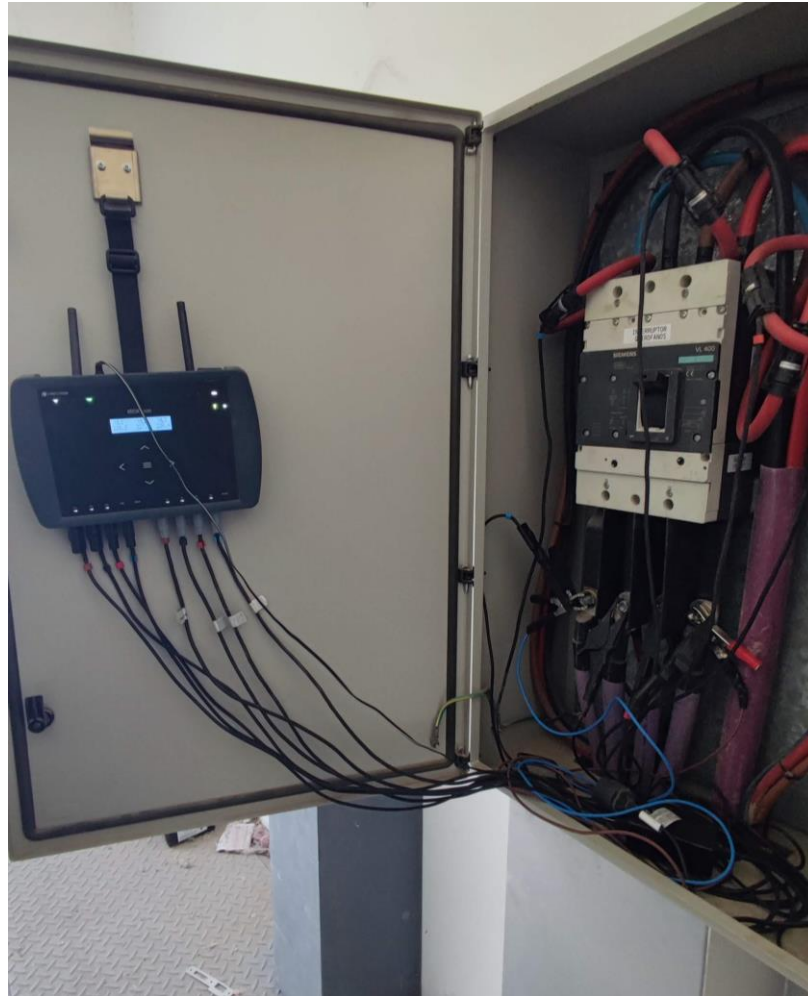
Figura 35: Analizador de redes Circutor MYeBOX 1500 en tablero principal
