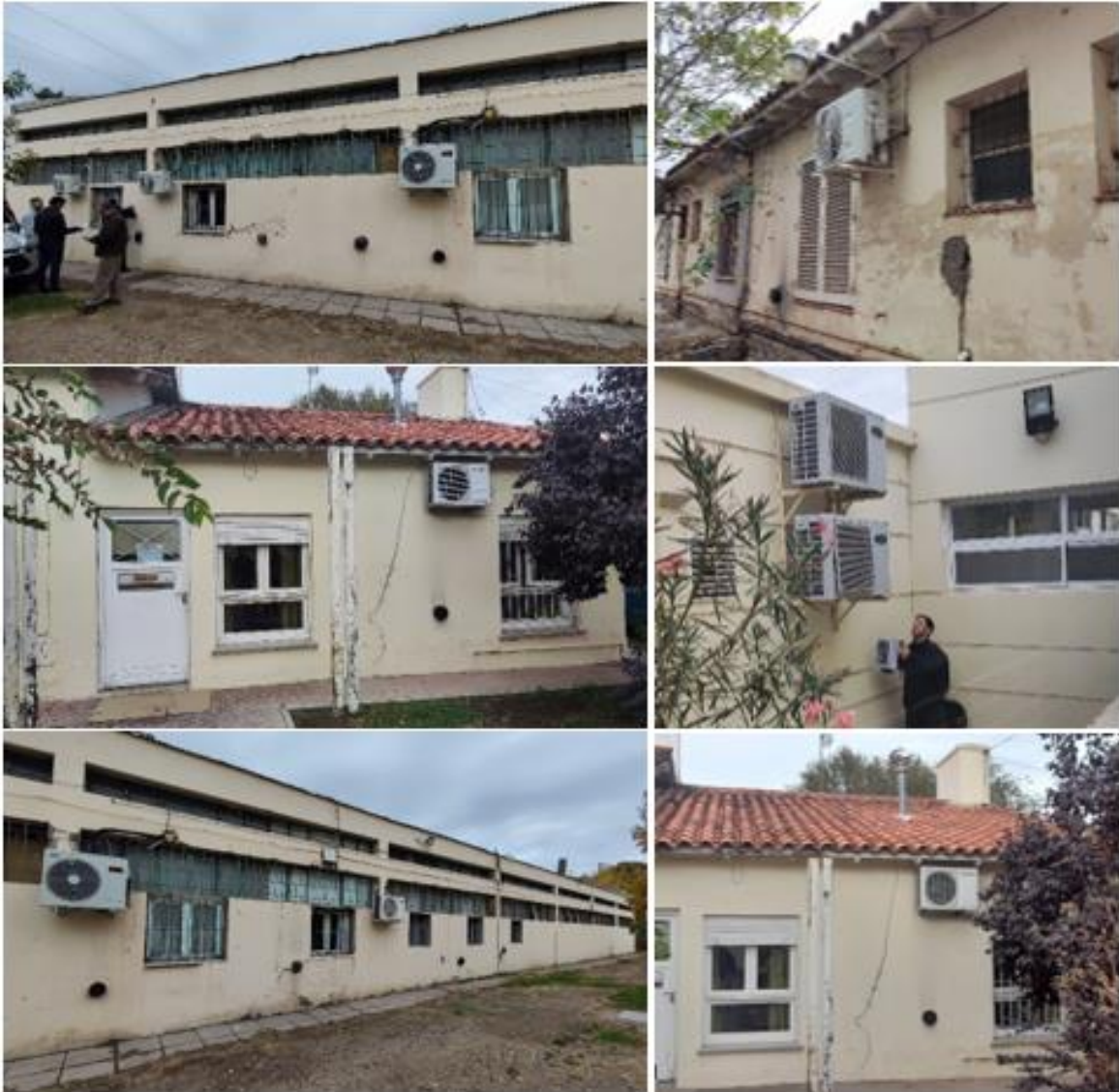
Figura 49: Sistemas de refrigeración del hospital de Roca
