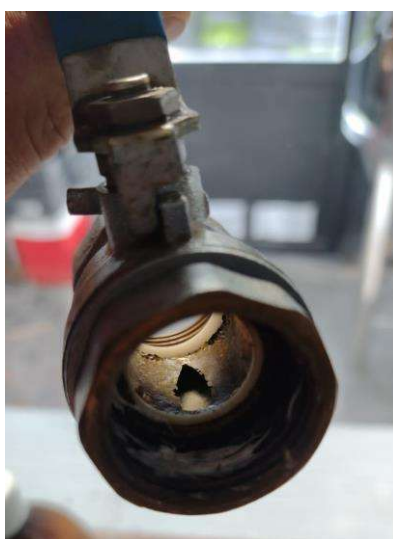
Imagen 4. Válvula esférica corroída
