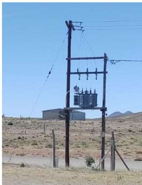
Figura n°6. Transformador de elevación a 13.2 KV 160KW.
