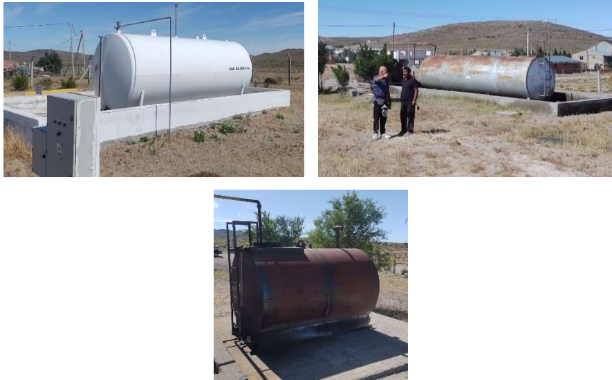
Figura 34. Tanques de almacenamiento de combustible de Lagunita Salada, provincia del Chubut. Fuente: Imagen relevada in situ por el responsable técnico del proyecto, año 2022.
