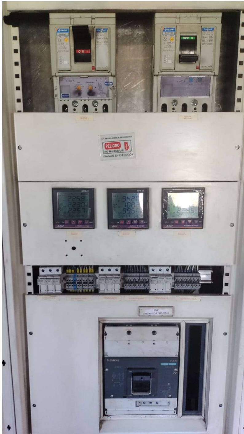
Figura n°10. Tablero de conexión al trafo de elevación de 13.2KV / 160 KW.
