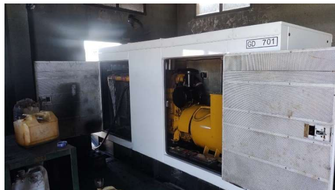
Figura 33. Grupo electrógeno que abastece de energía a Lagunita Salada, provincia del Chubut. Fuente: Imagen relevada in situ por el responsable técnico del proyecto, año 2022.
