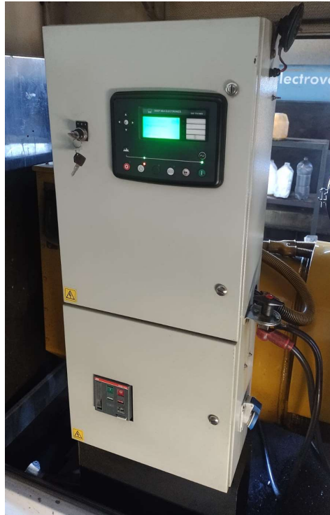
Figura 32. Grupo electrógeno que abastece de energía a Lagunita Salada, provincia del Chubut. Fuente: Imagen relevada in situ por el responsable técnico del proyecto, año 2022.
