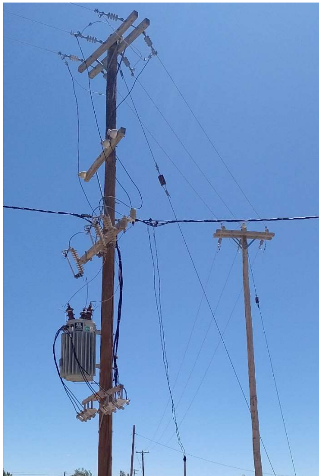
Figura n°8. Transformador de rebaje de 45 KW.
