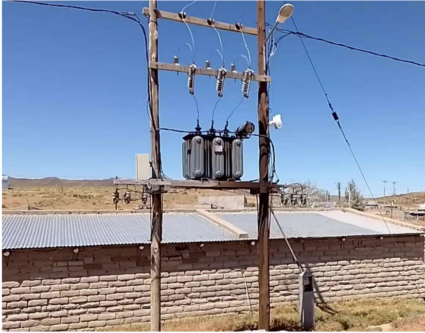
Figura n°7. Transformador de rebaje de 100 KW.
