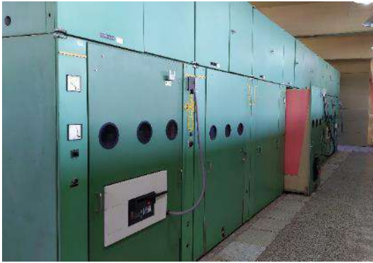
Ilustración 6 – Sala de celdas de 33 kV
