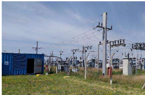
Ilustración 9 – Patio de generación CT Realicó 24 MW
