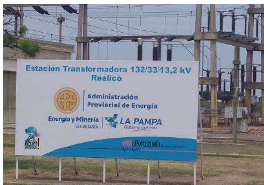
Ilustración 4 – Acceso a la ET Realicó
