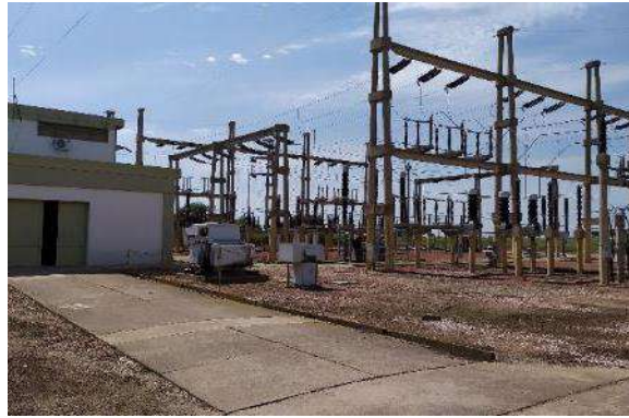
Ilustración 7 – Bahía en 132 kV
