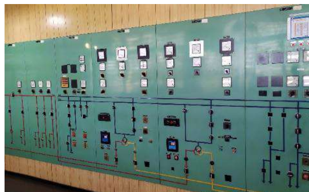
Ilustración 5 – Panel de control tipo mímico, ET Realicó
