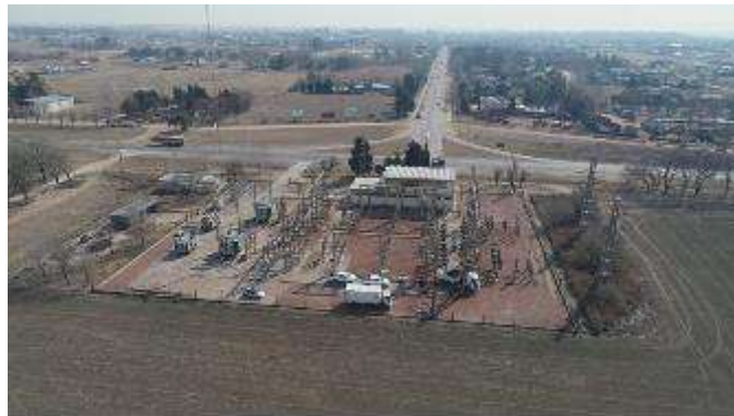
Ilustración 3 – Estación transformadora de Realicó 132/33/13,2 kV 60 MVA
