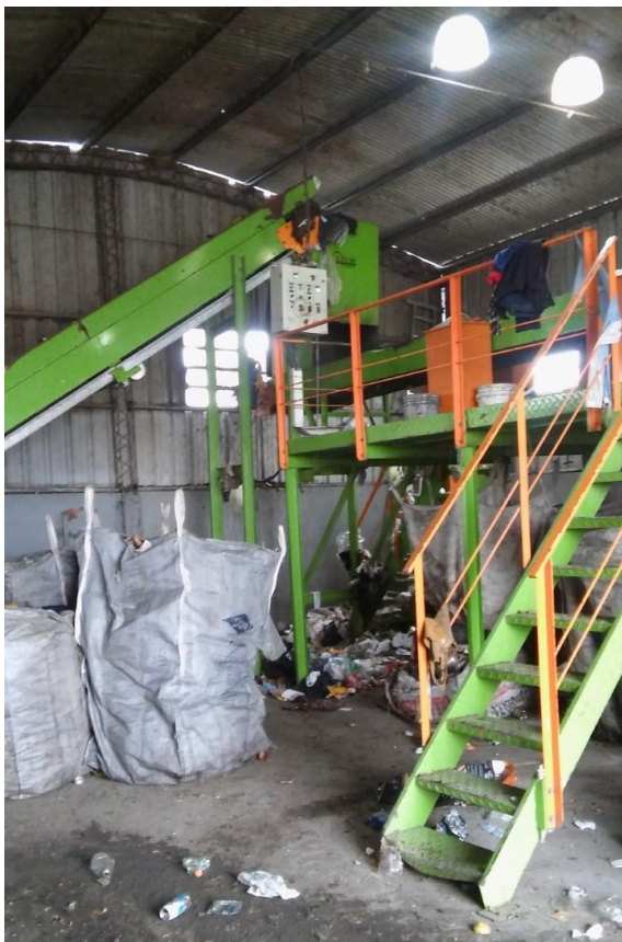
Imagen de cinta de elevación, plataforma de clasificación sobreelevada y material segregado en bolsones de rafia.
