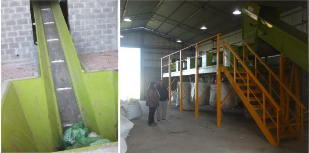
Fotos nº 17 y 18: Vista del sector (boca) de volcado de los residuos en la Planta en el inicio del proceso de separación y vista interior de la Planta
