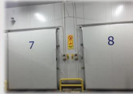
Almacén de freezing 冷库
