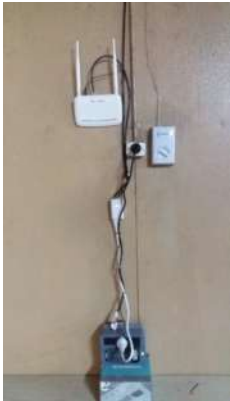
Foto de equipos interior
