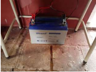
Foto de baterías e inversores
