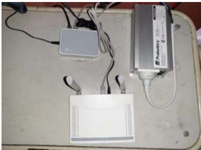
Foto de equipos interior
