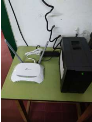
Foto de equipos interior
