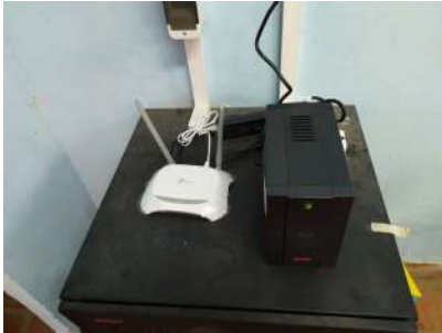
Foto de equipos interior
