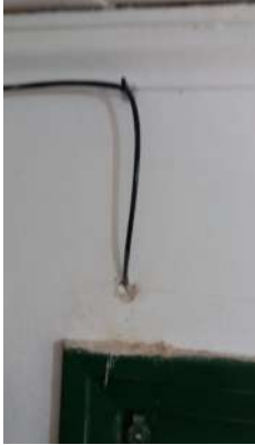
Foto del cableado interior general 1
