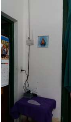
Foto de equipos interior
