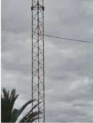
Foto de cableado a pie de torre
