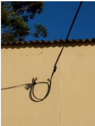
Observaciones sobre el cableado
