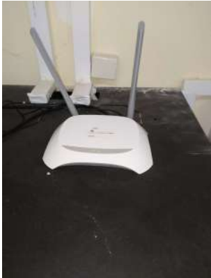
Foto de equipos interior
