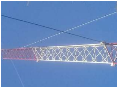
Foto cableado en torre
