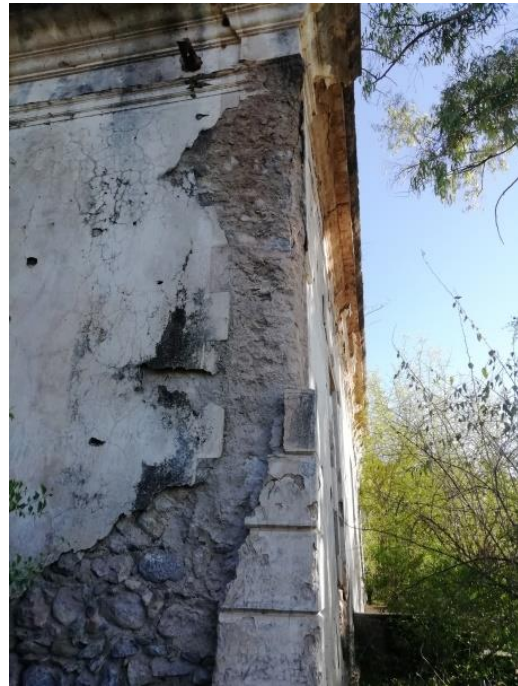
Imagen 19: Detalle del revoco caído en una de las esquinas de la vivienda
