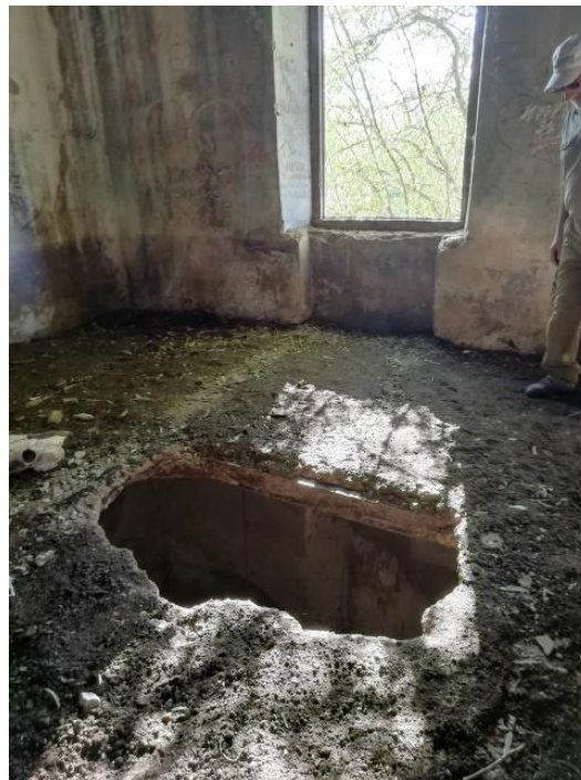
Imagen 21: Agujero en el piso de una de las habitaciones desde la cual se observa el sótano.
