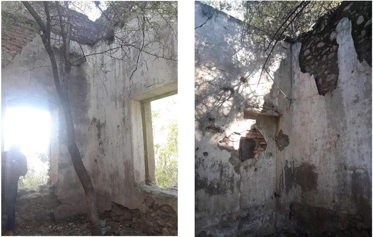
Imagen 23: vegetación en el interior de las habitaciones y techo colapsado de la 2° línea de habitaciones
