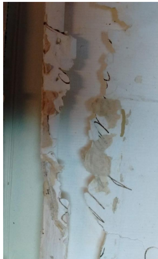
Detalle: abrasiones, roturas y pérdida de soporte
