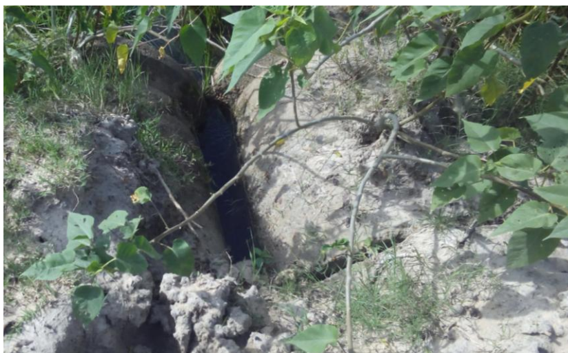
Ruta Provincial Nº 2. Alcantarillado sin defensa
