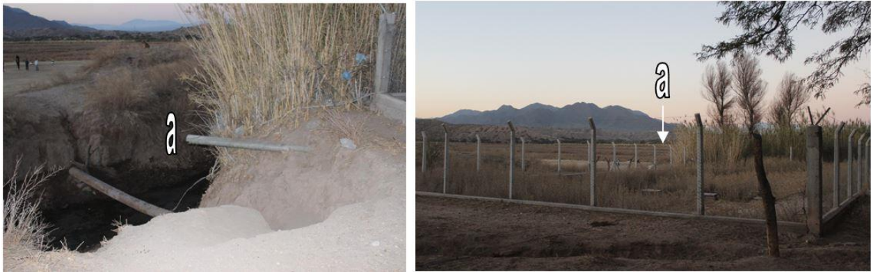
Fig. 50: Planta de tratamiento de residuos cloacales. a) muestra los caños de desagüe al canal de drenaje
