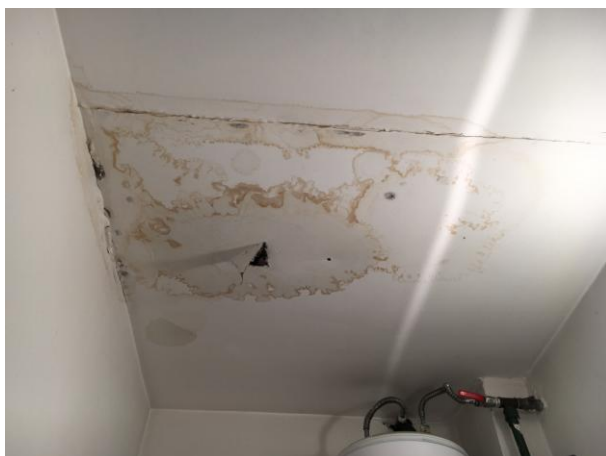
IMAGEN CIELORRASO SUSPENDIDO – ZONA AFECTADA - COCINA PLANTA ALTA
