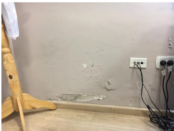
IMAGEN OFICINA JUEZ – PARED CON HUMEDAD
