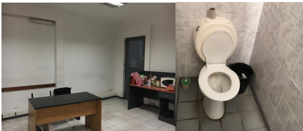
IMAGEN OFICINA SEGURIDAD Y BAÑO PLANTA BAJA - PISO CERAMICO
