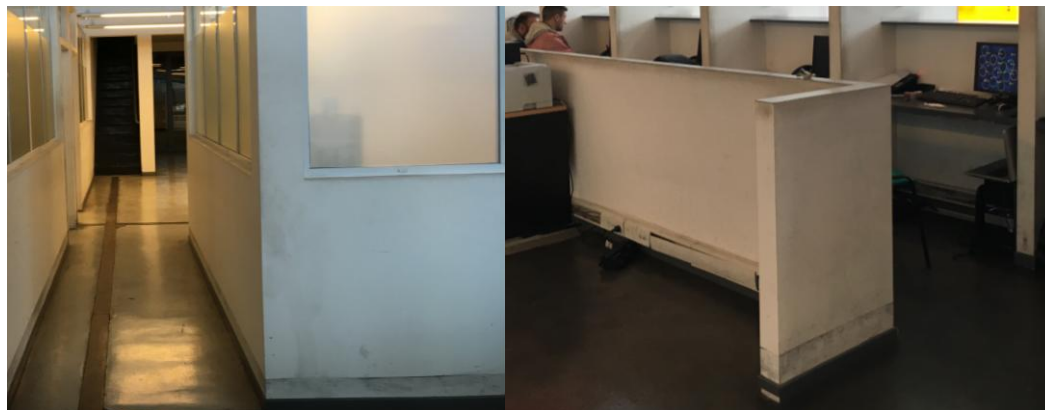
IMAGEN PAREDES PLANTA BAJA – MARCAS PROVOCADAS POR LA INUNDACION.
