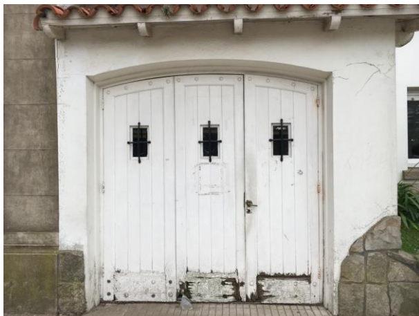
IMAGEN PORTON GARAGE SIN MANTENIMIENTO
