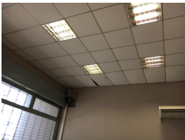
IMAGEN SALA DE ESPERA – CIELORRASO PANELES DAÑADOS INSTALACION ELECTRICA
