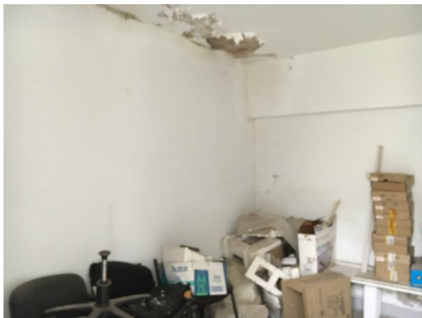
IMAGEN DEPOSITO PLANTA BAJA – HUMEDAD
