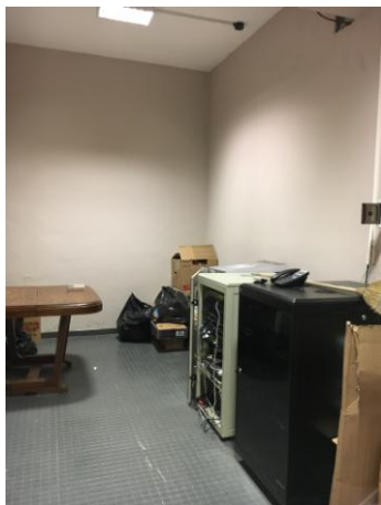
IMAGEN SALA DE MAQUINAS - CIELORRASO APLICADO
