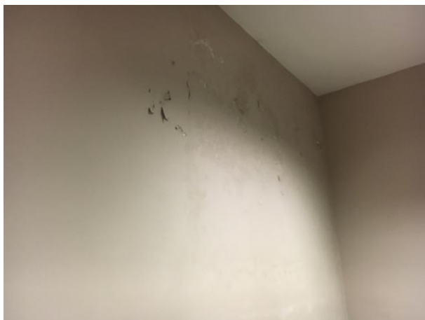
IMAGEN SALA DE MAQUINAS – PARED CON HUMEDAD
