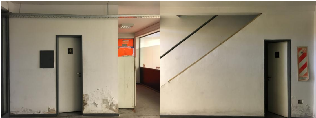
IMAGEN PAREDES BAÑOS PLANTA BAJA- PRESENTAN HUMEDAD PROVOCADA POR SER ZONA HUMEDA Y DETERIORO AGRAVADO POR INUNDACION.
