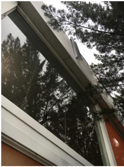
IMAGEN EXTERIOR – CANALETA SUELTA
