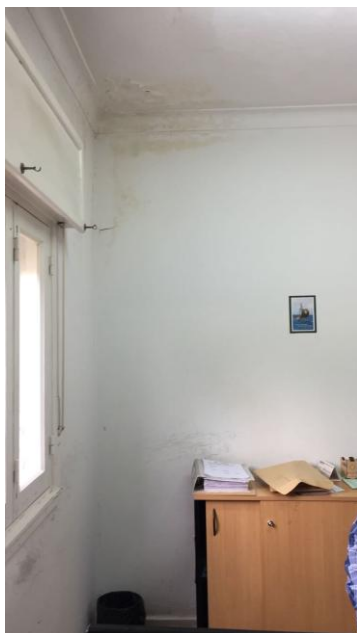
IMAGEN OFICINA ADMINISTRATIVA PLANTA BAJA- PARED CON HUMEDAD
