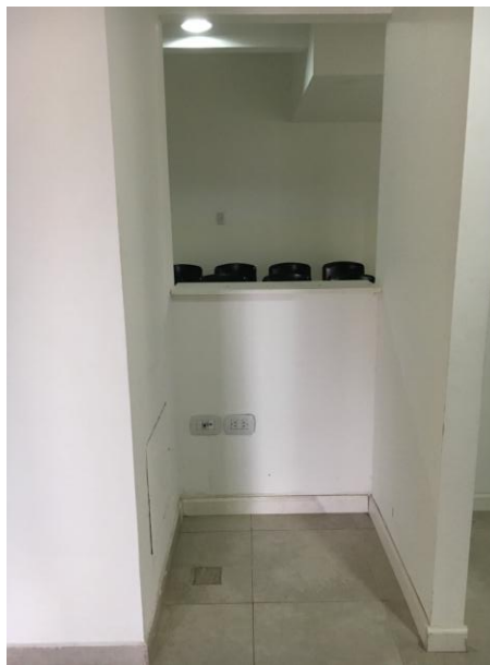
IMAGEN BOX DE ATENCION - CIELORRASO APLICADO
