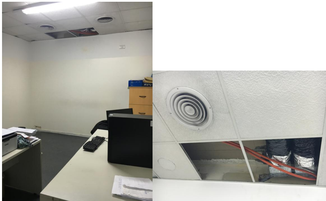
IMAGEN CIELORRASO OFICINA PROSECRETARIO – DAÑOS POR FILTRACION DE AGUA
