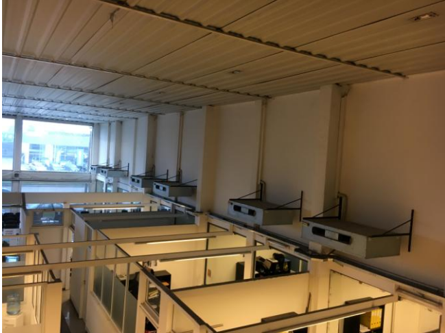
IMAGEN AIRES ACONDICIONADOS
