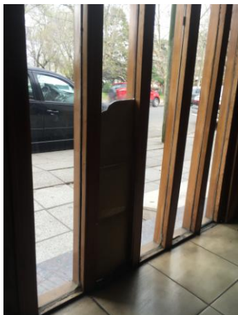
IMAGEN VENTANA PUERTA DE ACCESO-VIDRIO ROTA
