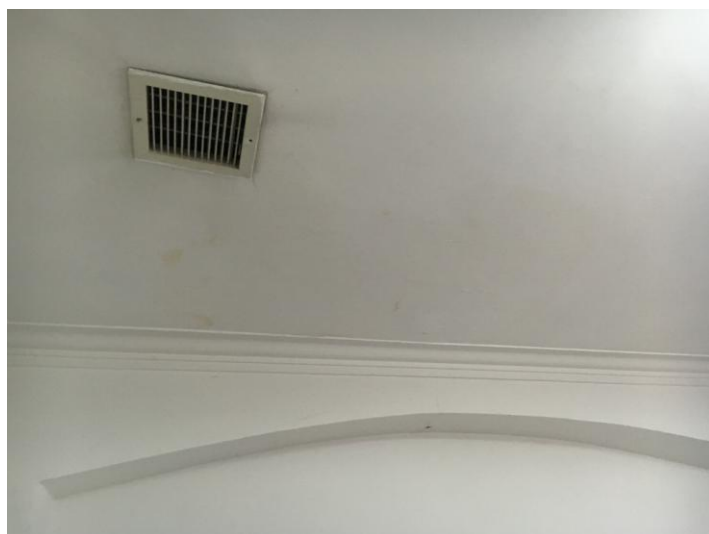
IMAGEN OFICINA JUEZ PLANTA ALTA – FILTRACION DE AGUA POR CUASA DE LAS TEJAS DAÑAS
