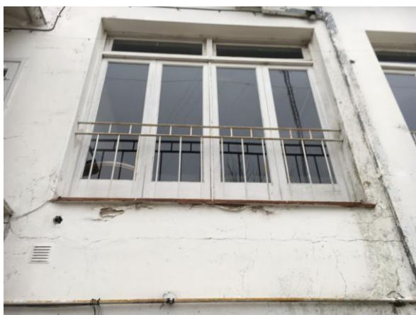
IMAGEN EXTERIOR – PAREDES DAÑAS POR CAUSA DE CANALETAS ROTAS- HUMEDAD EN LAS PAREDES
