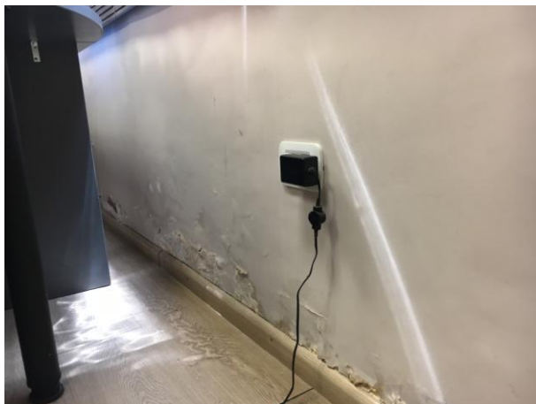
IMAGEN OFICINA JUEZ – PARED CON HUMEDAD
