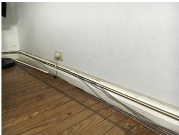
IMAGEN ZOCALODUCTOS EN MAL ESTADO OFICINA PROSECRETARIO
