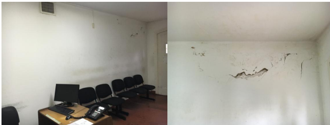
IMAGEN SALA DE ESPERA PLANTA BAJA- PAREDES CON HUMEDAD
