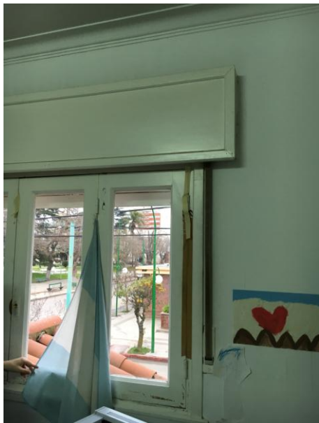
IMAGEN OFICINA PROSECRETARIO SIN MANTENIMIENTO
