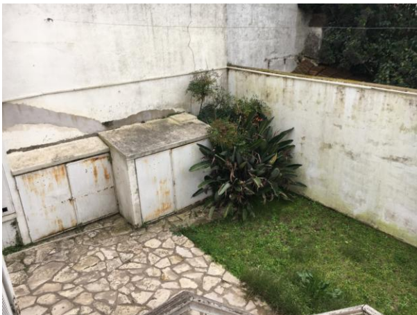
IMAGEN PATIO-PAREDES SIN MANTENIMIENTO
