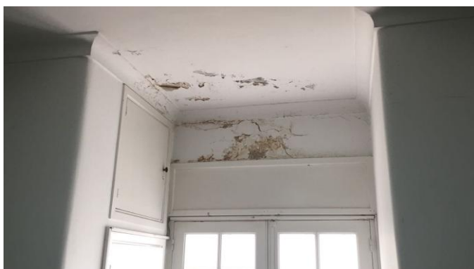
IMAGEN OFICINA ADMINISTRATIVOS – HUMEDAD DEBIDO A CANALETAS ROTAS
