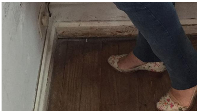
IMAGEN PISO DE MADERA OFICINA ADMINISTRATIVOS - ZONA DAÑADA
