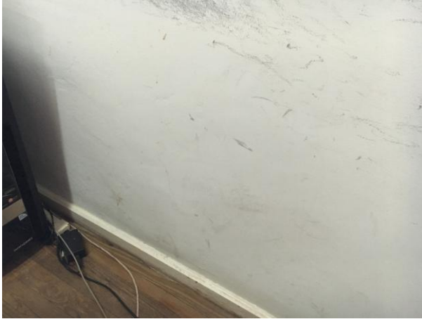
IMAGEN OFICINA PROSECRETARIO – PAREDES DESGASTE DEL PASO DEL TIEMPO, SIN MANTENIMIENTO
