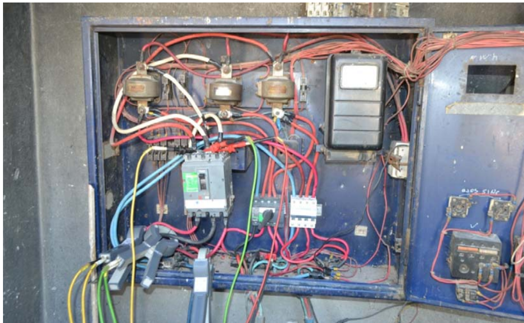
Ilustración 13: Tablero de protecciones y maniobras actual
