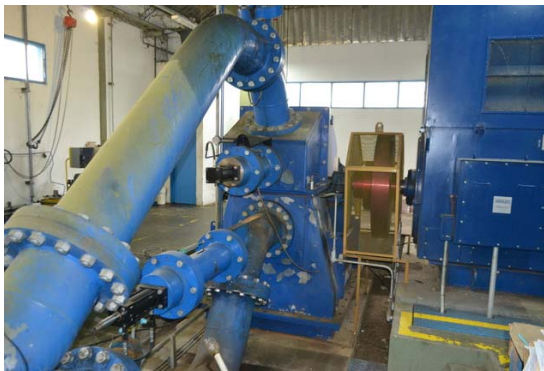
Ilustración 17: miniturbina tipo Pelton con volante y generador
