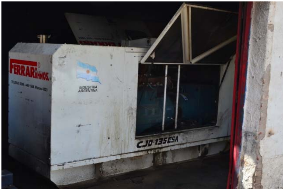
Ilustración 12: Grupo generador en operación.
