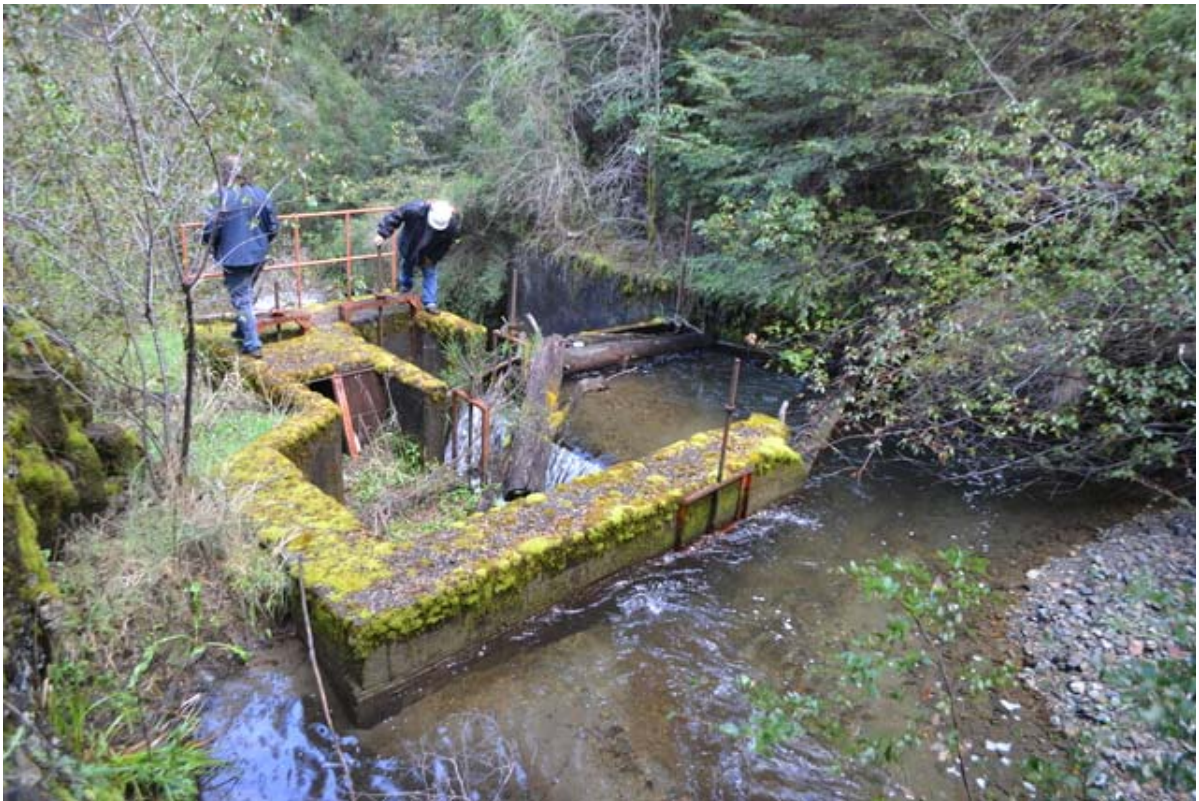
Ilustración 22: Obra de captación, desarenador y cámara de carga
