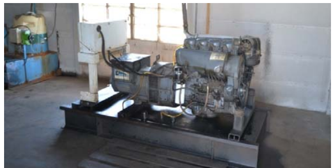
Ilustración 8: Generador sistema de bombeo.
