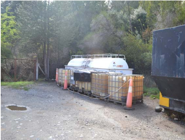
Ilustración 20: depósito de combustible en predio de generación
