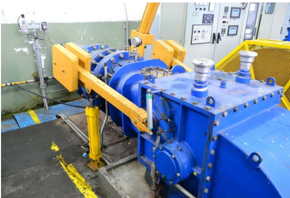
Ilustración 15: miniturbina de flujo cruzado con vista de válvula
