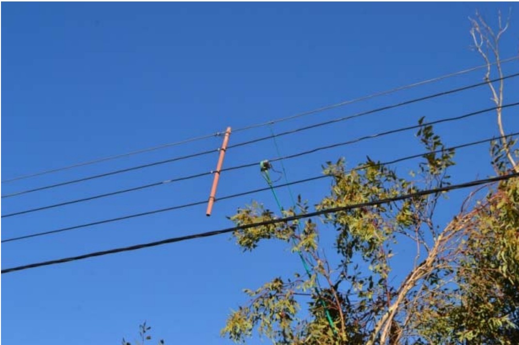
Ilustración 15: Ejemplo de bajada eléctrica residencial existente.
