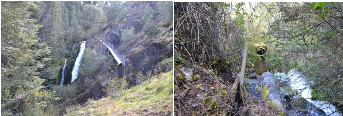
Ilustración 23: faltante de tubería a mitad de recorrido Ilustración 24: faltante de tubería al inicio de traza
