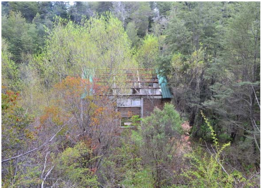
Ilustración 6: ruinas de sala de máquinas
