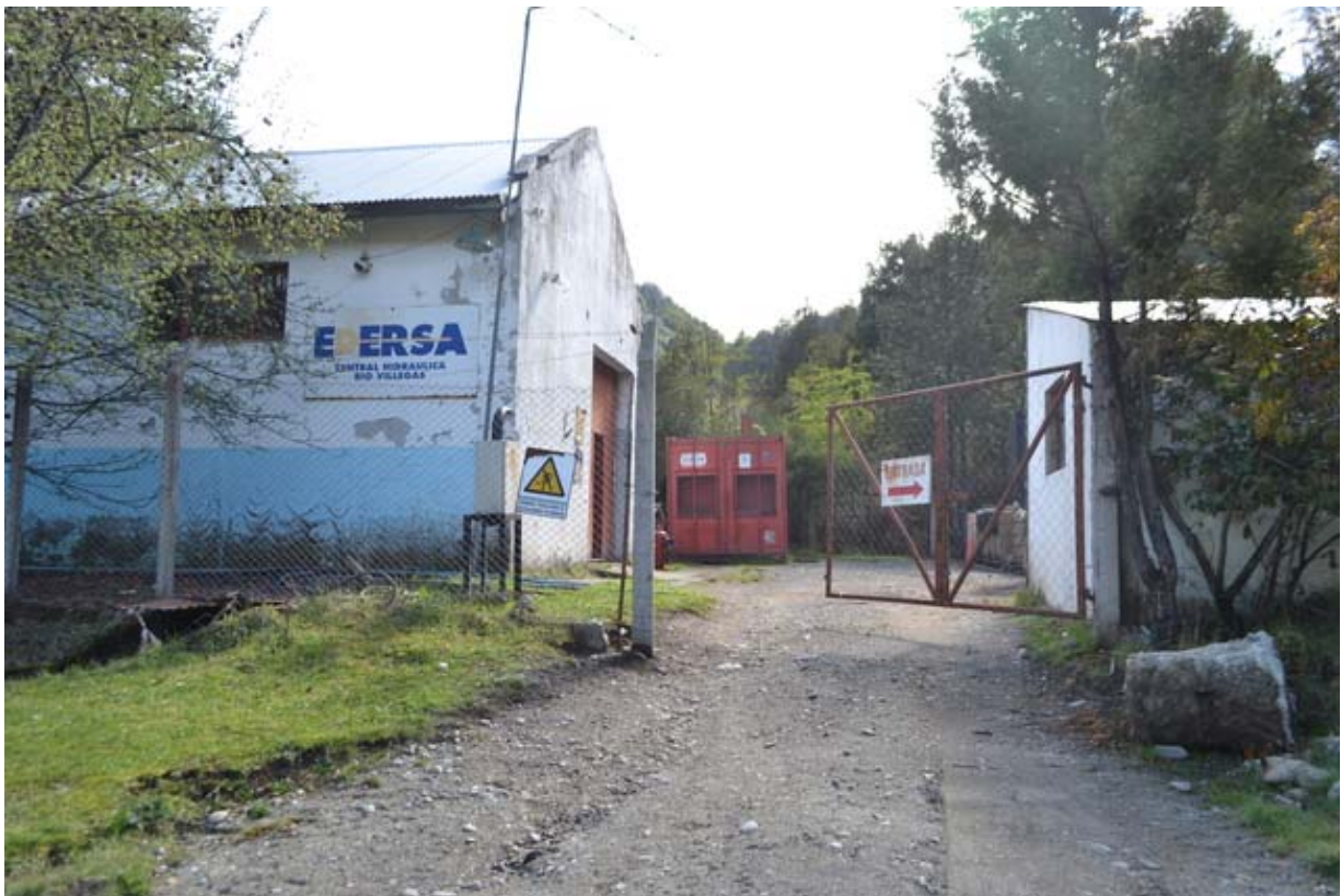
Ilustración 19: predio de microturbina y grupos electrógenos
