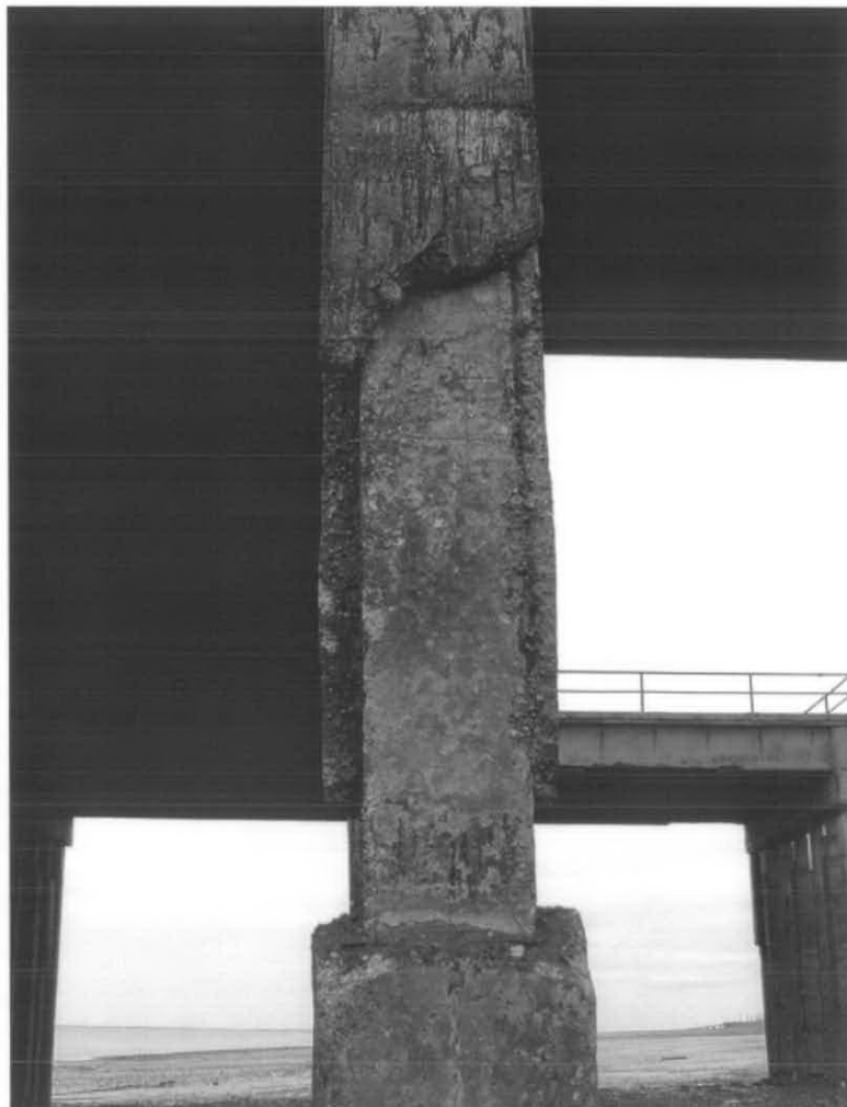
Detalle del desprendimiento de la protección actual de los pilotes
