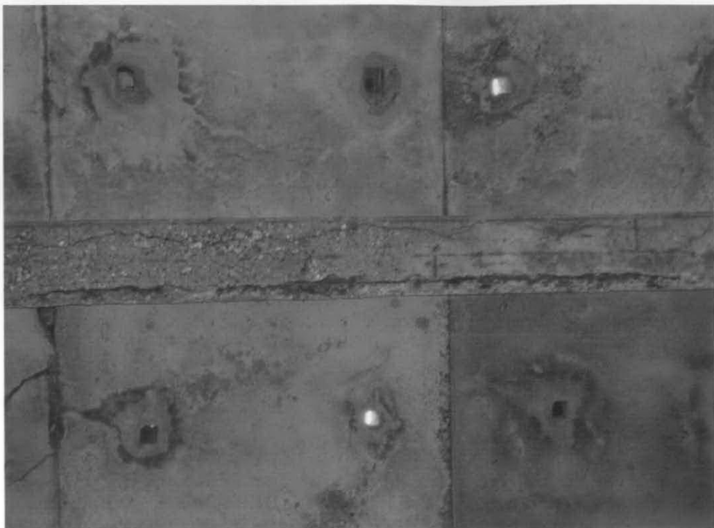
Fisuras longitudinales en viga de apoyo de losetas
