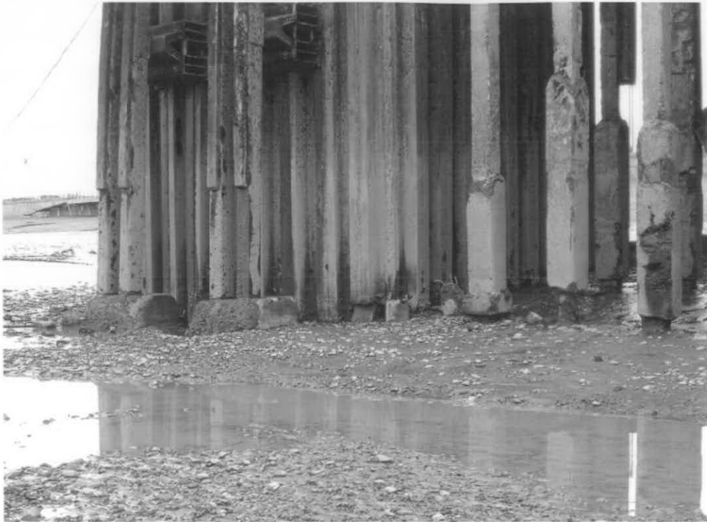
Vista de los dados de hormigón al pie de las defensas en el dolfin este
