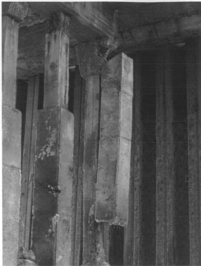
Detalle de una diagonal partida, suspendida de la armadura
