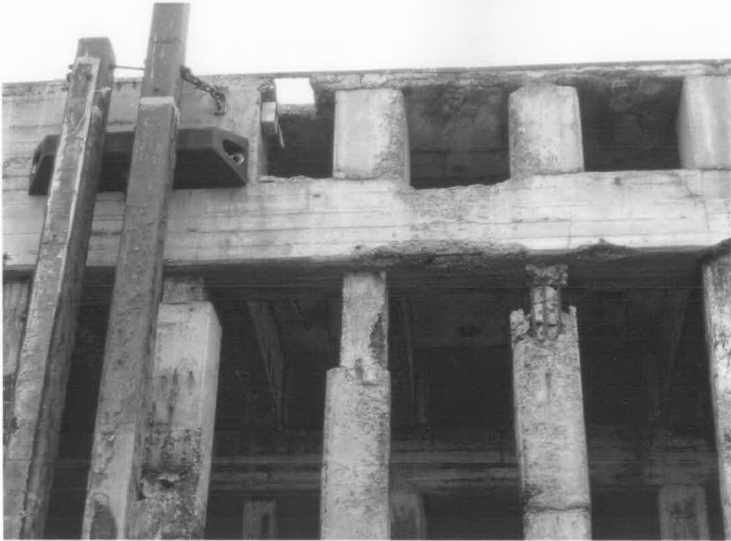
Pilote con pérdida de recubrimiento en el Frente de Atraque
