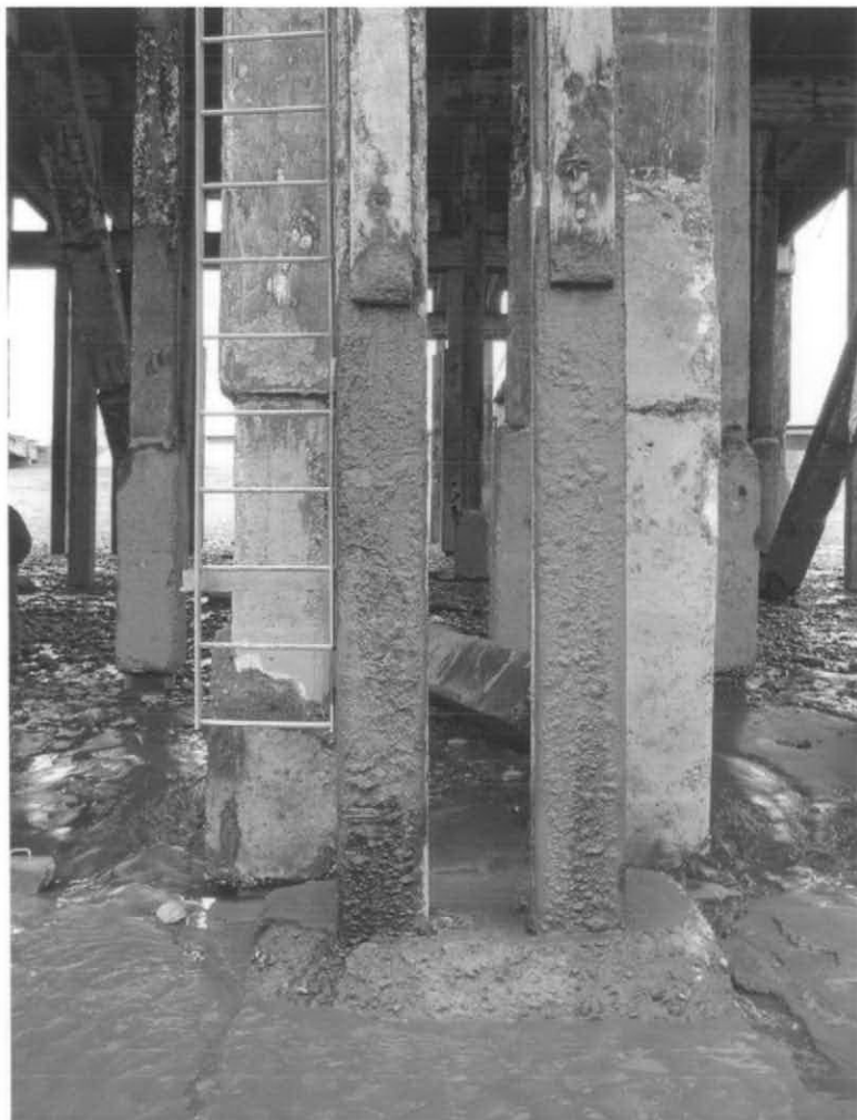
Vista del dado de hormigón al pie de una defensa con escalera
