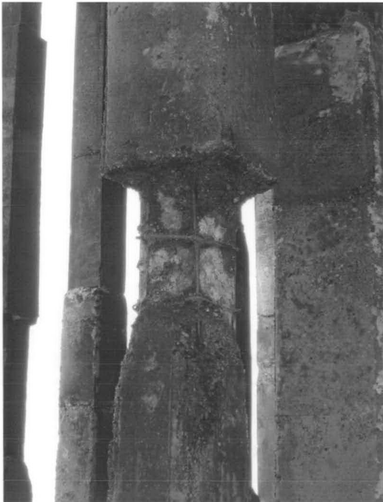
Detalle de daño en pilote
