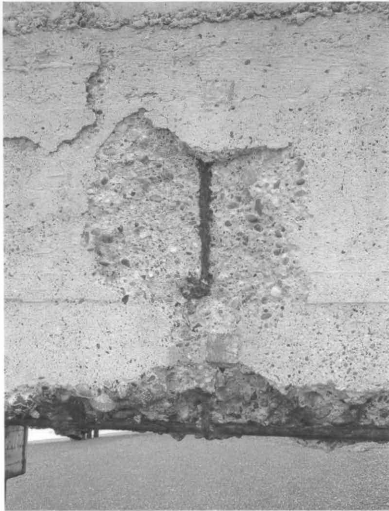
Desprendimiento lateral e inferior del recubrimiento
