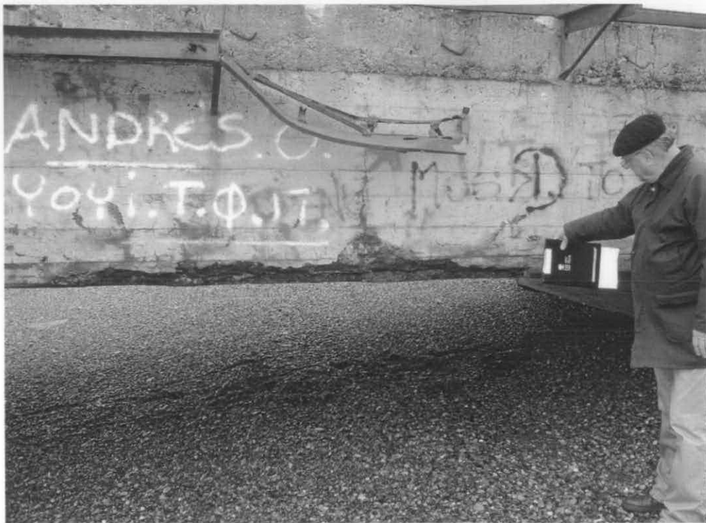
Desprendimiento del recubrimiento en una viga longitudinal de viaducto
