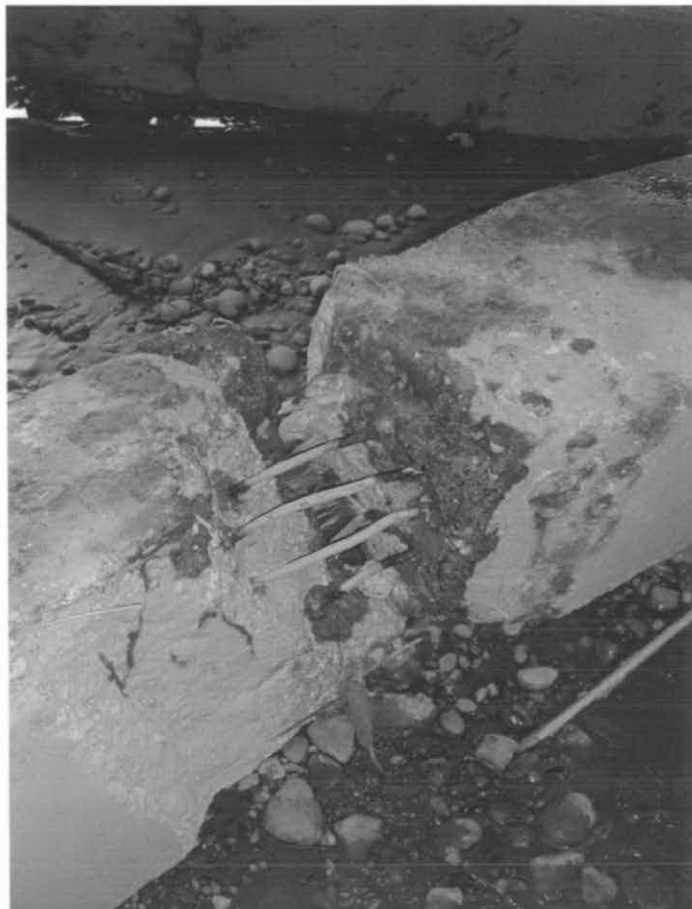
Detalle de armadura expuesta en una diagonal caída
