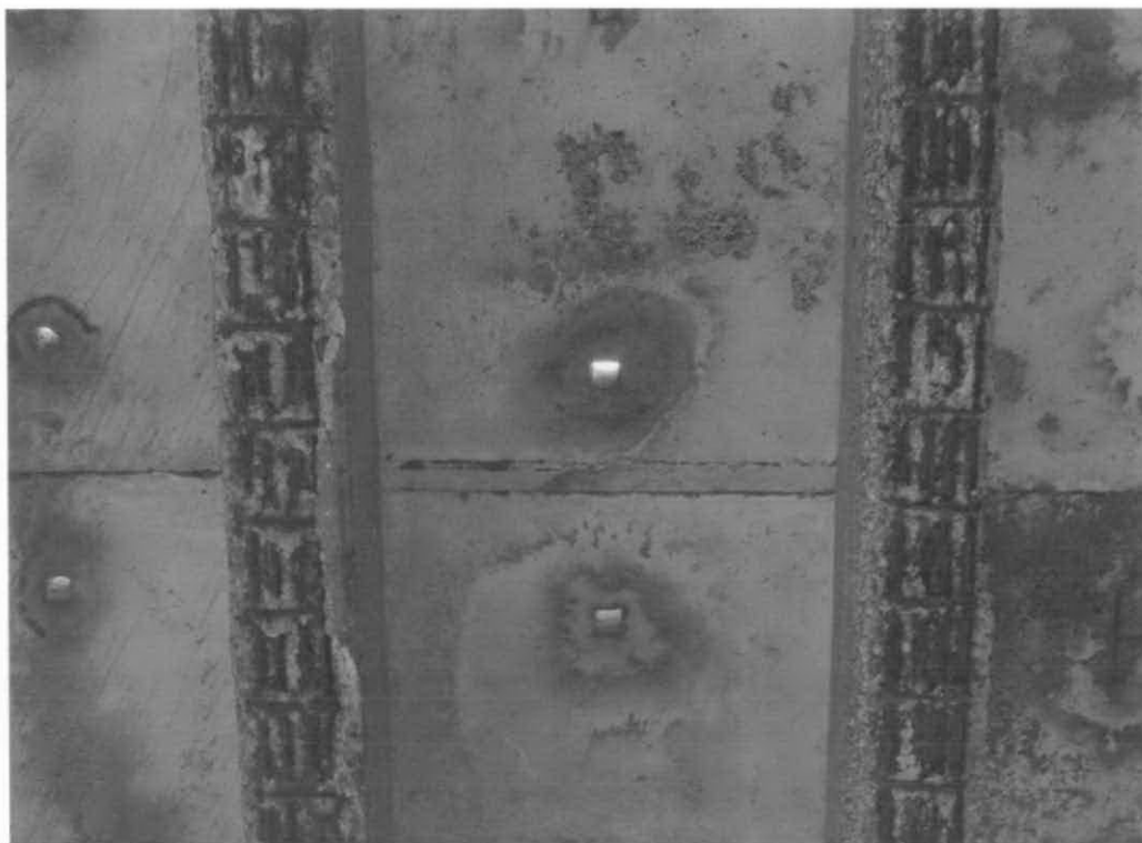
Desprendimiento del recubrimiento en vigas de apoyo de losetas
