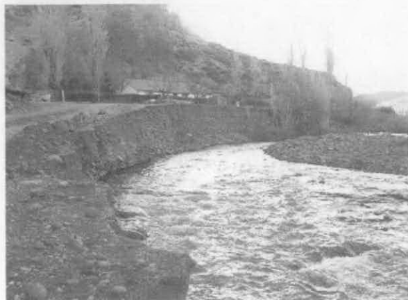
Erosión del río Guañaco pone en peligro el camino que lleva a la Chacra experimental en las proximidades de la confluencia del Guañaco con el Neuquén.
