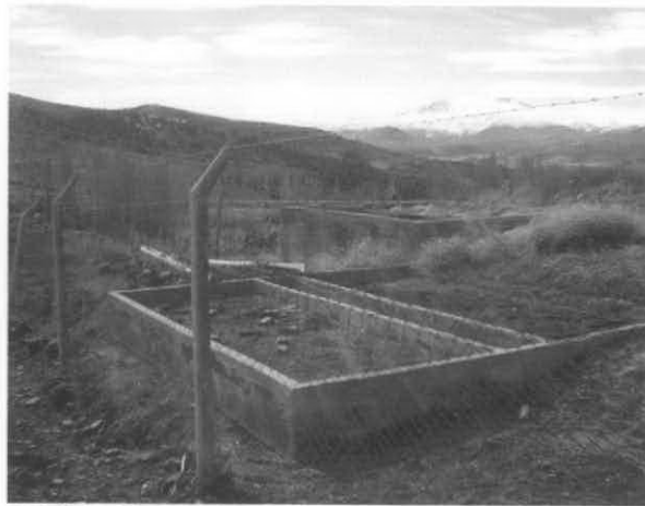
Fig. 6 Vista Planta de Tratamiento Cloacal fuera de servicio.
