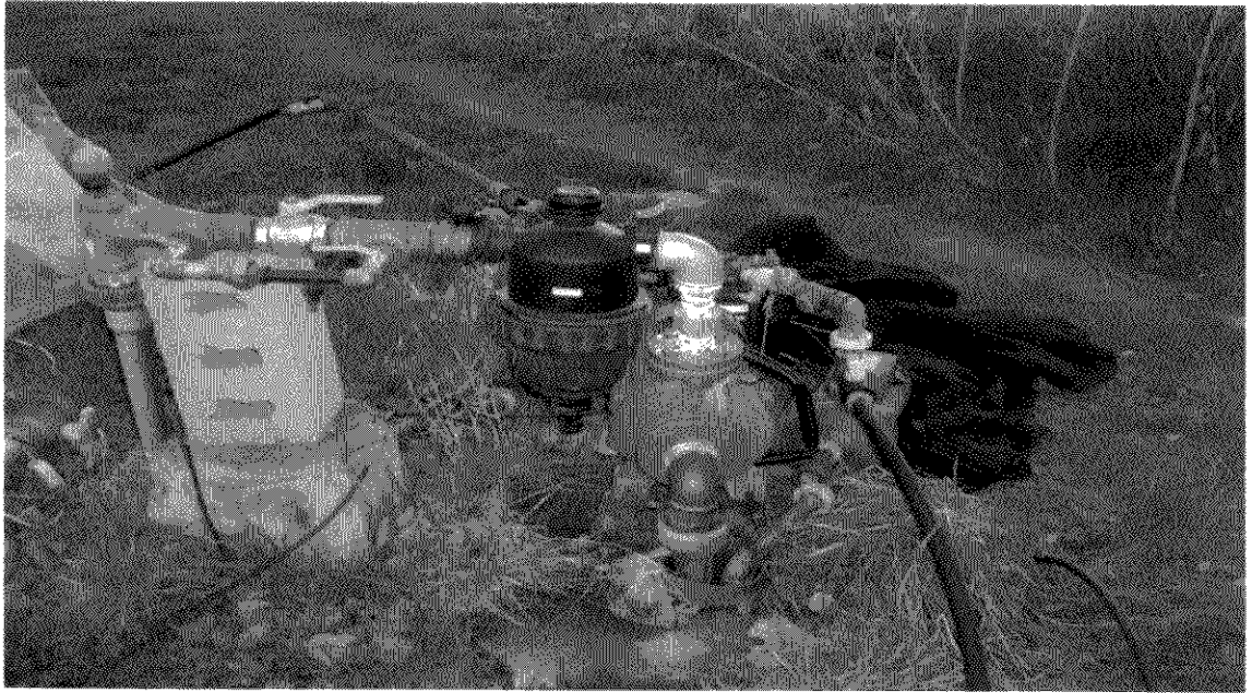
Foto N° 27: Detalle de perforación y cabezal de riego presurizado en Los Antiguos
