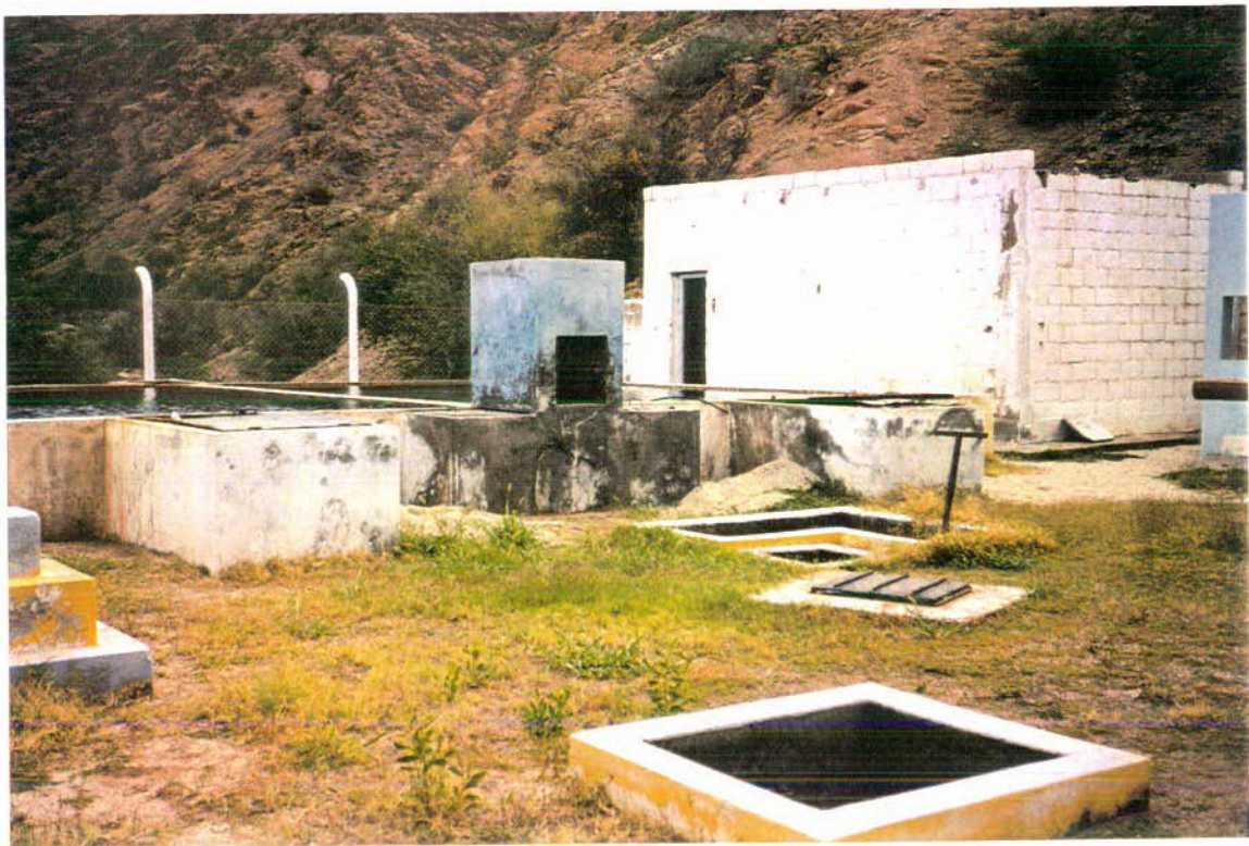
FOTO N° 37: Vista general de los filtros y los dos cloradores de la planta potabilizadora de agua de Villa Mazán.
