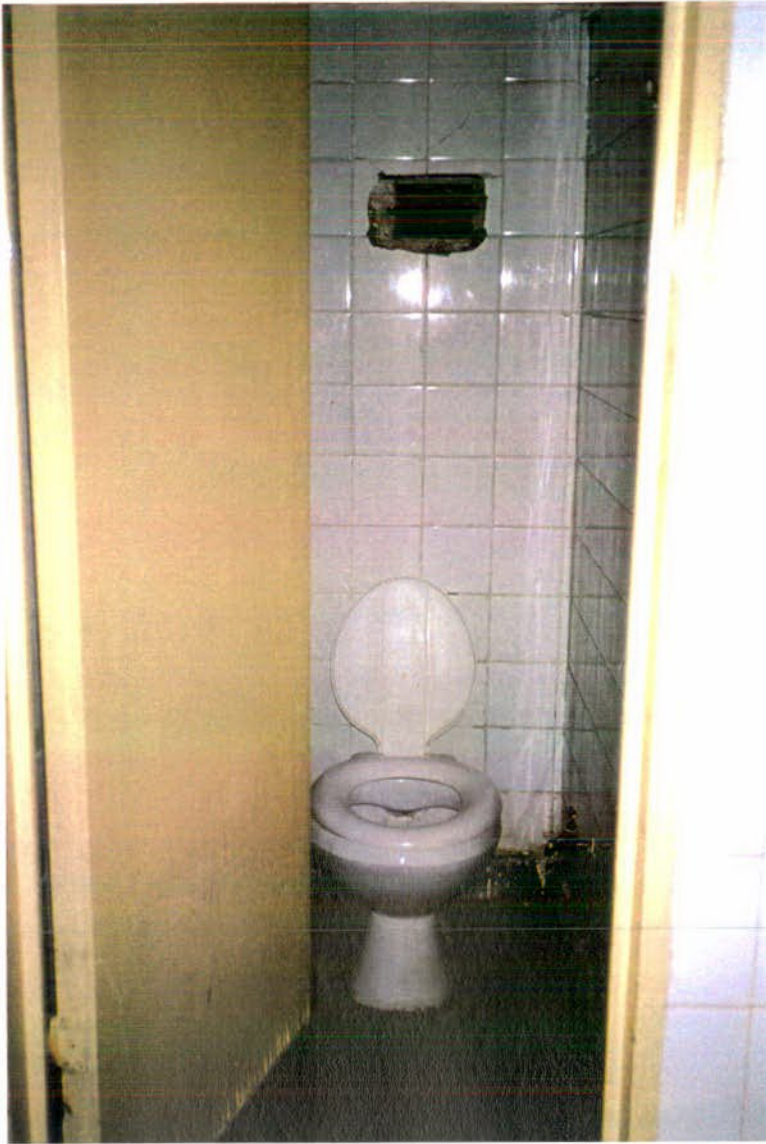
FOTO N° 64: Vista del deterioro que presentan los sanitarios de los alumnos en el edificio de la Escuela primaria y secundaria de Villa Mazán, a pesar de haber sido reparados recientemente.
