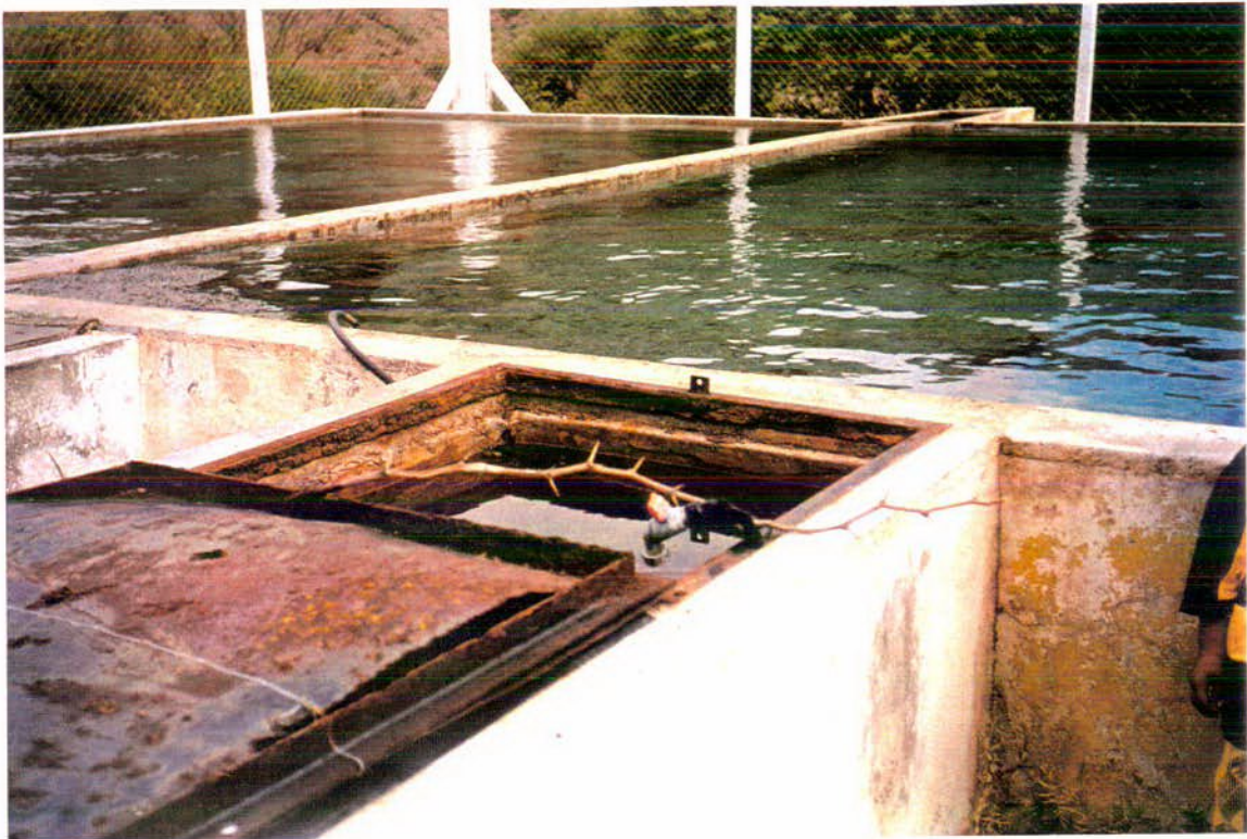
FOTO N° 36: Vista de una de las dos cámaras de cloración que tiene la planta potabilizadora, donde se le añade al agua cloro por goteo.
