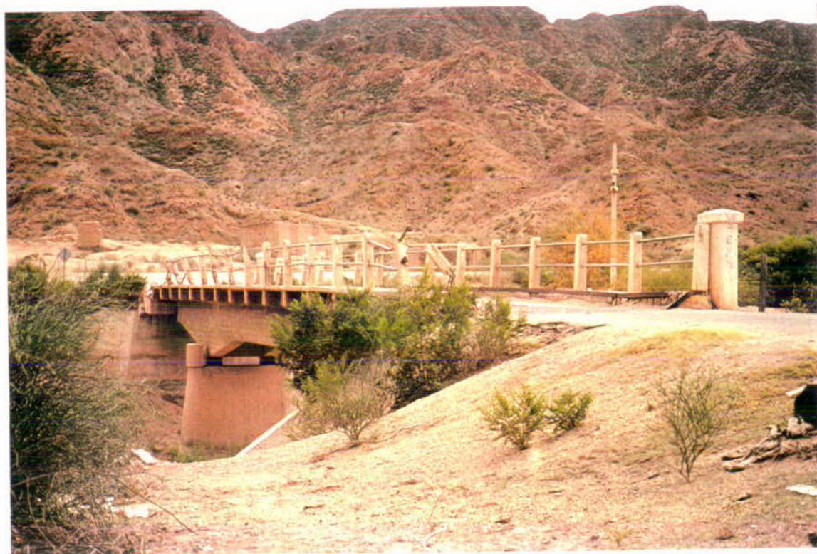
FOTO N° 11: Puente sobre la R.N.N° 60. Es sumamente angosto (3 m de ancho), de una sola mano y en la actualidad no se encuentra en buen estado de conservación.
