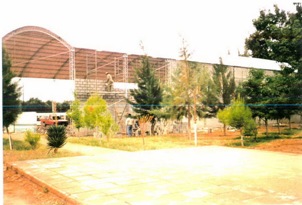
FOTO N° 71: Tinglado del Polideportivo de Villa Mazán, que a la fecha del relevamiento, estaba siendo cerrado con paredes de bloque para protegerlo del viento.
