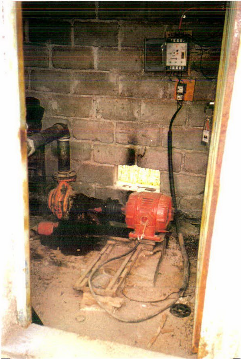
FOTO N° 34: Vista interna de la sala de bombas ubicada frente a la planta potabilizadora de Villa Mazán. El agua es elevada con una bomba centrífuga de eje horizontal conectada a un motor trifásico durante 17 horas al día.
