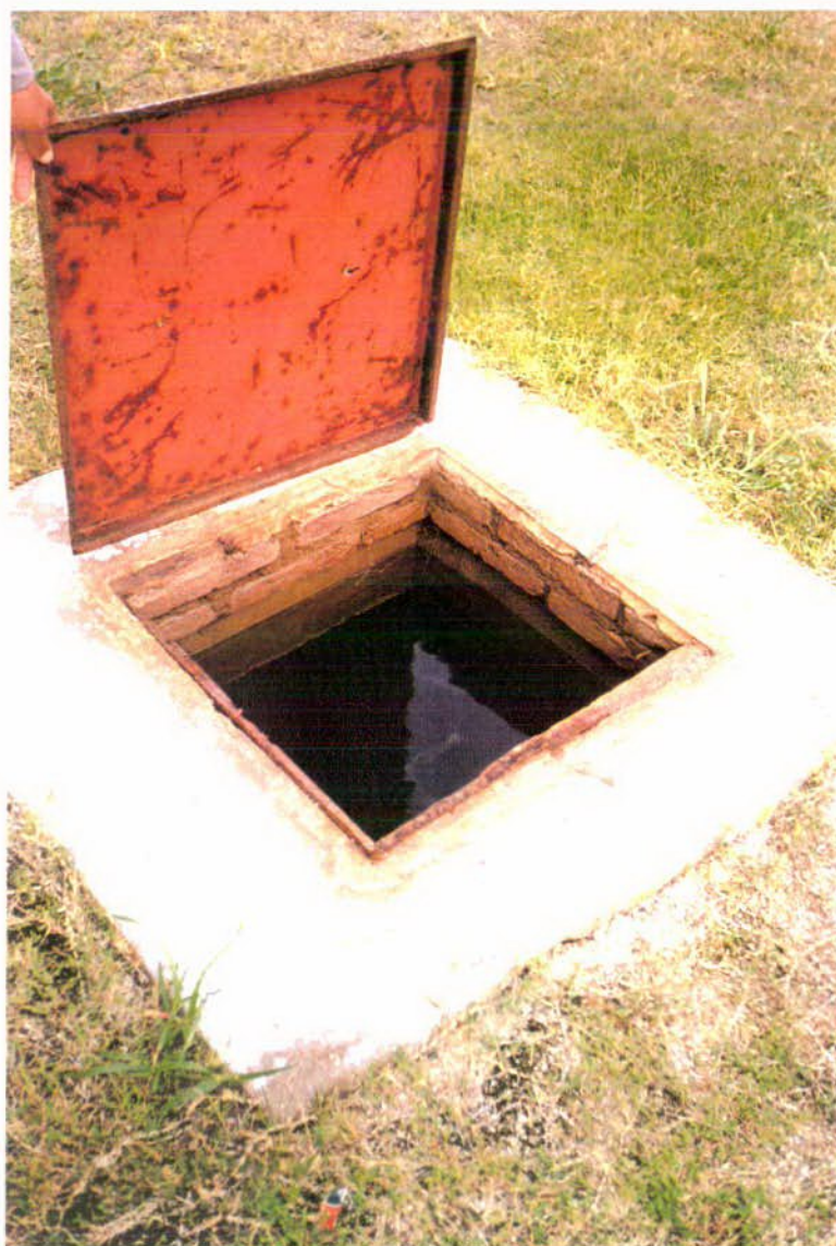
FOTO N° 38: Tapa de la cisterna donde se almacena el agua para consumo humano luego de ser clorada. La capacidad de esta cisterna es de aproximadamente unos 30 m 3 .
