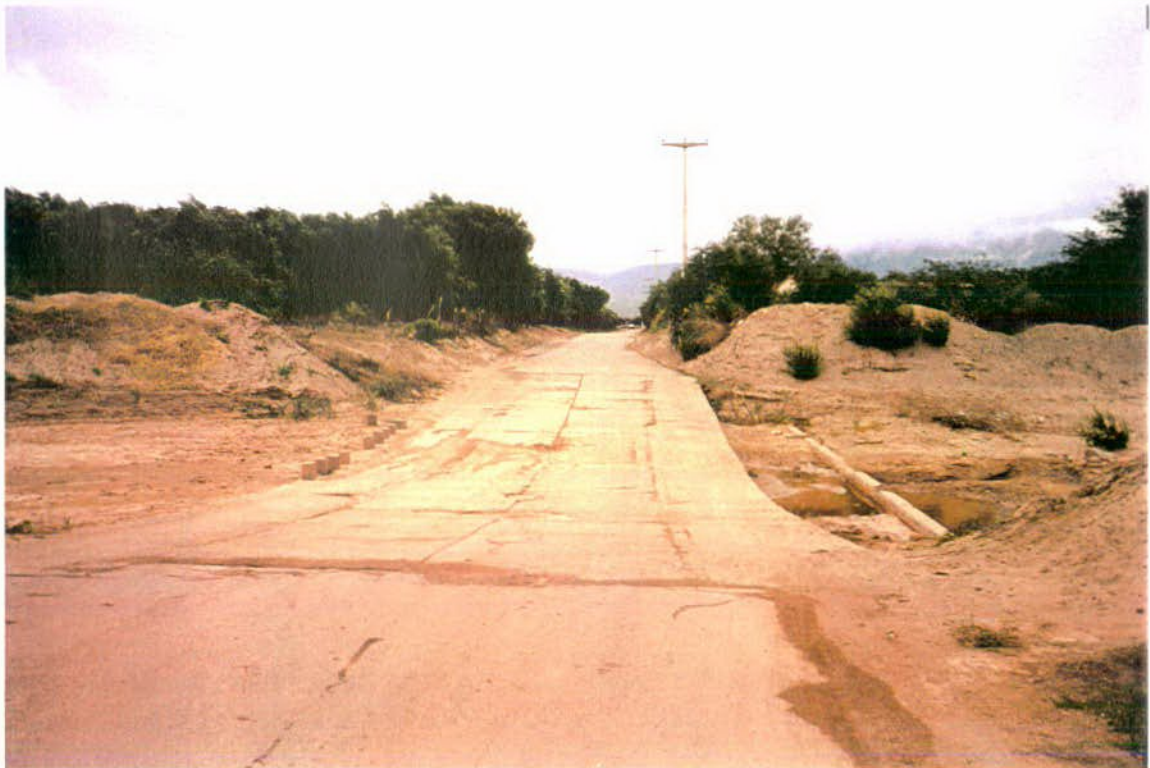
FOTO N° 10: Badén en la “calle del Medio” de Villa Mazán, que es la que permite la comunicación más directa de la localidad con Estación Mazán y la salida a la R.N.N° 60.
