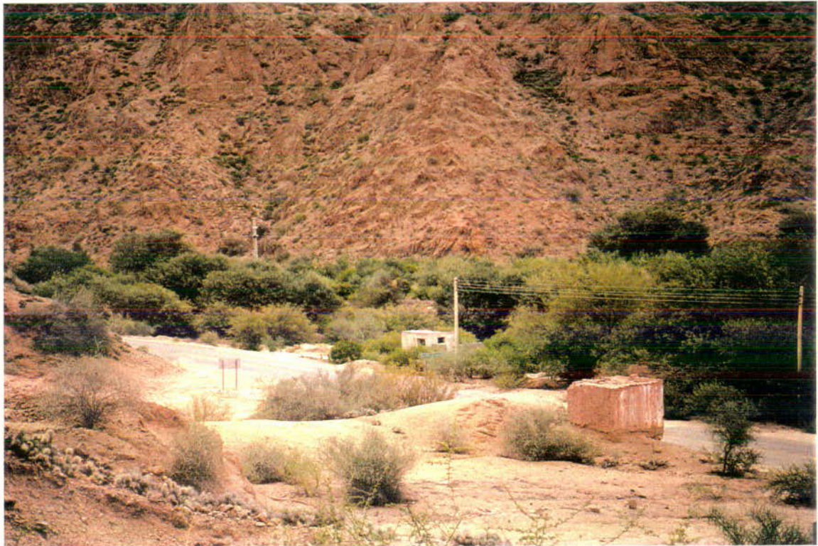
FOTO N° 26 bis: Vista de la casilla donde se encuentran las bombas que permiten elevar el agua a la planta potabilizadora, ubicada sobre la R.N.N° 60 a la entrada de la localidad.
