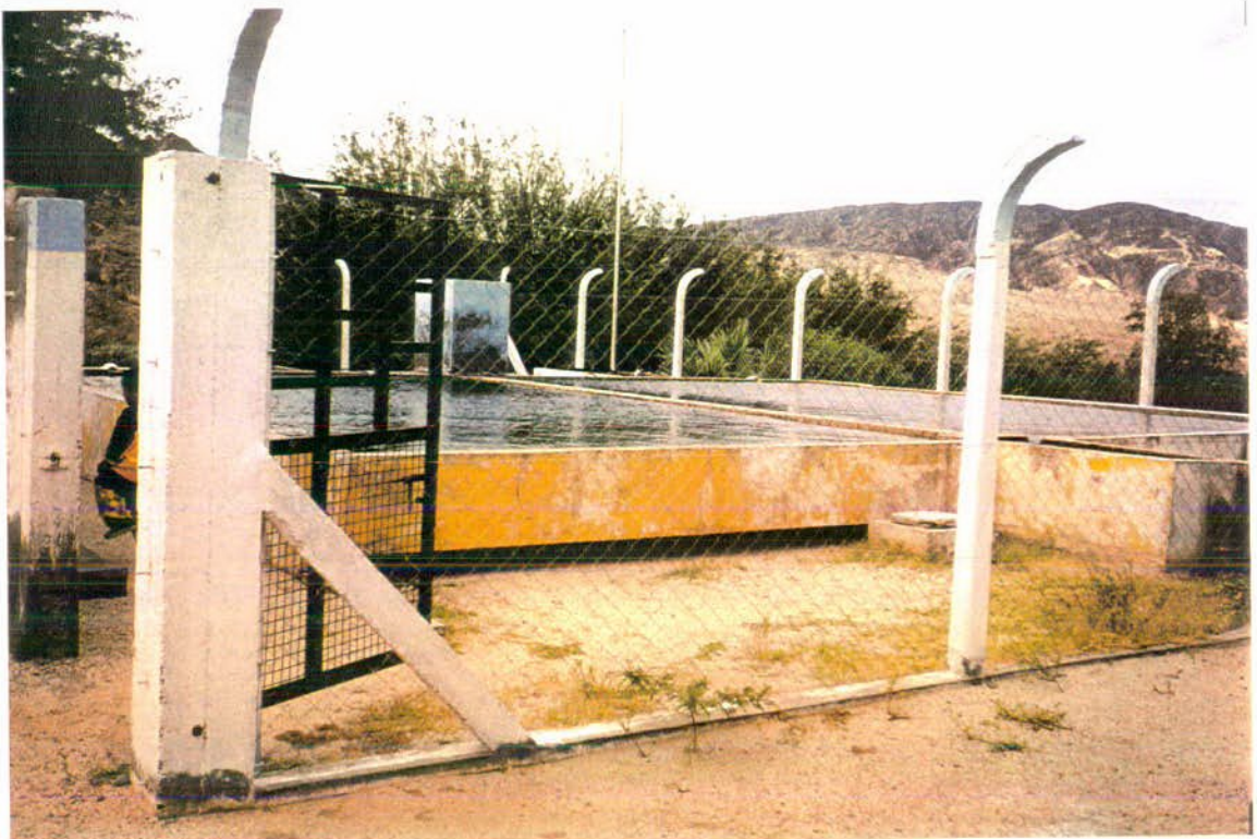
FOTO N° 35: Filtros de la planta potabilizadora a los que ingresa el agua para consumo humano luego de haber sido elevada desde la sala de bombeo.
