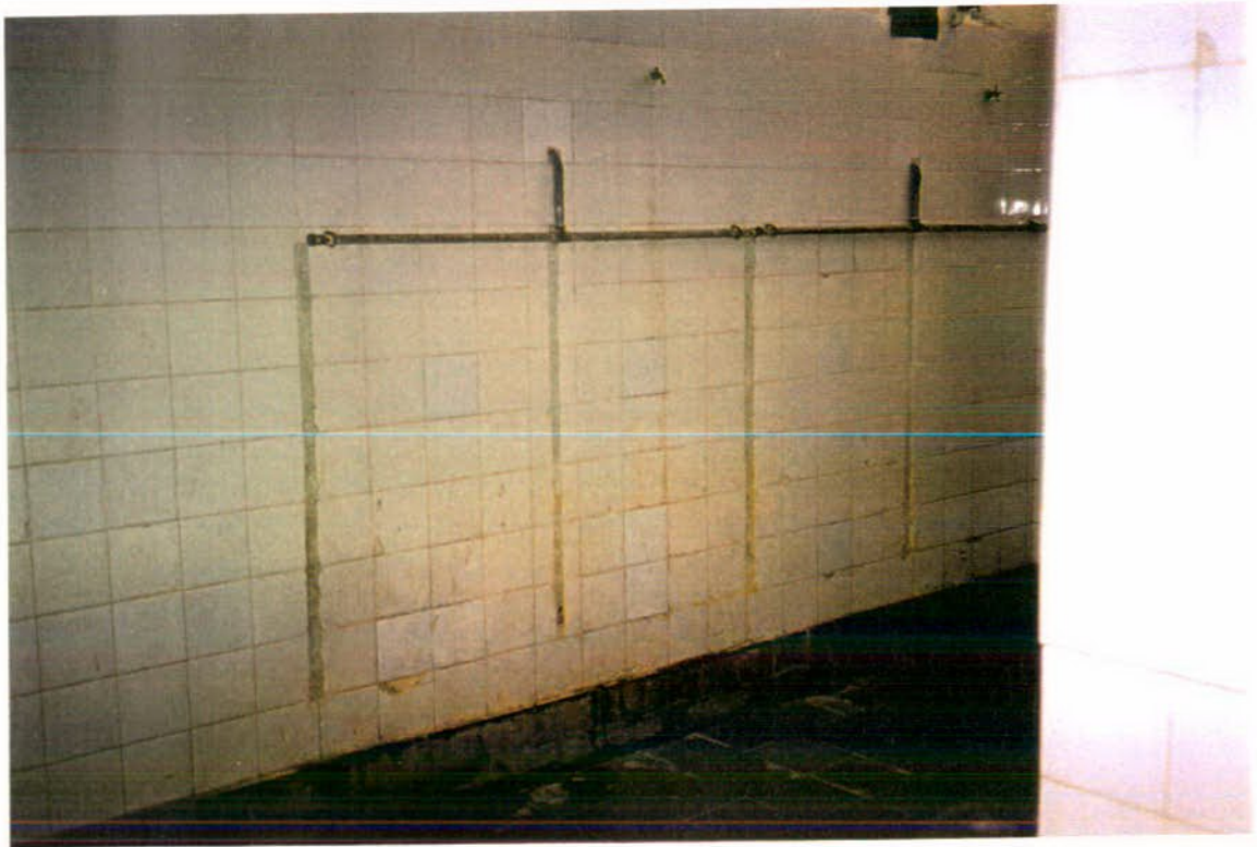
FOTO N° 57: Vista del baño de varones. Tiene tres inodoros, mingitorios y tres lavatorios. A pesar de haber sido reparados, el estado general no es bueno.
